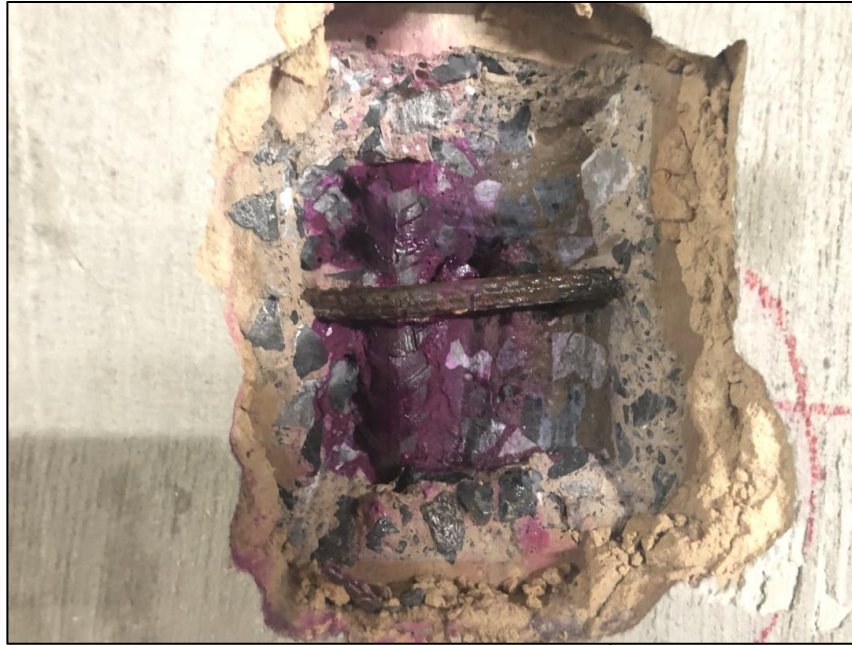
P1 – Concreto Carbonatado
