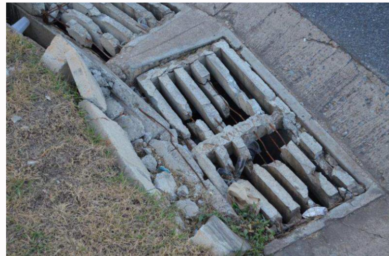
Tampa de bocas de lobo danificadas
