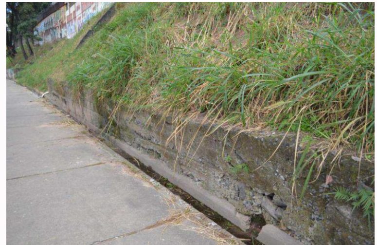
Contenção com sinais de ruptura em sua base
