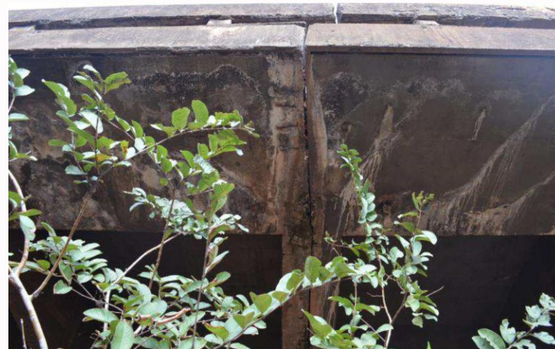
Entorno de junta com armadura aparente e eflorescências
