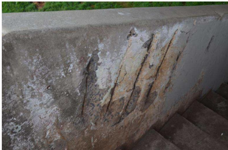
Perda de cobrimento e oxidação de armadura
