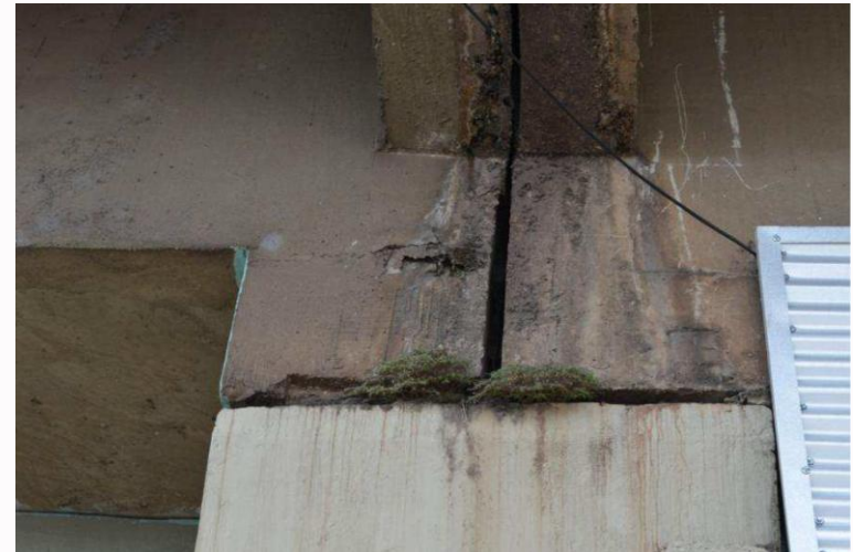
Falta de estanqueidade, com início de lixiviação e crescimento de vegetação
