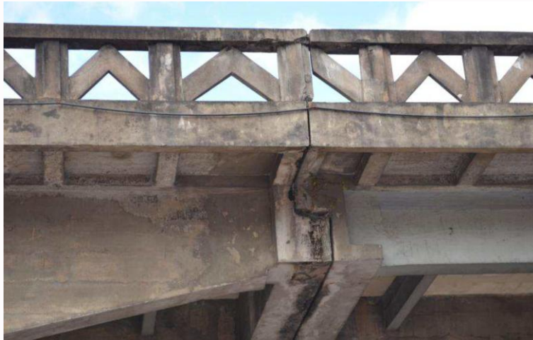
Excesso de umidade no entorno de uma das juntas de dilatação
