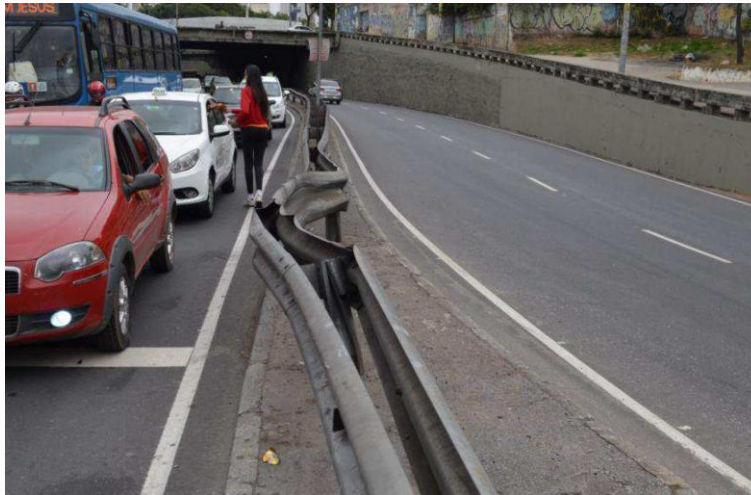
Deformidade em proteção metálica causada por impacto de veículo
