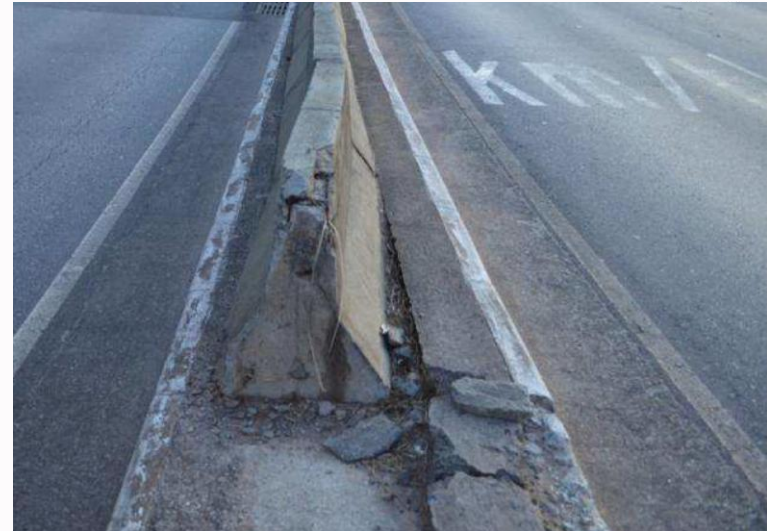
Detalhe ao centro de barreira de concreto danificada por colisão
