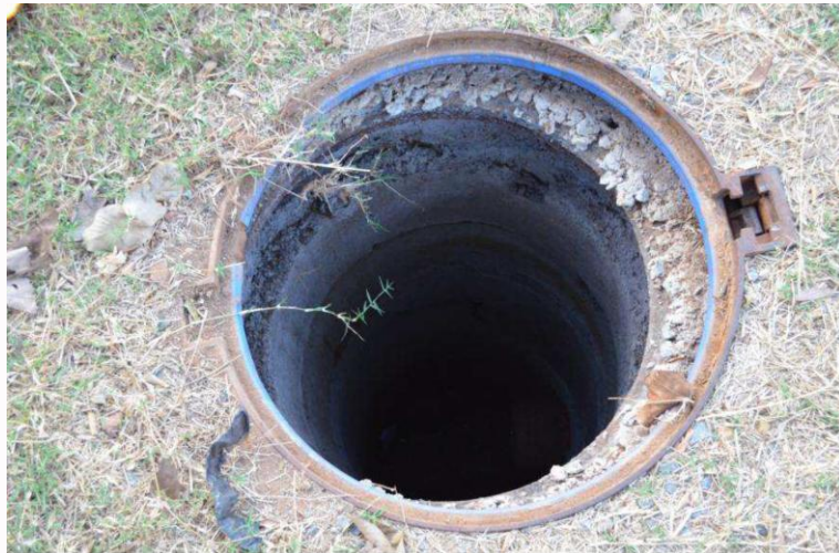
Falta de tampa, implicando em risco a pedestres
