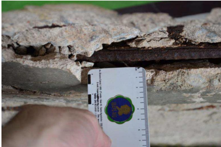
Detalhe ao centro de barreira de concreto danificada por colisão
