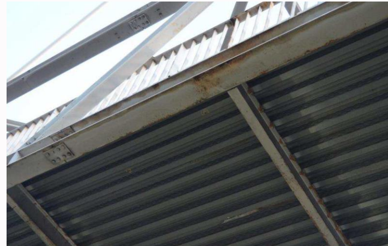
Início de processo de corrosão em passarela metálica
