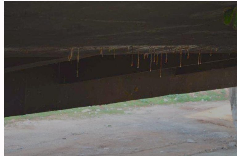
Formação de estalactites na parte inferior da laje do viaduto
