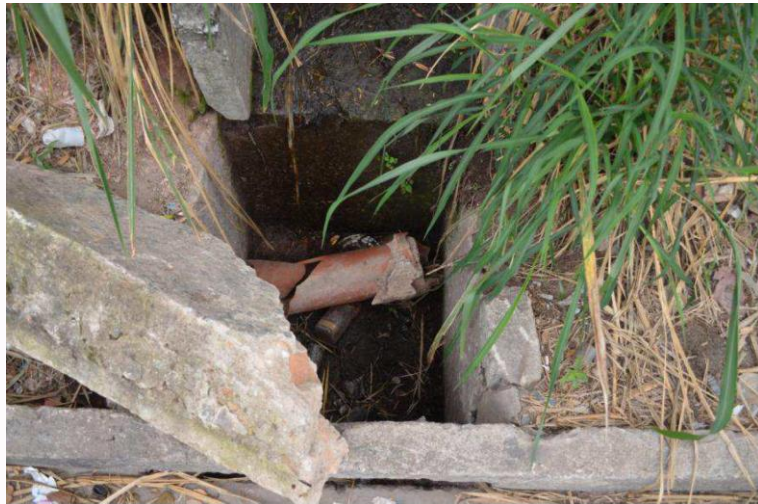
Tubo rompido, dentro da escada hidráulica pedestres, prejudicando o sistema de drenagem
