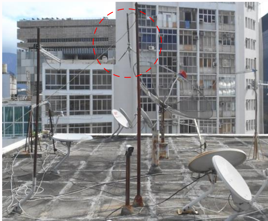
FALHAS DE MANUTENÇÃO Mastros de para-raios quebrados
