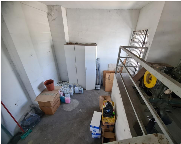
Armazenamento inadequado de objetos, materiais e resíduos em partes da edificação
