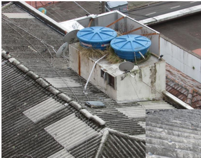
FALHAS DE USO E MANUTENÇÃO Pavimentos técnicos de cobertura/telhado
