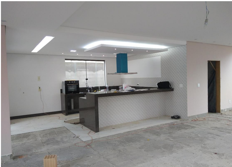
Imagem 4 – Remoção do revestimento do piso, confirmando que não houve a dos cordões de argamassa aplicada ao substrato
