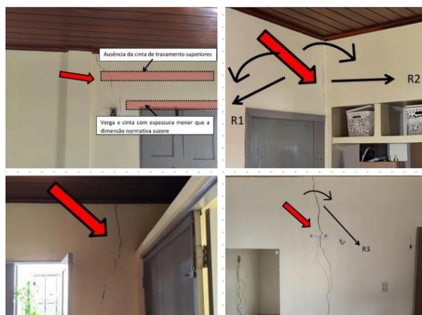
Figura 3 – Primeiro quadrante: Rachadura em canto superior da sala, acima da esquadria da porta, indicando propagação da patologia para áreas internas. Segundo quadrante: Fissura no canto esquerdo acima da janela, destacando ausência de vergas e contravergas. Terceiro quadrante: Detalhe complementar do mesmo padrão patológico acima da esquadria da janela oposta. Quarto quadrante: Fendas estruturais identificadas no dormitório da suíte de casal, revelando avanço dos danos.
