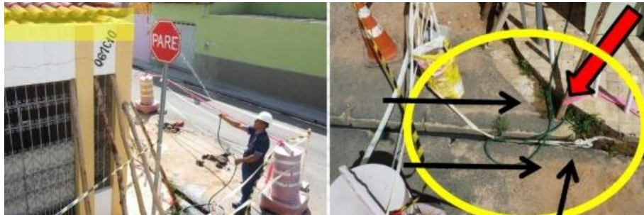
Figura 8 – Esquerda: teste de saturação com mangueira sobre laje não grampeada, evidenciando pontos críticos de infiltração. Direita: detalhe do sistema de drenagem ineficaz, sem válvula de retenção e com fluxo retrógrado observado.
