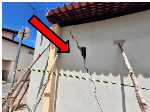
Figura 6 - Ponto de destacamento induzido na fachada lateral, evidenciando ausência de pilares estruturais e vigas longitudinais.
