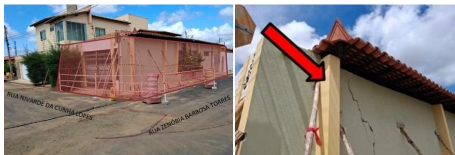
Figura 1: imagem superior representando a fachada principal da residência com presença de escoramentos e isolamento, demonstrando risco iminente de colapso. Imagem inferior: detalhe das rachaduras na quina da fachada lateral, com fissura vertical compatível com recalque por percolação e ausência de travamento estrutural.
