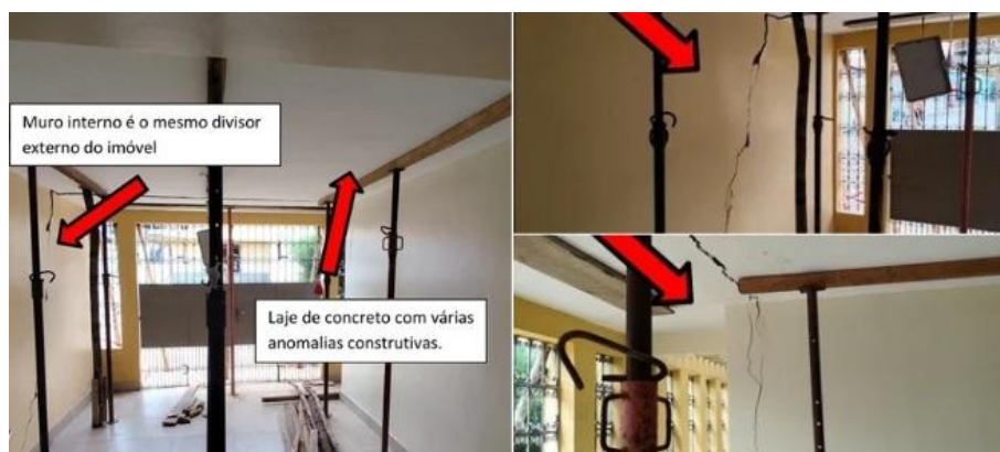
Figura 2 – À esquerda: rachaduras na parede lateral da garagem, com escoramento instalado. Direita superior: rachaduras extensas na parede da garagem, associadas a recalque de rotação e ausência de grampeamento entre volume estruturais. Direita inferior: vista interna complementar das fissuras na garagem, demonstrando abertura significativa.
