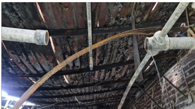
Figura 6 - Rede pressurizada sem funcionamento, devido ao registro de gaveta fechado
