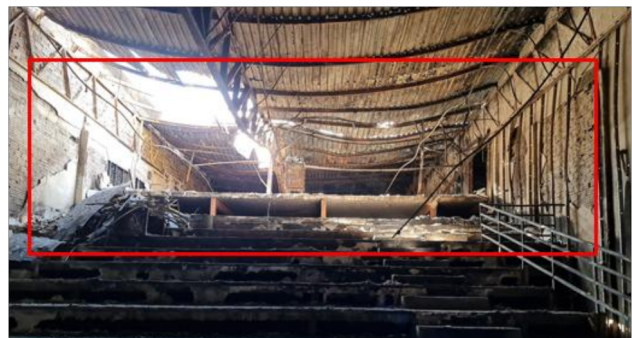
Figura 9 - Região de ignição do incêndio e atendida pela rede de sprinklers
