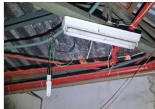
Figura 14 - Instalações tipo "gambiarras"
