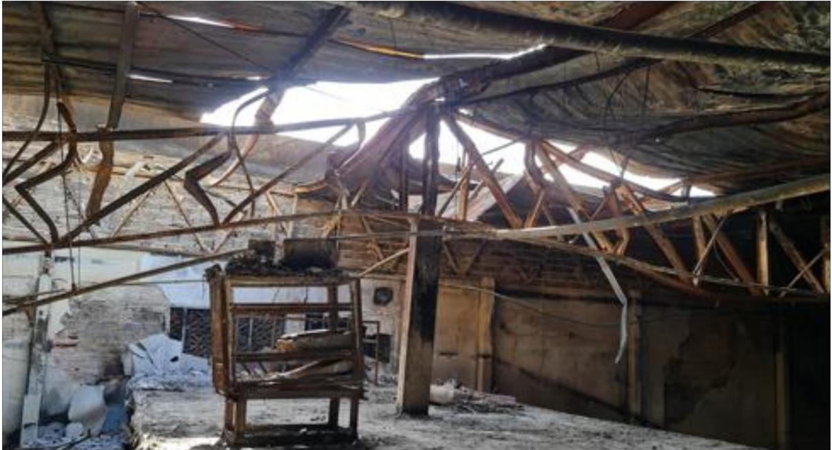
Figura 16 - Região onde inicialmente suspeitava como ponto de ignição, porém sem nexo causal – Local com maior deformação das estruturas em comparação com as outras salas de cinema – Arquivo Próprio
