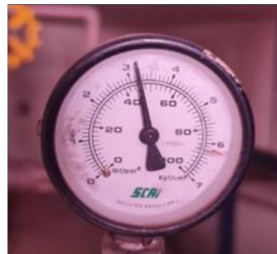
Figura 21 - Pressão do Sistema pós Incêndio
