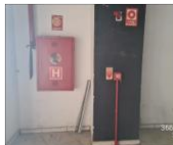
Figura 22 – Conjunto: Hidrante, avisador sonoro/ visual e acionador de alarme
