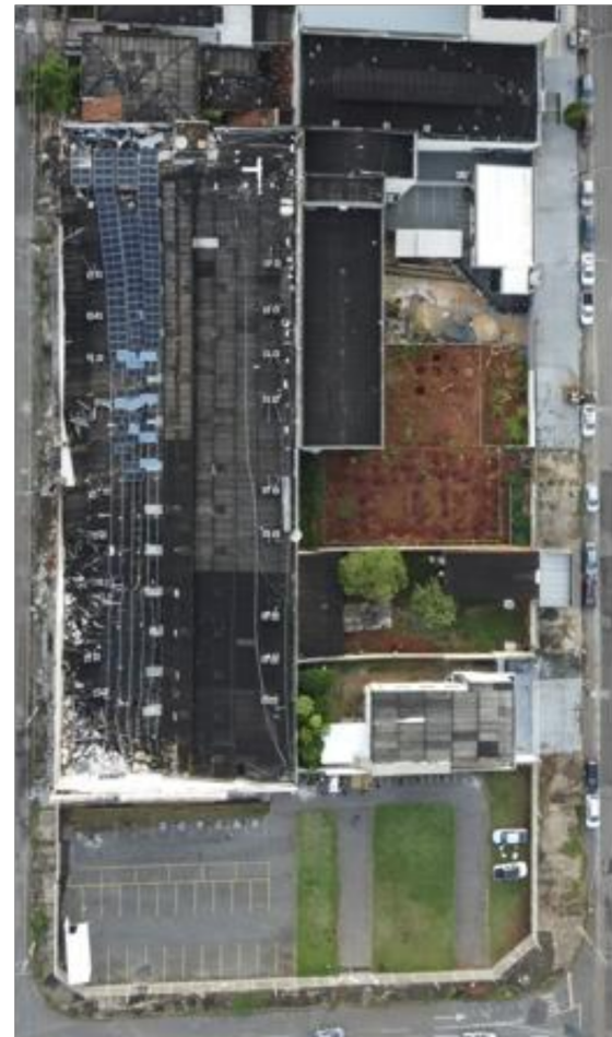
Figura 2 - Vista superior da igreja, após colapso
