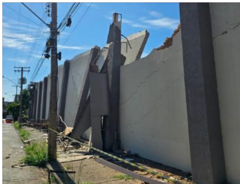
Figura 10 - Muros limítrofes com risco de colapso - arquivo próprio
