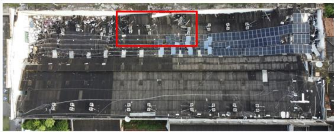
Figura 23 - Local onde ocorreu o colapso estrutural – Arquivo Pessoal
