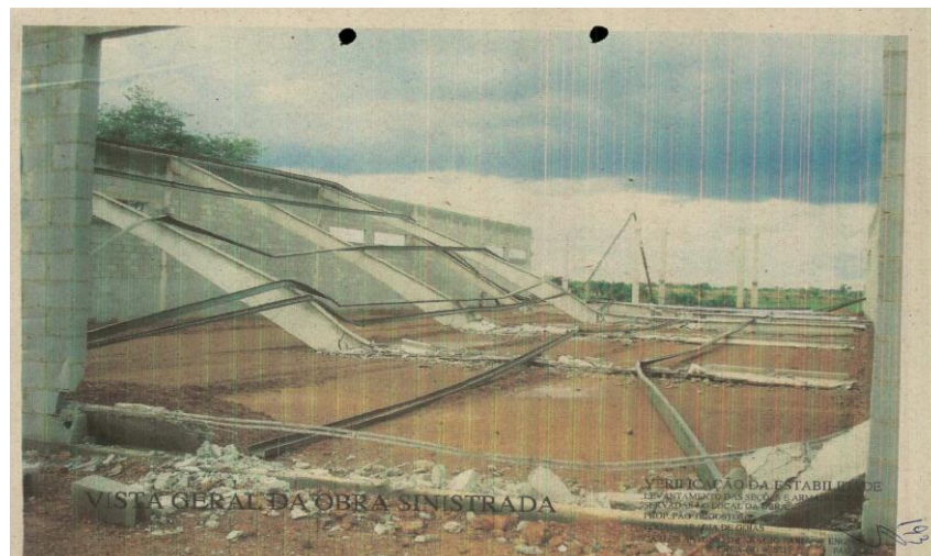
Figura 12 - Visão geral da edificação após ruína, imagem anexada nos autos
