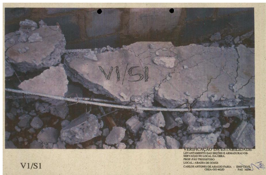
Figura 13 - Ruína total do concreto da viga – arquivo disponível nos autos
