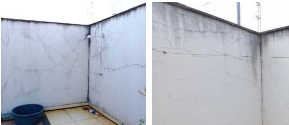
Figura 2: Fissuras mapeadas nos revestimentos de algumas paredes, fachadas e muros.
