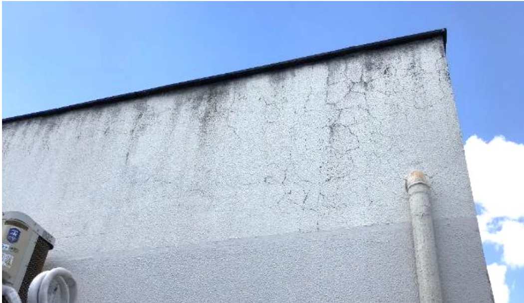
Figura 6: Sinais de umidade no topo de muros e fachadas. Fonte: Autores, 2024.
