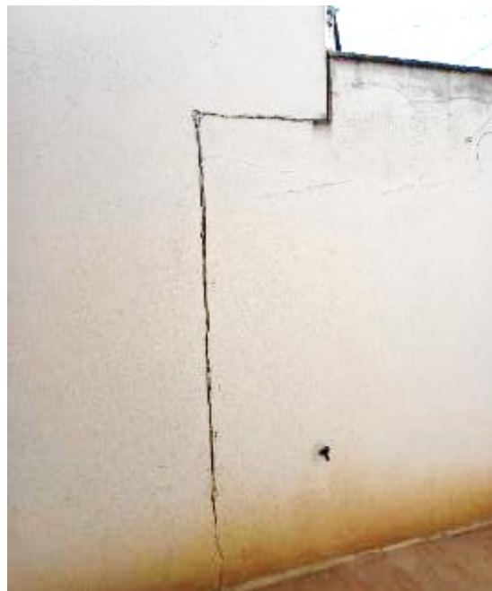
Figura 4: Trincas e/ou aberturas de destacamento. Fonte: Autores, 2024.
