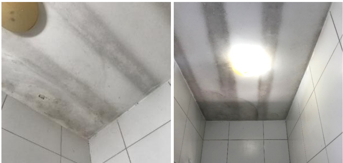
Figura 5: Infiltrações no topo das paredes e teto. Fonte: Autores, 2024.
