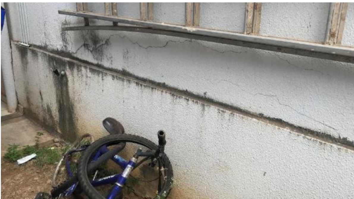
Figura 3: Fissuras e trincas nos revestimentos de algumas paredes, fachadas e muros. Fonte: Autores, 2024.
