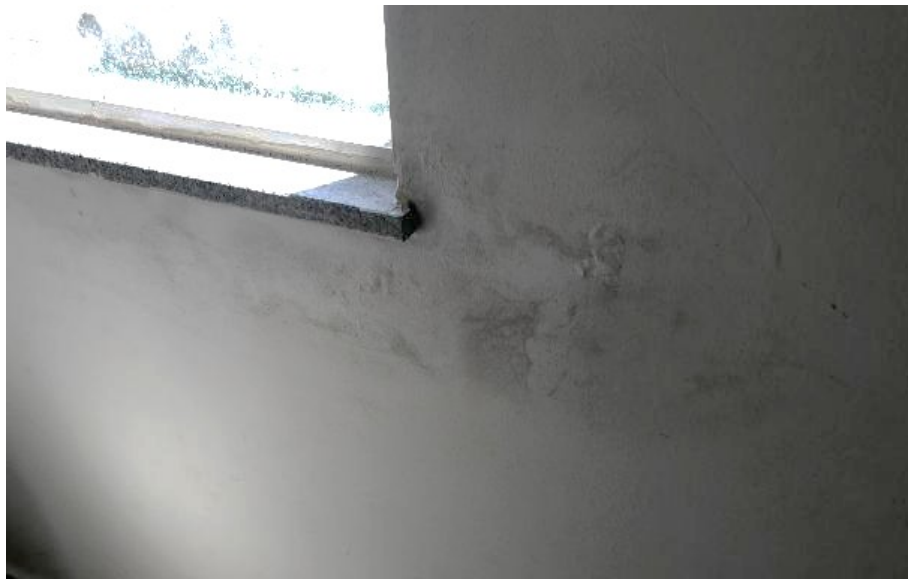
Figura 7: Infiltrações no entorno das janelas Fonte: Autores, 2024.
