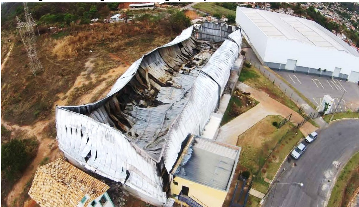
Figura 13 – Imagem aérea do galpão após o incêndio
