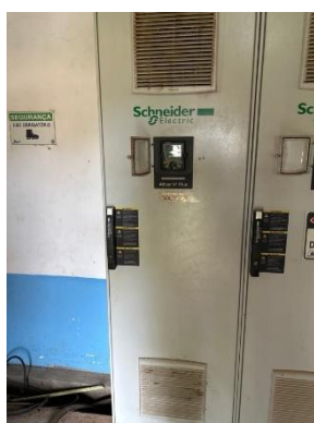
Painel das bombas de captação
