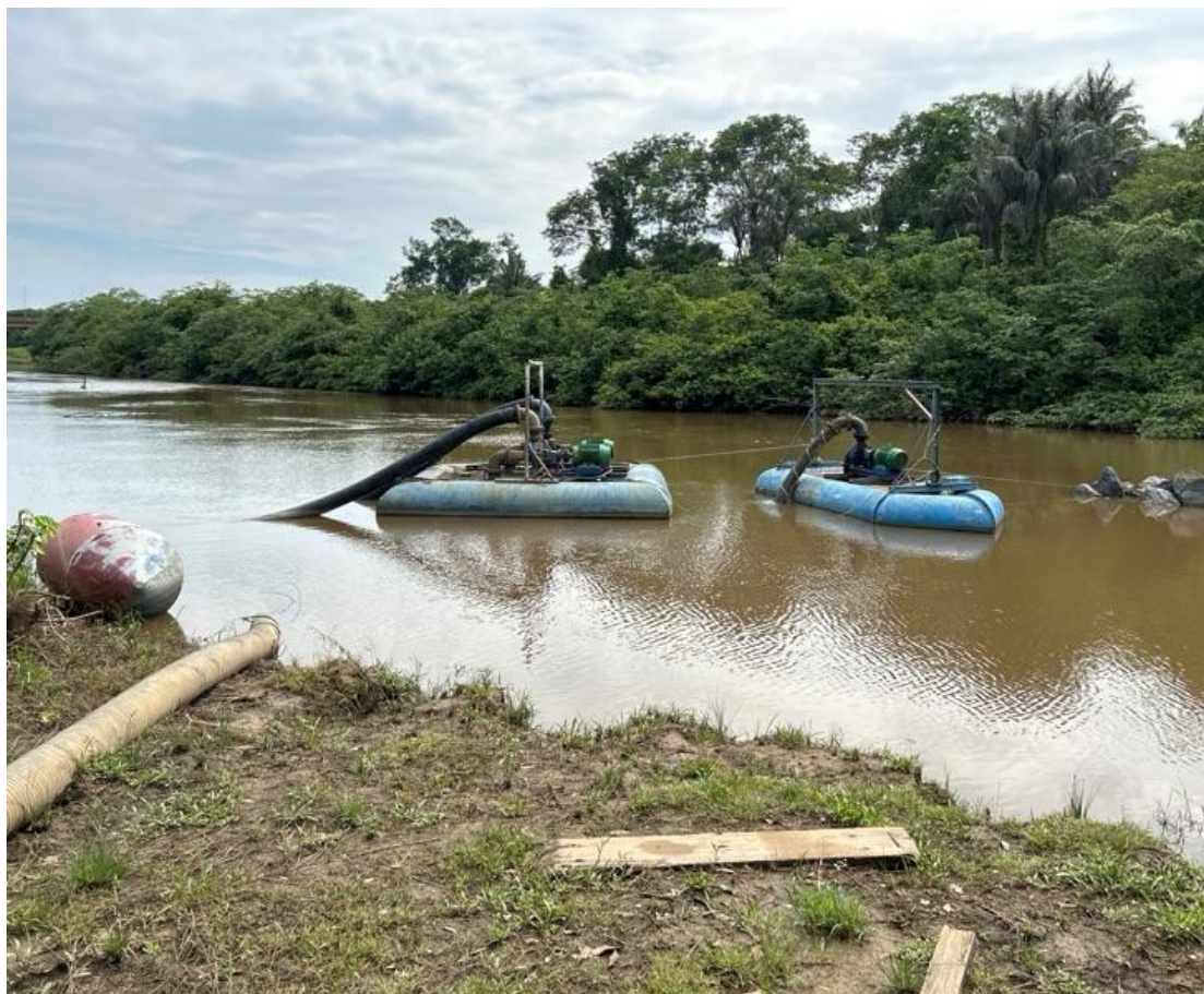
Figura 2 – Captação de água bruta
