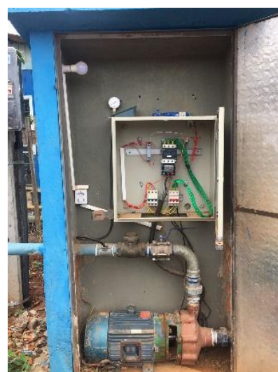
Bomba e painel de comando
