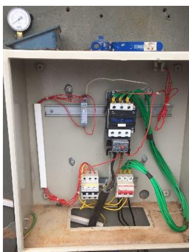
Painel de comando
