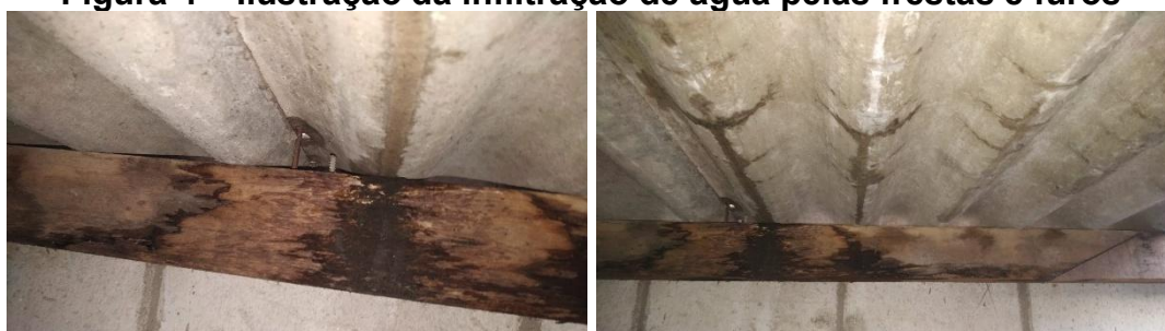
Figura 4 – Ilustração da infiltração de água pelas frestas e furos
