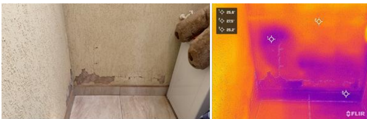
FIGURA 4: Parede da área de serviço da edificação 3. FONTE: Autoria própria, (2025).
