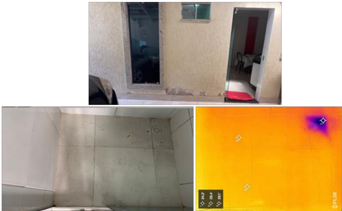
FIGURA 5: Parede e piso do banheiro da edificação 3. FONTE: Autoria própria, (2025).
