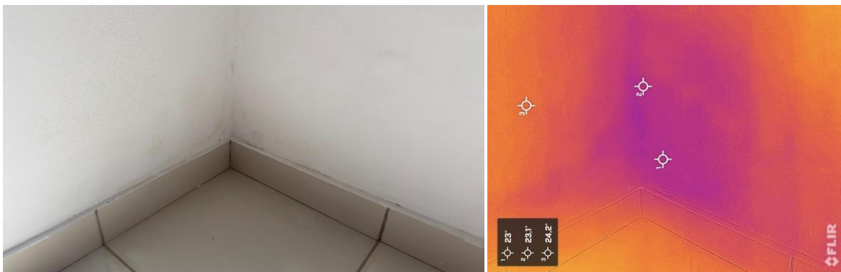
FIGURA 3: Parede do quarto suíte da edificação 3. FONTE: Autoria própria, (2025).
