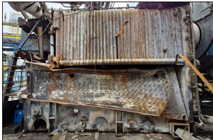
Figura 11: Explosão de caldeira. Fonte: autoria própria
