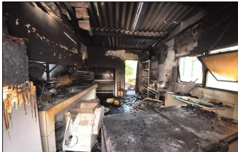
Figura 12: Cozinha industrial destruída devido incêndio por chama aberta (fogão). Fonte: https://www.campograndenews.com.br/cidades/capital/homem-esquece-oleo-no-fogao-e-cozinha-industrial-pega-fogode News
