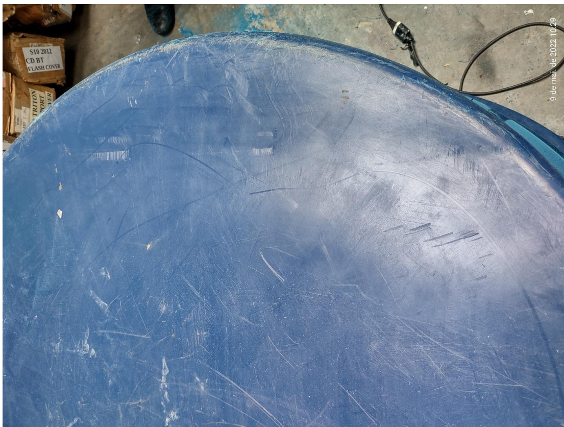
Figura 17 – Evidência da dobra.
