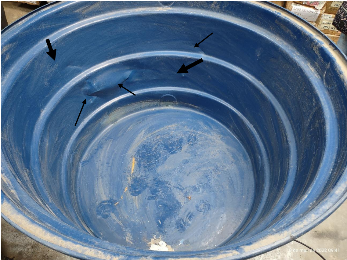
Figura 10 – Evidências da falha em serviço.
