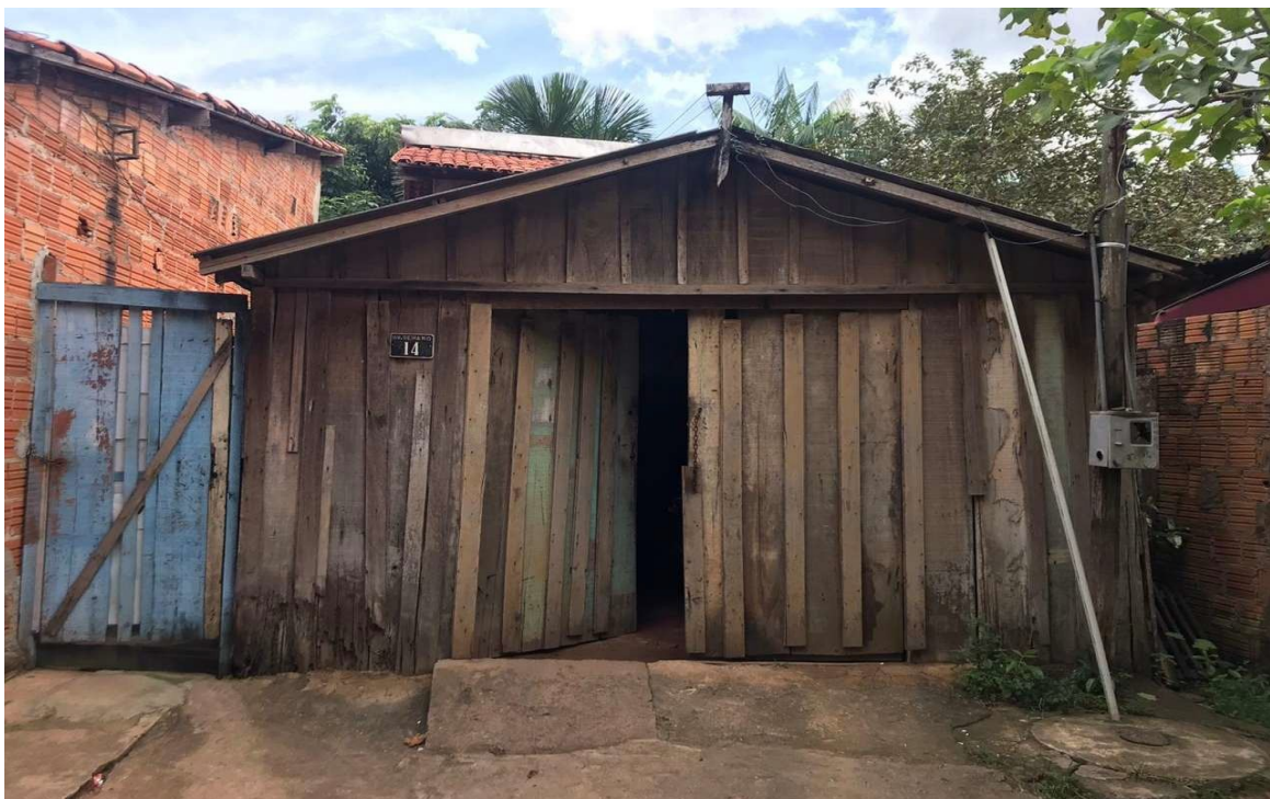
Figura 11: Exemplo de tipologia de edificação afetada (autoria própria).
