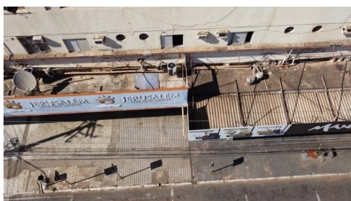
Foto 22: Sobrepeso de estruturas metálicas, antenas, aparelhos de ar condicionado e outras instalações
