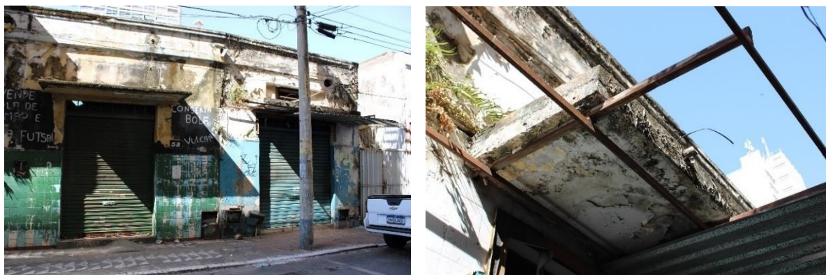
Fotos 12 e 13: Marquise com grau severo de degradação devido a umidade apresentando deslocamento de concreto e ferrugem com corrosão.
