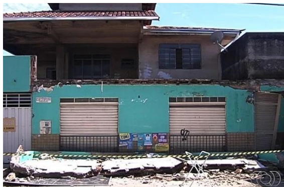
Foto 7: Fachada da padaria após queda da marquise em Goiânia. Fonte: MaisGoiás.com
