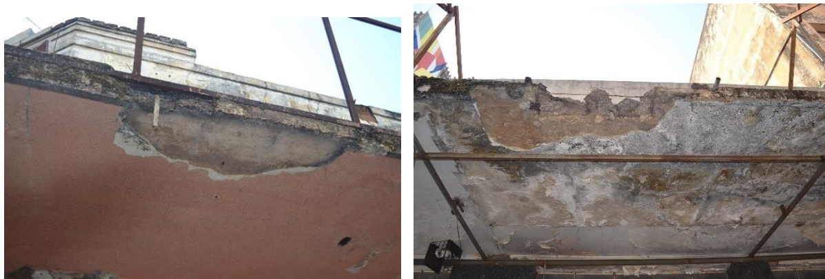
Foto 20 e 21: Marquise com grau severo de degradação e deslocamento de acabamento e concreto.
