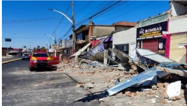
Foto 6: Marquise colapsada em Aparecida de Goiânia. Fonte: MaisGoiás.com
