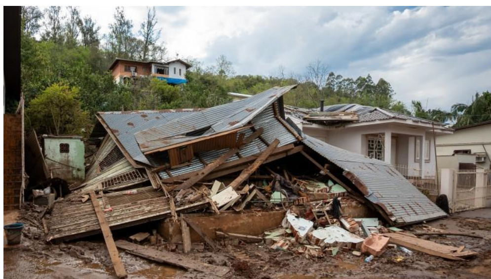
Figura 4 - Benfeitoria destruída (Fonte: https://ssp.rs.gov.br/calamidade-publica-no-estado-e-reconhecida-pelo-governo-federal )
