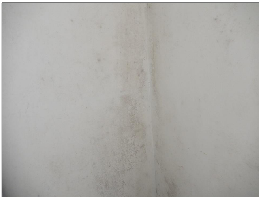
Figura 15: Manchas decorrentes de condensação, que acometem área extensa do cômodo, sem apresentar degradação do revestimento de gesso
