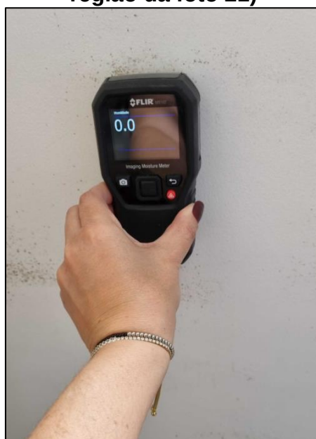
Figura 26: Índice de umidade nulo, indicando inexistir infiltrações (mesma região da foto 21)
