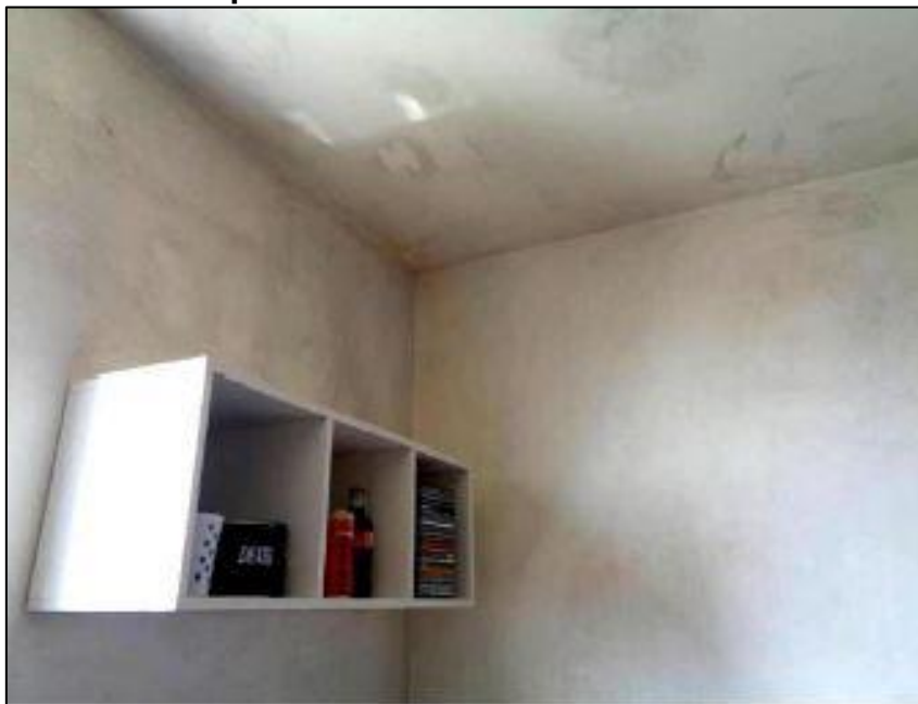
Figura 9: Manchas decorrentes de condensação que acometem praticamente todo o cômodo
