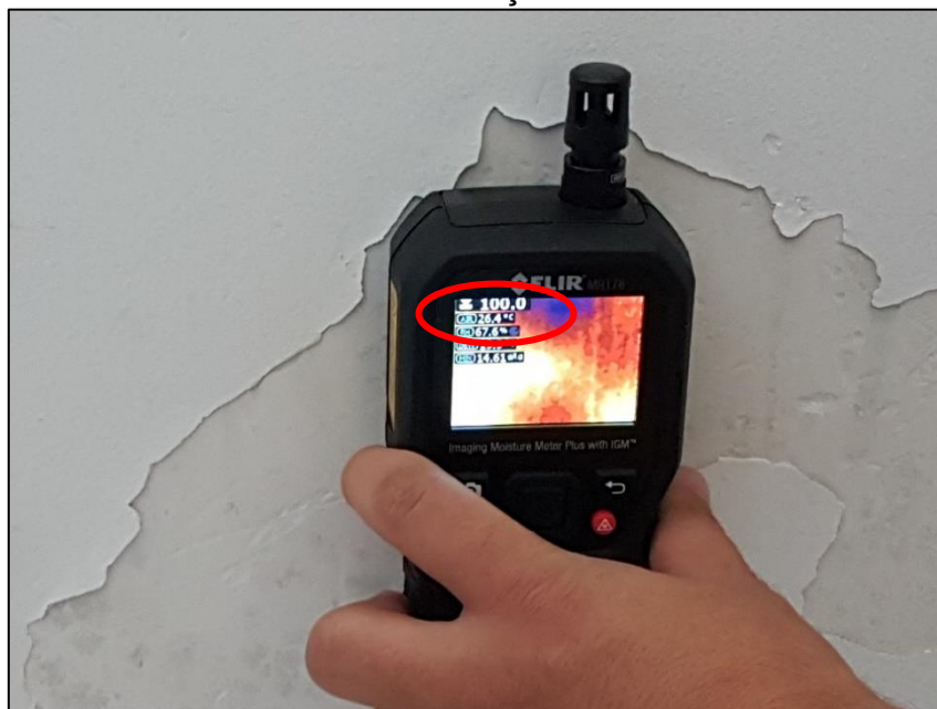
Figura 6: Índice de umidade de 100%, indicando patologia decorrente de infiltração
