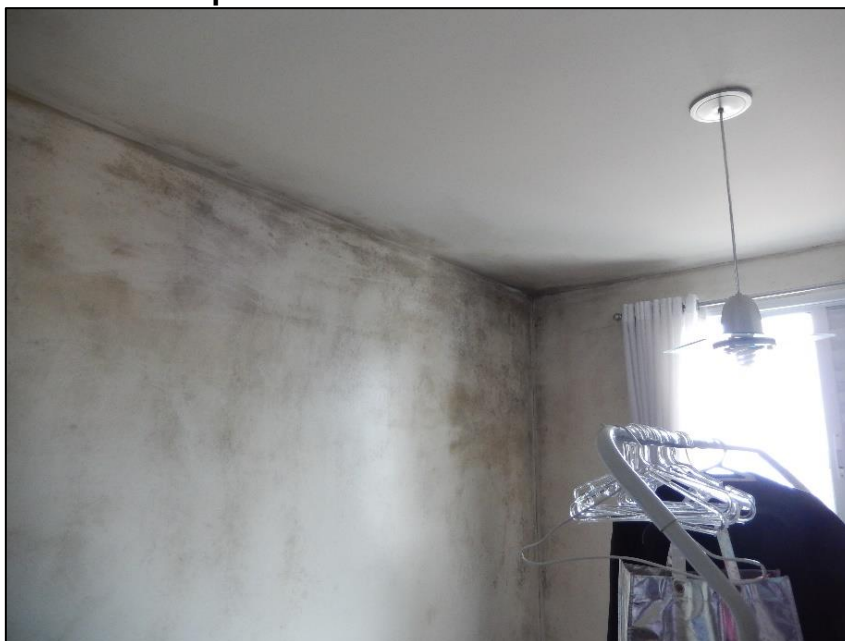
Figura 10: Manchas decorrentes de condensação que acometem praticamente todo o cômodo
