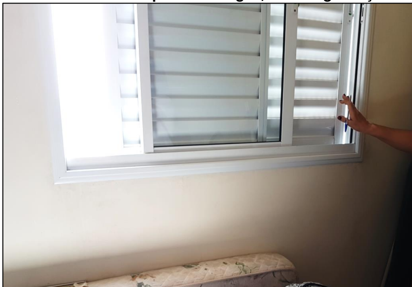
Figura 17: Manchas escurecidas ao redor da janela. Observa-se revestimento da parede íntegro, sem degradação
