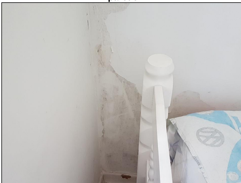
Figura 5: Manchas de infiltração com degradação do revestimento da parede
