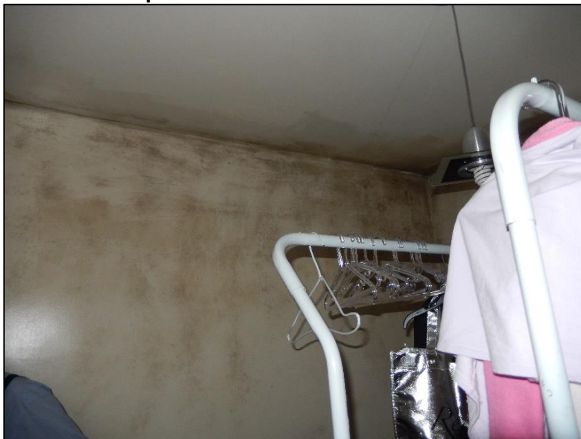
Figura 11: Manchas decorrentes de condensação que acometem praticamente todo o cômodo
