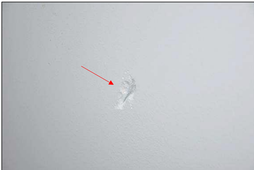
Figura 31: Escarificações no revestimento de gesso da parede com manchas: revestimento seco.
