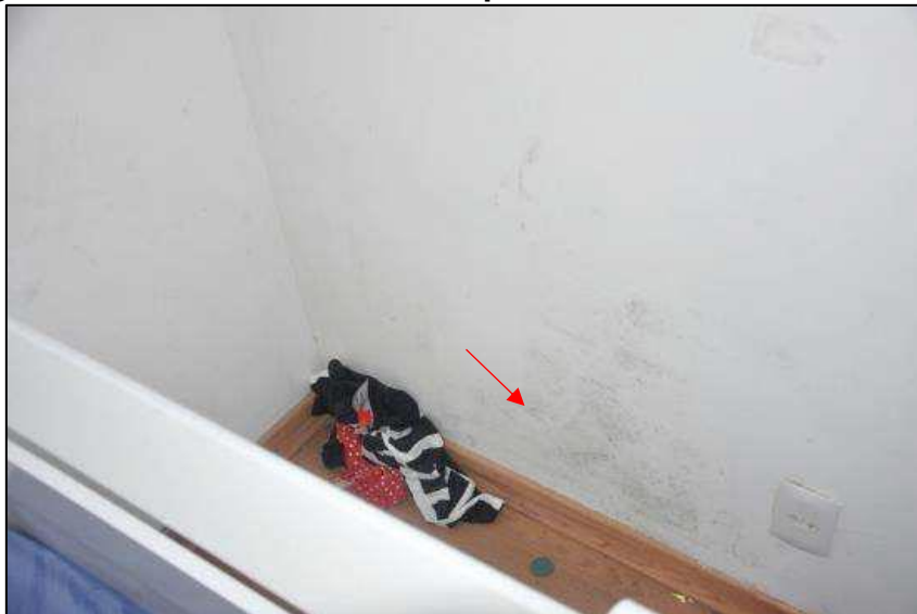
Figura 29: Manchas escuras na parede do cômodo vistoriado.
