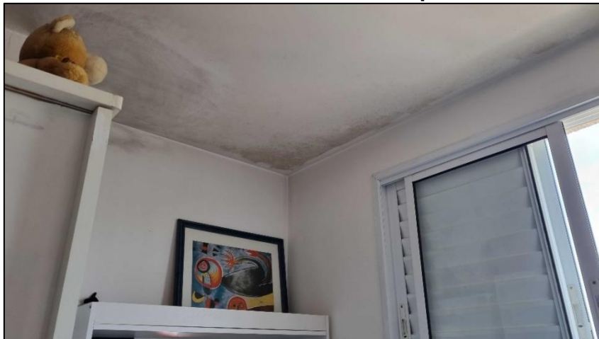
Figura 23: Manchas escurecidas no teto e parede do dormitório
