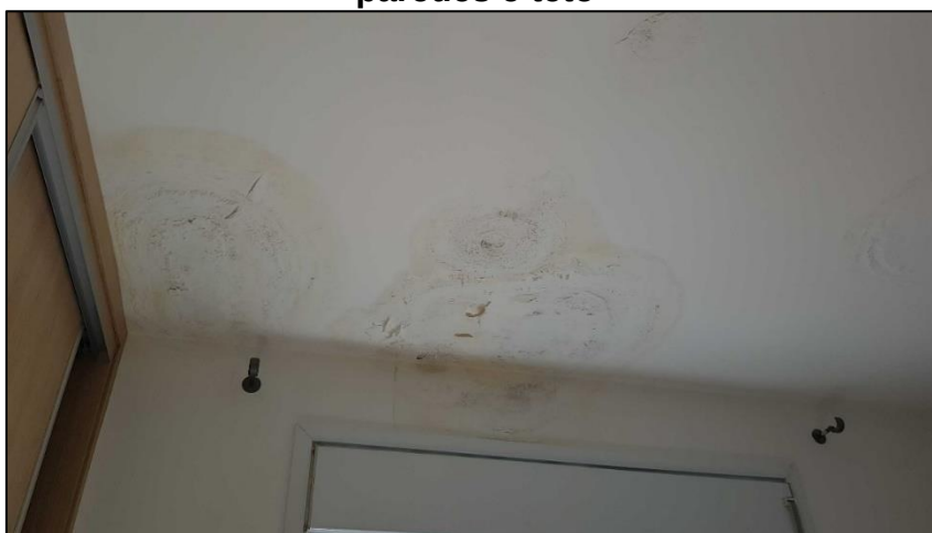
Figura 1: Manchas de infiltração com degradação do revestimento de paredes e teto
