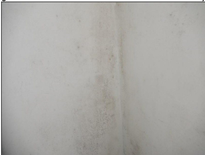
Figura 8: Detalhe de manchas decorrentes de condensação
