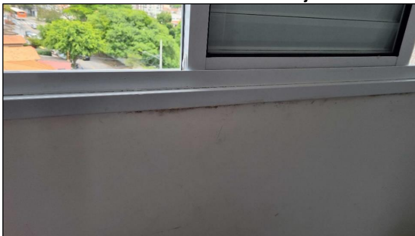
Figura 25: Manchas escurecidas ao redor da janela do dormitório
