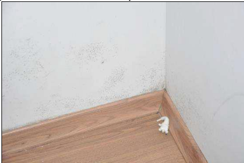
Figura 30: Manchas escuras na parede do cômodo vistoriado.
