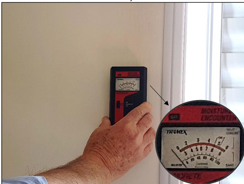
Figura 18: Índice nulo de umidade, indicando inexistir infiltrações
