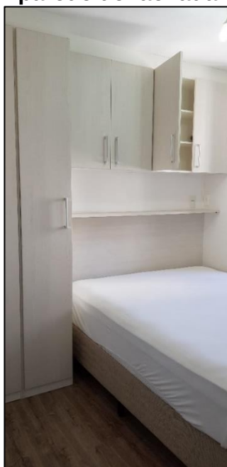
Figura 20: Manchas escurecidas no interior dos armários instalados na parede de fachada
