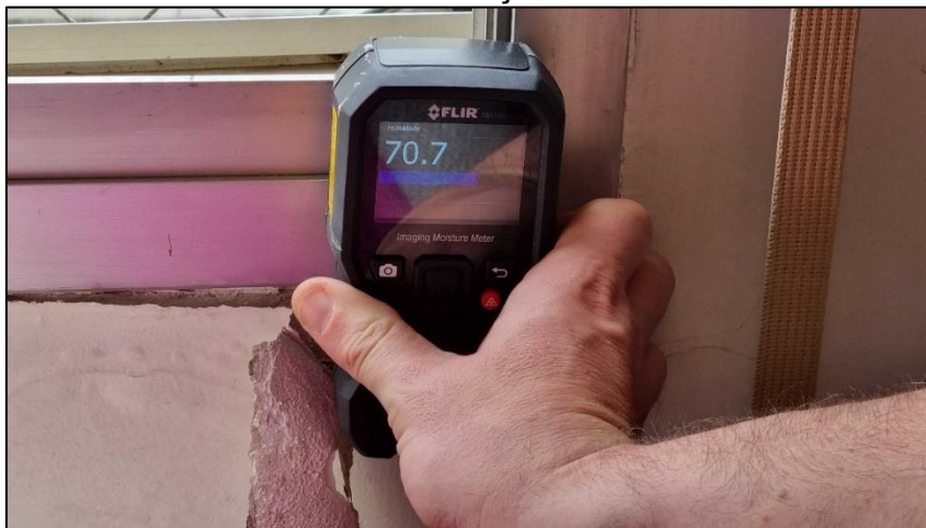
Figura 4: Índice de umidade de 70,7%, indicando patologia decorrente de infiltração
