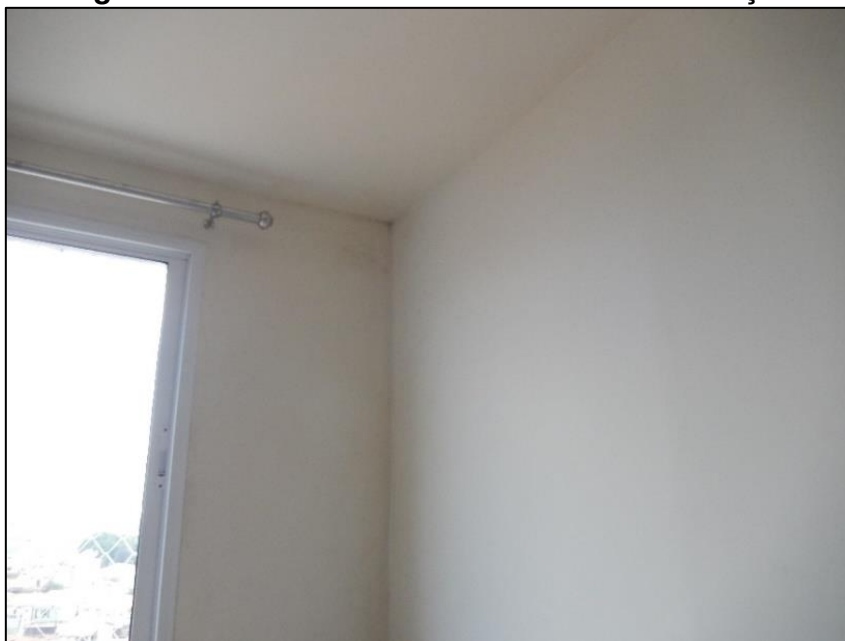
Figura 7: Manchas decorrentes de condensação
