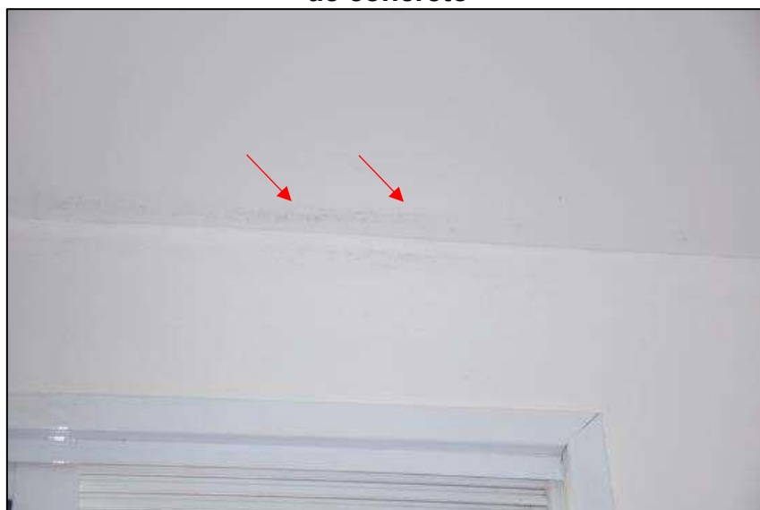
Figura 28: Manchas escuras no canto central superior da alvenaria e laje de concreto
