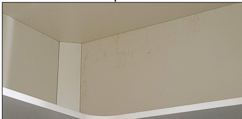
Figura 21: Detalhe das manchas escurecidas no interior dos armários instalados na parede de fachada
