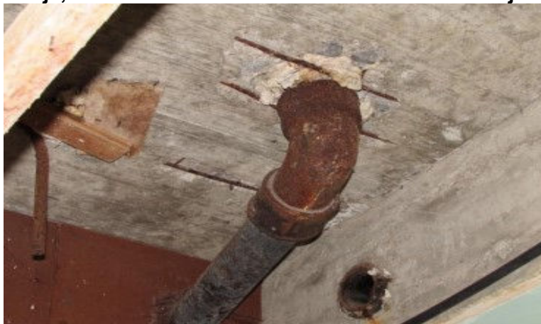
Figura 28 – Tubulação de esgoto ligada à armadura da laje, desencadeando corrosão da armadura da laje
