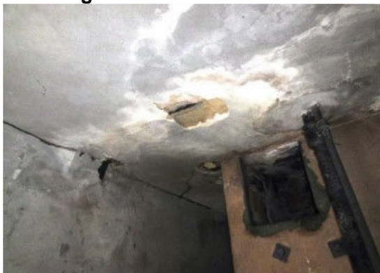
Figura 21 – Deficiência de impermeabilização da laje da casa de máquinas causando infiltrações, e por conseguinte corrosão da armadura
