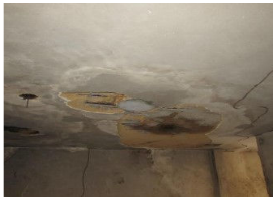
Figura 22 – Infiltração, corrosão da armadura e deslocamento do concreto, na casa de máquinas
