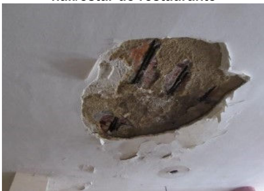
Figura 17 – Corrosão da armadura com deslocamento do concreto na laje hall/estar do restaurante
