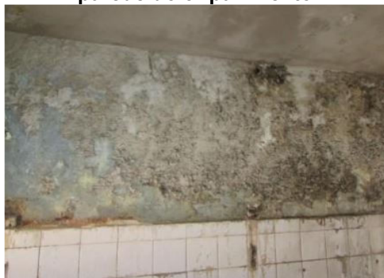
Figura 32 – Presença de infiltração em parede do 3º pavimento
