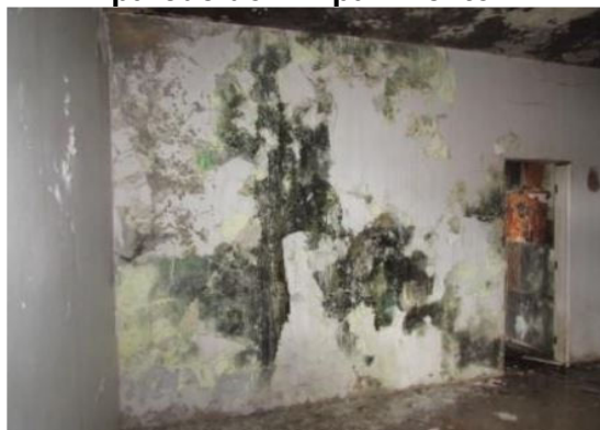
Figura 31 – Presença de infiltração em parede do 12º pavimento
