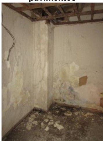
Figura 23 – Exemplo do shaft que originava vazamento em todos os pavimentos
