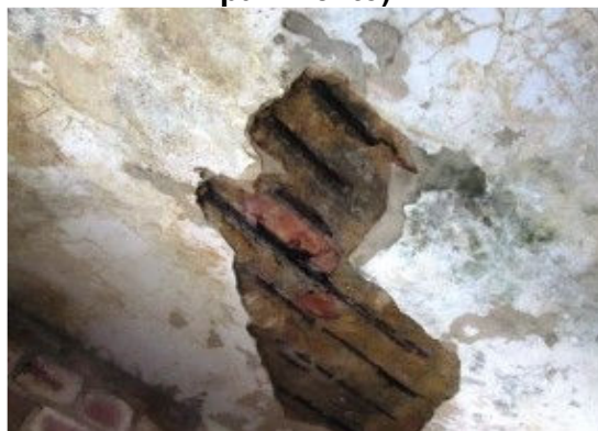
Figura 13 – Presença de infiltração, corrosão da armadura e deslocamento do concreto (12º pavimento)
