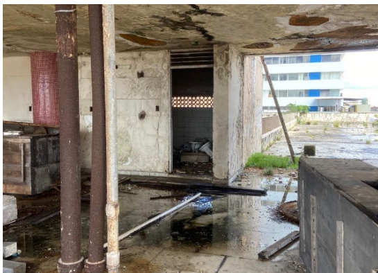
Figura 15 – Corrosão da armadura na laje do tipo caixão perdido situada no 3º pavimento, associada à infiltração
