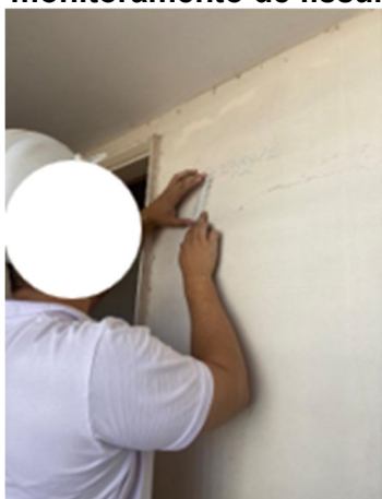
Figura 5 – Registro do 1º monitoramento de fissura
