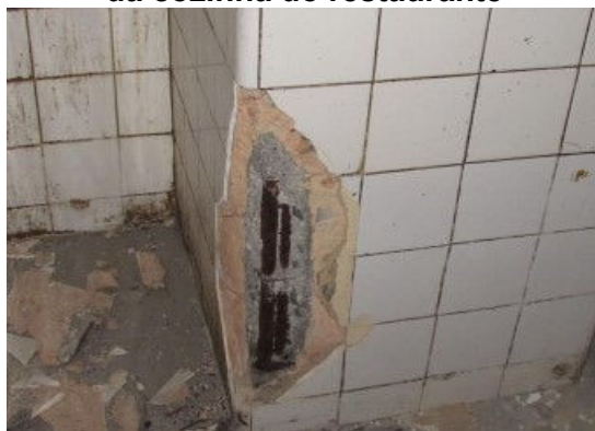
Figura 18 – Corrosão da armadura e deslocamento do concreto no pilar da cozinha do restaurante
