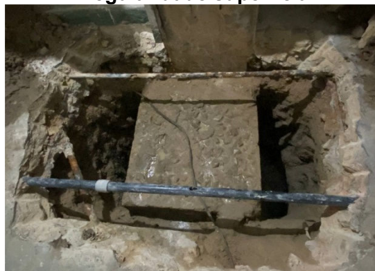
Figura 11 – Vista do bloco de fundação, com percepção de irregularidade superficial
