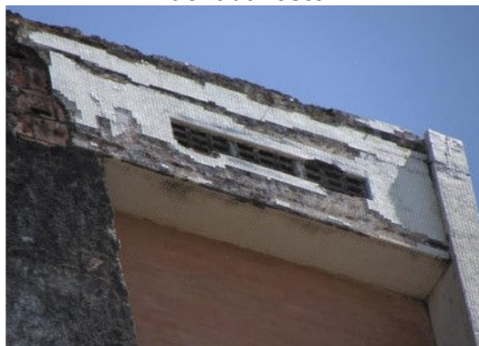
Figura 27 – Avarias verificadas na fachada leste
