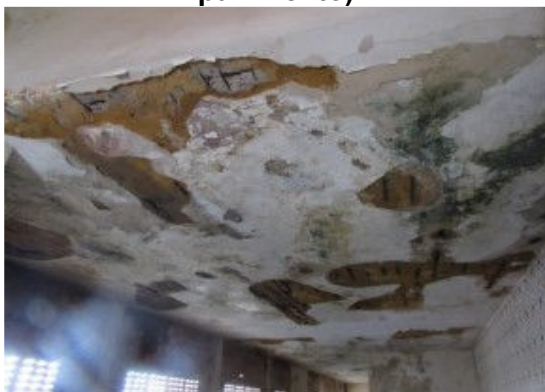
Figura 12 – Presença de infiltração, corrosão da armadura e deslocamento do concreto (12º pavimento)
