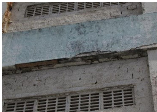
Figura 26 – Avarias verificadas na fachada leste
