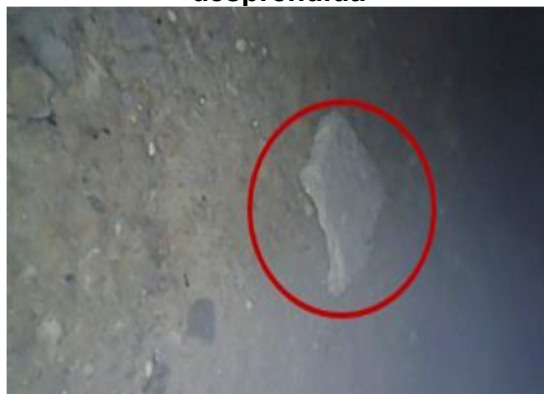
Figura 16 – Ensaio de boroscopia da laje superior do 3º pavimento, com destaque para fração de concreto desprendida
