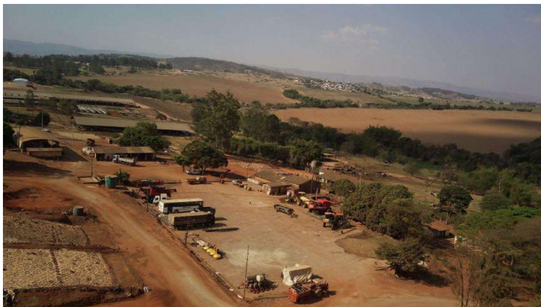
Figura 3: Outro detalhe do pátio das máquinas. Fonte: Dados de campo (2021).
