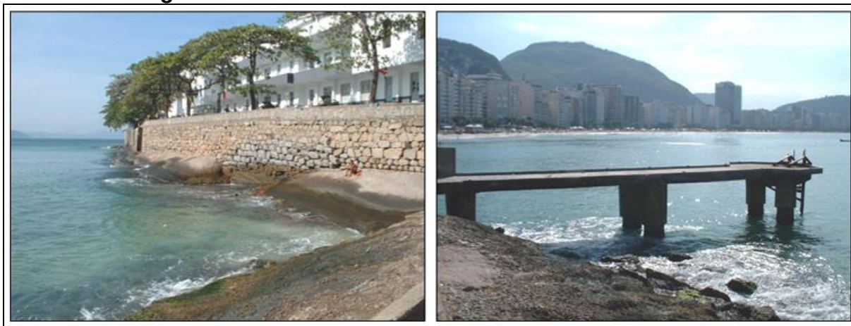
Figura 30 – Fotos do enrocamento tomadas na Perícia
