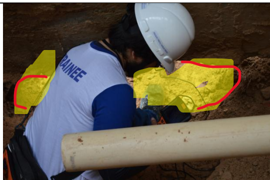
Foto: C4-019 Momento da abertura da interface entre os imóveis. Comprovação do ponto de fuga de todo volume entre o canteiro de obras de Alpha e a parte interna do subsolo 2 de Beta.
