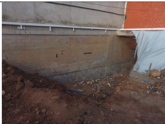
Foto: C4-001 Ponto de fuga de passagem das águas pluviais.
