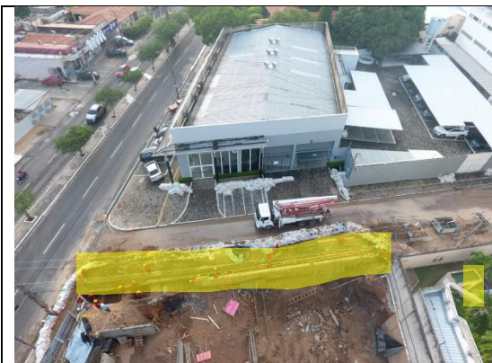
Foto: C4-005 Muro com cálculo estrutural refeito para evitar novos danos à obra Alpha e Condomínio Beta.
