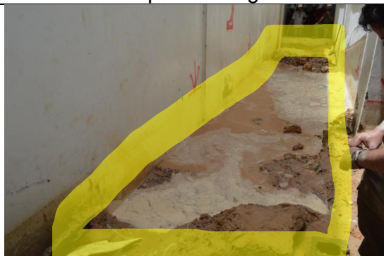
Foto: C4-025 Vaso comunicante comprovado pelo lado do condomínio Beta, em boa parte do colchão drenante interno que existe no nível do subsolo 2, que funcionou com abertura de erupção do volume, o que acarretou a invasão do canteiro de obras de Alpha.
