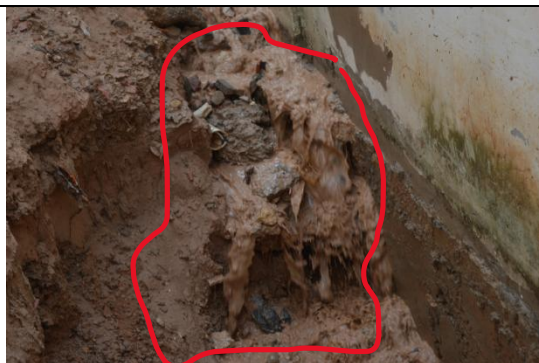
Foto: C4-024 No momento do teste fora encontrado presença de resíduos sólidos conforme comprova imagem acima.
