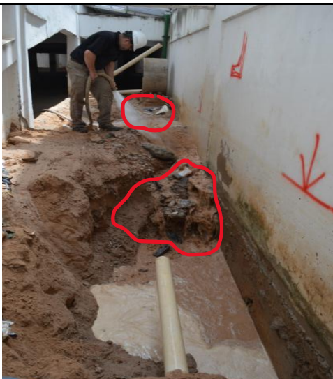
Foto: C4-023 No momento do teste fora encontrado presença de resíduos sólidos conforme comprova imagem acima.
