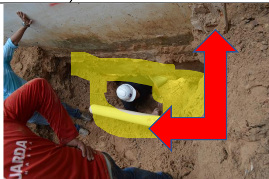
Foto: C4-020 Momento da abertura da interface entre os imóveis. Perito signatário refaz.
