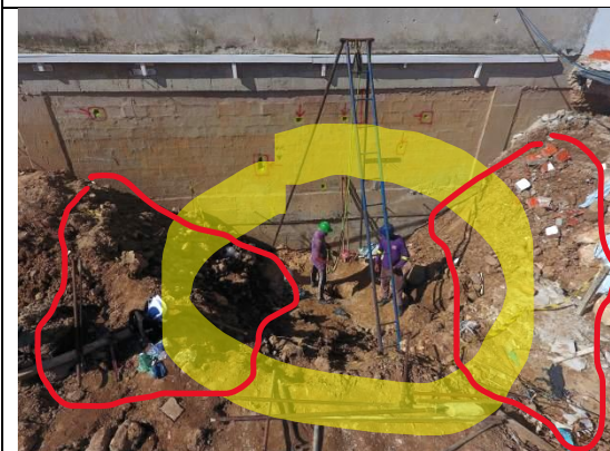
Foto: C4-007 Teste SPT- (amarelo), parte do processo da perícia técnica sobre o sinistro. Os contornos em vermelho demonstram a qualidade do aterro original de obra Beta, que saiu após os trabalhos periciais.
