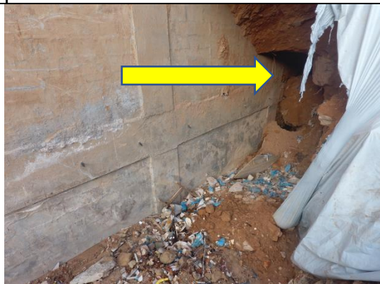
Foto: C4-003 Ponto de fuga de passagem das águas pluviais (rolha cilíndrica residual).
