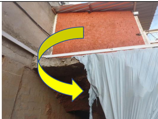
Foto: C4-004 Área com risco de desabamento devido a estrutura ter ficado em balanço.
