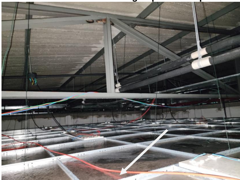
Foto 6: Vista entre forro e telhado. Detalhe para face de cima do forro com excesso de umidade devido acúmulo de água percolada pelas telhas
