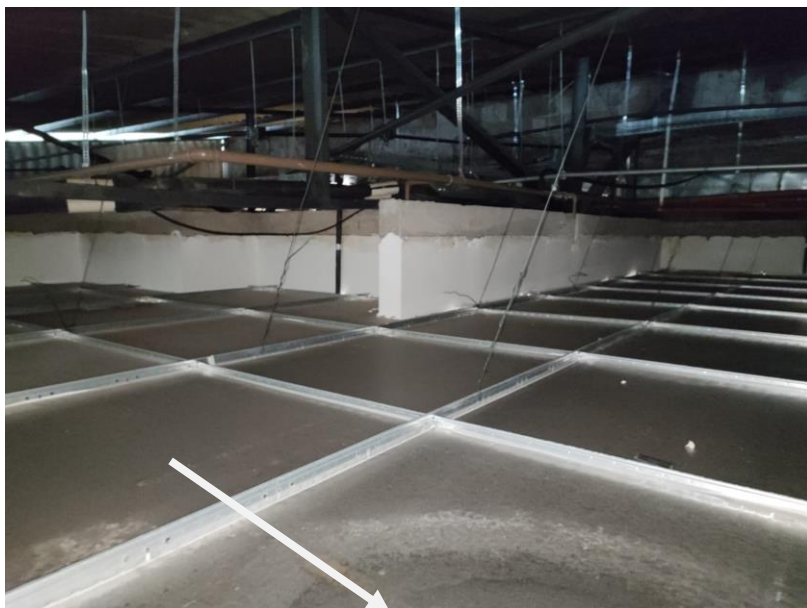
Foto 8: Vista de lâmina d'água formada em cima do forro após chuvas
