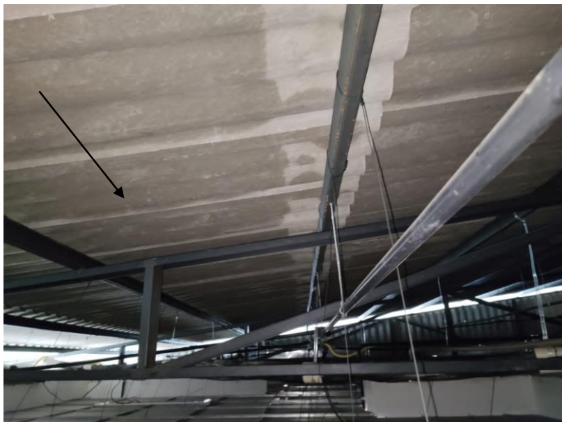
Foto 5: Vista da mudança de coloração devido à absorção e permeabilidade excessiva em toda área das telhas
