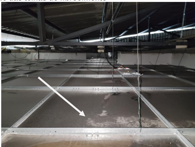
Foto 7: Vista do acúmulo de água em cima do forro ocasionado pela permeabilidade das telhas de fibrocimento
