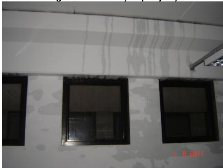
Figura 3 – Infiltração por junção
