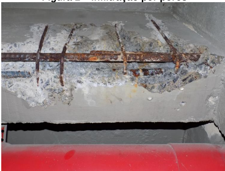
Figura 1 – Infiltração por poros
