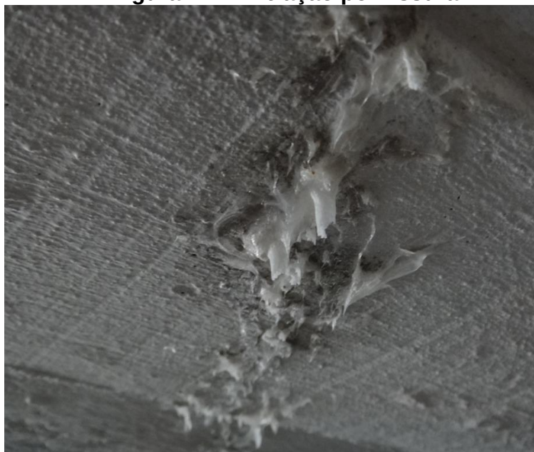
Figura 2 – Infiltração por fissura
