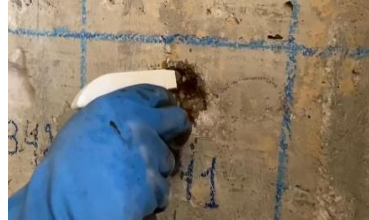
Profundidade de penetração de íons cloretos
