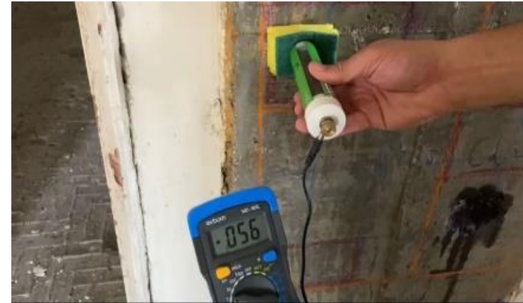
Potencial de corrosão
