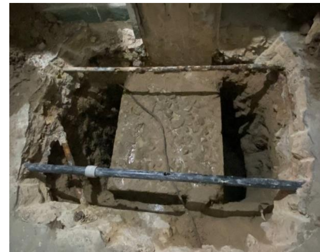
Vista do bloco de fundação, com percepção de irregularidade superficial
