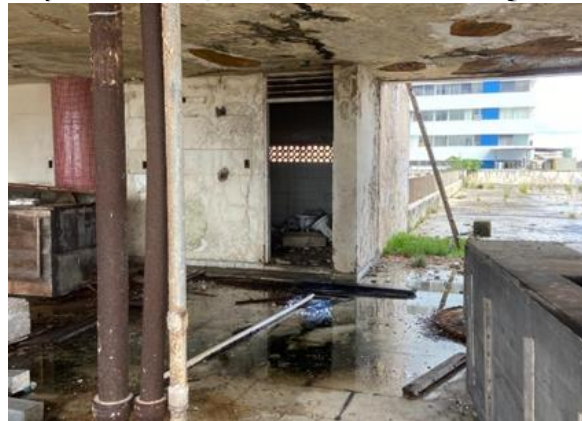
Corrosão da armadura na laje do tipo caixão perdido situada no 3º pavimento, associada à infiltração
