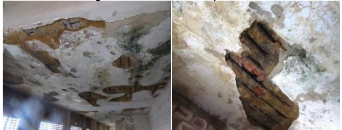
Registros de corrosão no 12º pavimento
