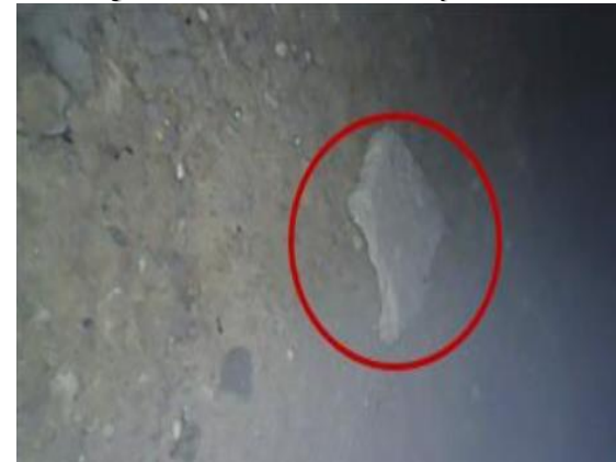
Inspeção por boroscopia da laje superior do 3º pavimento, com destaque para fração de concreto desprendida
