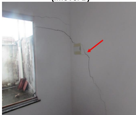
Figura 24 – Fissuras inclinadas (Imóvel B)
