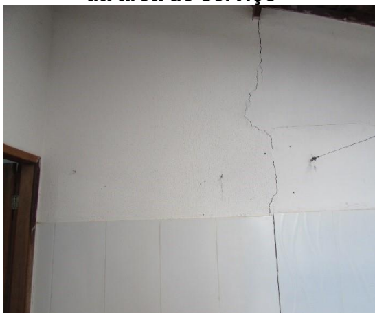
Figura 11 – Trincas na parede da área de serviço
