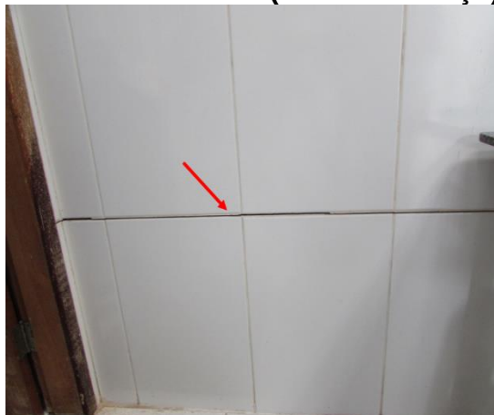
Figura 14 – Trincas na junta de assentamento (área de serviço)
