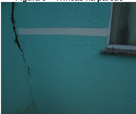
Figura 9 – Trincas na parede
