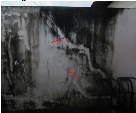
Figura 17 - Trincas no muro
