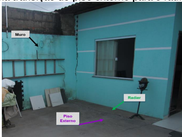
Figura 34 – Ausência de descontinuidade no muro na transição do piso externo para o radier
