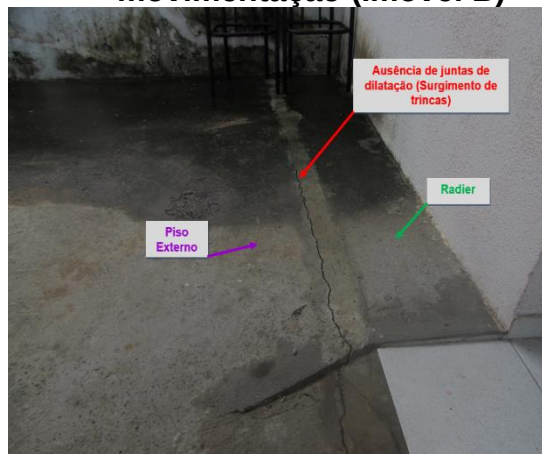
Figura 33 – Ausência de juntas de movimentação (Imóvel B)
