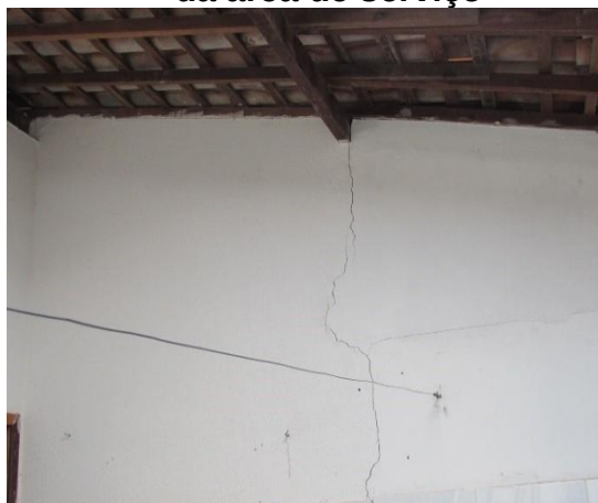
Figura 12 – Trincas na parede da área de serviço
