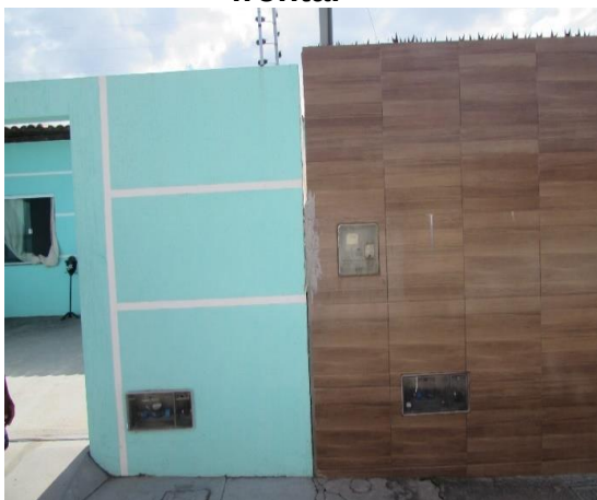
Figura 3 – Desaprumo do muro frontal
