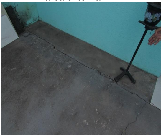
Figura 7 - Trincas no piso da área externa
