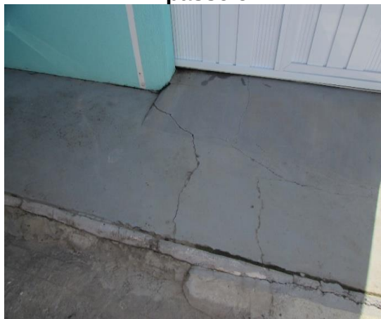
Figura 2 – Trincas no piso do passeio
