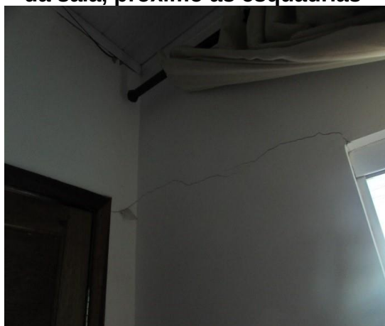
Figura 10 – Trinca na parede da sala, próximo às esquadrias
