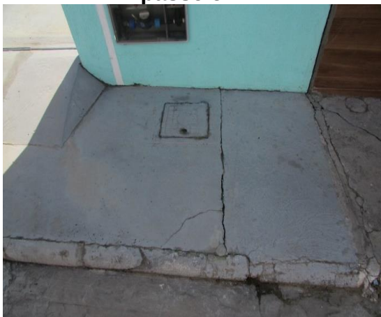
Figura 1 – Trincas no piso do passeio
