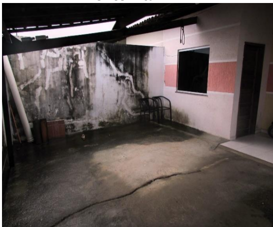
Figura 15 – Trincas nas paredes e no muro e rachadura no piso da área externa
