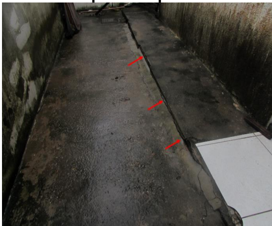
Figura 21 – Rachaduras e trincas no piso do quintal
