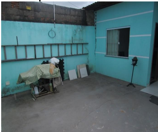
Figura 5 – Trincas no muro e no piso da área externa
