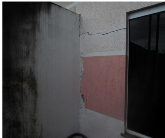
Figura 18 – Trincas na parede e no encontro com o muro
