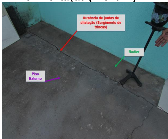
Figura 32 – Ausência de juntas de movimentação (Imóvel A)
