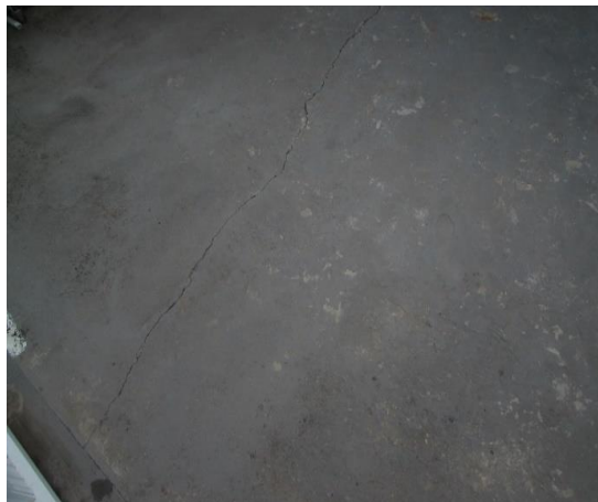
Figura 6 – Trinca no piso da área externa
