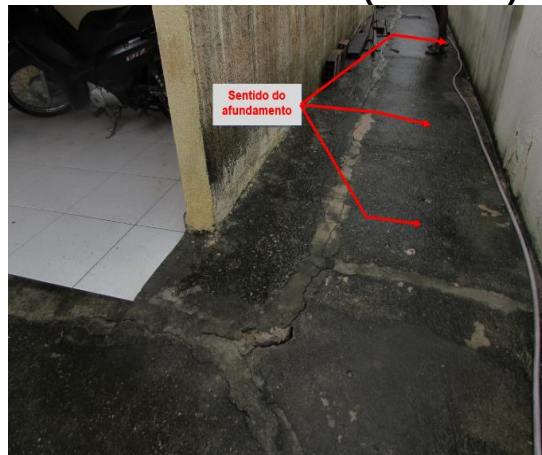
Figura 28 – Afundamento do piso do corredor lateral (Imóvel B)
