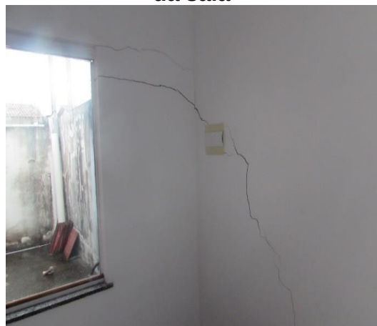
Figura 20 – Trincas na parede da sala
