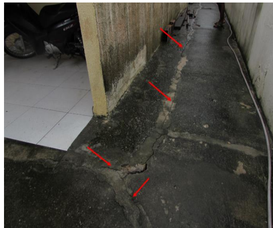
Figura 22 – Trincas no piso do corredor lateral
