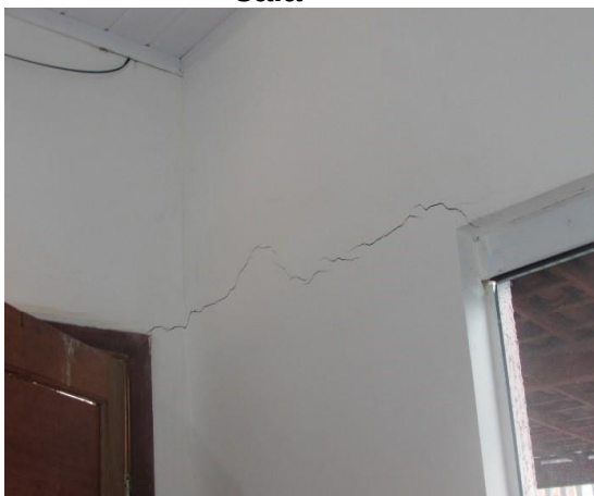
Figura 19 – Trinca na parede da sala
