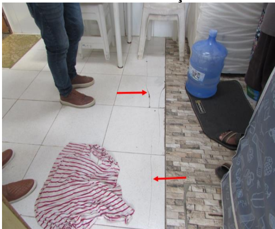
Figura 13 – Trincas no piso da área de serviço
