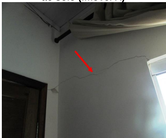
Figura 23 – Fissuras paralelas ao solo (Imóvel A)
