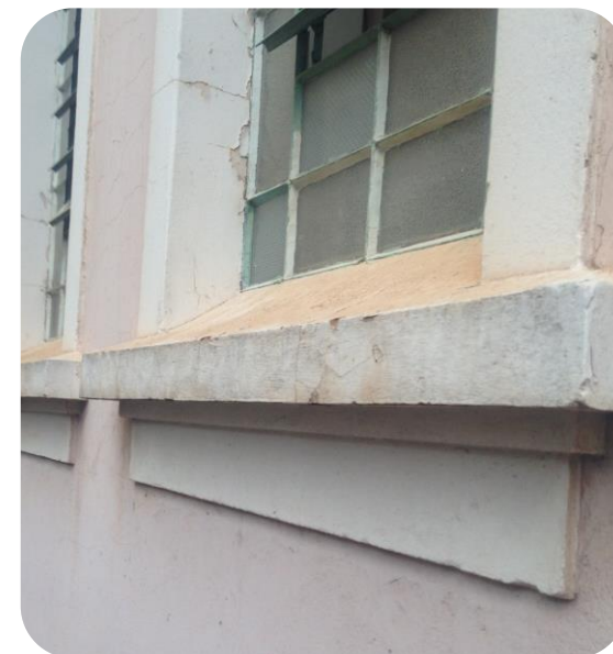
Inexistência (ausência) de pingadeira
