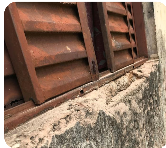
Oxidação (ferrugem vermelha) total e quebra parcial
