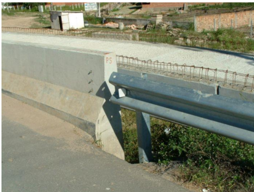
Imagem 12 – Detalhes do sistema adotado, ineficaz.
