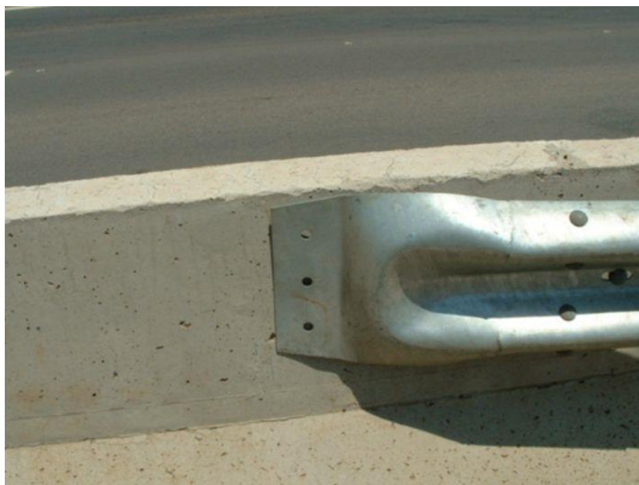
Imagem 11 – Ausência de fixação
