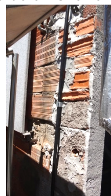
Figura 17: Deficiência de impermeabilização da alvenaria.
