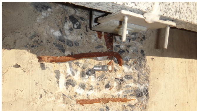
Figura 19: Ausência de tratamento da ferragem, antes da montagem da fachada ventilada.
