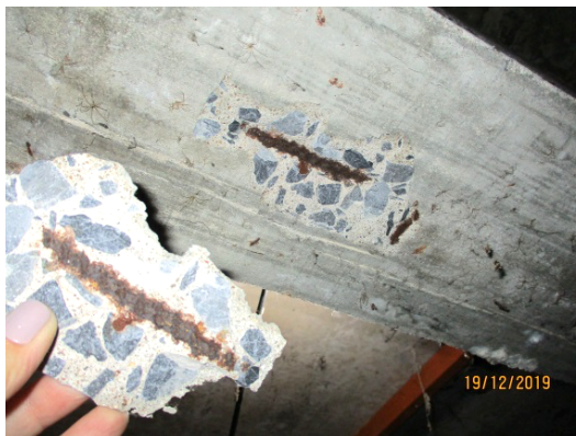
Figura 9: Deslocamento e corrosão de armadura.
