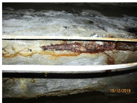
Figura 12: Carbonatação, corrosão de armadura e deslocamento.
