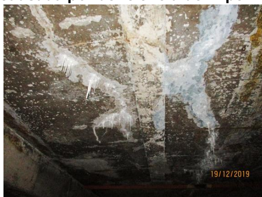
Figura 20: Infiltração causada por deficiência de impermeabilização do pilotis.
