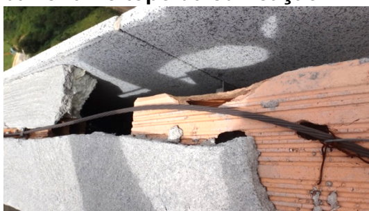
Figura 16: Deficiência de vedação da barreira no topo da edificação.
