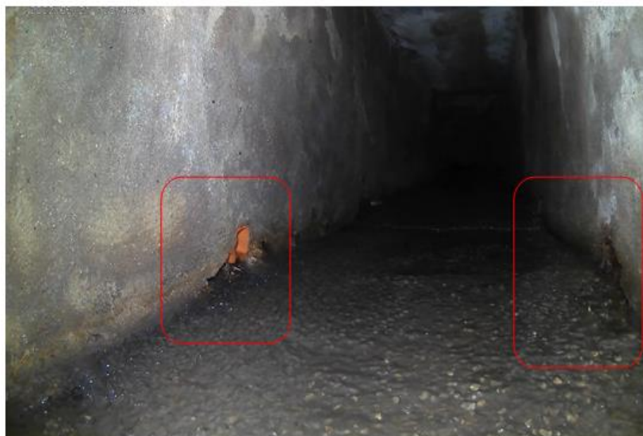
Figura 35 – Pontos danificados no revestimento das paredes e piso
