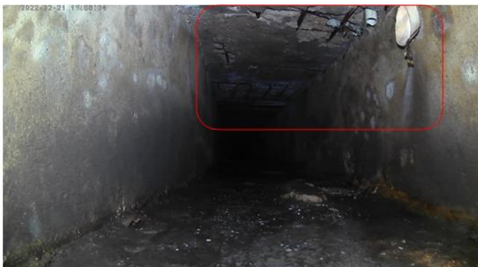
Figura 21 – Armaduras de aço expostas e oxidadas
