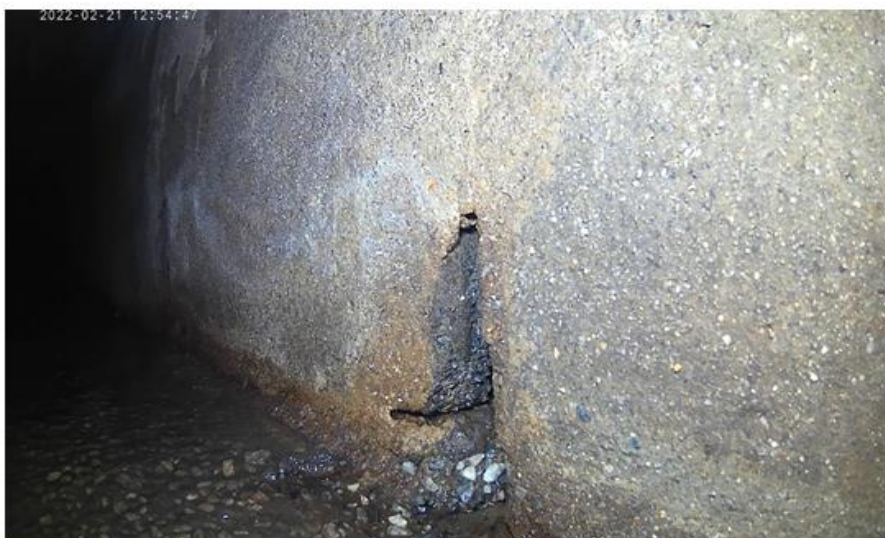
Figura 36 – Ponto danificados no revestimento da parede; infiltrações
