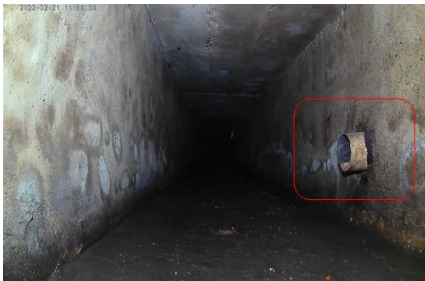
Figura 20 – Ligações clandestinas de esgoto doméstico
