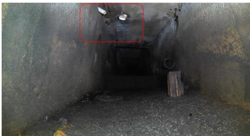
Figura 23 – Ligações irregulares e clandestinas de esgoto doméstico
