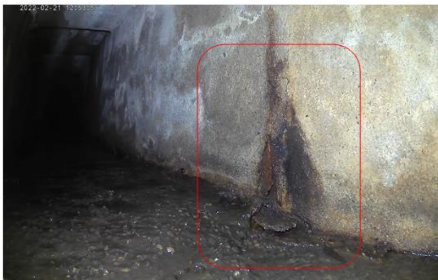
Figura 34 – Ponto com trincas e infiltrações externas
