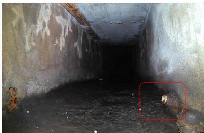
Figura 32 – Ligações clandestinas e irregulares de esgoto doméstico
