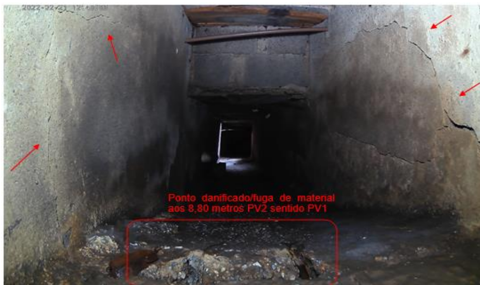
Figura 26 – Fissuras e trincas nas paredes da galeria
