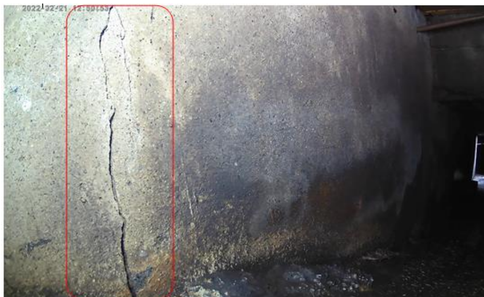
Figura 27 – Grande abertura na parede da galeria pluvial
