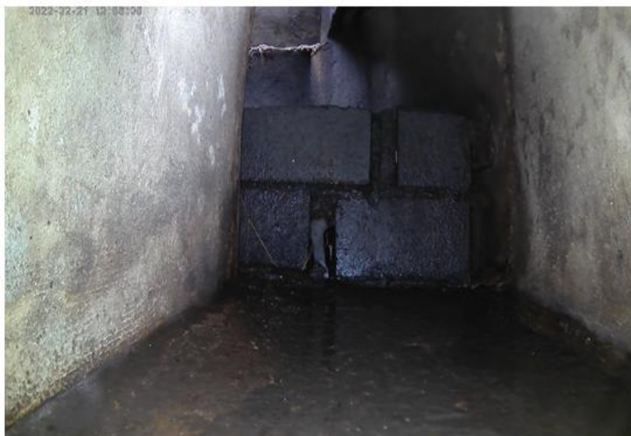
Figura 37 – Falhas no revestimento em degrau próximo ao PV Interno
