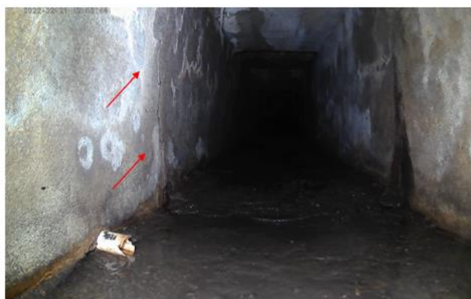
Figura 33 – Trincas na parede da galeria (ver setas) e esgoto irregular
