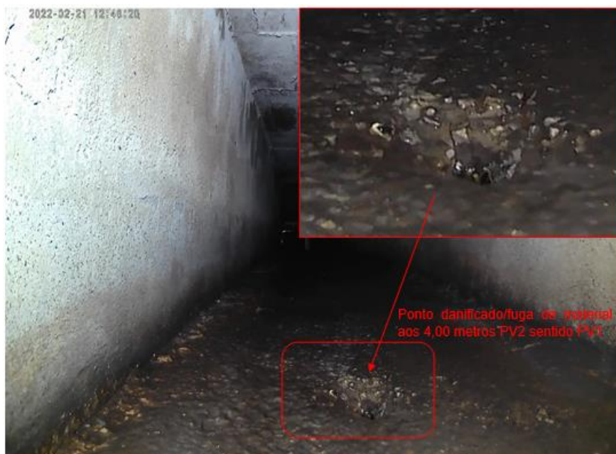
Figura 29 – Ponto danificado no piso da galeria; fuga de material
