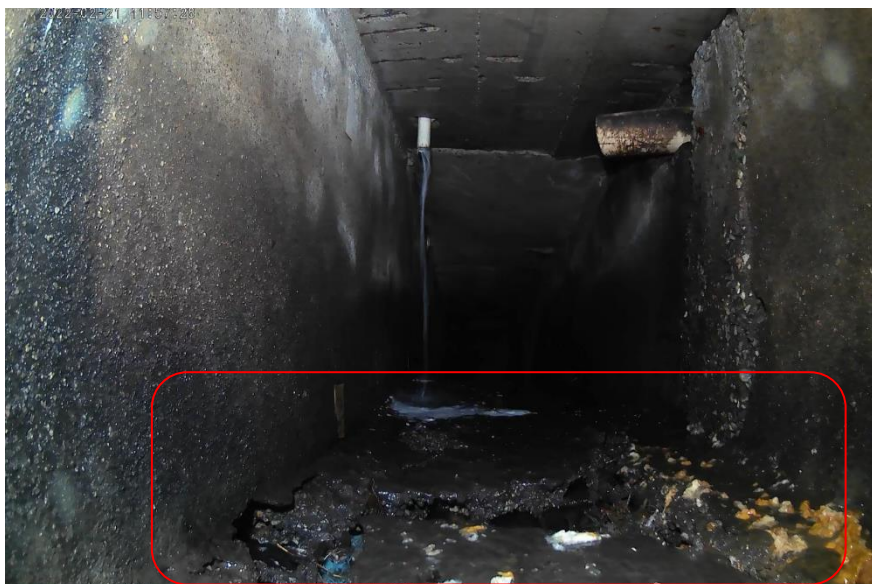
Figura 19 – Rompimento na parte inferior da galeria
