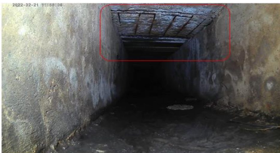
Figura 22 – Armaduras de aço expostas e oxidadas
