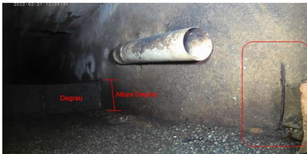
Figura 24 – Armaduras de aço expostas e oxidadas; esgoto irregular
