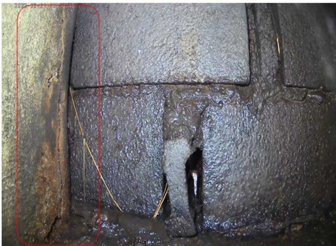
Figura 38 – Falhas no revestimento em degrau próximo ao PV Interno do Imóvel Industrial; trinas (ver detalhe)
