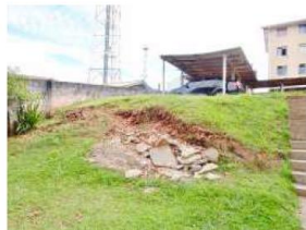
Foto 11 – Erosão no solo, com risco de desmoronamento. Fonte: autor.
