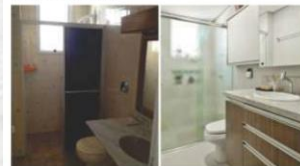
Fotos 1 e 2 – Mesmo banheiro, com estado de conservação distintos. Fonte: https://casaeconstrucao.org/projetos/reforma-de-apartamento/
