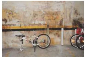
Foto 12 – Detalhe de infiltração em edifício residencial novo. Fonte: autor.
