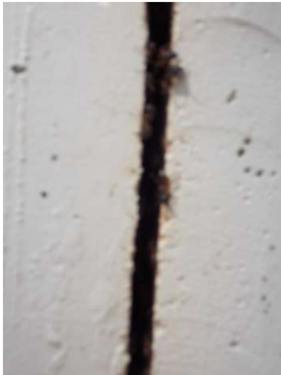
F08/FL – Viaduto Montese, detalhe da junta descrita nas fotografias anteriores, destacando a presença de formigueiro.
