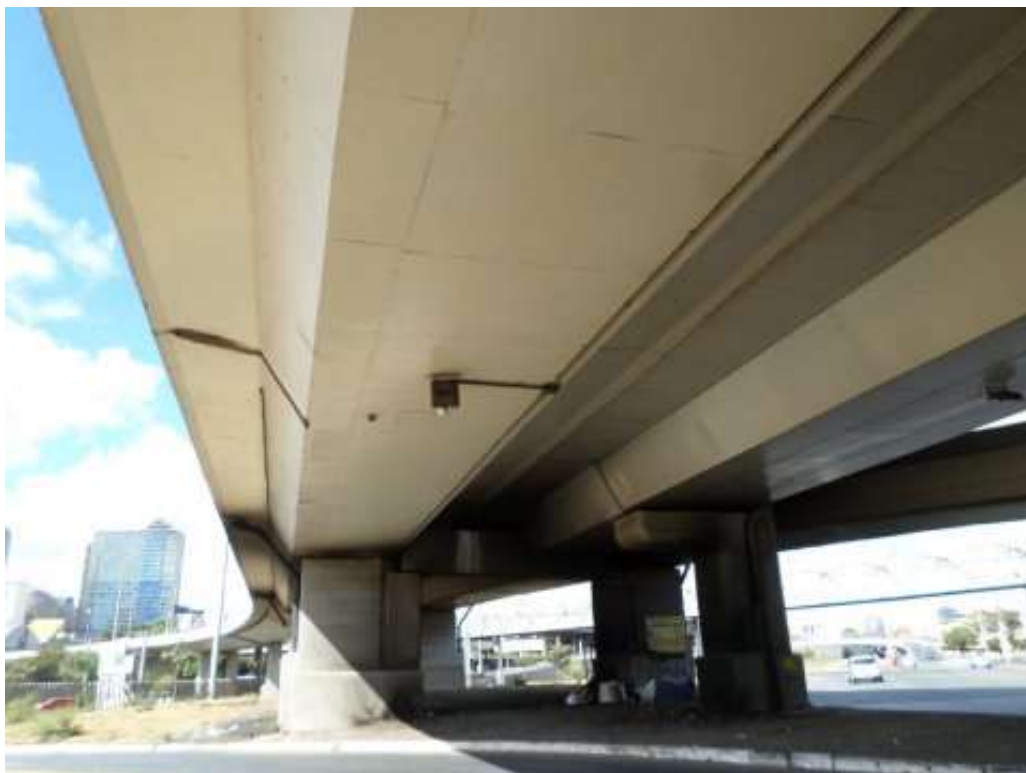
F57/FS – Vista da luminária em baixo do viaduto danificada e manchas de infiltrações e fuligem
