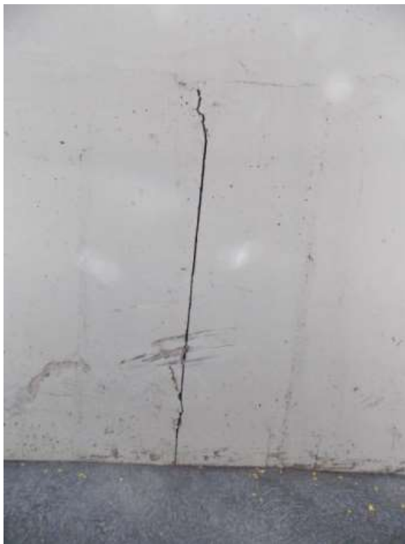
F59/FL – Viaduto Montese, detalhe da movimentação da estrutura provocando a junta.
