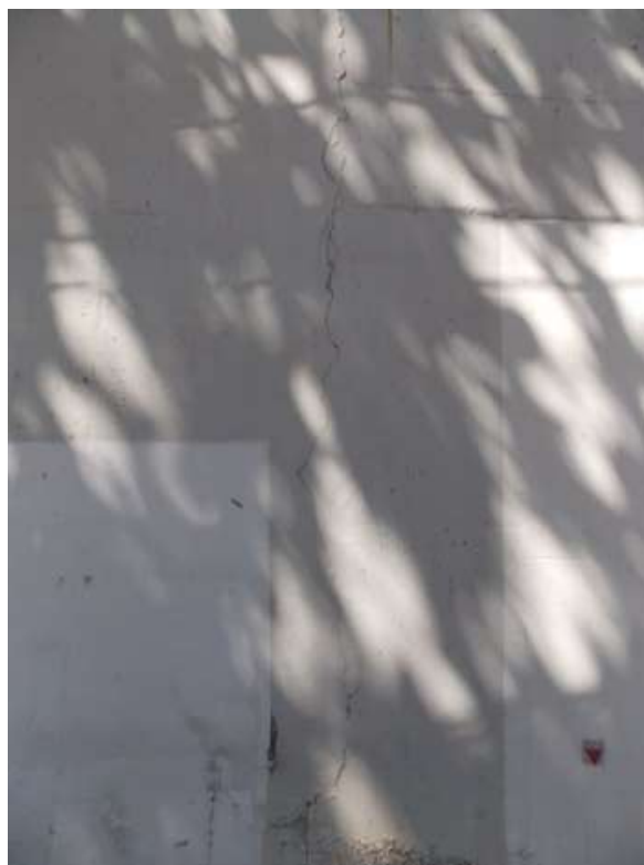
F14/FL – Viaduto Montese, detalhe das trincas verticais na estrutura de contenção.
