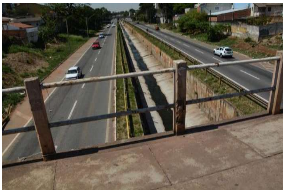
Figura 25 – Indicação de Anomalia:
