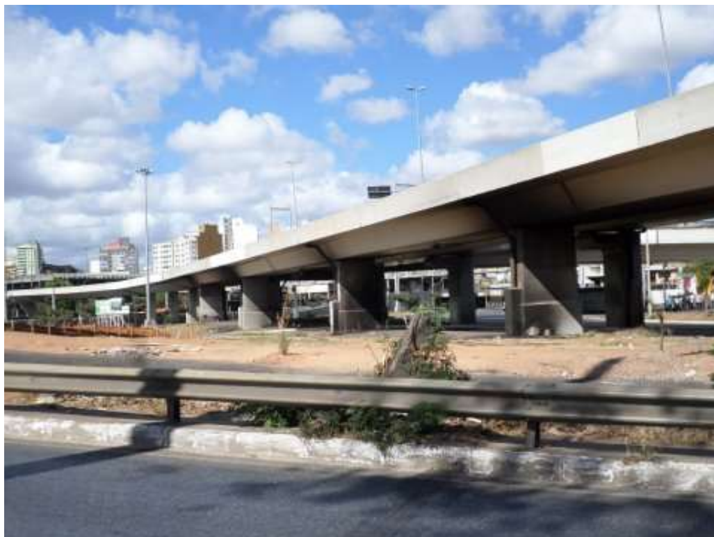
F55/FS – Outra vista geral pelo lado oposta mostrando vários pontos com manchas de fuligem em vários pilares marcando também os tabuleiros.
