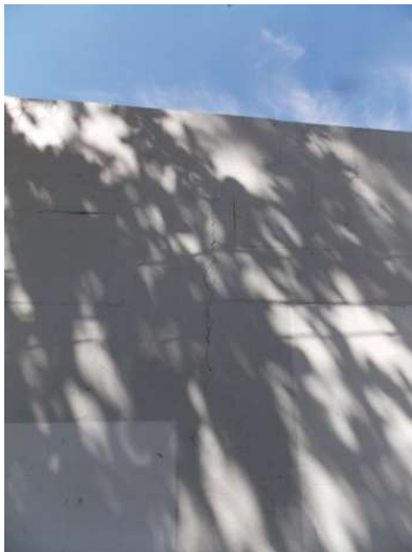
F13/FL – Viaduto Montese, trincas verticais na estrutura de contenção.
