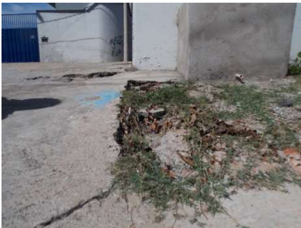
F30/FL –Viaduto Montese, base do pilar com indício de percolação de água e recalque de solo.
