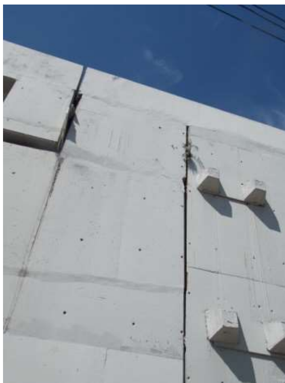
F26/FL – Viaduto Montese, junta com deficiências no prumo e presença de gramíneas.
