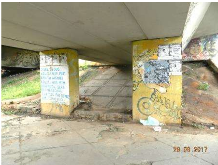
- Contenção da cabeceira 02, sentido Nazaré. Muita pichação.
