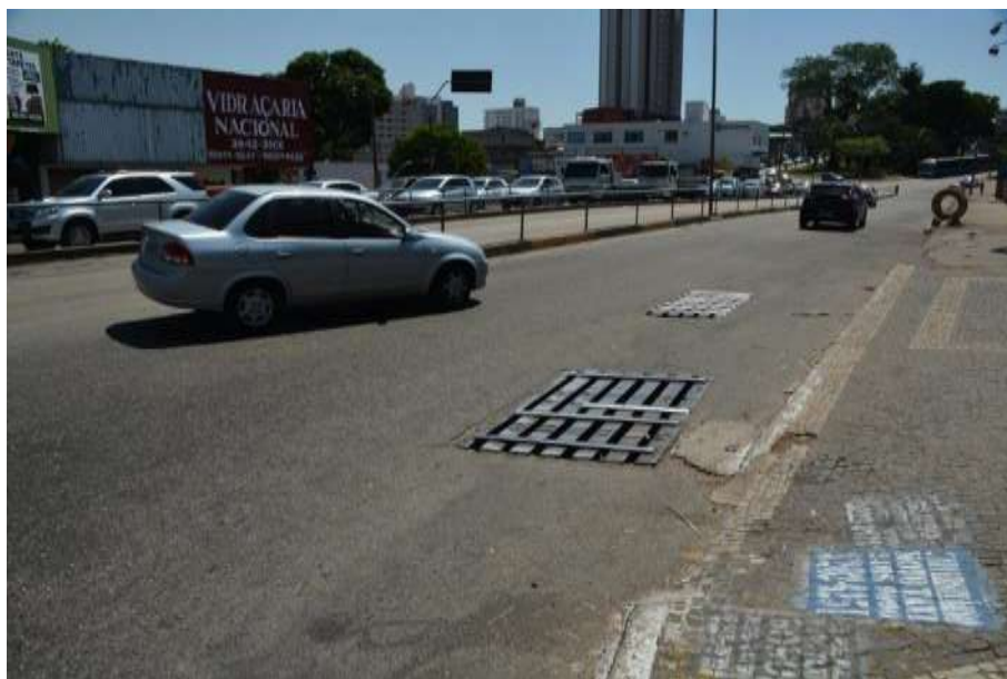
Figura 34 – Indicação de Anomalia: Captação de água pluvial existente na Avenida Anhanguera, antes do tabuleiro da ponte, no sentido Setor Central para o Setor Vila Nova (à esquerda) e Universitário (à direita).
