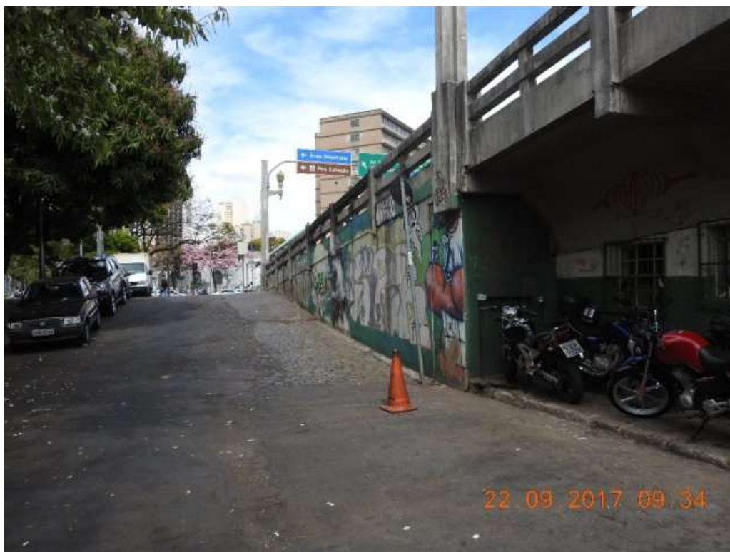
F59/FL – Detalhe da cabeceira do viaduto, pichações e infiltrações.
