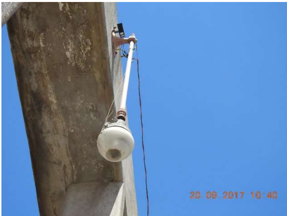
F53/ST – Improviso na parte elétrica, condutores de energia expostos.
