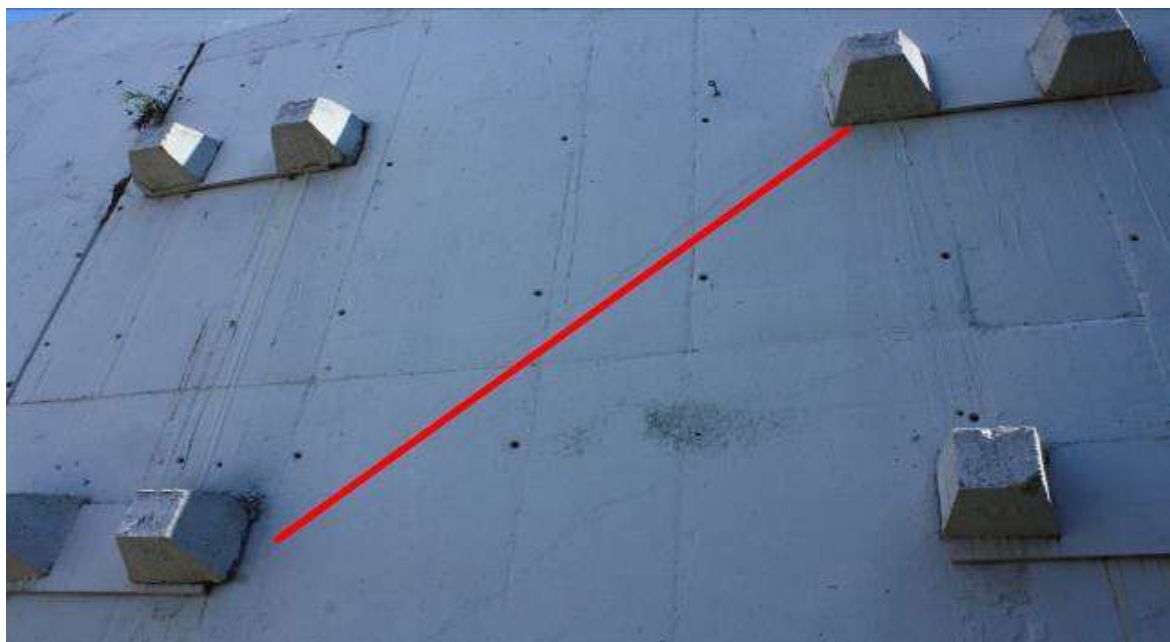
F50/FL –Viaduto Montese, detalhe relativo as não conformidades descritas acima.
