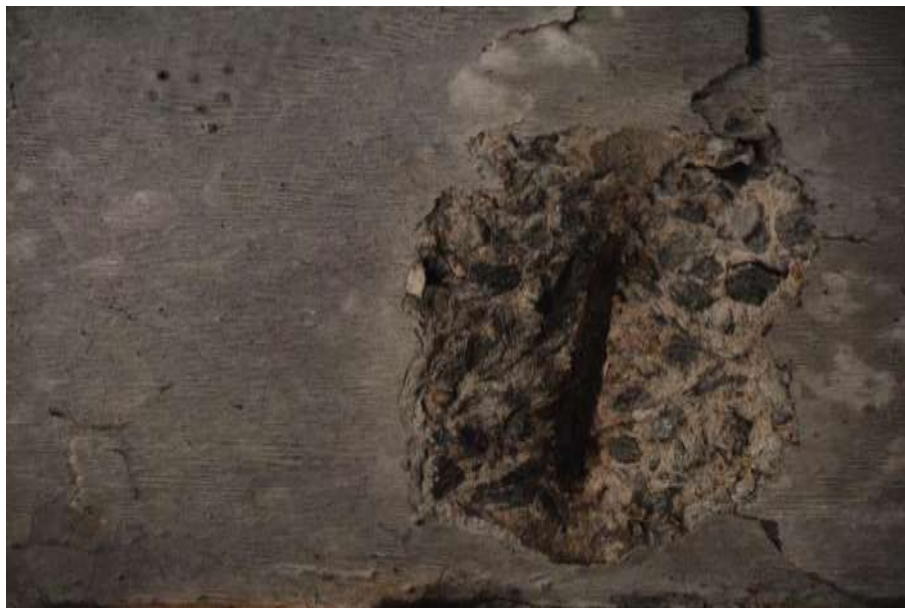
Figura 54 – Indicação de Anomalia:
