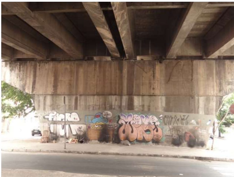
F09/FS – Vista de outro pilar e eflorescências em toda a extensão das vigas longitudinais ou longarinas (centro fiducial). Observa-se as marcas de ação de calor proveniente de fogueiras na base do pilar.
