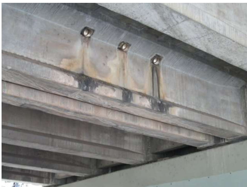
F16/FS – Outro detalhe da drenagem existente na laje inferior e eflorescências.
