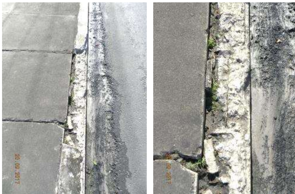
- Meio fio danificado e com vegetação.
