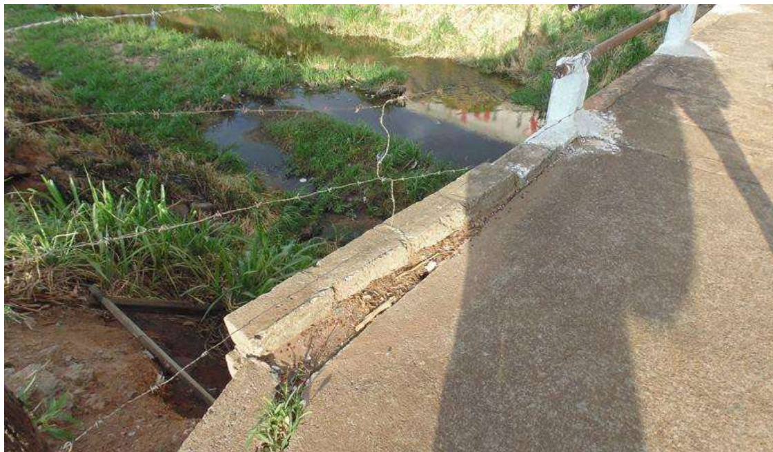
Foto 6 – Ausência de guarda-corpo em parte da ponte.
