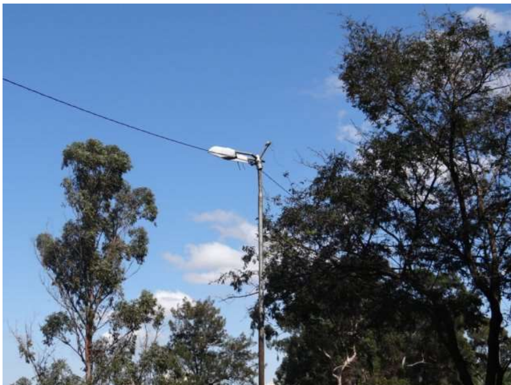
F13/HG – Detalhe do poste de iluminação do logradouro: Ausência de luminária e lâmpada.
