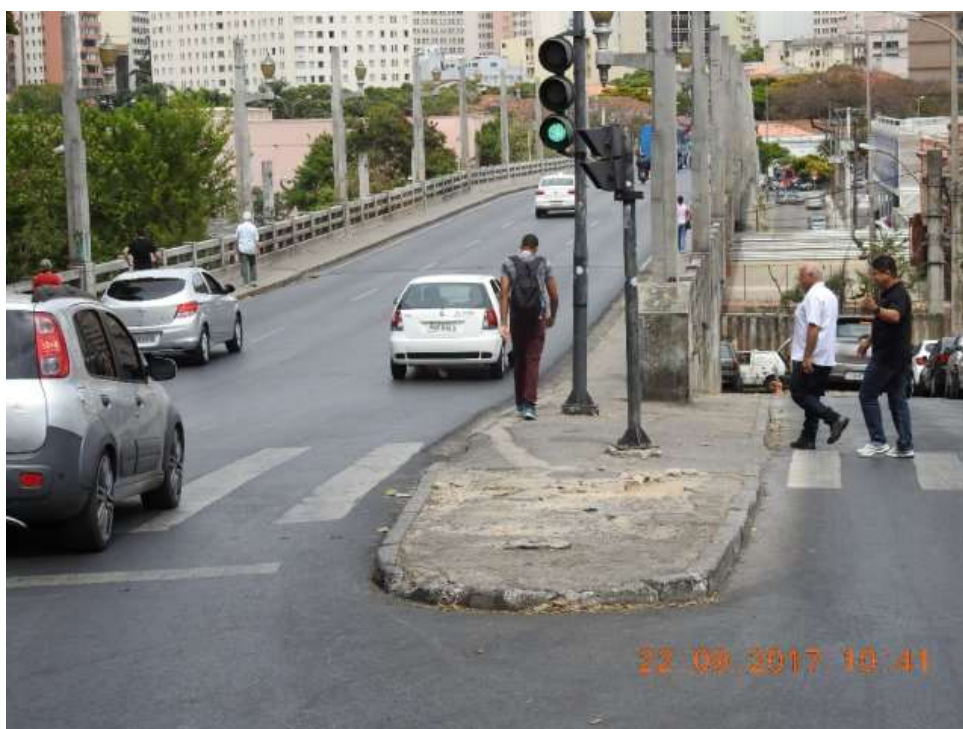
F02/FL – Danos generalizados e falta de padronização do passeio, falta do ladrilho hidráulico tátil de direcionamento e alerta. Ausência de sinalização (Avenida do Contorno continua na lateral com possibilidade de retorno).
