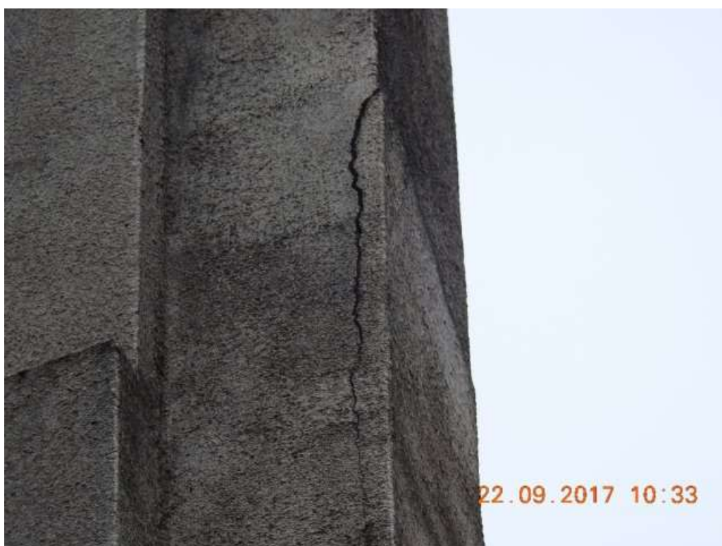
F10/FL – Trinca na base do pilar do poste da iluminação e do guarda corpo, neste ponto, abaixo, movimentação de carro e pedestre.
