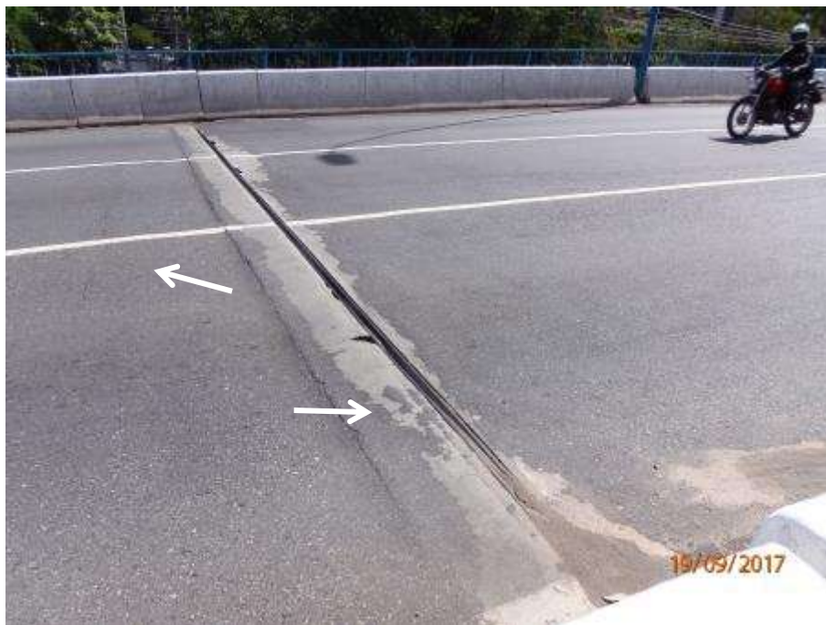
- Trincas no pavimento nas proximidades da junta de transição terrapleno x tabuleiro.
