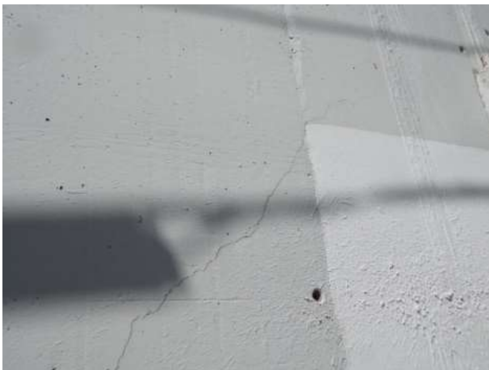
F23/FL –Viaduto Montese, detalhe de fissura na estrutura de contenção.
