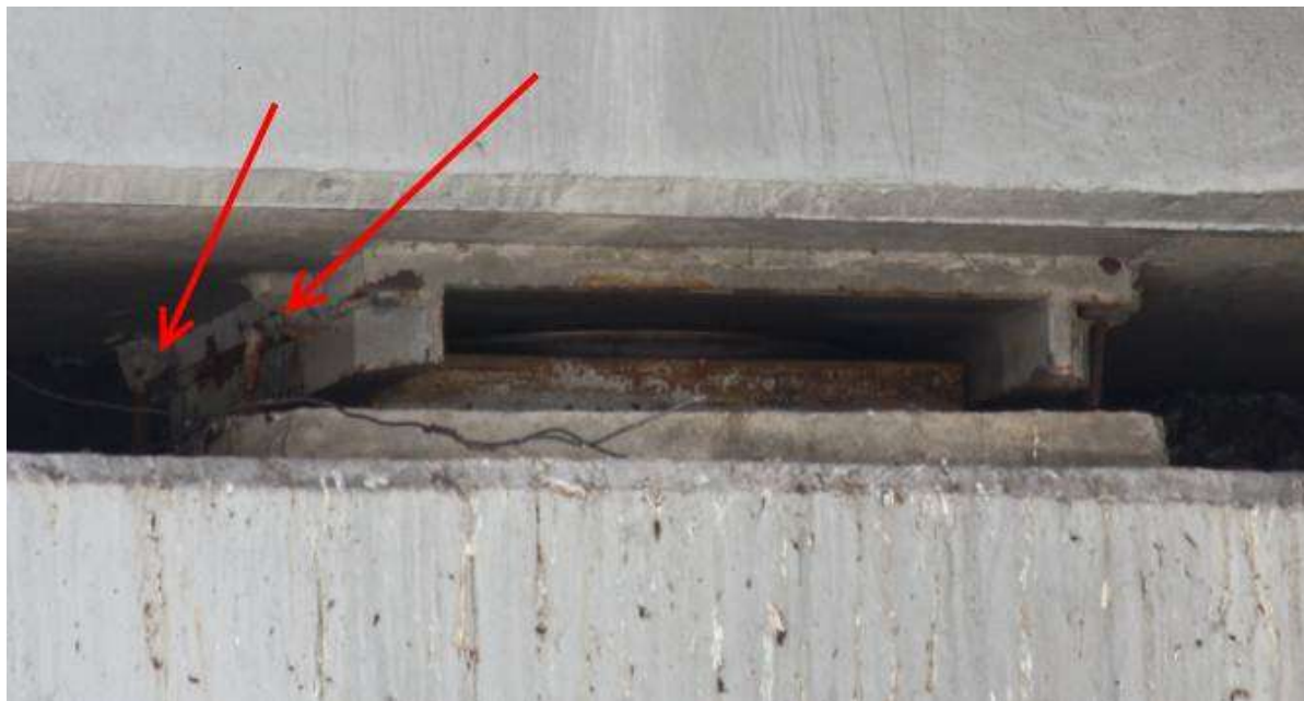
F33/FL – Detalhe de oxidação em elementos do aparelho de apoio, que podem estar relacionadas à ação de reações químicas liberadas na decomposição dos dejetos e evidências de deformações em parafusos.
