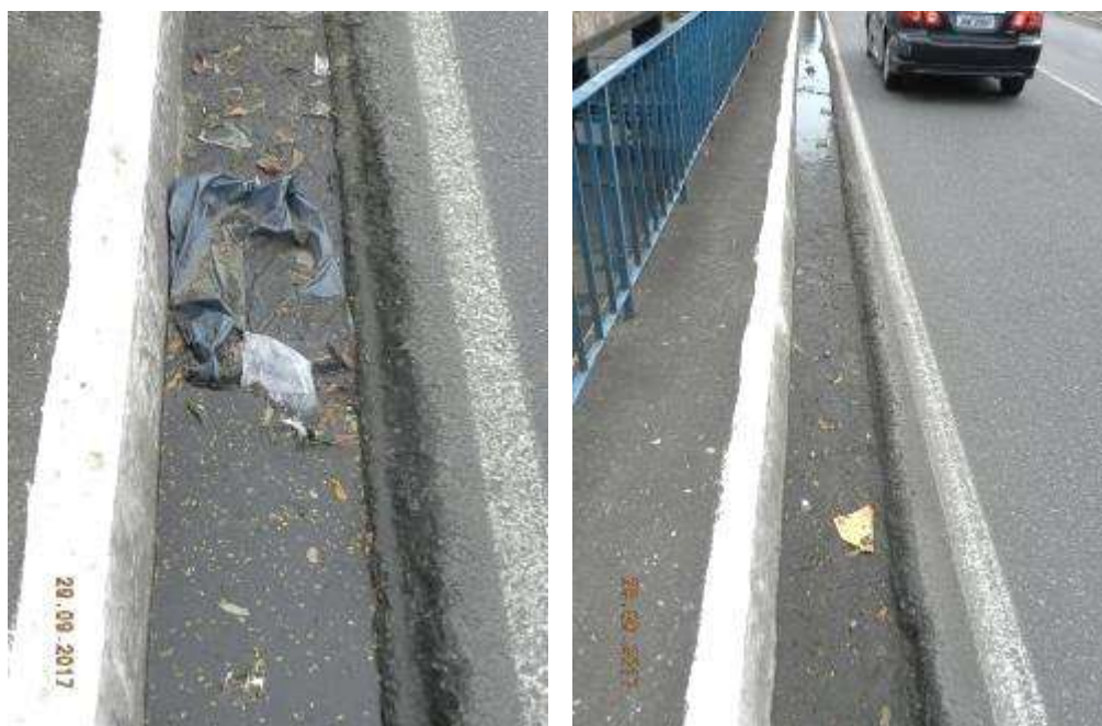
- Detalhe do acúmulo de lixo, obstruindo a passagem de água pluvial.
