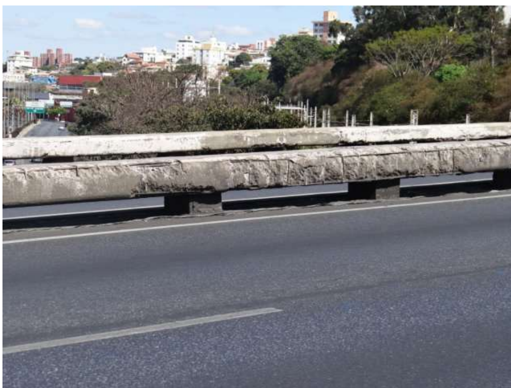
F22/HG – Detalhe da falta de recobrimento na parte central das pistas.
