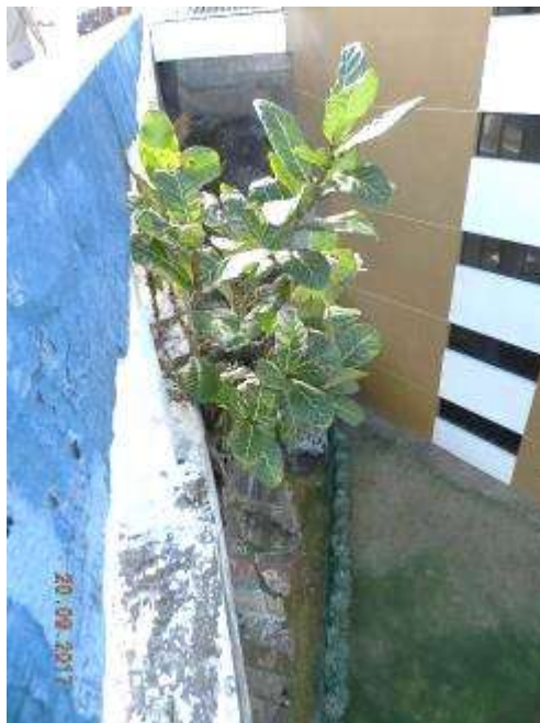
Crescimento de vegetação na junta de dilatação.
