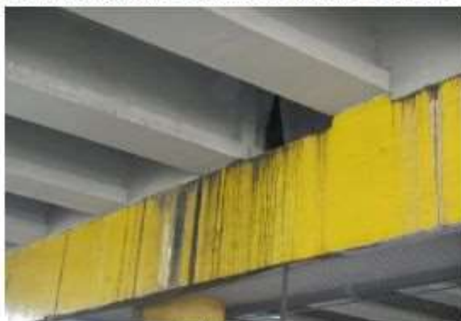
Infiltrações em todas as juntas de dilatações
