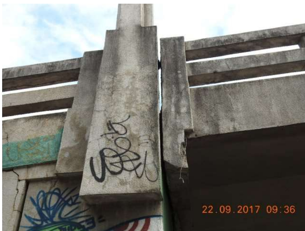
F62/FL – Detalhe foto anterior trincas e desprendimento do revestimento na base do pilar do guarda corpo. Pichações.
