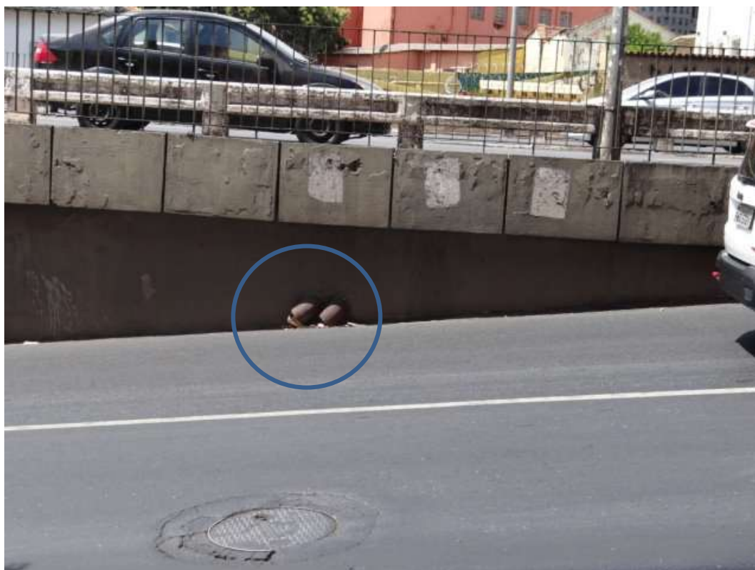
F22/FS – Detalhe de tubulação de drenagem sobre a via.
