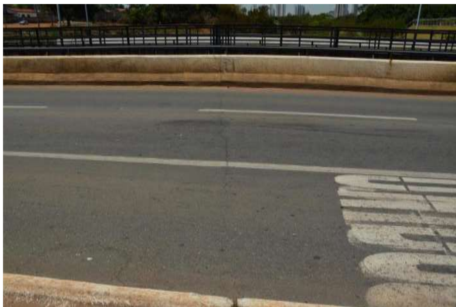
FOTO 14 – Vista da junta de trabalho na superestrutura (tabuleiro), as marcas de trabalho no pavimento asfáltico permitindo a passagem de água e ocasionando o excesso de umidade na parte inferior da superestrutura na Ponte T-63 sobre o córrego Cascavel visualizado da Avenida T-63 sentido Bairro / Centro.
