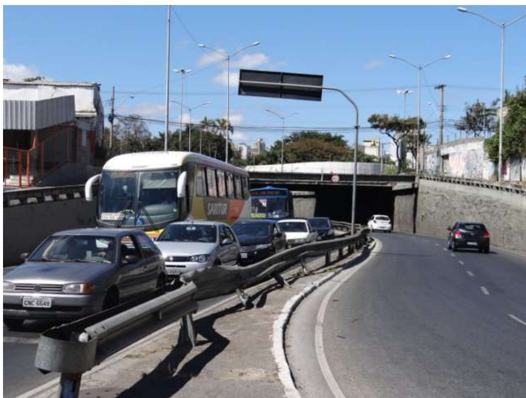
F04/HG – Detalhe de deformidade em proteção causada por impacto de veículo.
