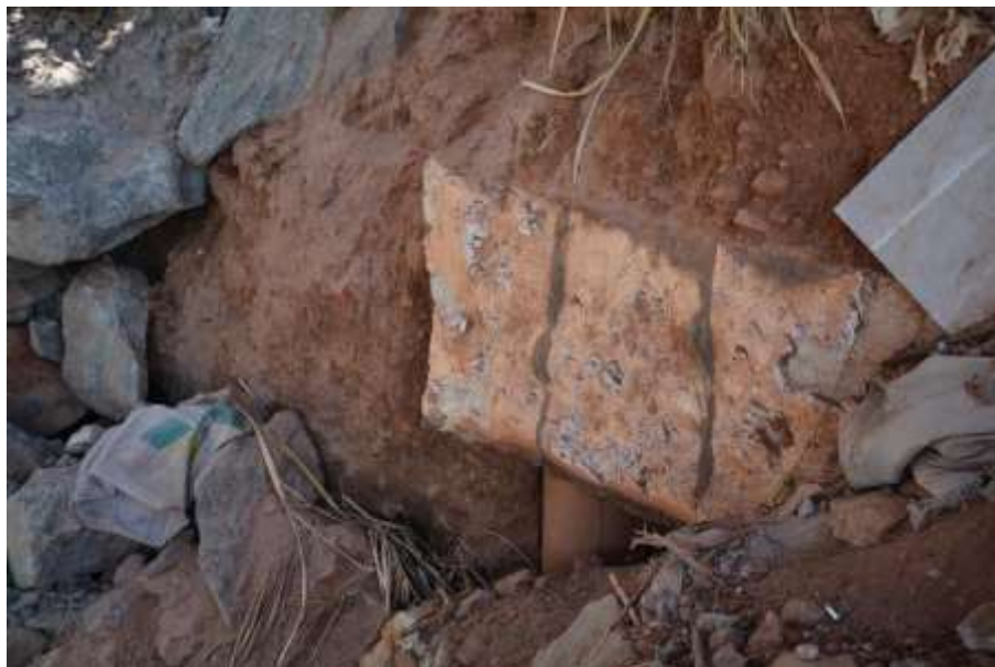
FOTO 39 –Vista aproximada do ponto da erosão de parte do aterro da fundação dos pilares da ponte podendo comprometer sua estabilidade na pista da Ponte T-63 sobre o córrego Cascavel visualizado da Avenida T-63 sentido Bairro / Centro
