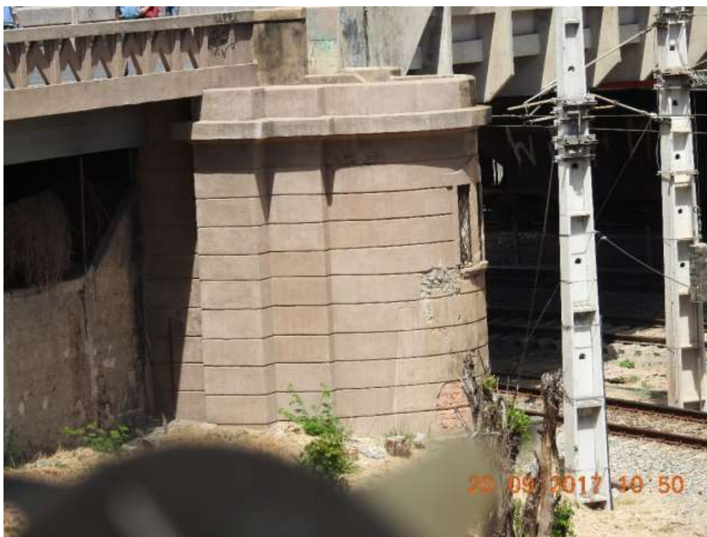
F60/ST – Mostra detalhe da parte externa da caixa de escada em outro ponto. Deslocamento do reboco.
