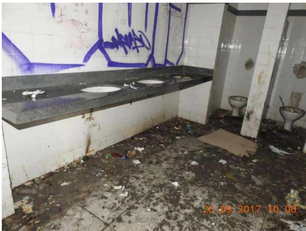
F33/ST – Todos os dois banheiros encontram-se completamente sujos. No local nota-se: Fezes, lixo, pichação, ausência de porta, ausência de iluminação, e ausência de água.
