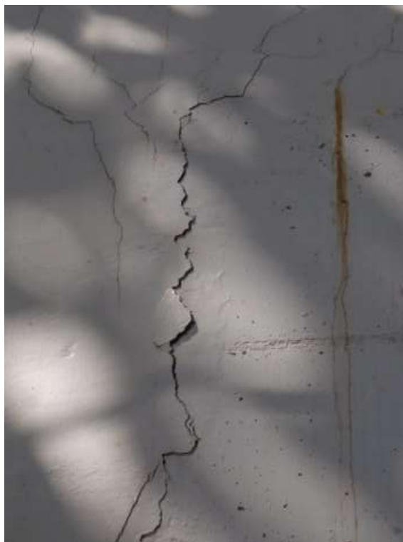
F16/FL –Viaduto Montese, detalhe das trincas verticais na estrutura de contenção.
