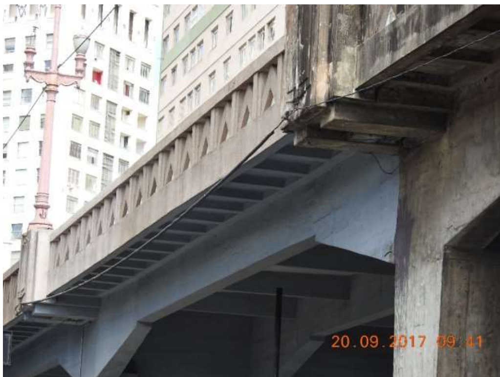
F19/ST – Falta da luminária a esquerda. Nota-se que o condutor de energia está aparente, tanto na parte inferior do viaduto, como nas ligações das luminárias na parte superior.
