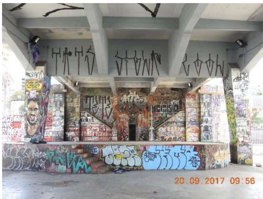
F30/ST – Detalhe do palco para shows, ao fundo escada de acesso para parte superior do viaduto e aos banheiros. Pichação.
