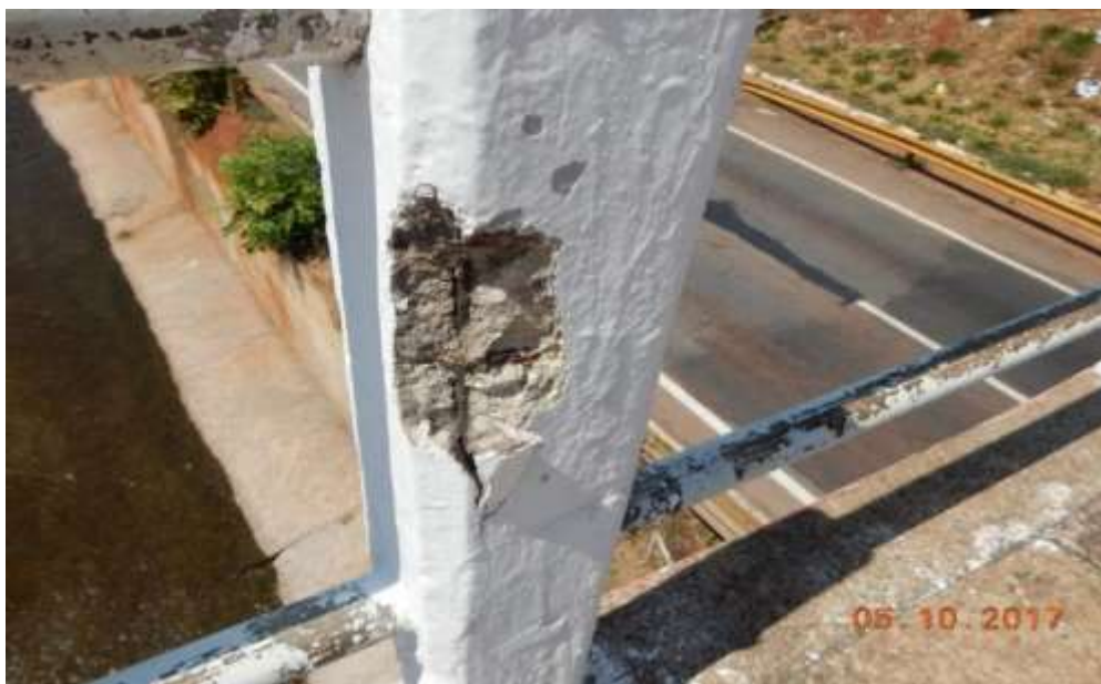
FOTO. 8 – Passeio, com guarda corpo de concreto deslocando, ferragem exposta e oxidada, evento que se repete em outros pilares da Avenida Universitária.
