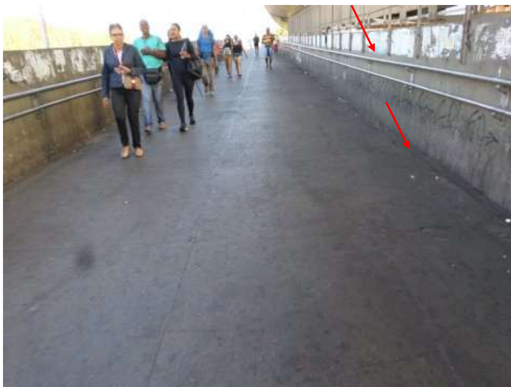
F25/FS – Vista da passarela, detalhe do deslocamento no piso cimentado e trincas.
