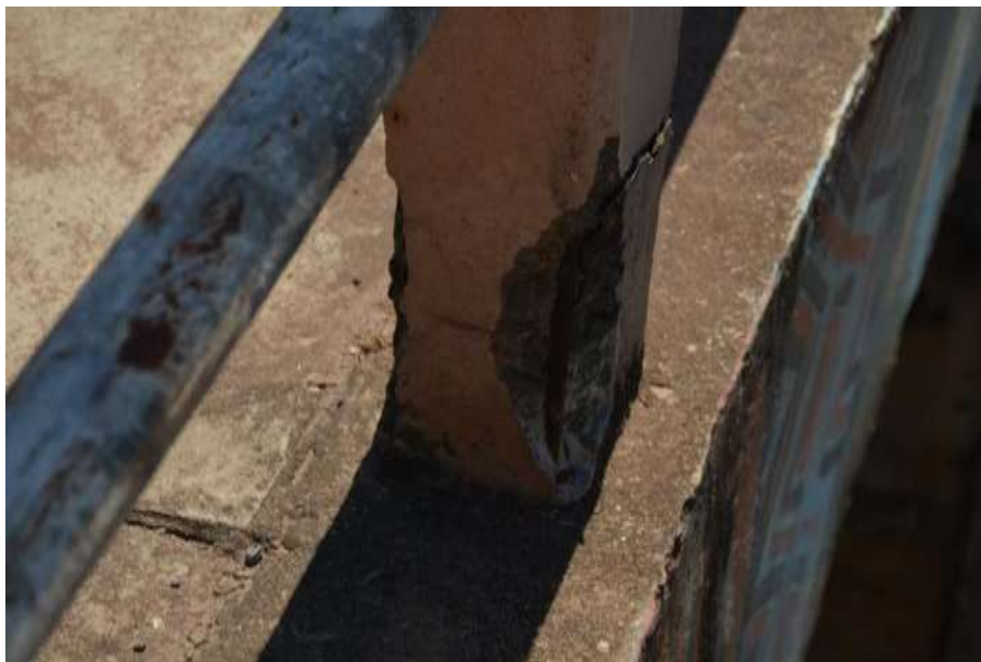
Figura 8 – Indicação de Anomalia:
