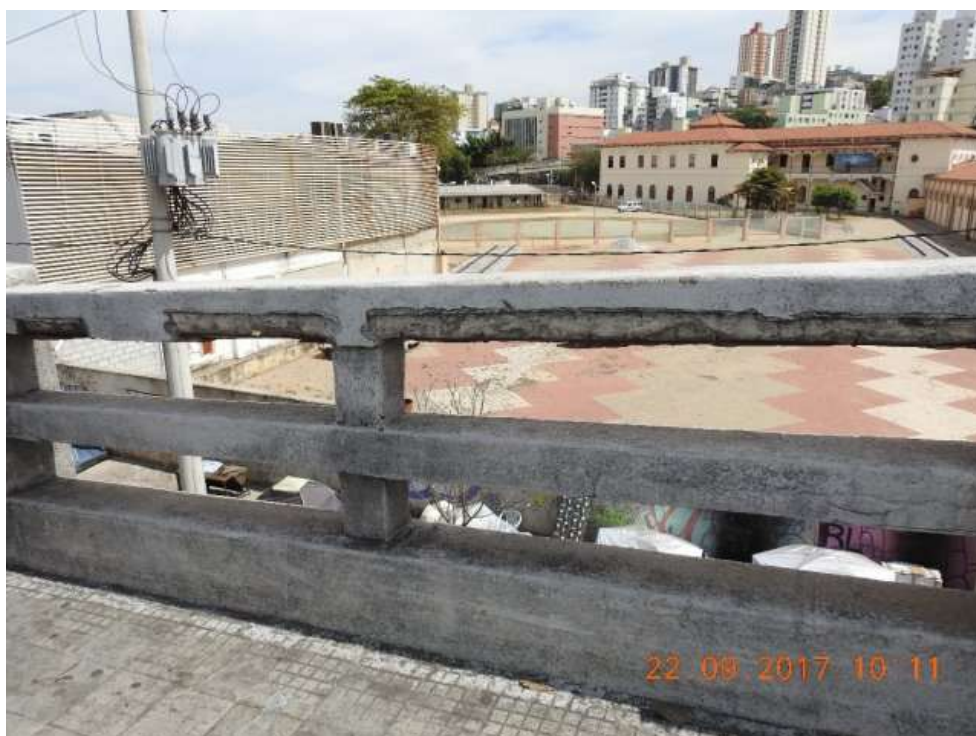
F40/FL – Outro ponto aonde ocorre deslocamento e perda do recobrimento, e oxidação da ferragem do guarda corpo, observa-se que abaixo fluxo de pedestres e veículos.
