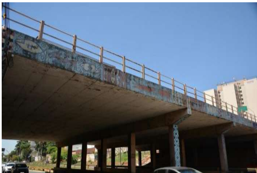
Figura 42 – Indicação de Anomalia:
