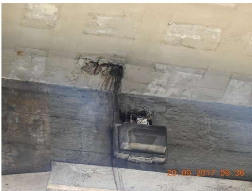
F12/ST – Deslocamento do concreto na parte inferior do tabuleiro. Efflorescência próxima a luminária.
