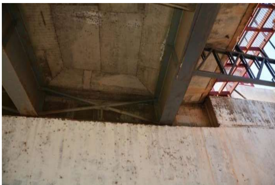
FOTO 58 – Vista da ferragem oxidada e sem proteção nos pilares de travamento da estrutura de contenção do aterro da cabeceira da ponte na Ponte T-63 sobre o córrego Cascavel visualizado da Avenida T-63 sentido Centro / Bairro e sentido Bairro / Centro.
