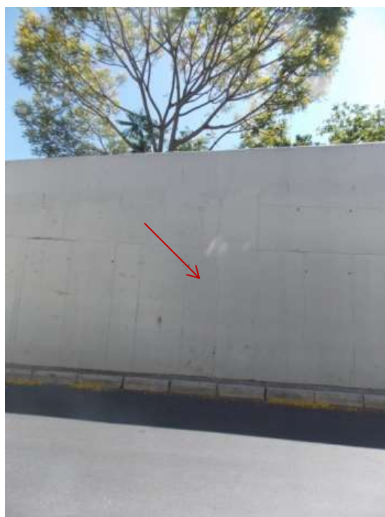
F57/FL – Viaduto Montese, detalhe da fissura presente na estrutura de contenção do viaduto.
