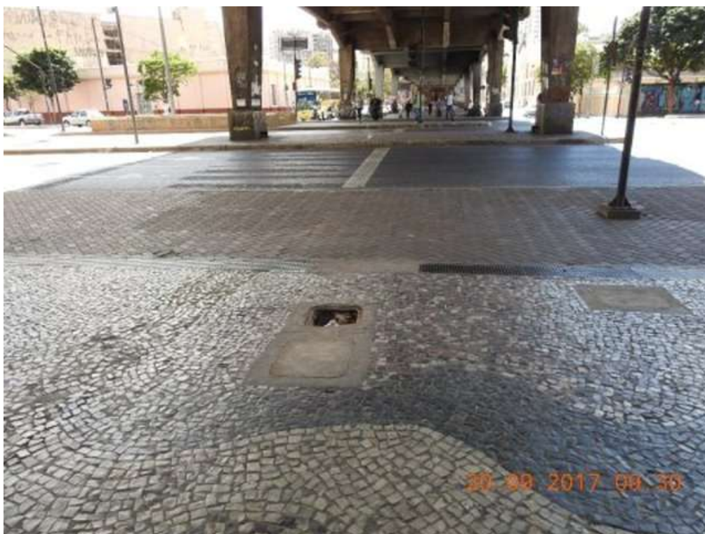
F08/ST – Ausência da tampa da caixa de passagem no passeio localizado na Avenida dos Andradas. Local com grande fluxo de pessoas.
