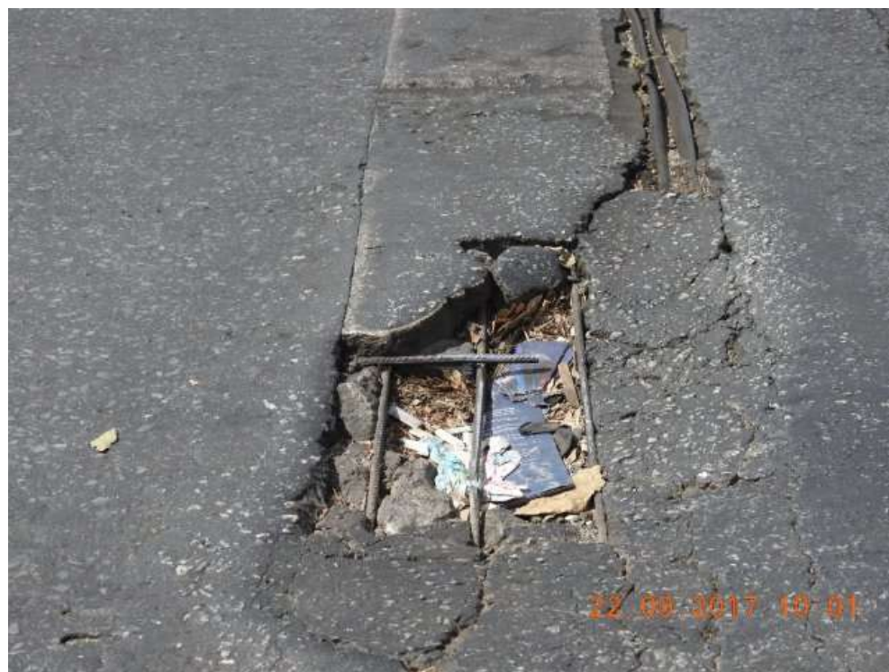
F46/FL – Detalhes da foto anterior mostra ferragem exposta, sujeira, perda do elemento de impermeabilização da junta, trincas.
