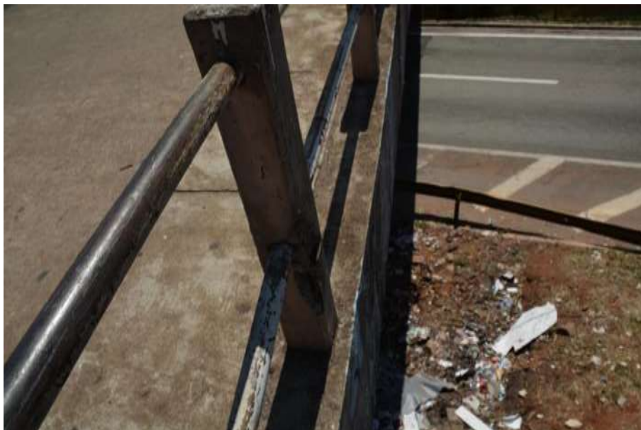
Figura 18 – Indicação de Anomalia:
