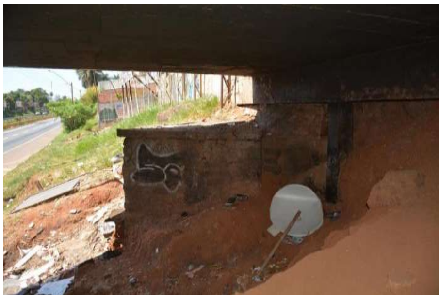
Figura 126 – Indicação de Anomalia:
