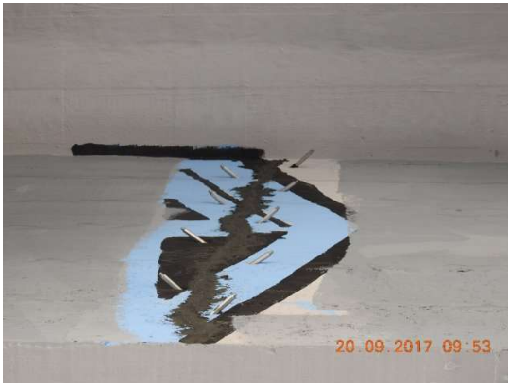
F27/ST – Detalhe de outra trinca na viga do tabuleiro que passou por intervenção.
