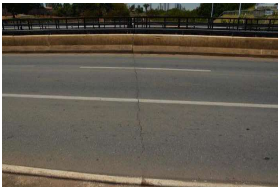
FOTO 16 – Vista de outro ponto da junta de trabalho na superestrutura (tabuleiro), as marcas de trabalho no pavimento asfáltico permitindo a passagem de água e ocasionando o excesso de umidade na parte inferior da superestrutura na Ponte T-63 sobre o córrego Cascavel visualizado da Avenida T-63 sentido Bairro / Centro.
