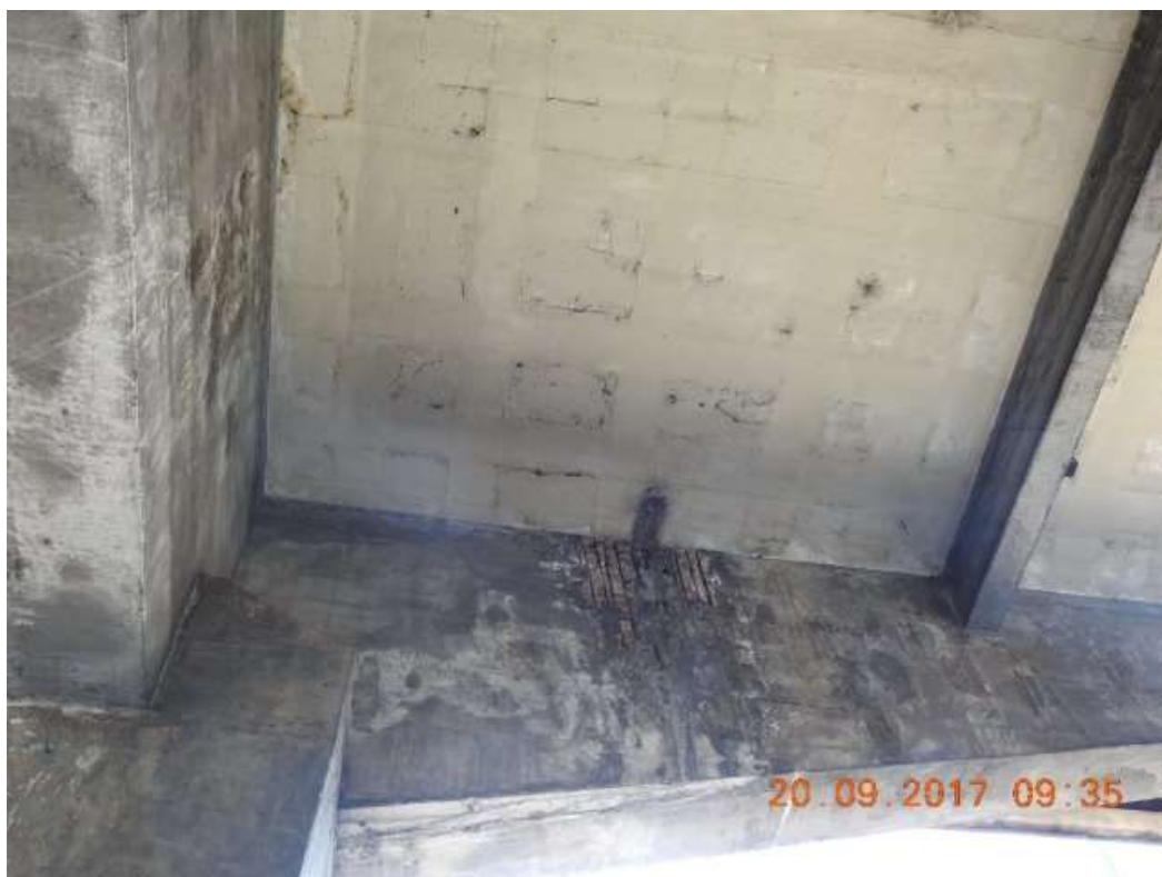
F14/ST – Detalhe: Viga do tabuleiro, eflorescência e oxidação da ferragem.
