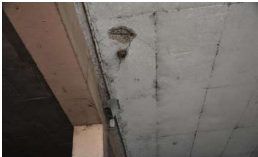
Figura 70 – Indicação de Anomalia:
