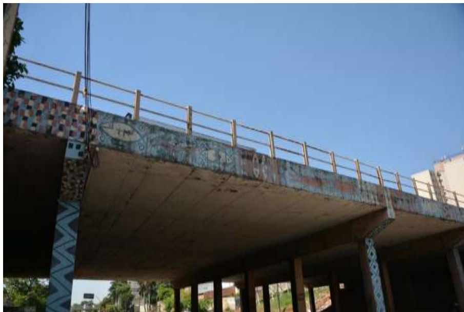
Figura 44 – Indicação de Anomalia:
