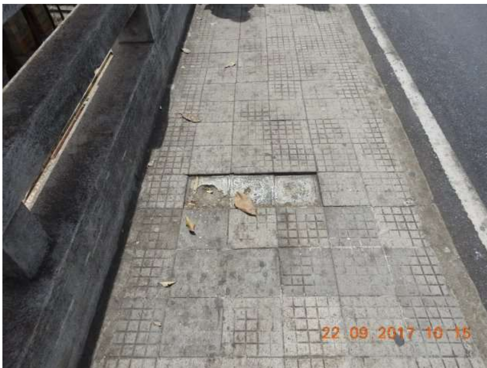
F33/FL – Perda de parte do revestimento no passeio.
