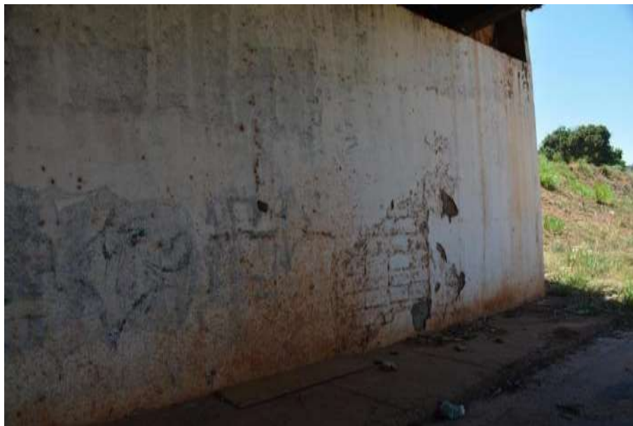
FOTO 53 – Vista do deslocamento da argamassa de proteção dos blocos de contenção do aterro da cabeceira da ponte na Ponte T-63 sobre o córrego Cascavel visualizado da Avenida T-63 sentido Bairro / Centro.
