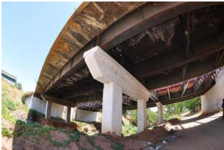
FOTO 31 – Vista da presença de umidade no balanço da parte inferior da superestrutura (tabuleiro), já com comprometimento do recobrimento da armadura (aço) na pista da Ponte T-63 sobre o córrego Cascavel visualizado da Avenida T-63 sentido Bairro / Centro.
