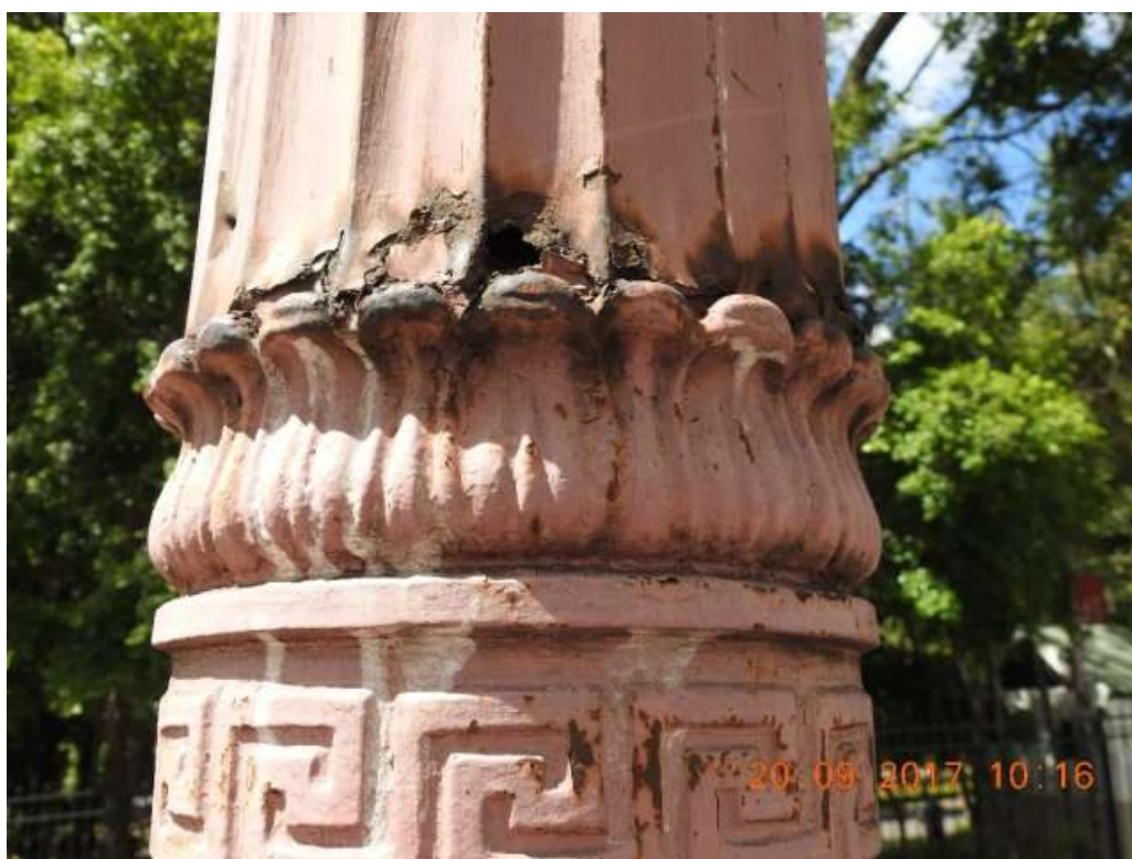
F46/ST – Poste da iluminação na parte superior do viaduto em processo de corrosão.
