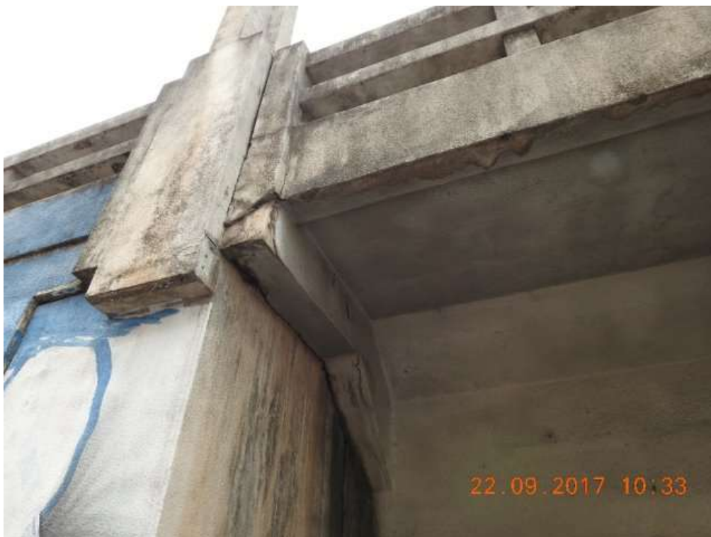
F11/FL – Presença de umidade na junta de dilatação, localizada na cabeceira do viaduto (lado do Bairro Floresta), desprendimento e perda do recobrimento no pilar, e trincas existentes na viga.
