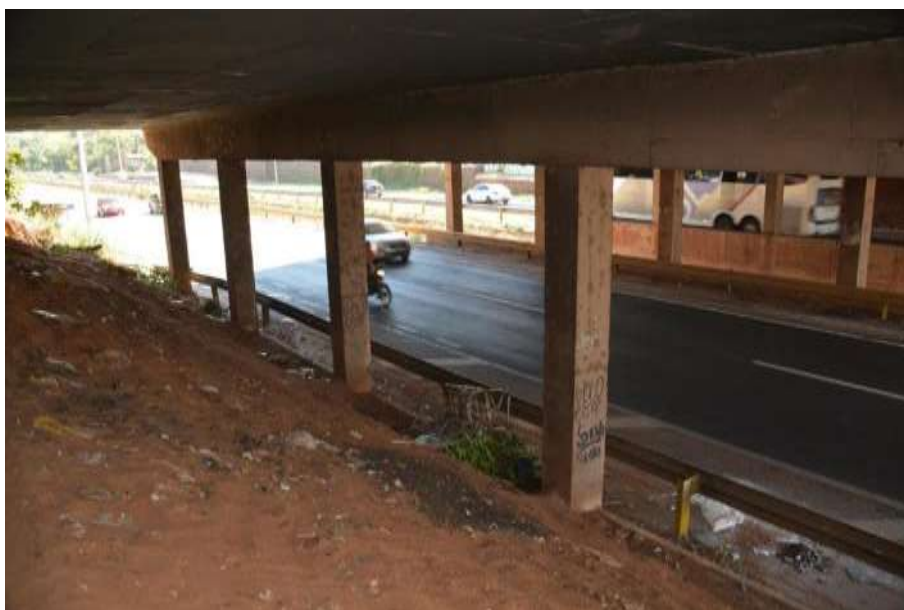
Figura 125 – Indicação de Anomalia:
