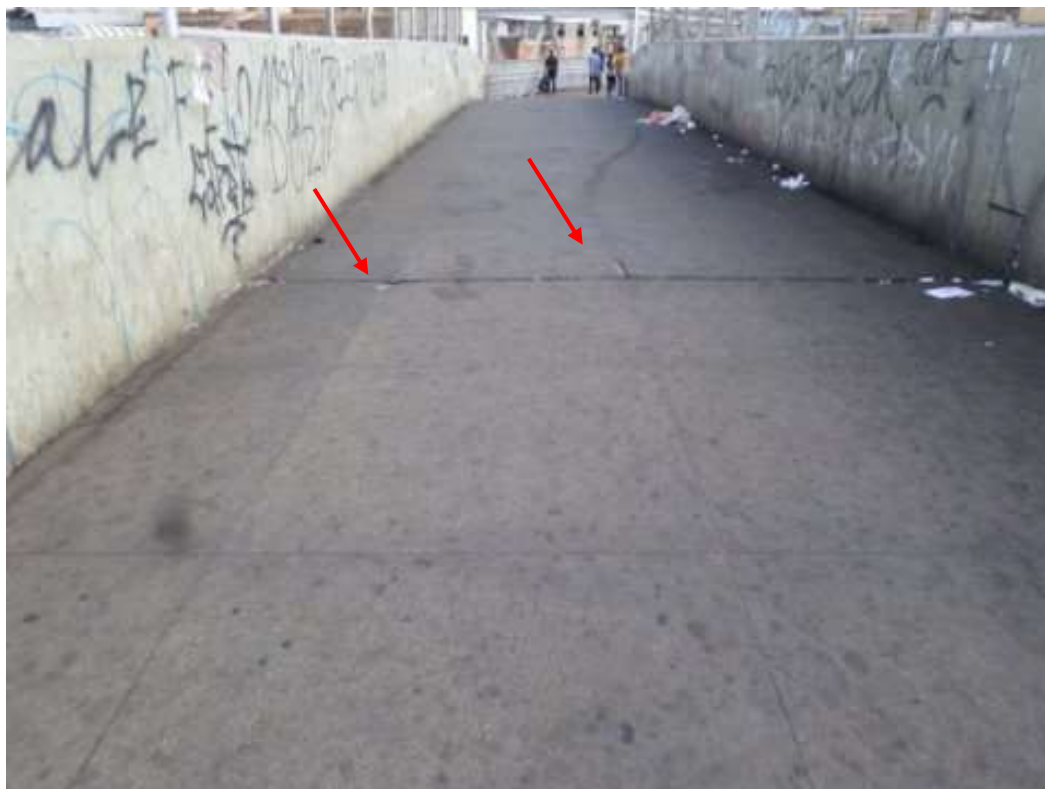
F38/FS – Vista de deslocamento de piso cimentado na junta de movimentação da passarela.
