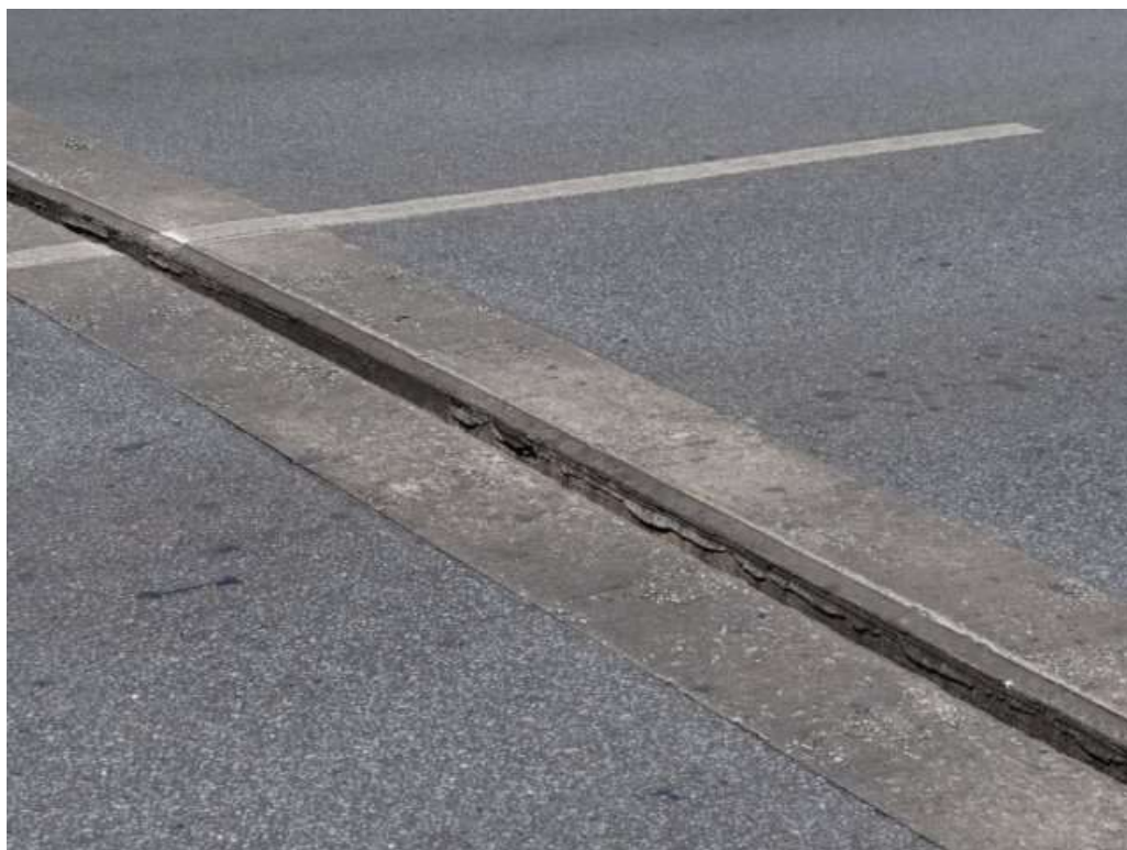
F44/FS – Detalhe do desnível existente na pista de rolamento no ponto onde se localiza junta de dilatação.
