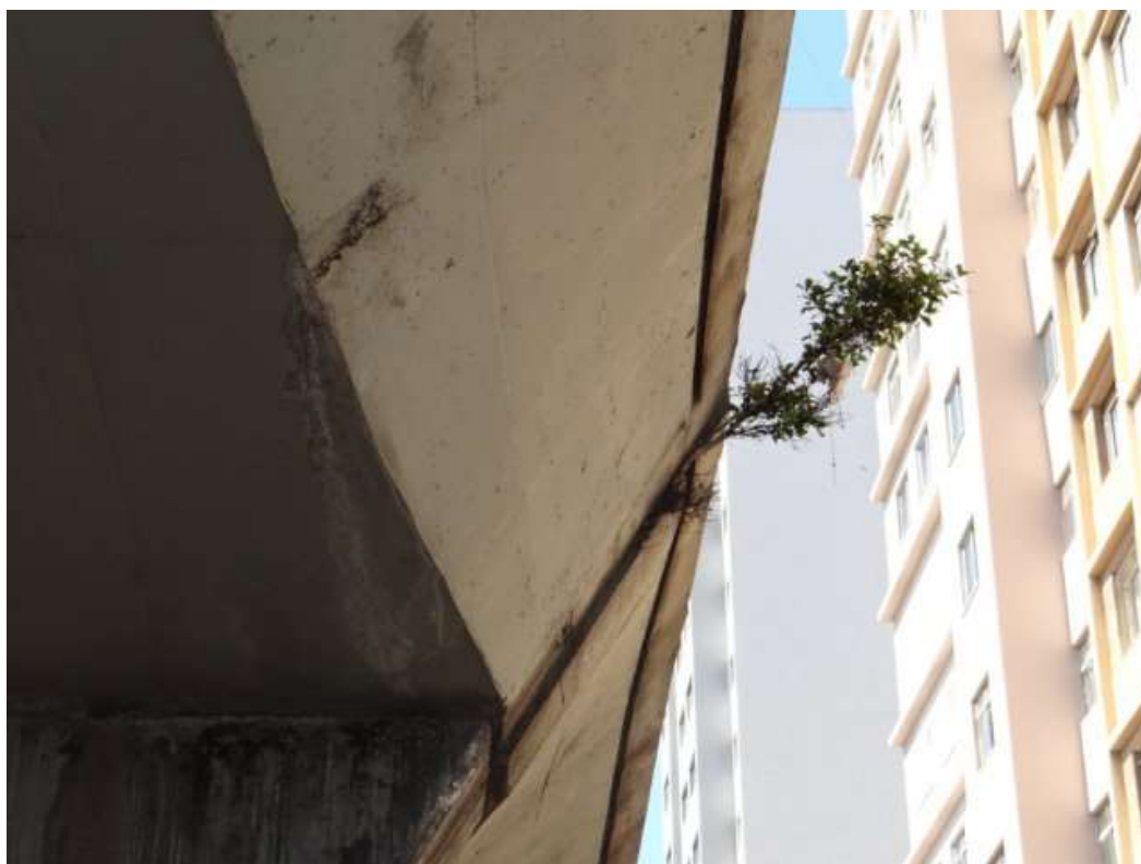
F36/HG – Detalhe de juntas com umidade e vegetação aparentes.
