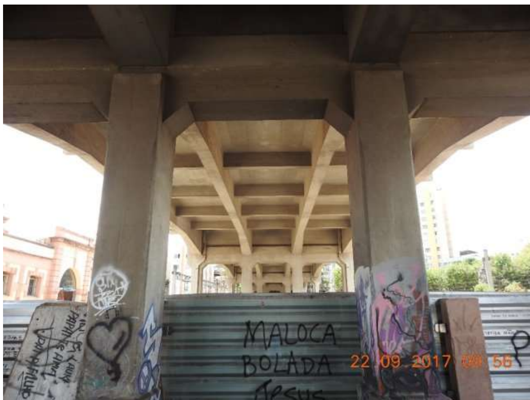
F85/FL – Vista do tabuleiro, vigas e pilares, pichações.
