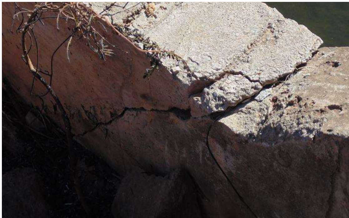
Foto 8 – Trinca expressiva na viga da lateral do talude.
