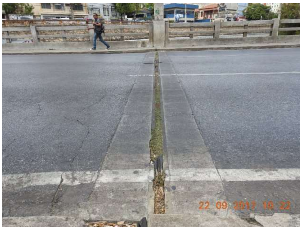
F22/FL – Detalhe da junta, o elemento do sistema de impermeabilização já comprometido e sem função. Presença de vegetação e sujeira na junta.
