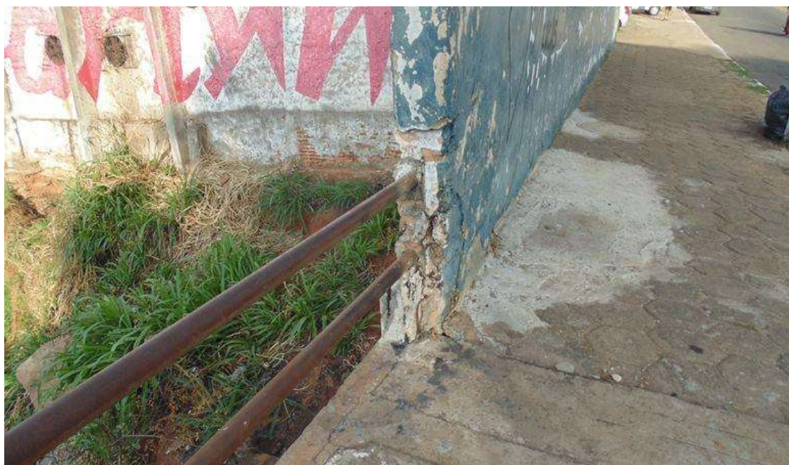
Foto 3 – Guarda-corpo mal fixado.
