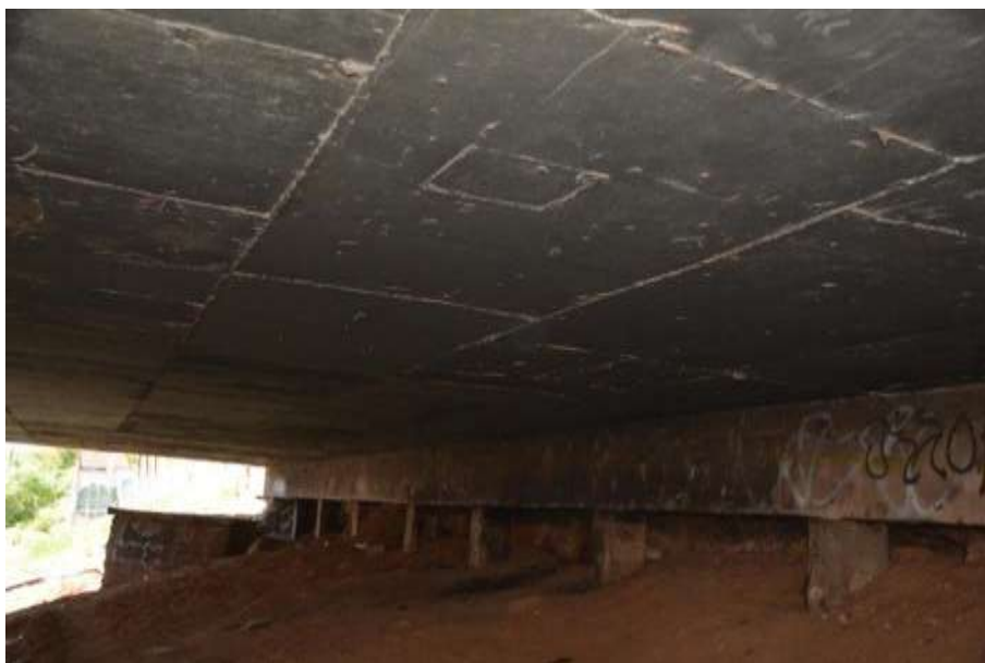
Figura 131 – Indicação de Anomalia:
