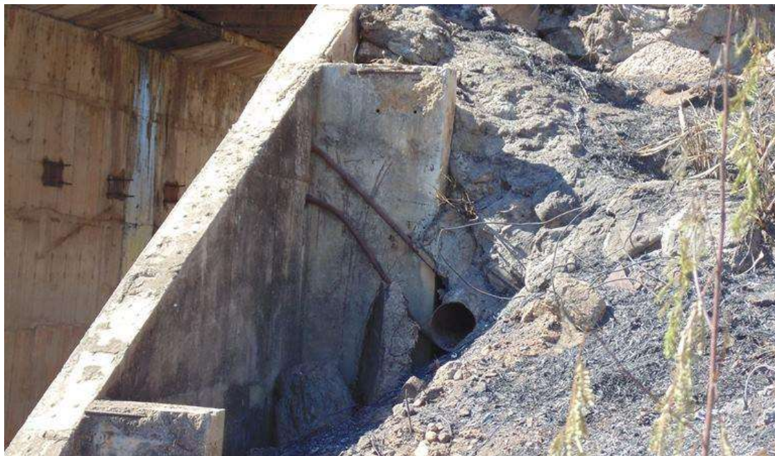
Foto 4 – Ferragem aparente na cabeceira, sujeita à corrosão, onde está ocorrendo erosão.
