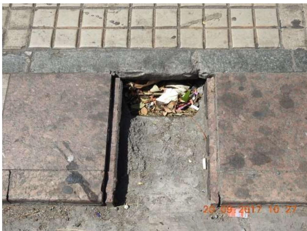
F48/ST – Detalhe: Sistema de drenagem obstruído por sujeira.
