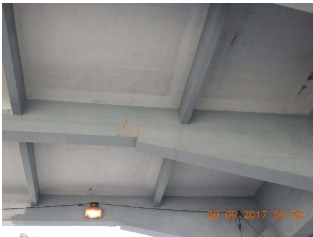
F24/ST – Condutor de energia fora do eletroduto. Armadura do tabuleiro comprometida e trinca na viga.
