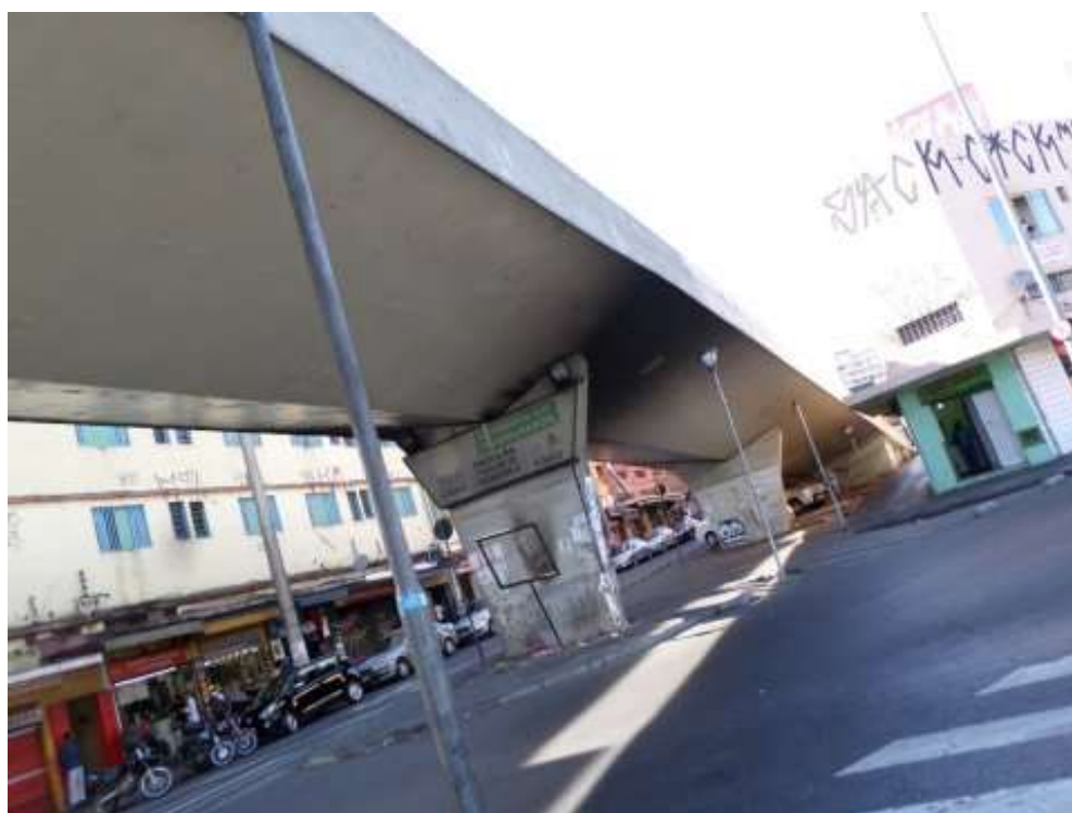
F12/FS – Vista da parte inferior do tabuleiro com manchas de fuligem.
