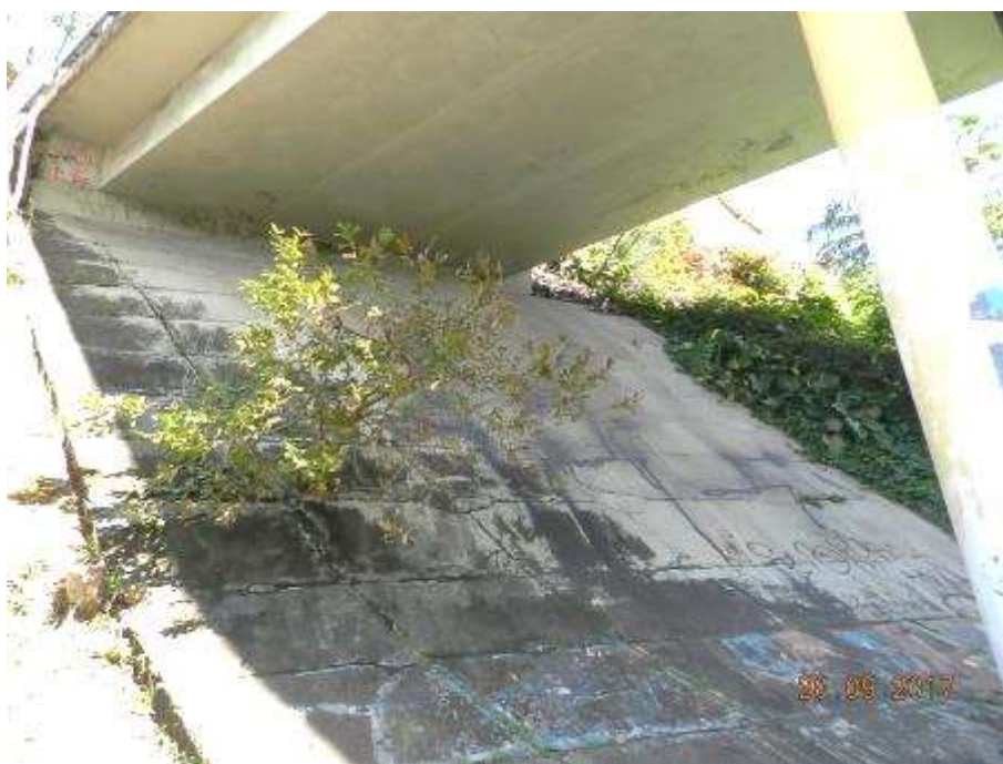
- Crescimento de vegetação na camada de concreto do talude.
