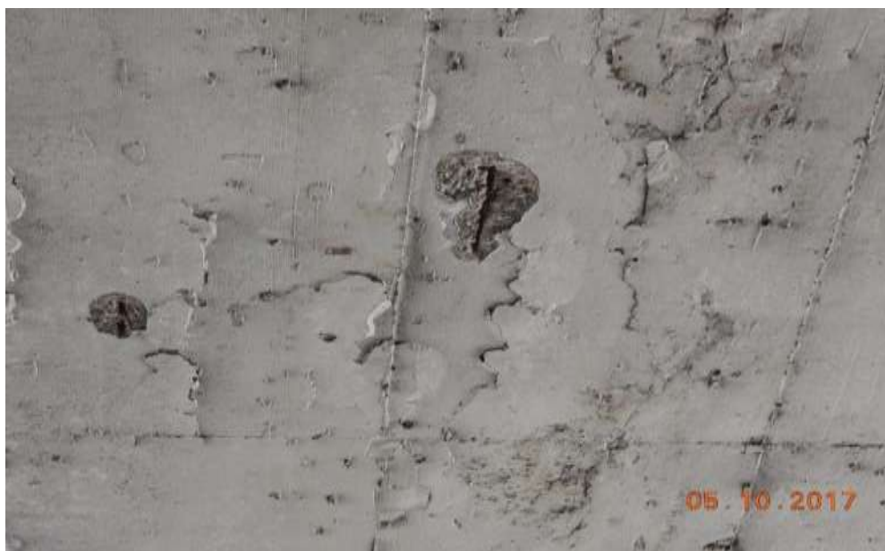
FOTO. 19 – Laje, vista inferior pela Marginal Botafogo, com concreto deslocando, ferragem exposta e oxidada. Consequência do cobrimento inferior insuficiente.
