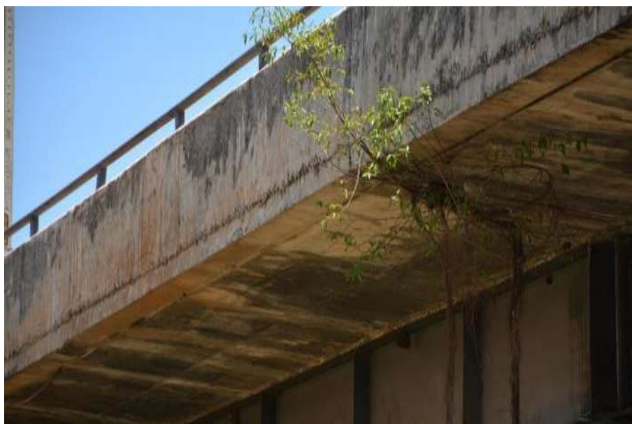
FOTO 34 – Vista aproximada do ponto de outro ponto do detalhe da lateral da ponte com presença de umidade em diversos pontos. Detalhe de junta de dilatação com excesso de umidade e evidência da falta de manutenção (vegetação).
