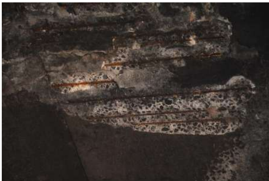
FOTO 43 – Vista aproximada da presença de umidade na parte inferior da superestrutura (tabuleiro), já com comprometimento do recobrimento da armadura (aço).
