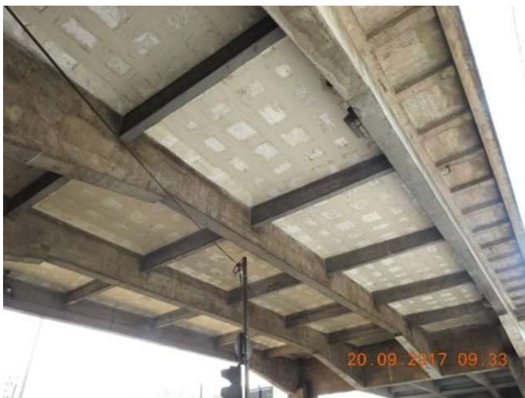
F10/ST – Vista geral do tabuleiro. Manchas provenientes de umidade.
