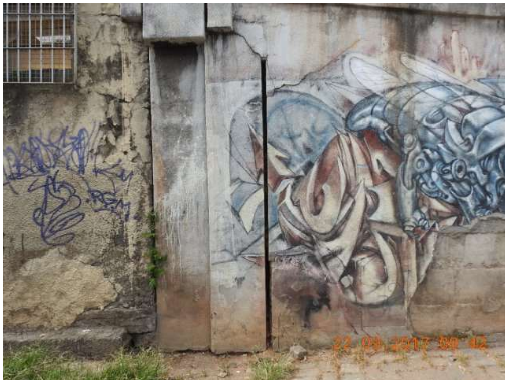
F71/FL – Infiltrações e trincas no muro da cabeceira do viaduto próxima a junta, presença de vegetação, pichações.
