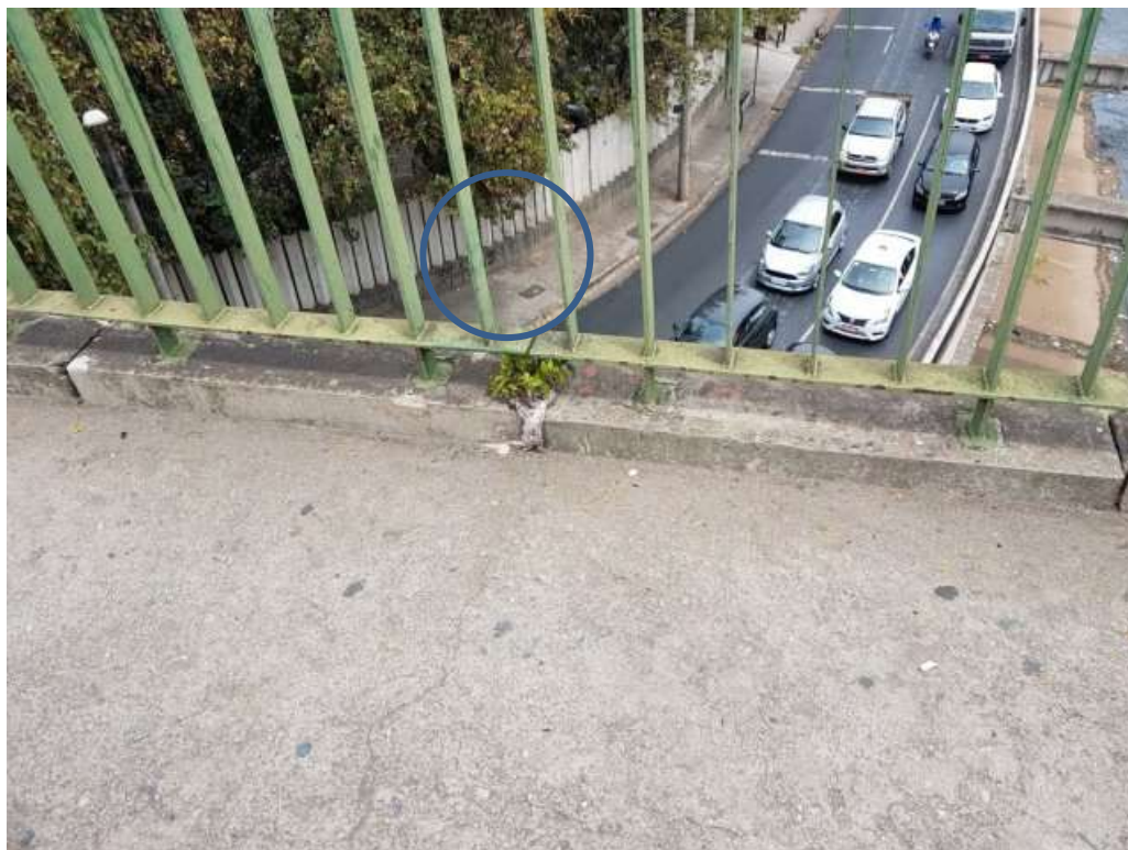
F53/FS – Vegetação crescendo junto ao guarda corpo.
