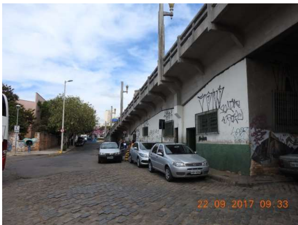
F52/FL – Vista da lateral do viaduto ao lado do Centro de Referência da Juventude, neste ponto, na parte de baixo do viaduto, existe um local de apoio à SLU, vestiários e armazenamento de ferramentas. Pichações e deterioração do cobrimento das paredes.
