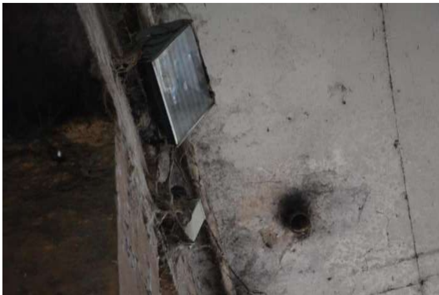
Figura 62 – Indicação de Anomalia:
