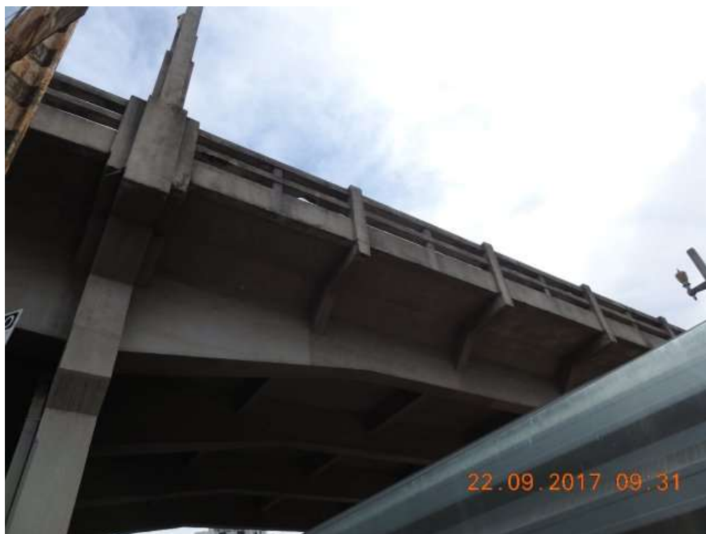
F55/FL – Outra vista da lateral, trincas, deslocamento e perda do recobrimento da base de outro pilar do guarda corpo, abaixo passagem de veículos e pedestres.
