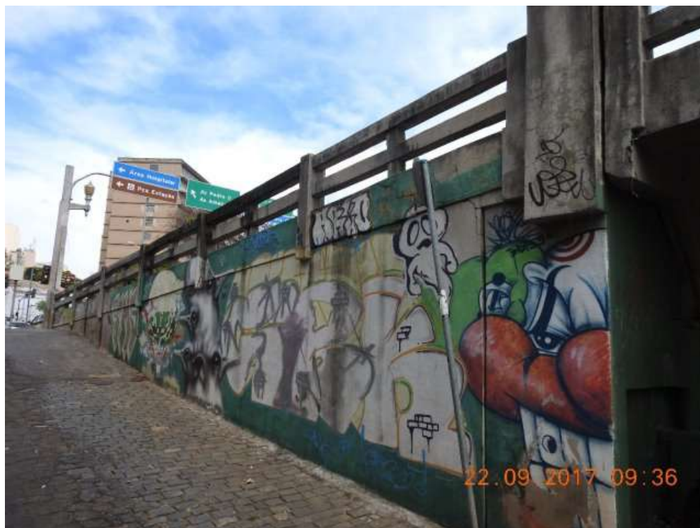
F61/FL – Trincas próximas a junta e desprendimento de parte do revestimento na base do pilar do guarda corpo.
