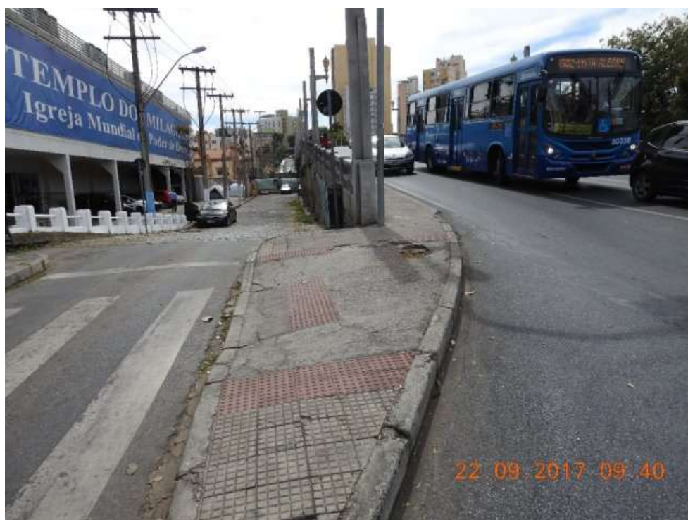
F67/FL – Vista do passeio do lado esquerdo do Centro de Referência da Juventude esquina da Avenida do Andradas esquina de da Avenida do Contorno. Danos, falta de padronização, falha na sinalização, falta do ladrilho tátil de direcionamento e alerta.
