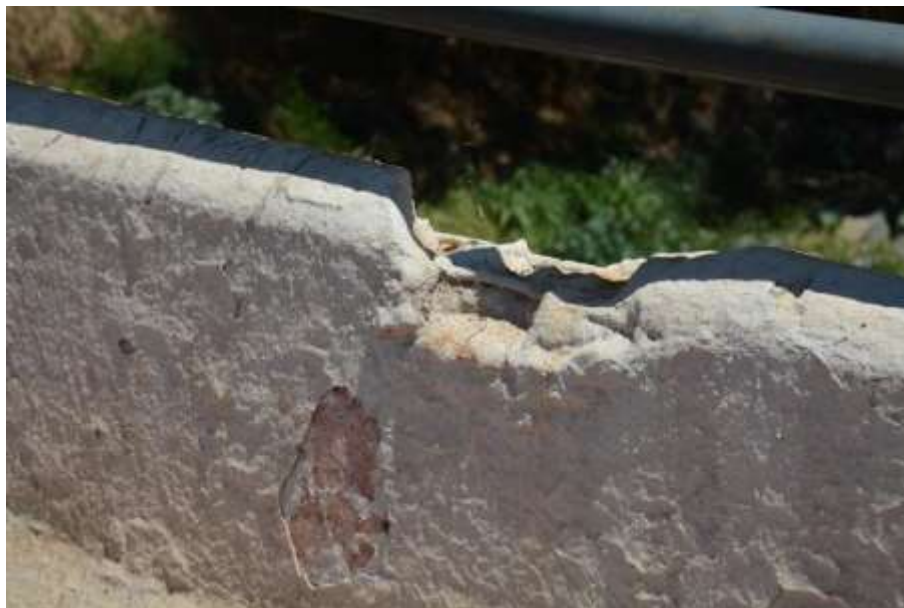
FOTO 7 – Vista de outro ângulo do guarda corpo com deslocamento do concreto na lateral da pista deixando a ferragem exposta da Ponte T-63 sobre o córrego Cascavel visualizado da Avenida T-63 sentido Centro / Bairro
