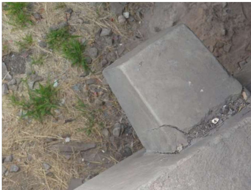
F26/HG – Cabeça de um dos tirantes apresentando trincas.
