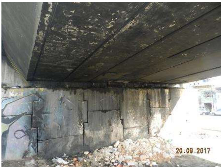
- Sinais de queimadas na cabeceira 02 do viaduto.
