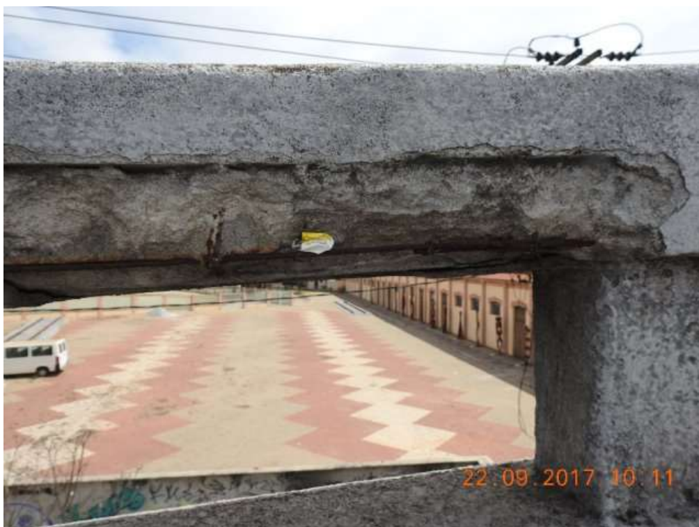
F38/FL – Outro ponto onde ocorre deslocamento e perda do recobrimento, e oxidação da ferragem no guarda corpo.
