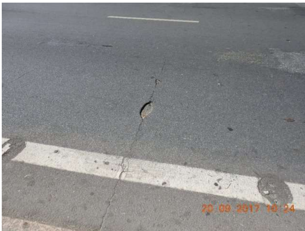
F42/ST – Neste ponto o asfalto precisa de reparos
