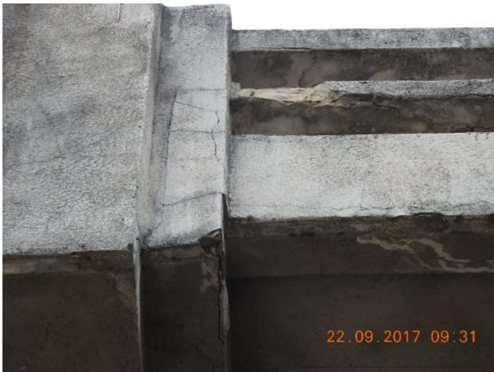
F58/FL – Deterioração do recobrimento no pilar e guarda corpo, trincas.
