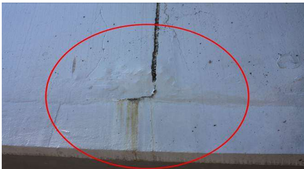
F82/FL – Evidências de deterioração da armadura.
