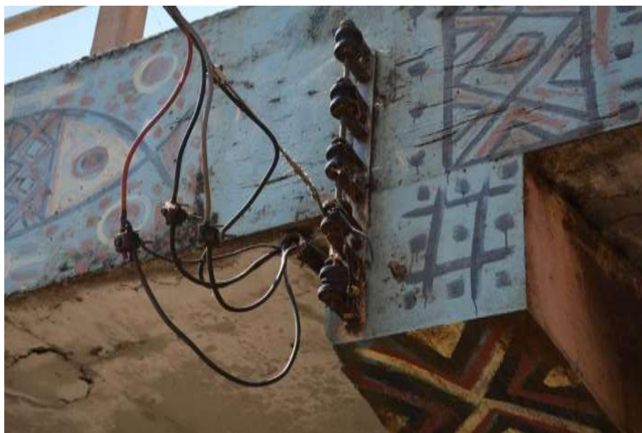
Figura 50 – Indicação de Anomalia:
