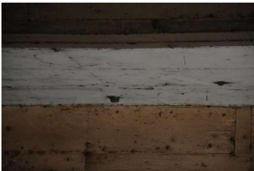
Figura 65 – Indicação de Anomalia:
