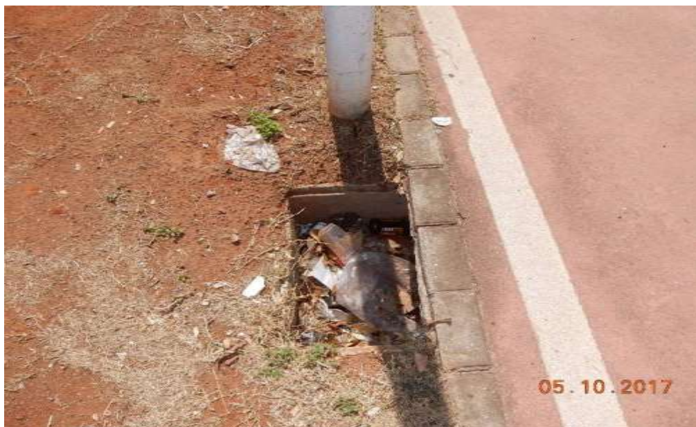
FOTO. 12 – Caixa de inspeção com entulhos e sem tampa, na ilha central da Avenida Universitária.
