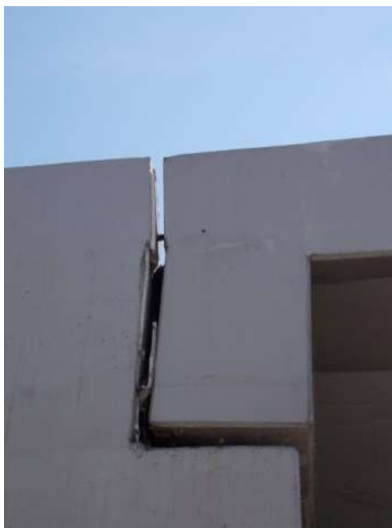
F44/FL –Viaduto Montese, detalhe do deslocamento do apoio direito, alça do lado do Bairro Santa Branca.
