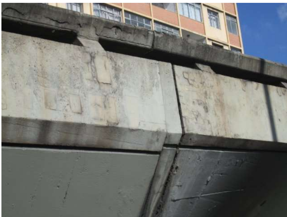
F32/HG – Detalhe de umidade em torno de uma das juntas e deslocamento.
