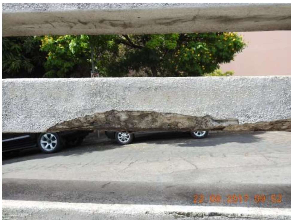
F51/FL – Outro ponto desprendimento e perda do recobrimento, e oxidação da ferragem do guarda corpo.
