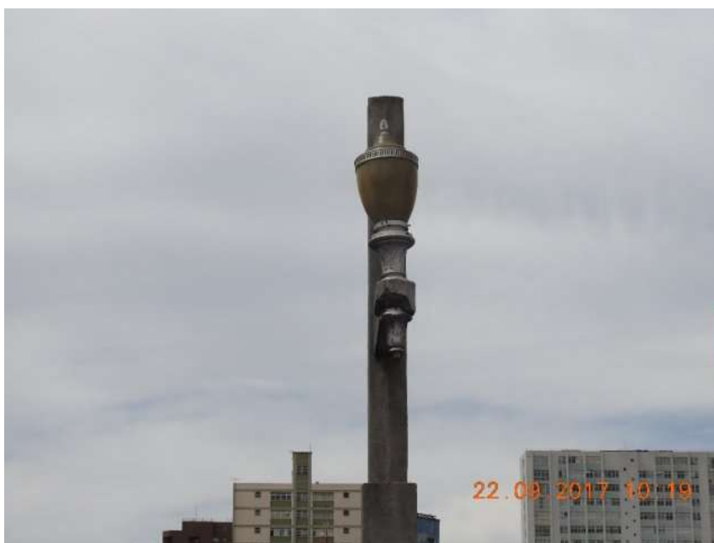
F28/FL – Desplacamento do concreto na base do suporte da luminária, abaixo grande fluxo de pedestres e veículos.
