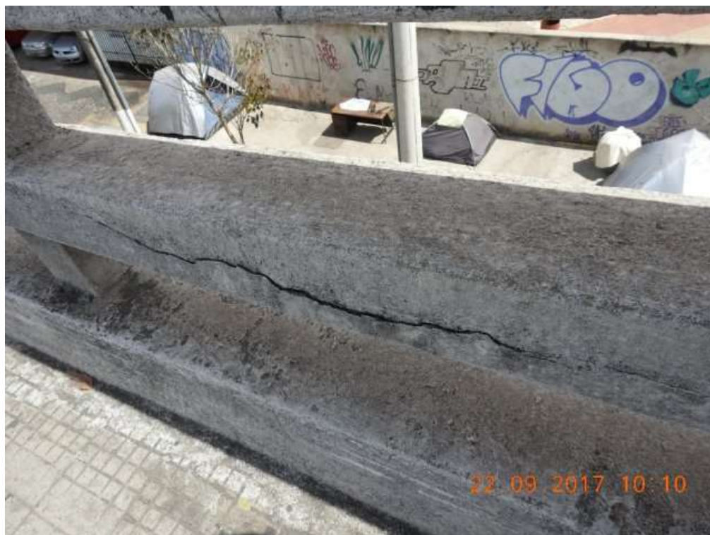
F41/FL – Trincas no recobrimento do guarda corpo.
