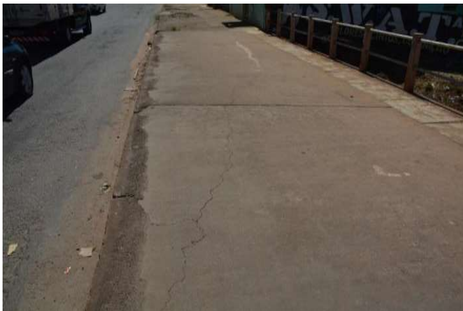
Figura 27 – Indicação de Anomalia:
