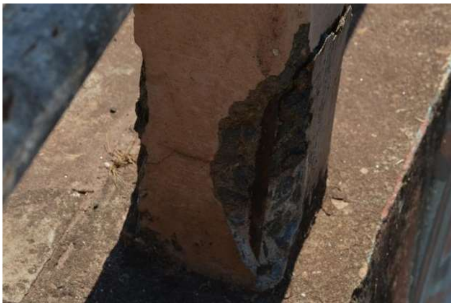
Figura 9 – Indicação de Anomalia:
