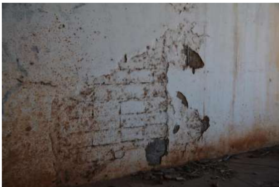
FOTO 54 – Vista aproximada do deslocamento da argamassa de proteção dos blocos de contenção do aterro da cabeceira da ponte na Ponte T-63 sobre o córrego Cascavel visualizado da Avenida T-63 sentido Bairro / Centro.
