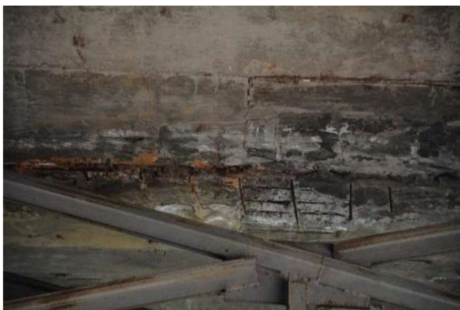
FOTO 28 – Vista de outro ângulo da presença de umidade na parte inferior da junta de dilatação da superestrutura (tabuleiro), já com comprometimento do recobrimento da armadura (aço).
