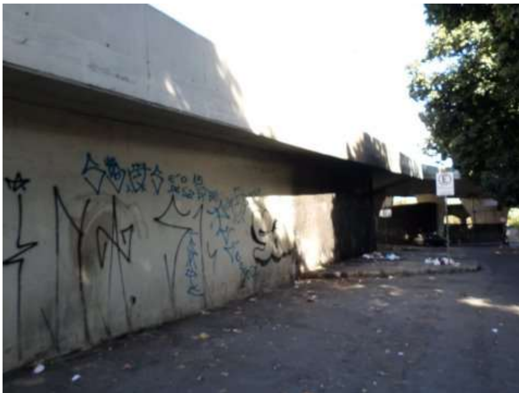
F18/FS – Vista da lateral direita apresentando sujidades e pichações.
