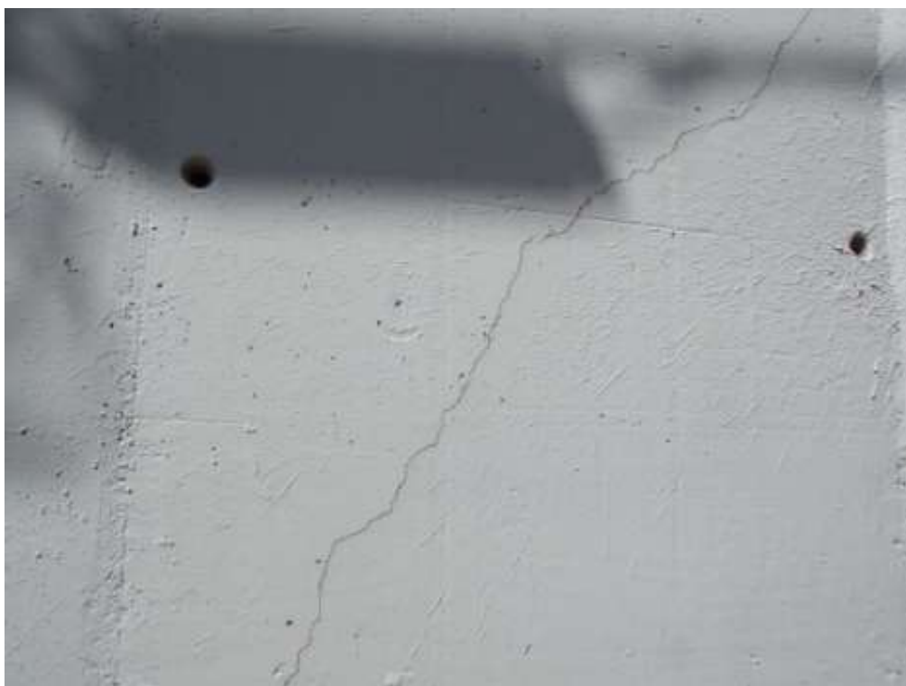
F22/FL –Viaduto Montese, detalhe de fissura na estrutura de contenção.
