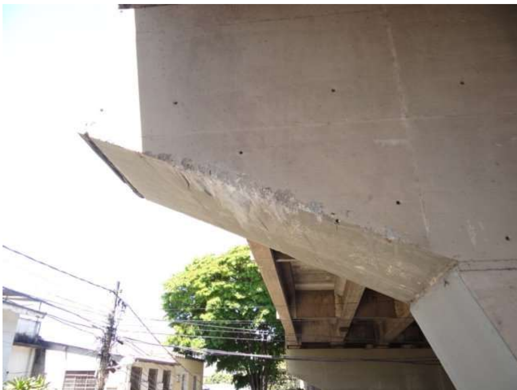
F36/FS – Lateral do viaduto, Bairro Floresta, onde há ocorrência patologias decorrentes de impacto de veículos. Não foi constatada a existência de placas que indiquem o limite de altura no local.
