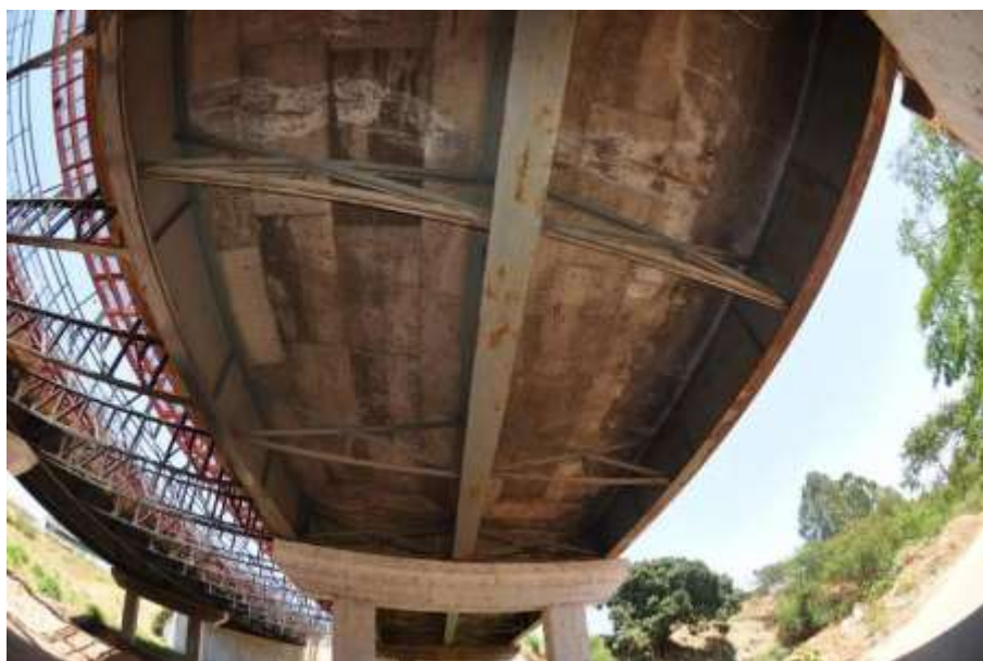
FOTO 20 – Vista da presença de umidade na parte inferior da superestrutura que já está com comprometimento do recobrimento da armadura (aço), na pista da Ponte T-63 sobre o córrego Cascavel visualizado da Avenida T-63 sentido Centro / Bairro.
