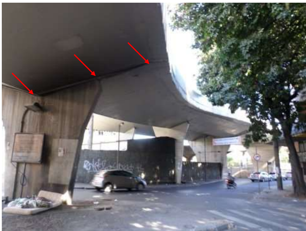
F20/FS – Vista da alça para Av. Presidente Antônio Carlos. Manchas provocadas por infiltrações, bem como trincas no concreto de sua extremidade.
