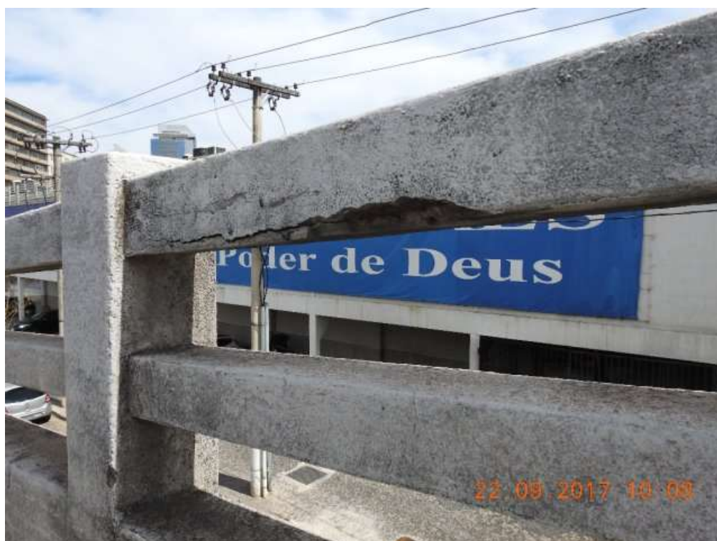
F42/FL – Trincas e desprendimento e perda do recobrimento do guarda corpo.
