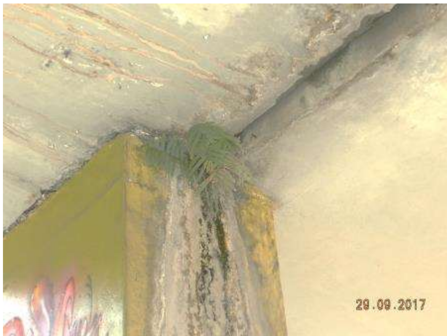
- Vegetação surgindo próximo à junta de dilatação, infiltrações e efflorescência.
