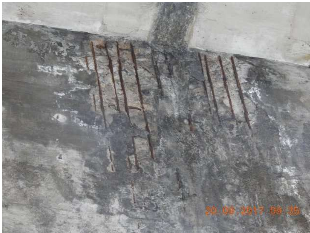
F15/ST – Falta de cobrimento e oxidação da ferragem.
