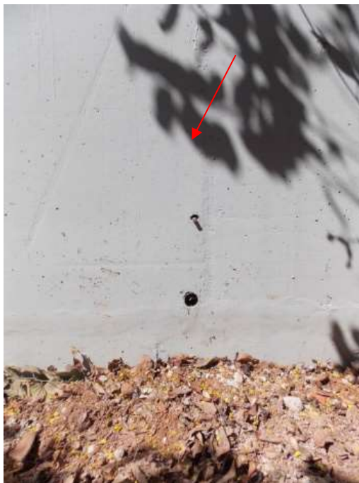
F05/FL – Viaduto Montese, contenção lateral esquerda 3 de acesso do Bairro Santa Branca, destacando haste metálica proeminente .
