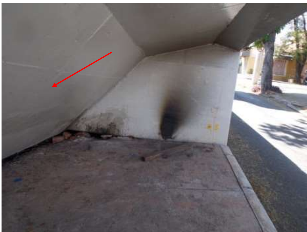
F70/FL – Viaduto Montese, sinais de fogueira situado sob o viaduto. Nota-se também pontos susceptíveis a infiltrações. Região da alça do Bairro Itapoã.
