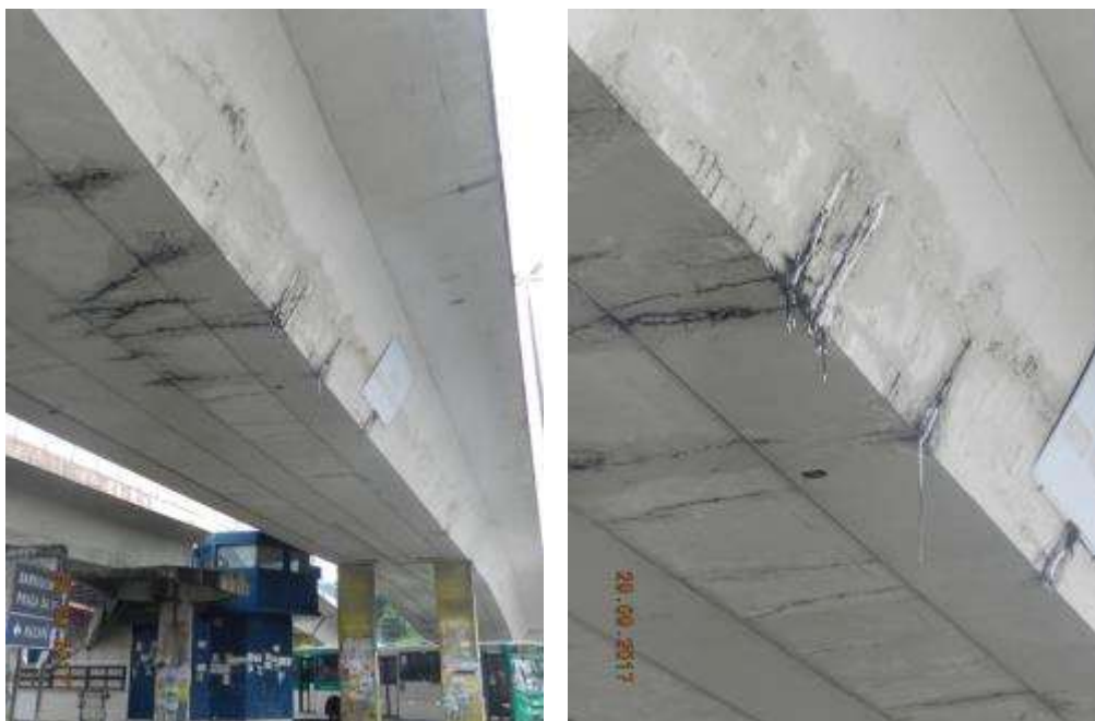
- Presença de estalactites na laje do viaduto (sentido Comércio).
