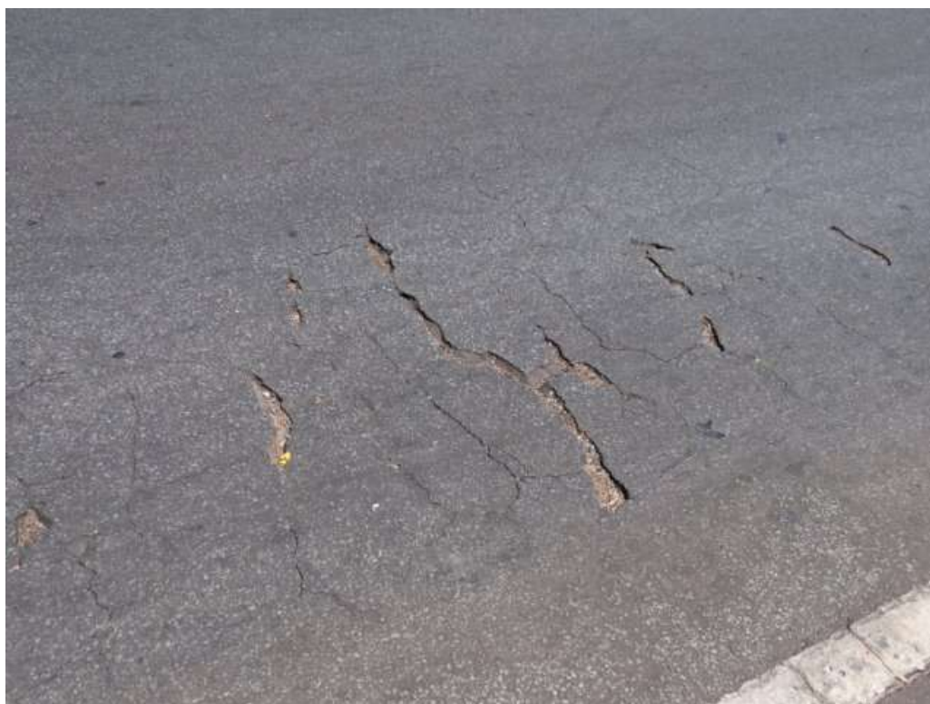
F57/FS – Pavimentação asfáltica necessitando de reparos.
