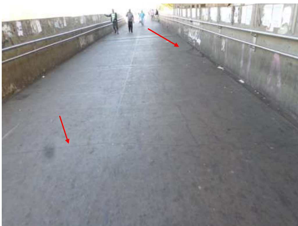
F26/FS – Vista de mais trincas e deslocamento.
