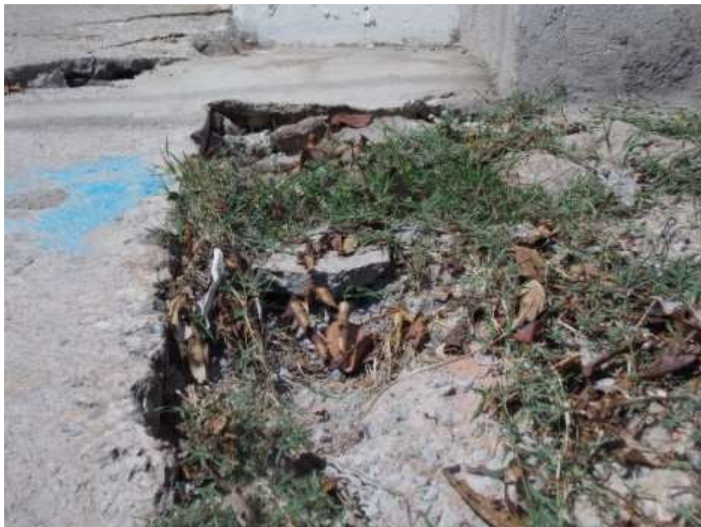
F31/FL – Viaduto Montese, detalhe da base do pilar com indício de percolação de água e recalque de solo.
