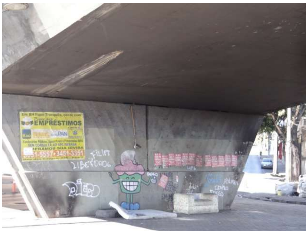
F37/HG – Outro ponto com eflorescência na laje.
