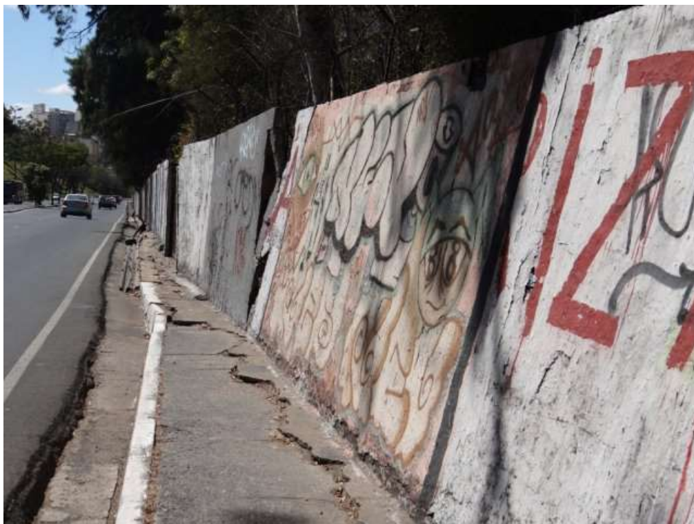
F43/HG – Detalhe de muro situado nas margens do logradouro prestes a desabar.
