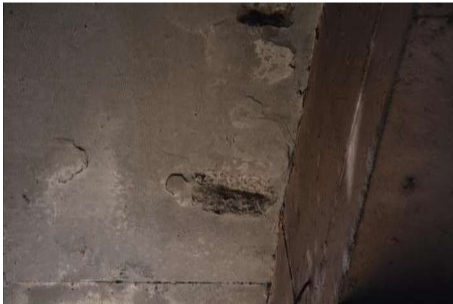
Figura 56 – Indicação de Anomalia:
