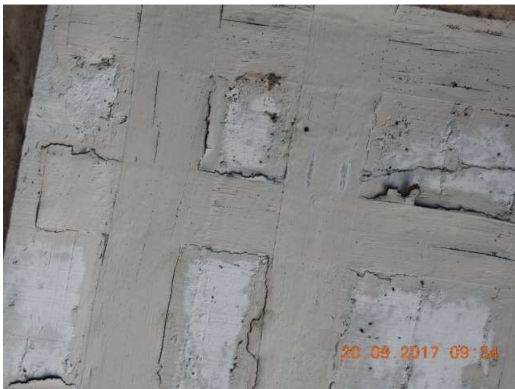
F11/ST – Detalhe visto da parte inferior do tabuleiro, o revestimento encontra-se desprendendo, logo abaixo existe passagem de pedestres.
