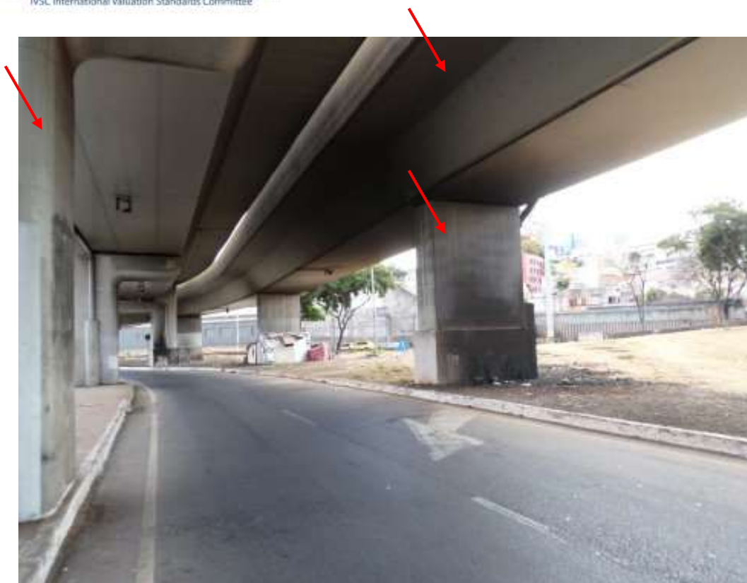
F63/FS – Vista de mais uma luminária danificada, base de pilar com manchas de fuligens.
