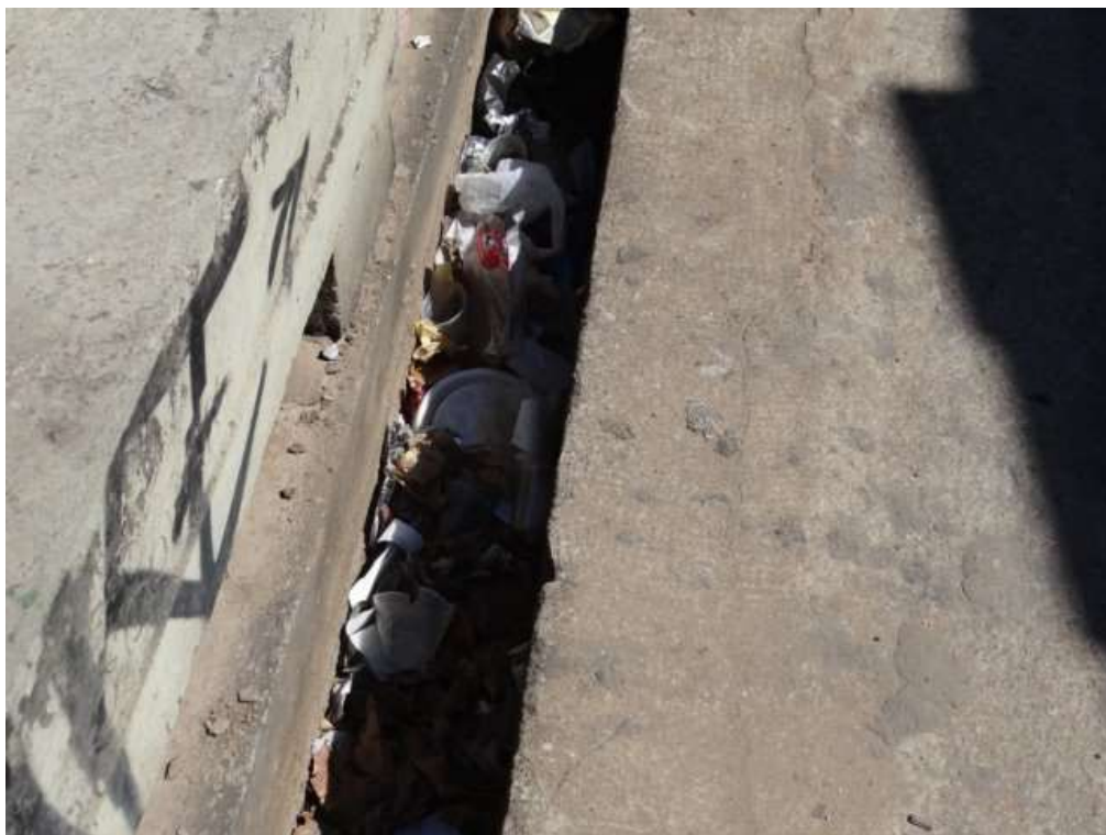
F11/HG – Sistema de drenagem necessitando de limpeza e com funcionamento projetado comprometido.
