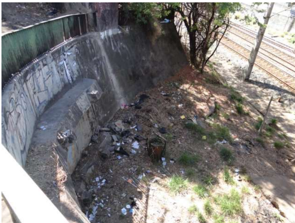
F24/HG – Detalhe de contenção com tirantes, próxima a linha férrea. Observa-se existência de lixo e tambor sem tampa.
