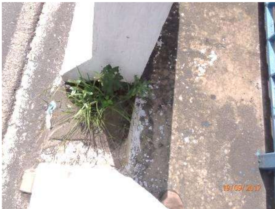
- Drenagem obstruída por vegetação.
