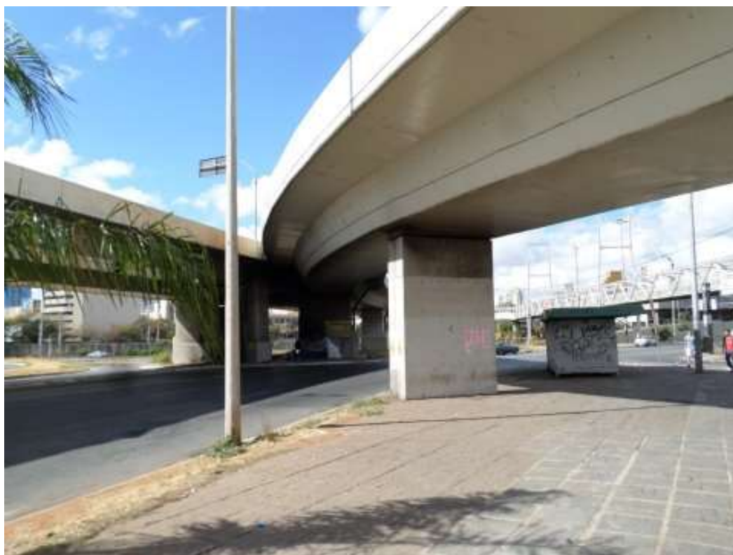
F52/FS – Vista de fulgens na parte inferior na divisão das alças.
