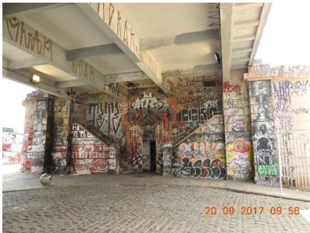
F31/ST – Entrada dos banheiros e escada de acesso para parte superior do viaduto. Pichação.
