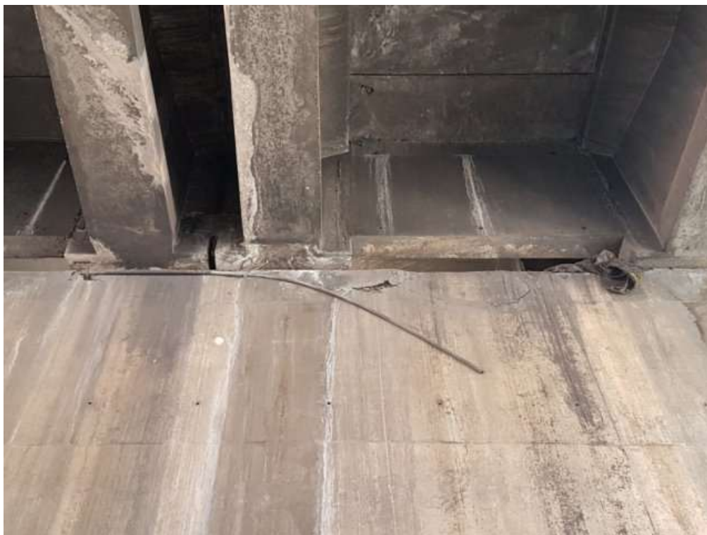
F11/FS – Detalhe de interseção entre vigas e pilar com existência de eflorescência e deslocamento.
