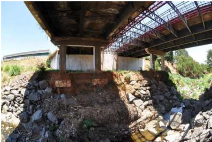
FOTO 35 – Vista da erosão de parte do aterro da fundação dos pilares da ponte podendo comprometer sua estabilidade na pista da Ponte T-63 sobre o córrego Cascavel visualizado da Avenida T-63 sentido Bairro / Centro.
