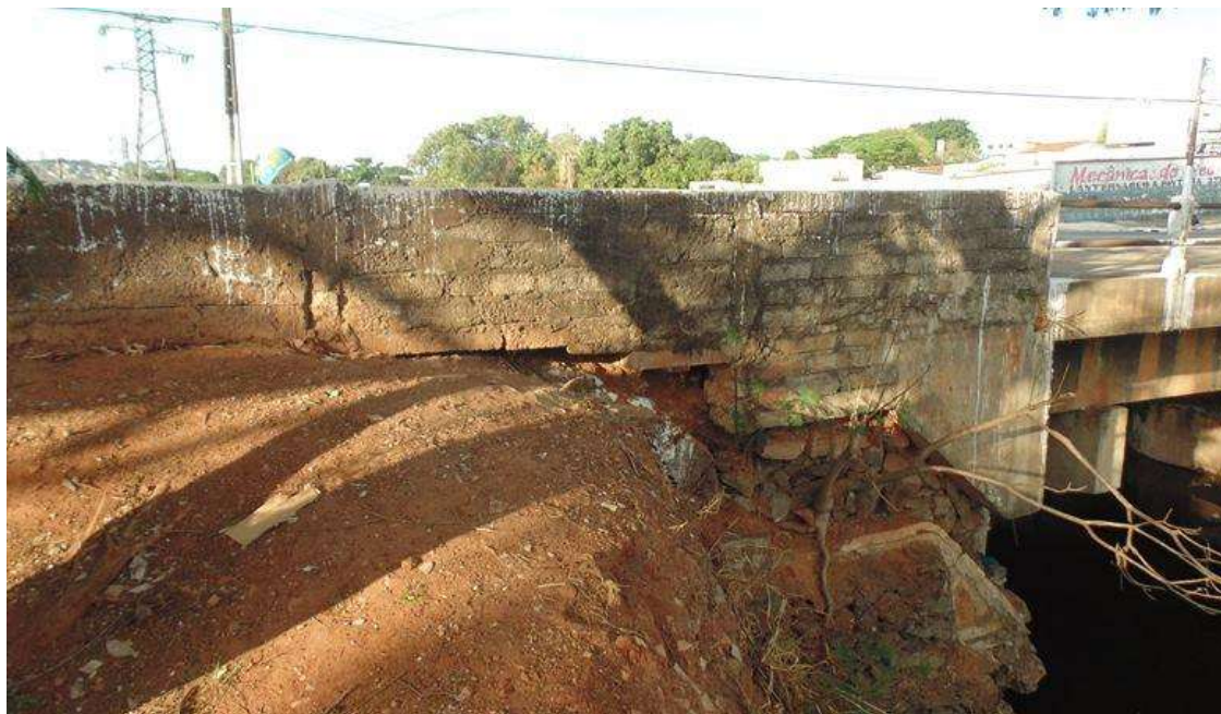
Foto 4 – Processo de erosão acentuada nos taludes, com possibilidade iminente de colapso da cabeceira oeste.
