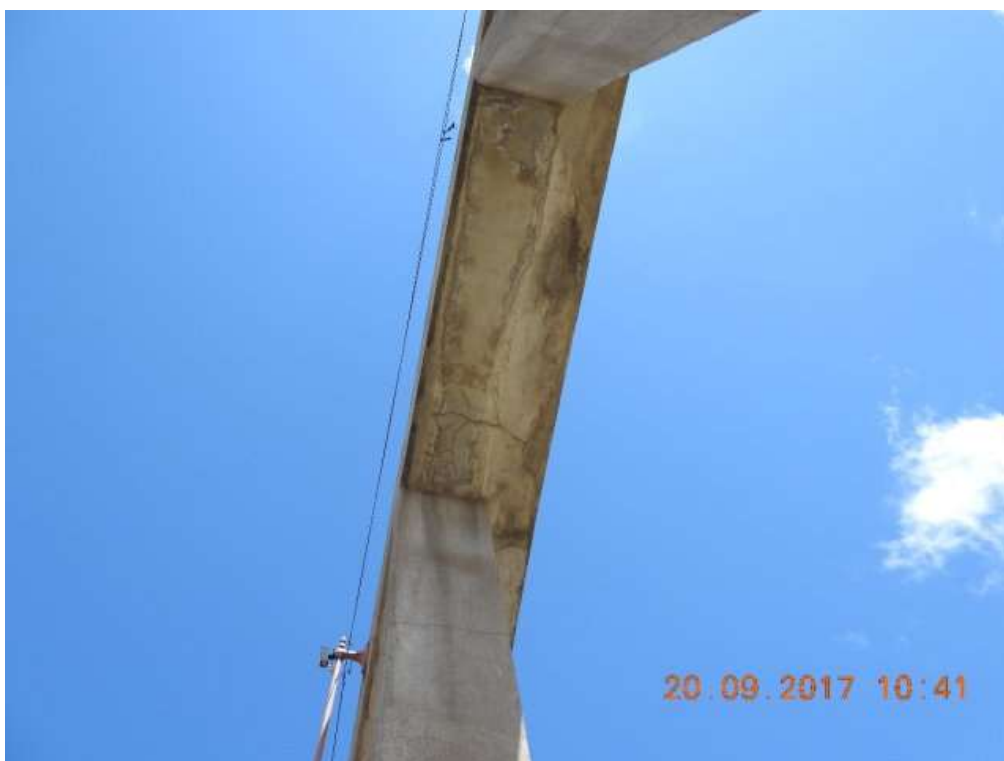
F54/ST – Trincas no revestimento na parte inferior do arco, vista do passeio com fluxo intenso de pedestres.
