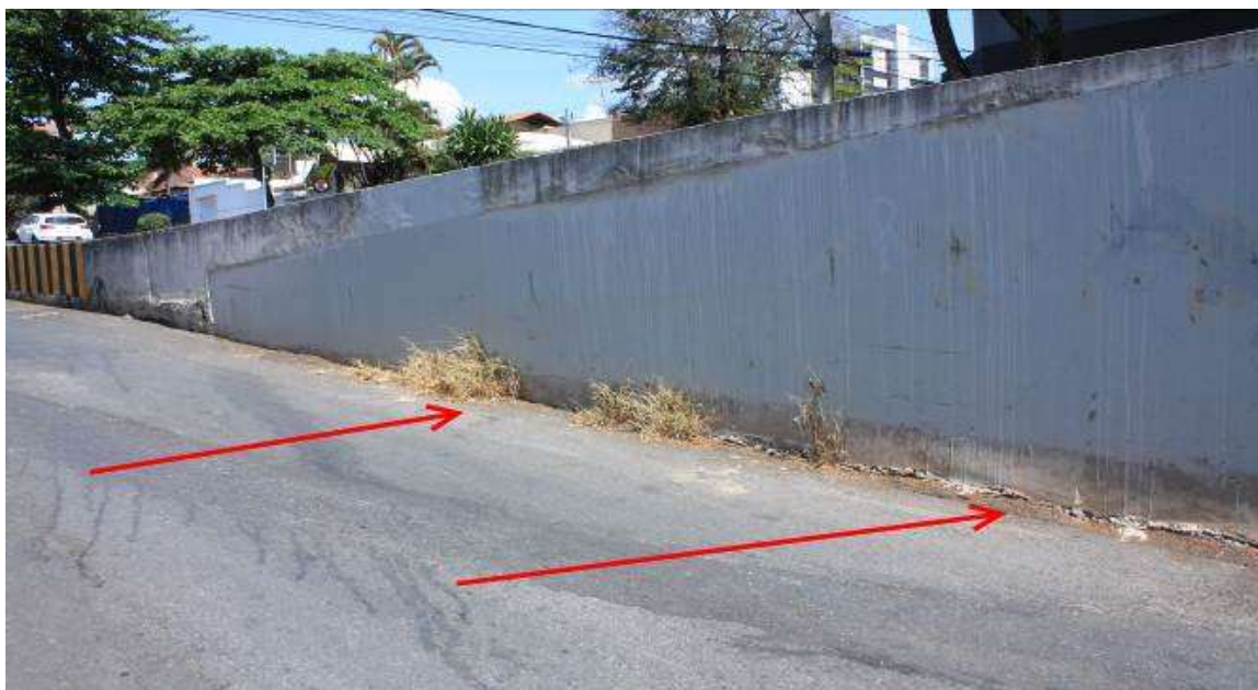
F85/FL – Pontos suscetíveis a infiltração de efluente e presença de gramíneas nos interstícios.
