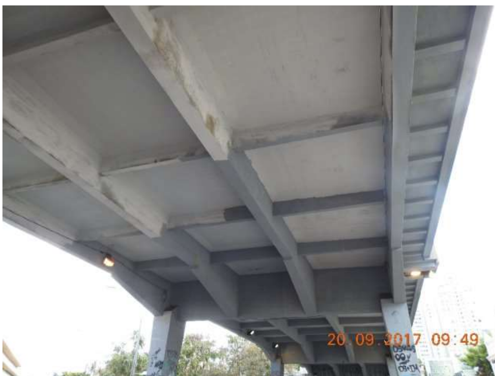
F22/ST – Vista de outra parte do tabuleiro que passou por revitalização nota-se presença de eflorescência, condutor de energia exposto e armadura oxidada.
