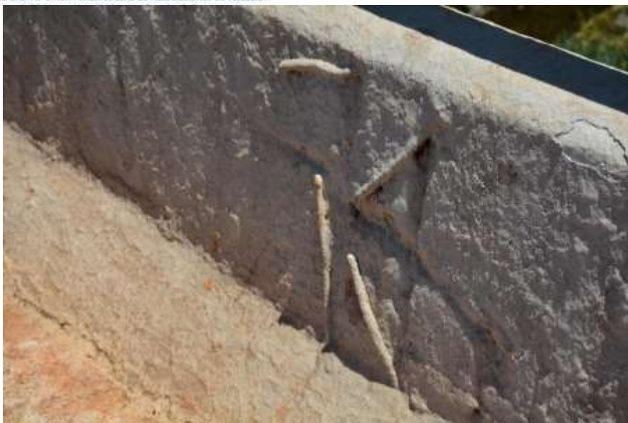
FOTO 9 – Vista de outro ângulo do guarda corpo com deslocamento do concreto na lateral da pista deixando a ferragem exposta da Ponte T-63 sobre o córrego Cascavel visualizado da Avenida T-63 sentido Centro / Bairro.
