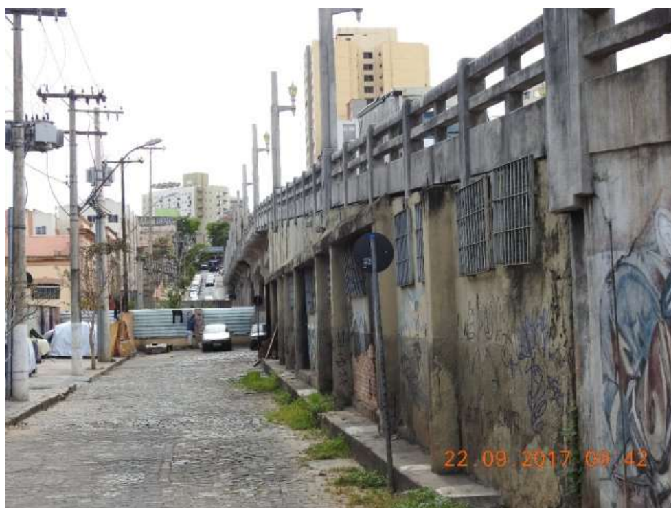
F68/FL – Vista da lateral, guarda corpo, junta, pichações.
