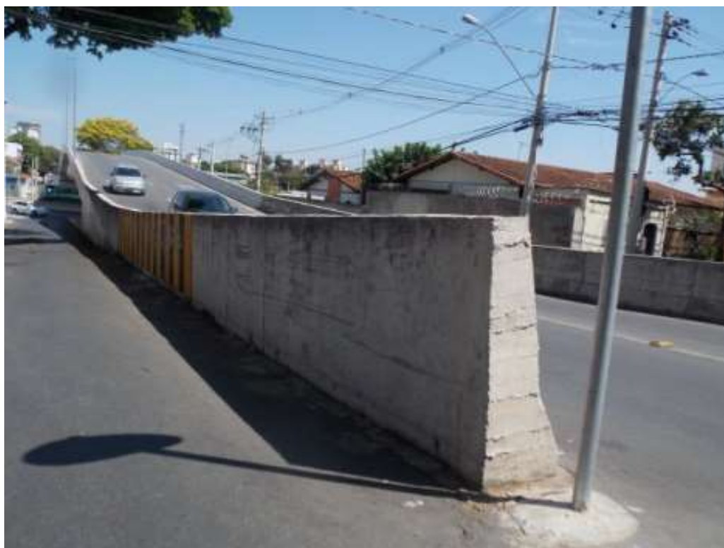
F62/FL – Viaduto Montese, detalhe de marcas de impacto de veículos.
