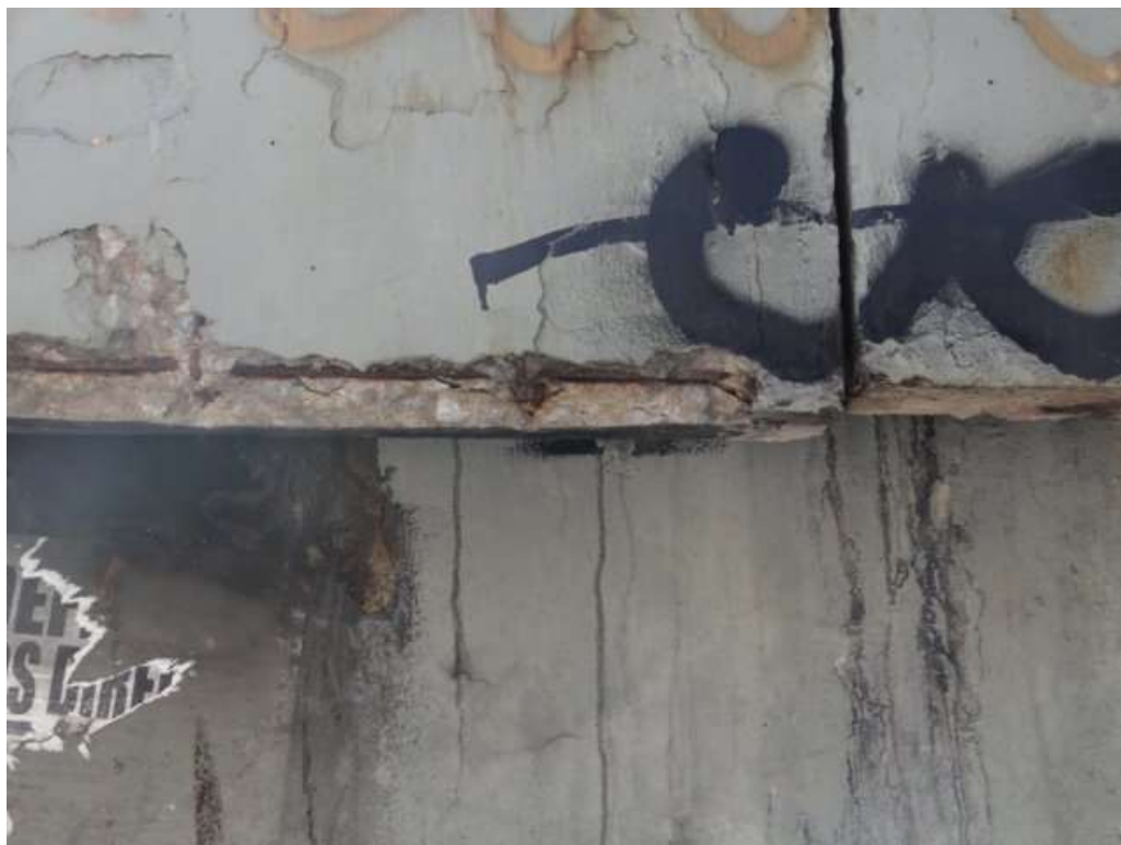
F33/FS – Detalhe de ausência de cobrimento, exposição e corrosão de parte da armadura.
