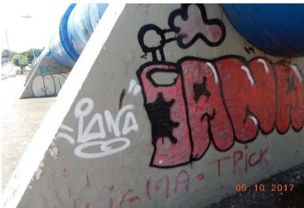
FOTO. 5 – Apoio da tubulação de água na Ilha central da Avenida Universitária, com pichação.
