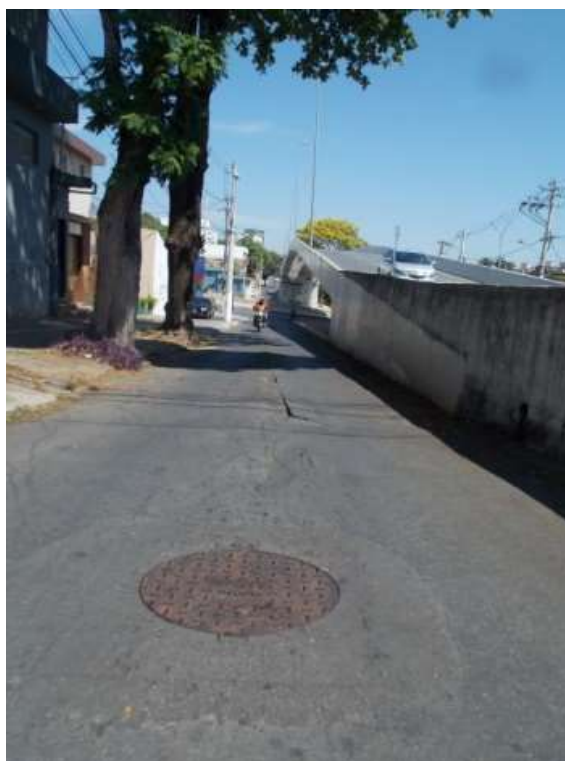
F65/FL – Viaduto Montese, recalque da vala da Rede Coletora de Esgotos (RCE).
