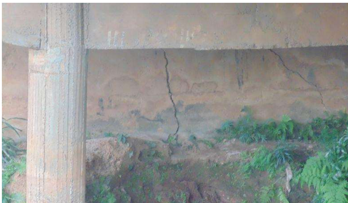
Foto 5 – O muro de arrimo da cabeceira leste apresenta fenda de largura média de 2cm.
