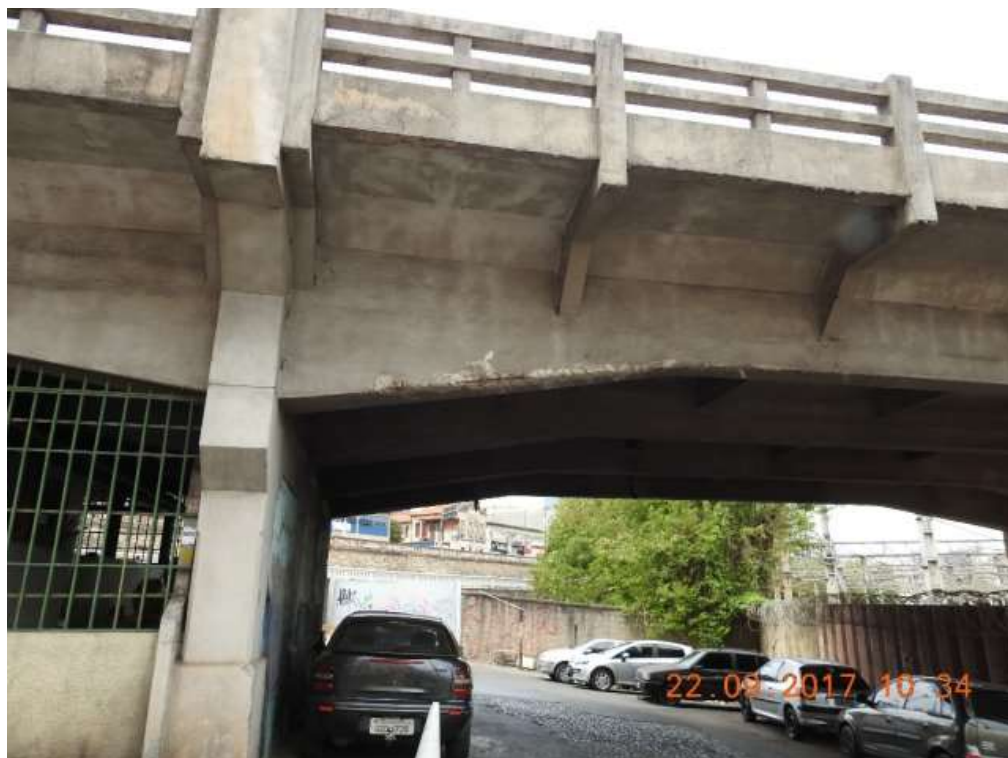
F13/FL – Neste ponto, observa-se impacto de veículos de grande porte na estrutura do viaduto.
