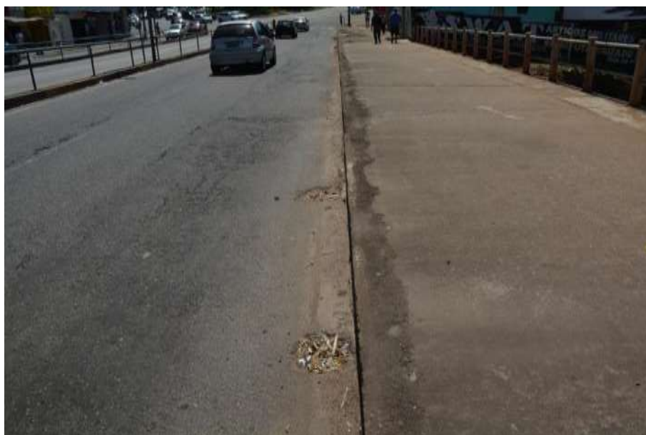
Figura 23 – Indicação de Anomalia:
