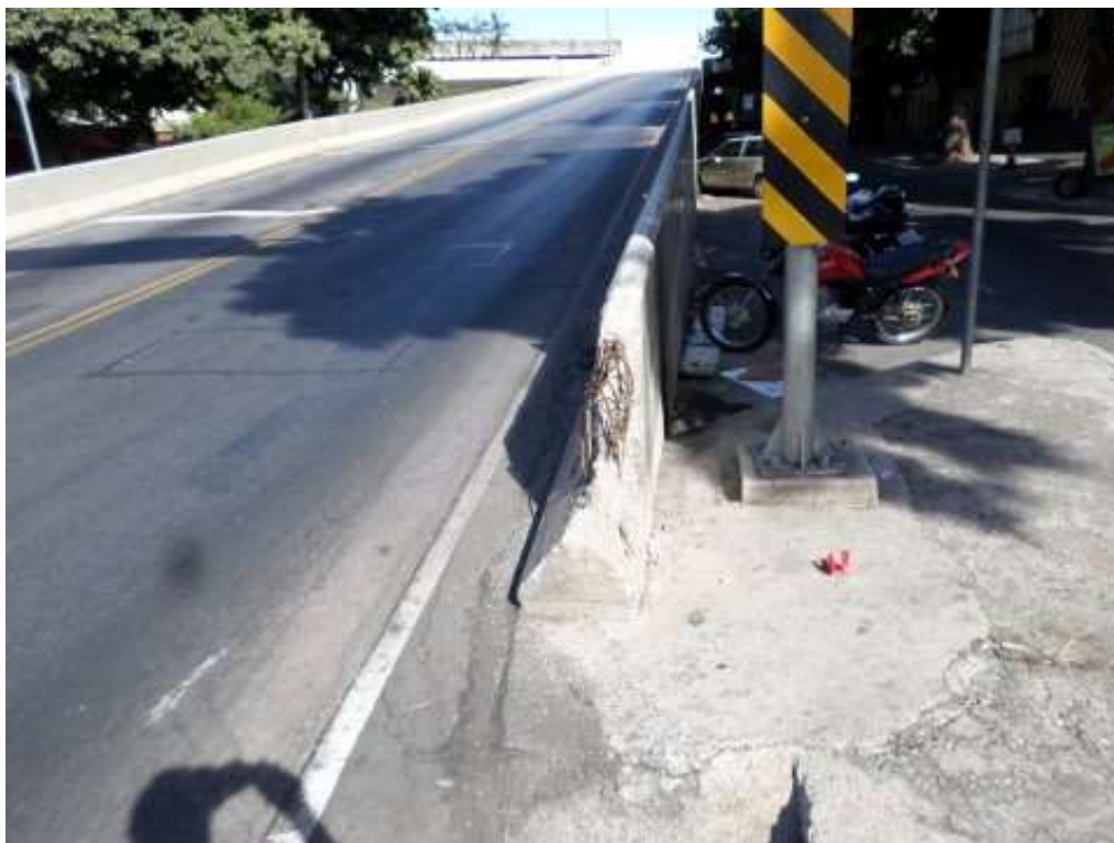
F17/FS – Vista da proteção lateral apresentando danos e ferragem aparente.
