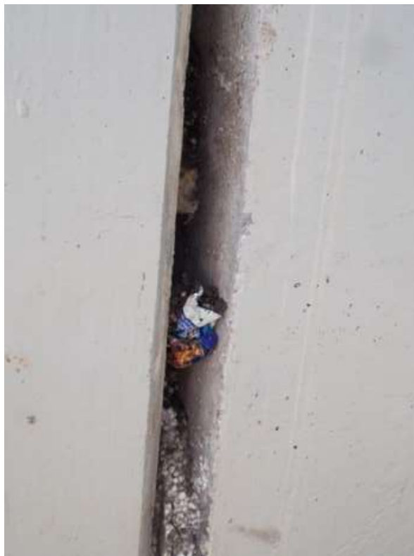
F68/FL – Viaduto Montese, detalhe da junta de dilatação do viaduto. Exposição às intempéries e danos provocados pela ação de terceiros.
