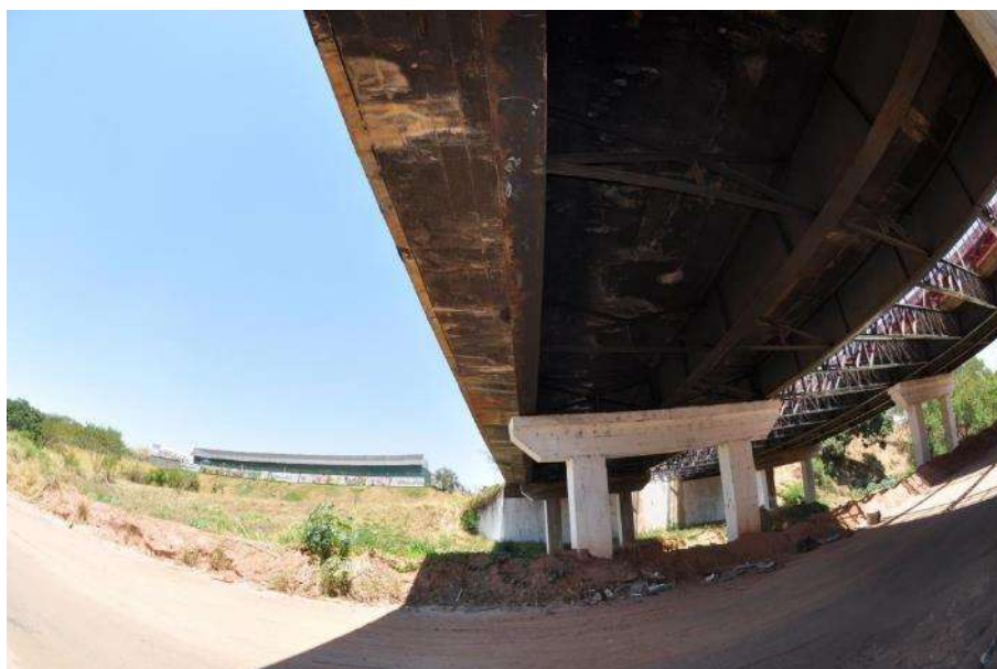
FOTO 30 – Vista de outro ângulo da presença de umidade na parte inferior da superestrutura (tabuleiro), já com comprometimento do recobrimento da armadura (aço) na pista da Ponte T-63 sobre o córrego Cascavel visualizado da Avenida T-63 sentido Bairro / Centro.
