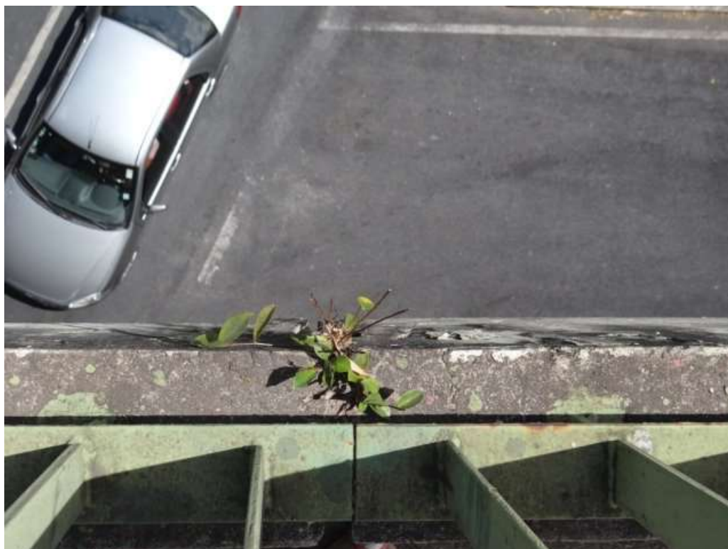
F54/FS – Detalhe da vegetação e deslocamento do cobrimento na lateral do viaduto com risco de atingir veículos e pedestres na via inferior.
