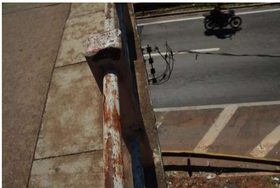
Figura 13 – Indicação de Anomalia:
