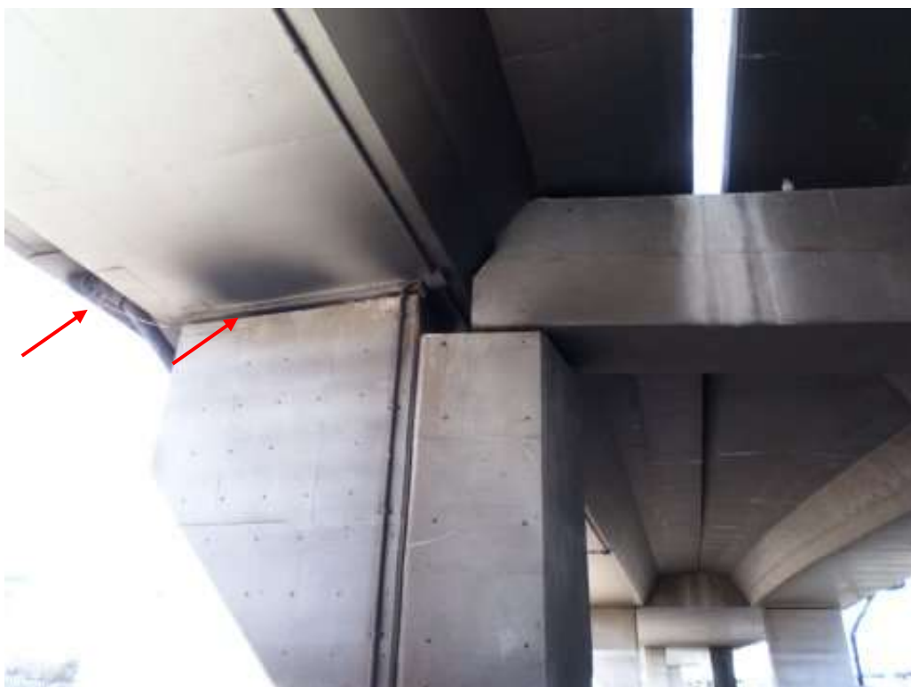
F58/FS – Vista de manchas de fuligens e cabos de energia exposto.
