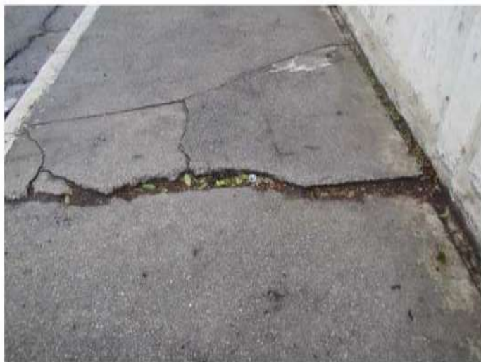
Detalhe de uma trinca da calçada
