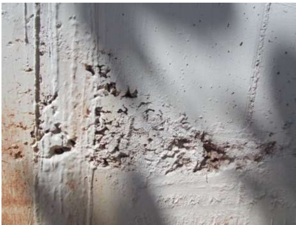
F25/FL –Viaduto Montese, deficiência na concretagem na estrutura de contenção.
