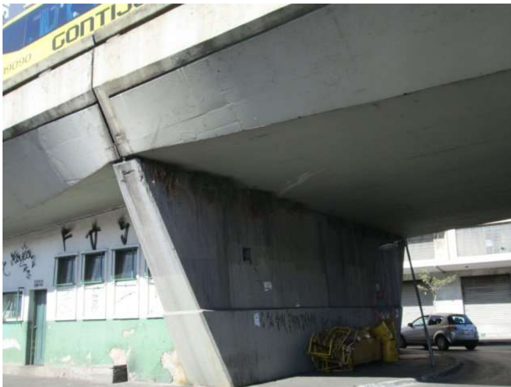
F33/HG – Vista de um dos pilares indicando a presença de umidade em torno de uma das juntas.
