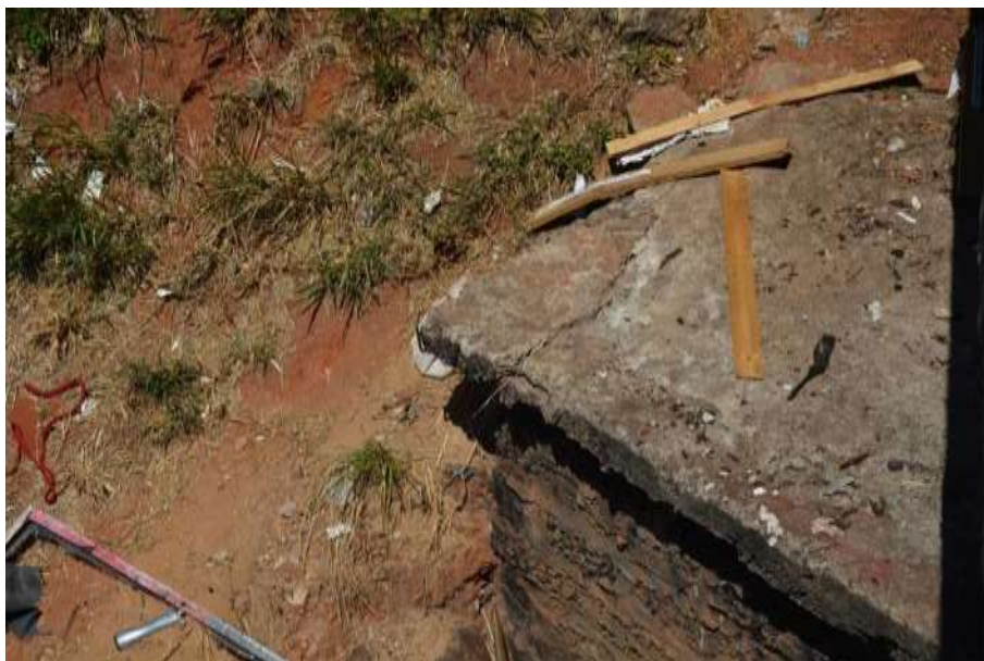
Figura 16 – Indicação de Anomalia:
