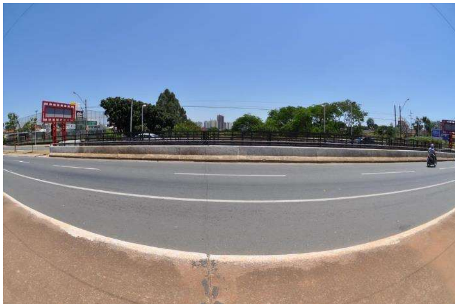
FOTO 5 – Vista da junta de trabalho na superestrutura (tabuleiro), as marcas de trabalho no pavimento asfáltico permitindo a passagem de água e ocasionando o excesso de umidade na parte inferior da superestrutura na Ponte T-63 sobre o córrego Cascavel visualizado da Avenida T-63 sentido Centro / Bairro.
