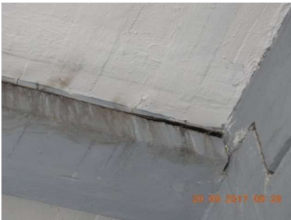
F07/ST – Detalhe da junta de dilatação, presença de umidade e eflorescência.
