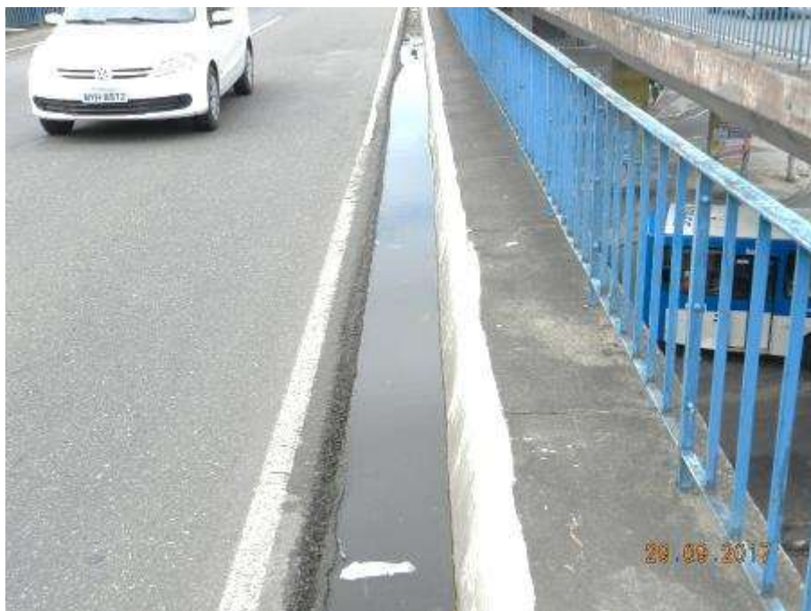
- Empoçamento de água em consequência do acúmulo de lixo na sarjeta.
