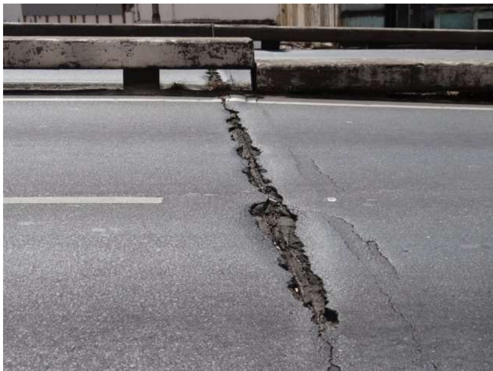
F47/HG – Detalhe do ponto onde existe junta de dilatação. Sistema de impermeabilização com vida útil ultrapassada, permitindo a passagem de água e ocasionando excesso de umidade. Ponto onde a pavimentação asfáltica necessita de reparos. Defesa parte central danificada.
