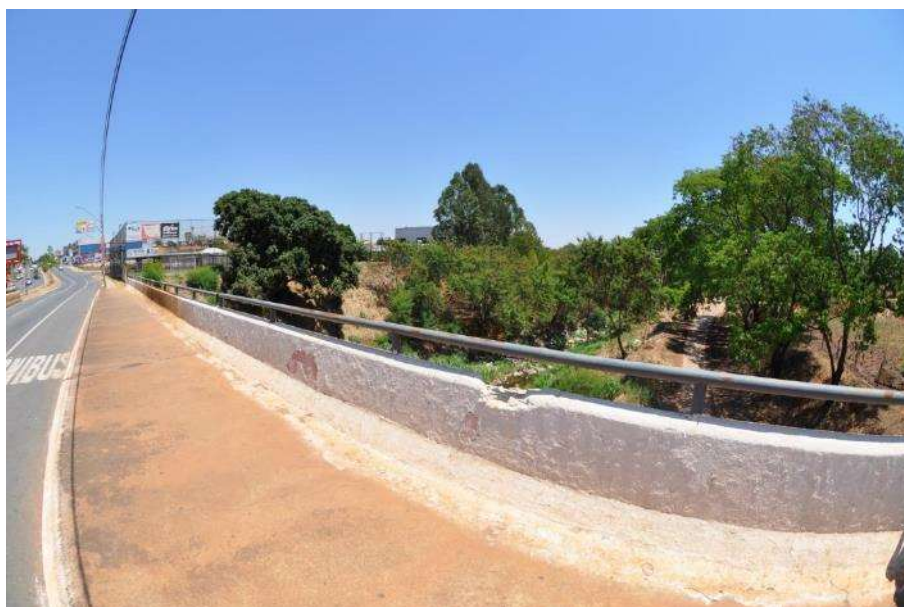
FOTO 6 – Vista do guarda corpo na lateral da pista com deslocamento do concreto deixando a ferragem exposta da Ponte T-63 sobre o córrego Cascavel visualizado da Avenida T-63 sentido Centro / Bairro.
