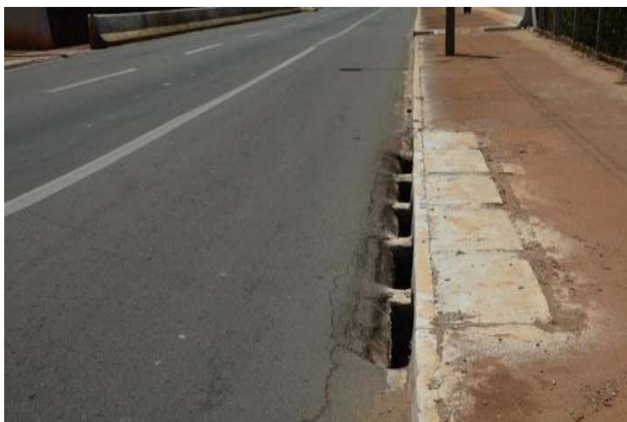
FOTO 48 –Vista aproximada do pavimento asfáltico rachado próximo a um dos pontos de drenagem pluvial lateral na pista de rolamento que antecede a pista da Ponte T-63 sobre o córrego Cascavel visualizado da Avenida T-63 sentido Bairro / Centro.
