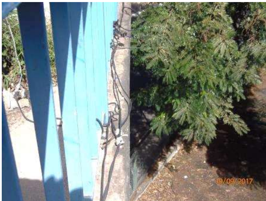
- Condutores de energia expostos e aparentes ao longo do passeio.
