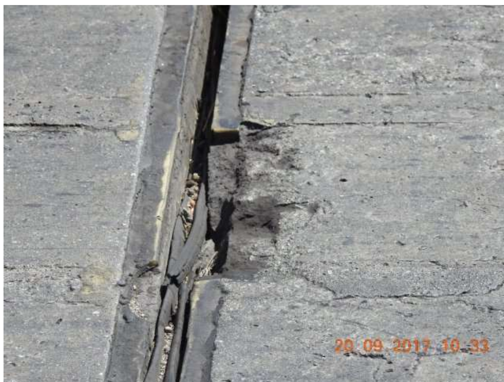
F52/ST – Detalhe do sistema de impermeabilização, elemento já comprometido e sem função. Junta danificada e danos no piso.
