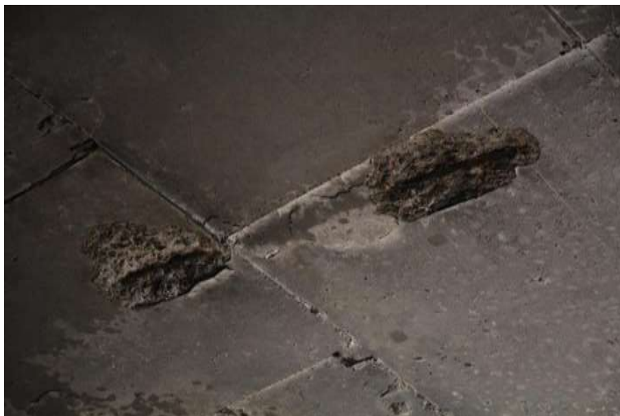
Figura 57 – Indicação de Anomalia:
