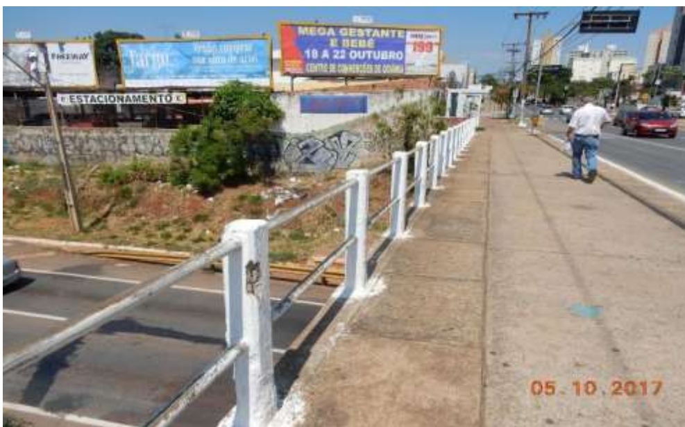
FOTO. 7 – Vista geral do passeio, com guarda corpo de concreto deslocando, ferragem exposta e oxidada, evento que se repete em outros pilares da Avenida Universitária.
