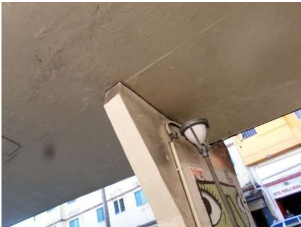
F07/FS – Vista da base inferior próximo do pilar com sinais de deslocamento de concreto.
