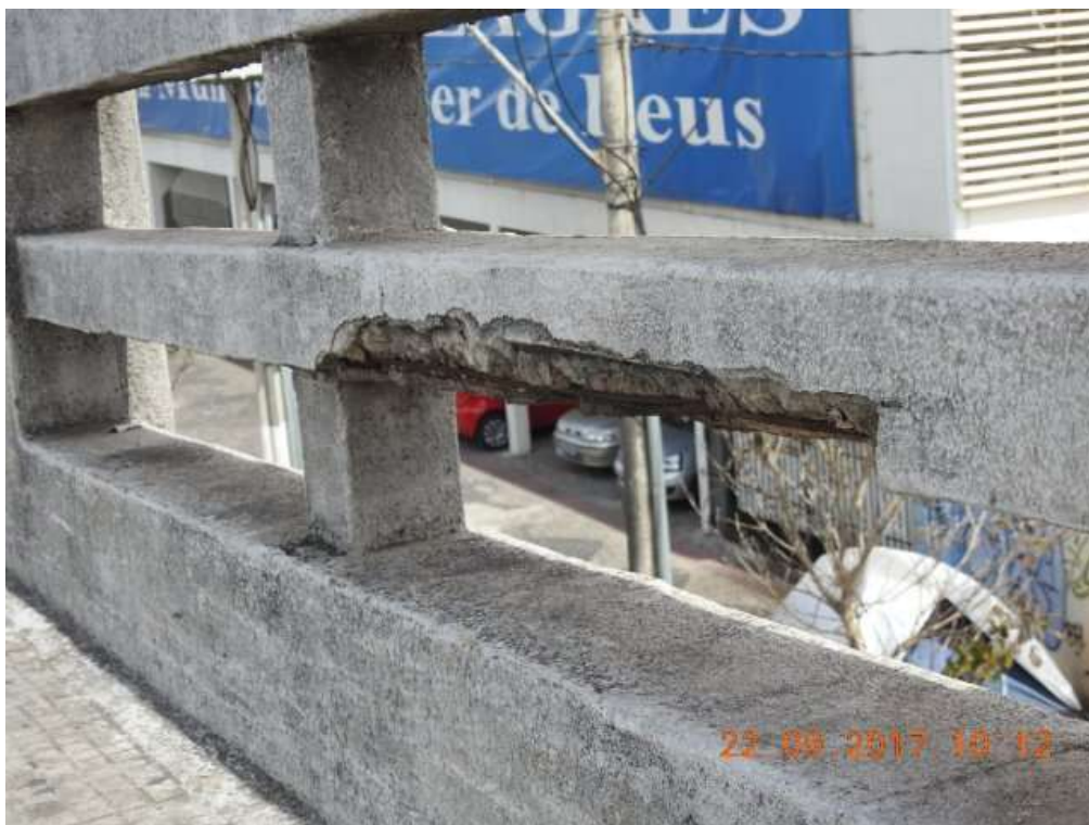
F37/FL – Outro ponto aonde ocorre desprendimento e perda do recobrimento, e oxidação da ferragem no guarda corpo, abaixo transito de veículos e pessoas.
