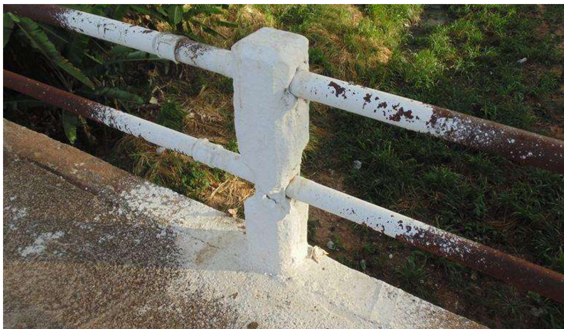
Foto 9 – Rompimento da ancoragem do guarda-corpo.
