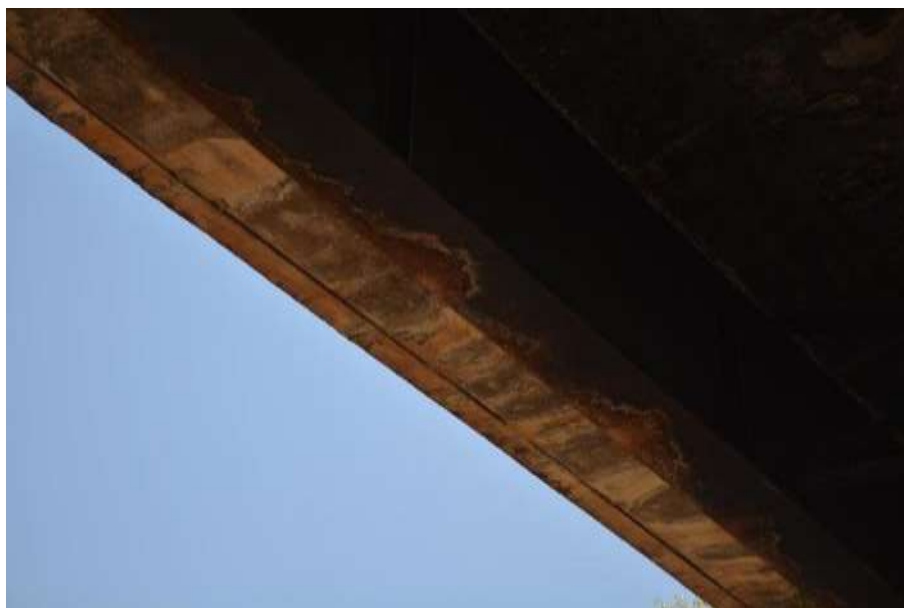
FOTO 22 – Vista de outro ponto de oxidação na parte inferior das vigas metálicas da superestrutura na pista da Ponte T-63 sobre o córrego Cascavel visualizado da Avenida T-63 sentido Bairro / Centro.
