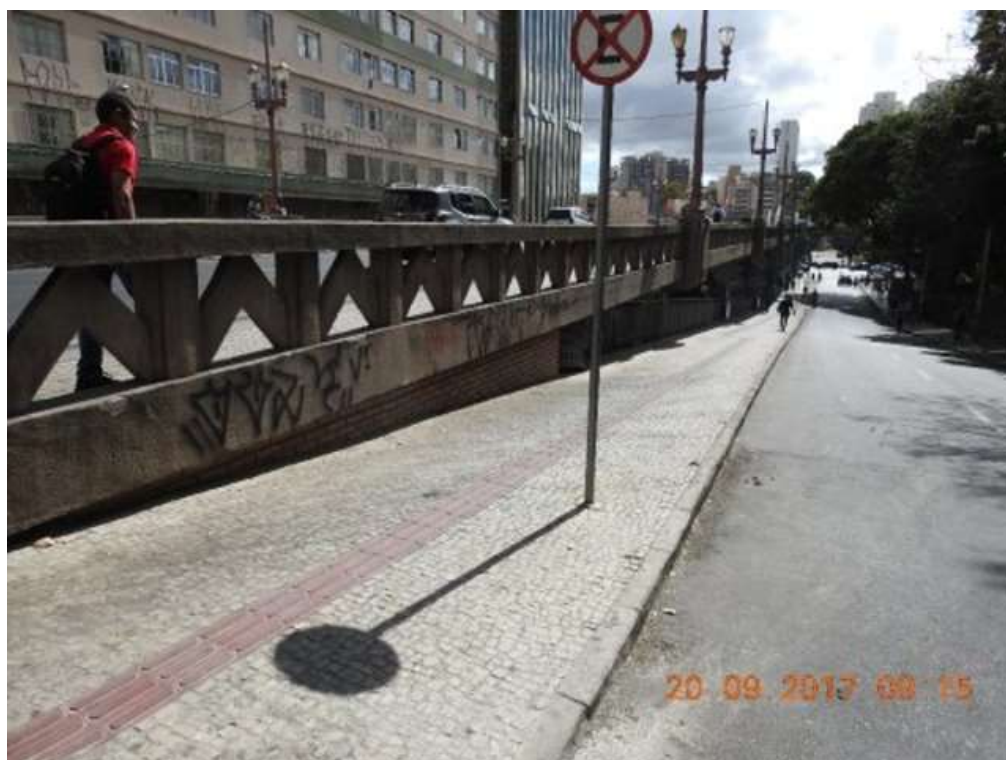
F03/ST – Vista da lateral do viaduto na Rua dos Tamoios, pichações e danos na estrutura de apoio do guarda corpo.
