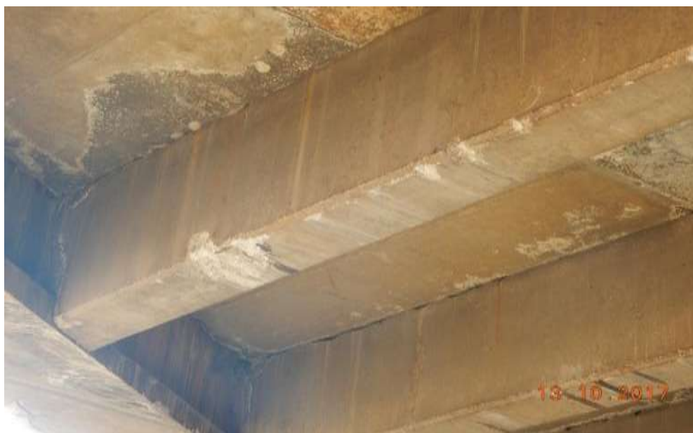
FOTO. 17 – Viga de concreto com quebrado (consequência da deficiência da sinalização vertical).
