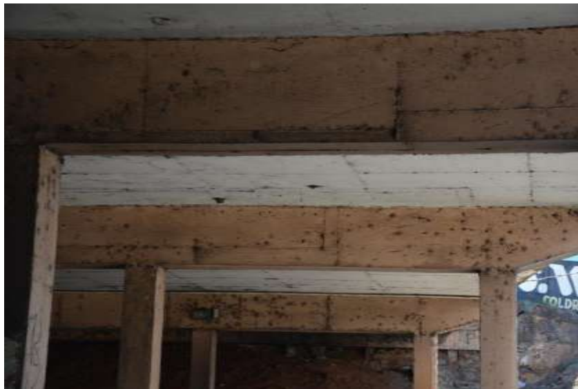
Figura 66 – Indicação de Anomalia:
