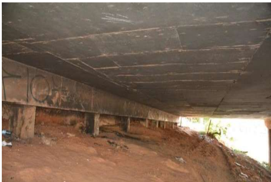
Figura 127 – Indicação de Anomalia:
