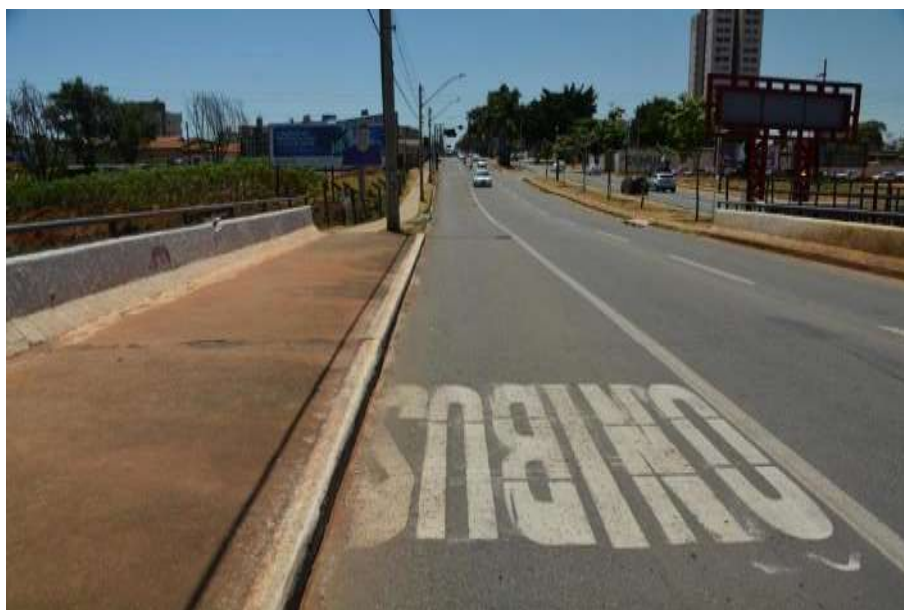
FOTO 18 – Vista da parte superior da superestrutura (tabuleiro) demonstrando que não foi verificado ponto de drenagem no mesmo.
