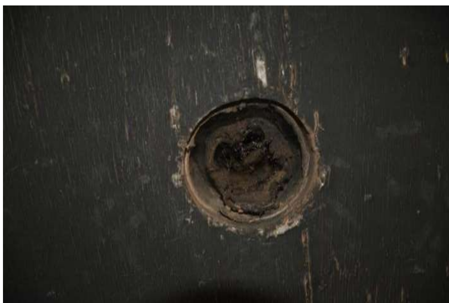
Figura 129 – Indicação de Anomalia:
