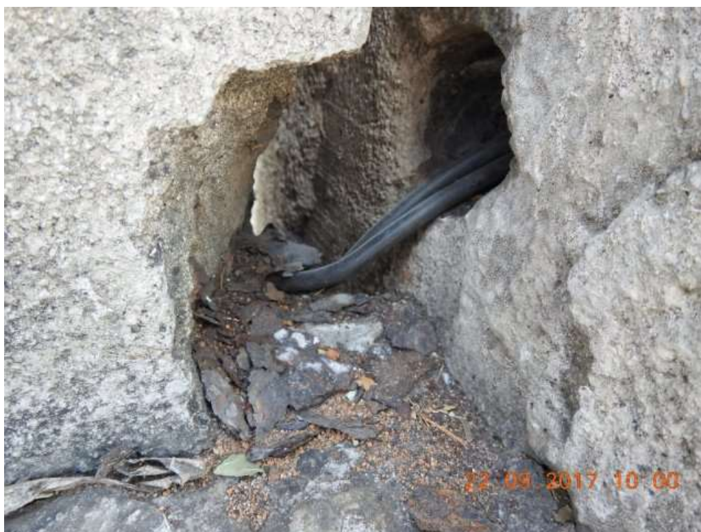
F44/FL – Detalhe do condutor de energia.
