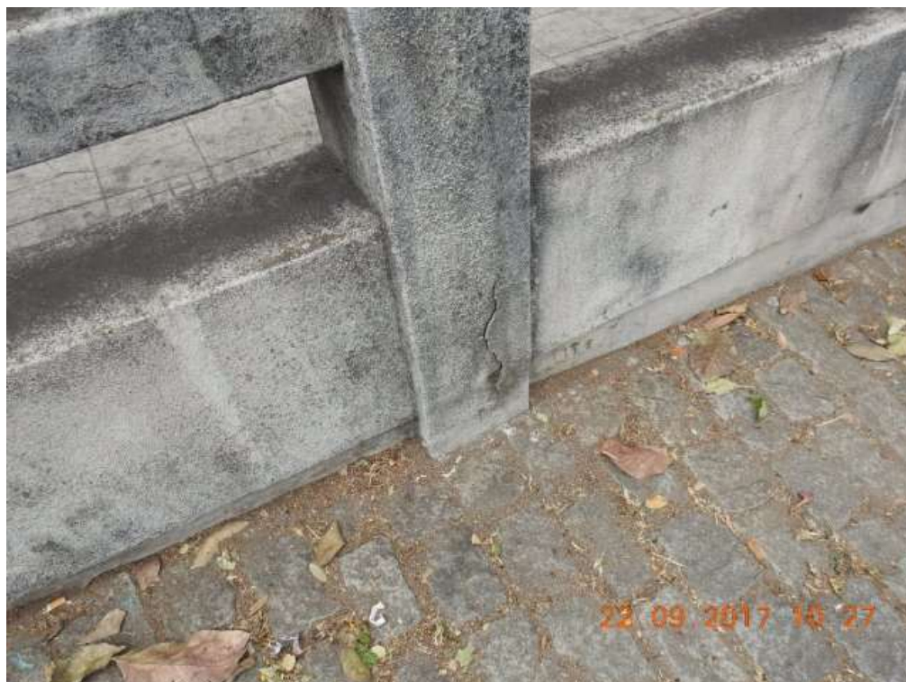
F05/FL – Trinca na base do pilar do guarda corpo.
