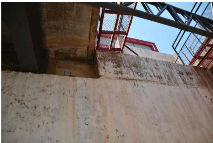
FOTO 56 –Vista da trinca na estrutura de contenção do aterro da cabeceira da ponte na Ponte T-63 sobre o córrego Cascavel visualizado da Avenida T-63 sentido Centro / Bairro.
