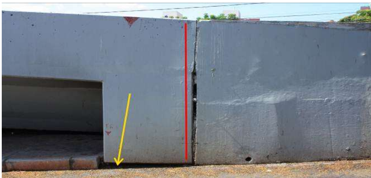
F67/FL – Viaduto Montese, junta de dilatação do viaduto, sujeita à ação de intempéries e de terceiros. Destaca-se também, ponto sob a base do apoio do tabuleiro, susceptível a infiltrações e acumulo de águas pluviais e/ou servidas, porventura lançadas na região.
