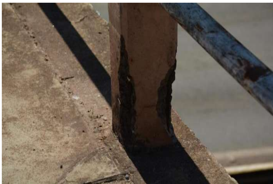
Figura 7 – Indicação de Anomalia:
