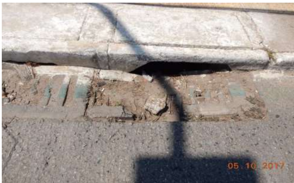
FOTO. 13 – Boca de lobo junto ao passeio obstruída e grelha quebrada na Avenida Universitária.
