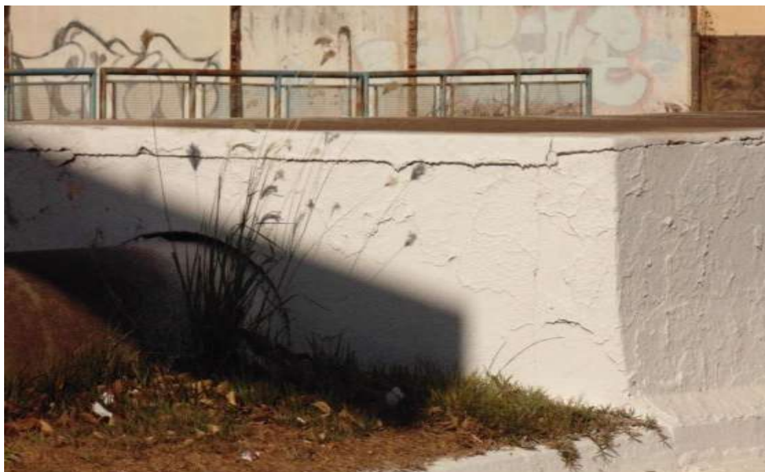
Foto 13 – Trinca no guarda-corpo da ponte.
