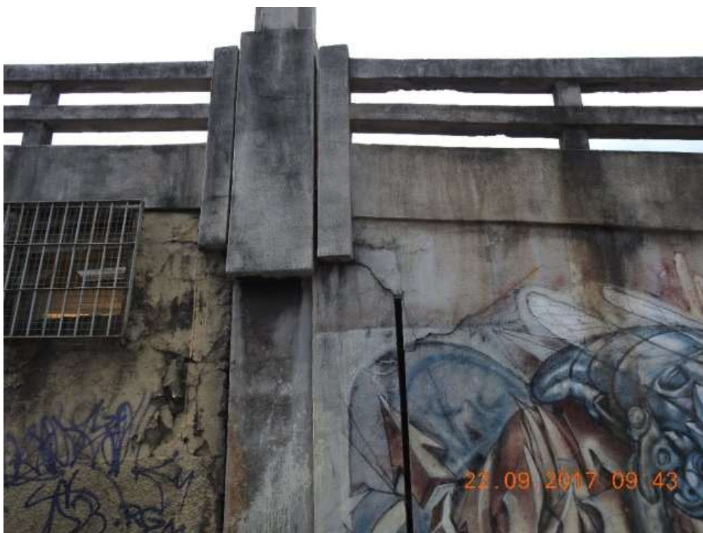
F72/FL – Detalhe da foto anterior, infiltrações e trincas.
