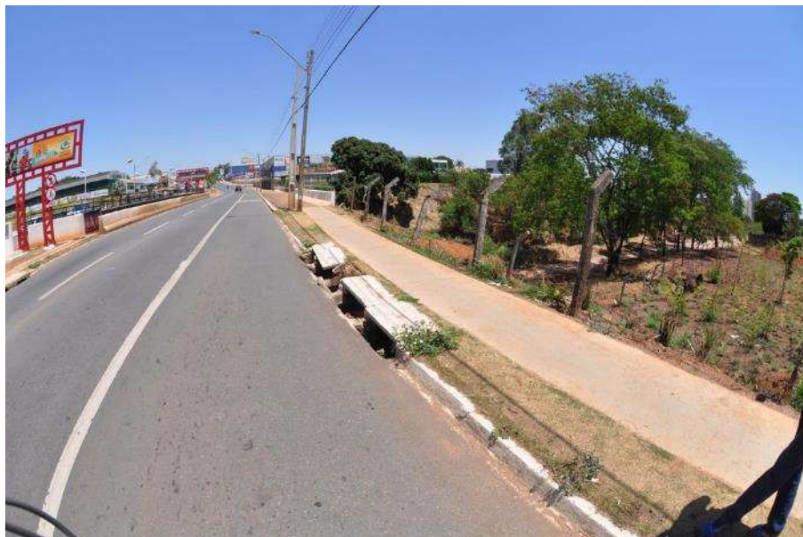
FOTO 45 – Vista da tampa quebrada de um dos pontos de drenagem pluvial lateral na pista de rolamento que antecede a pista da Ponte T-63 sobre o córrego Cascavel visualizado da Avenida T-63 sentido Centro / Bairro.
