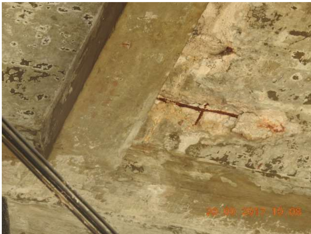
F37/ST – Falta de cobrimento na armadura, encontra-se em processo de oxidação.
