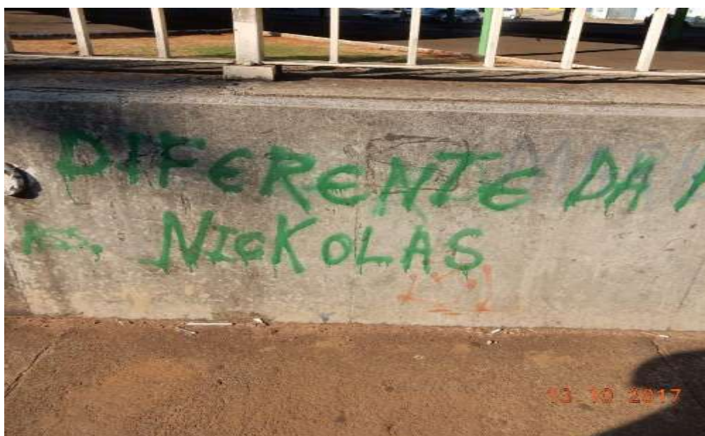
FOTO. 11 – Pichação no guarda-corpo no passeio da Avenida Fuad José Sebba.
