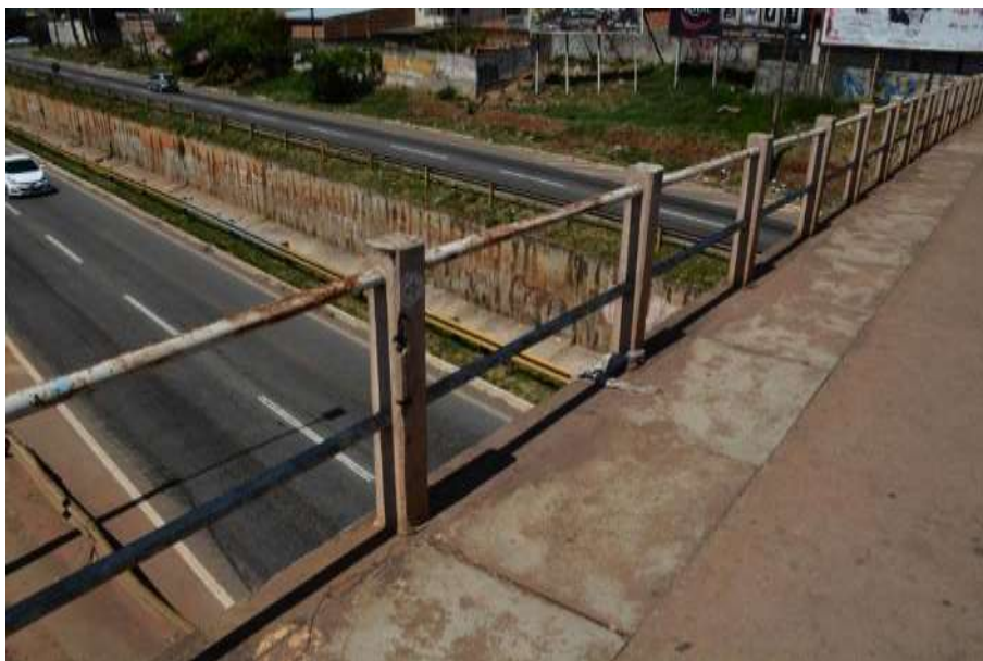
Figura 28 – Indicação de Anomalia:
