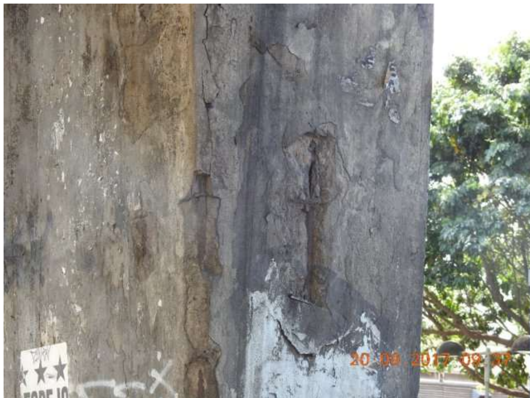
F17/ST – Detalhe da ferragem exposta em processo de oxidação e falta de cobertura.
