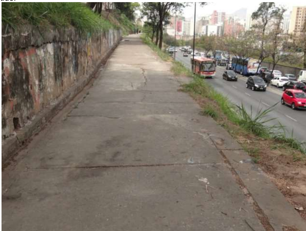
F12/HG – Vista do passeio que apresenta-se em desnível em relação ao logradouro, mas que não possui guarda corpo. Piso necessitando de reparos.
