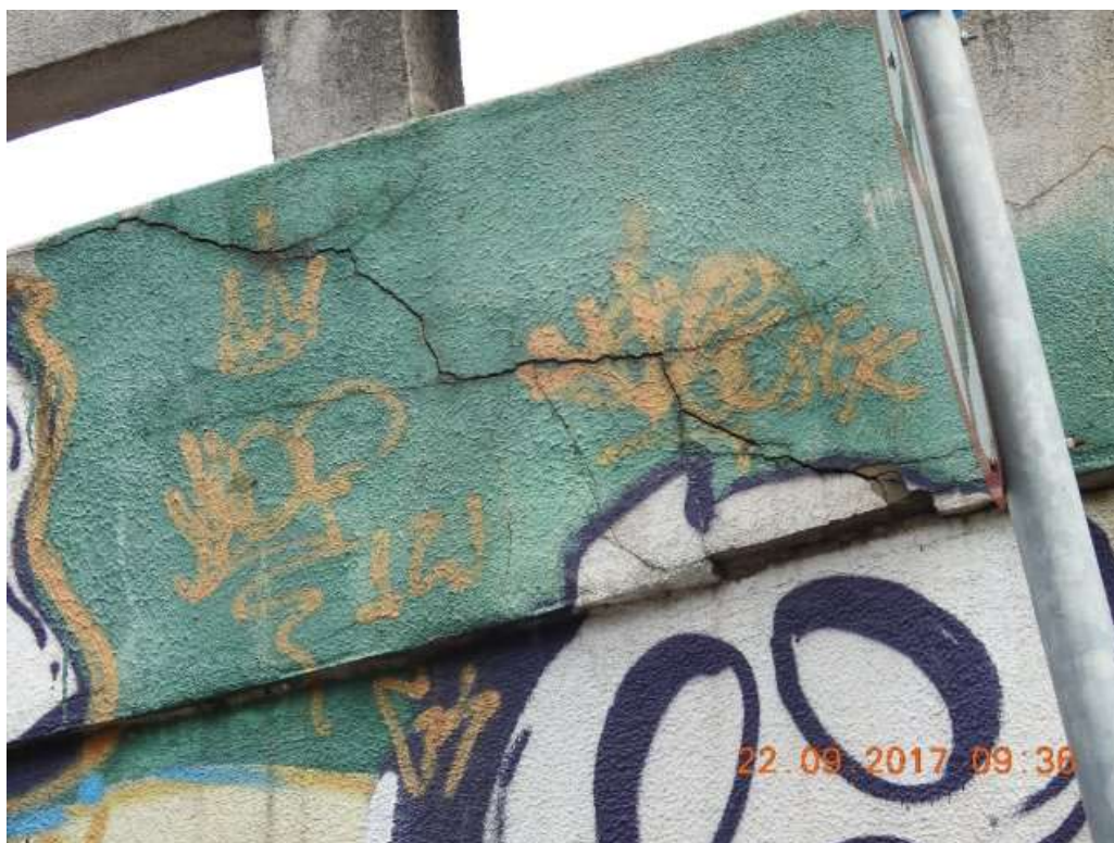
F63/FL – Outro detalhe da trinca.
