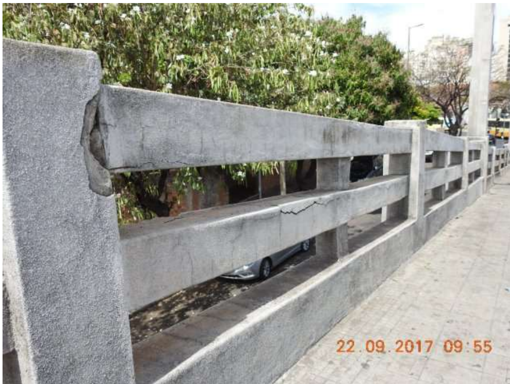
F49/FL – Outra vista geral do guarda corpo, trincas, deslocamento e perda de parte do recobrimento do pilar do guarda corpo.
