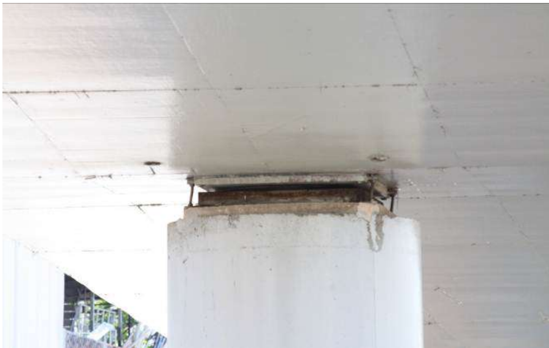
F34/FL – Detalhe de aparelho de apoio, com evidências de deformações em parafusos.
