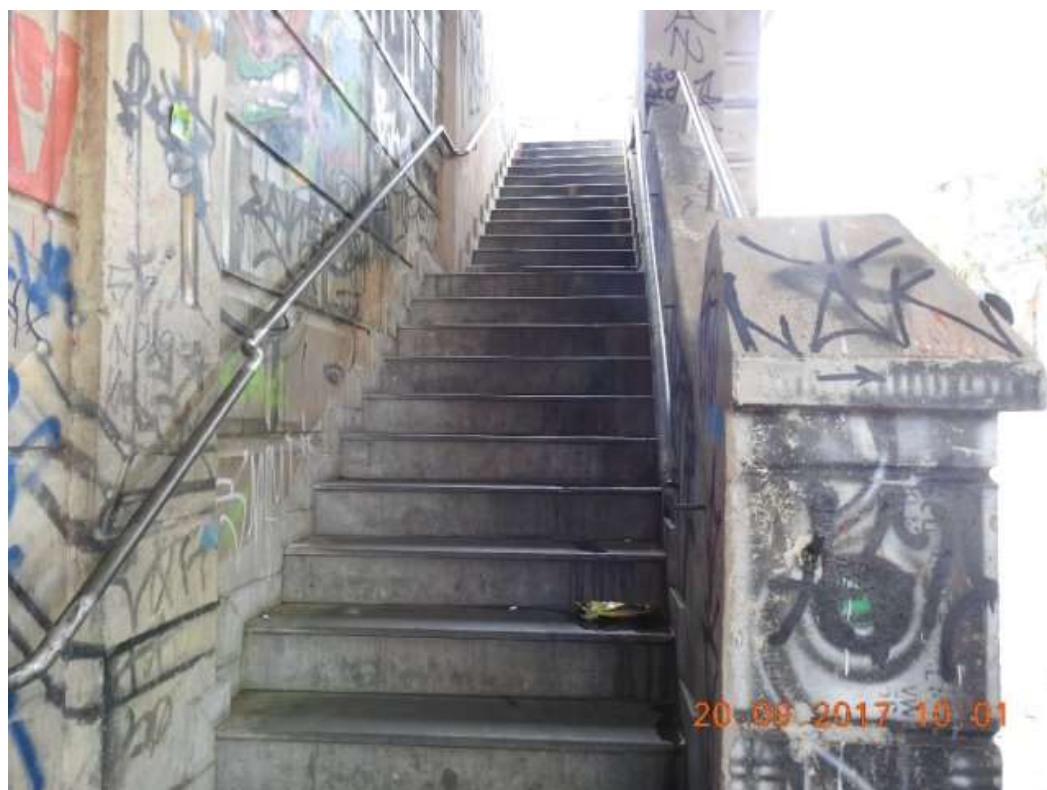
F32/ST – Escada de acesso a parte superior do viaduto. Pichação. Fezes e lixo.
