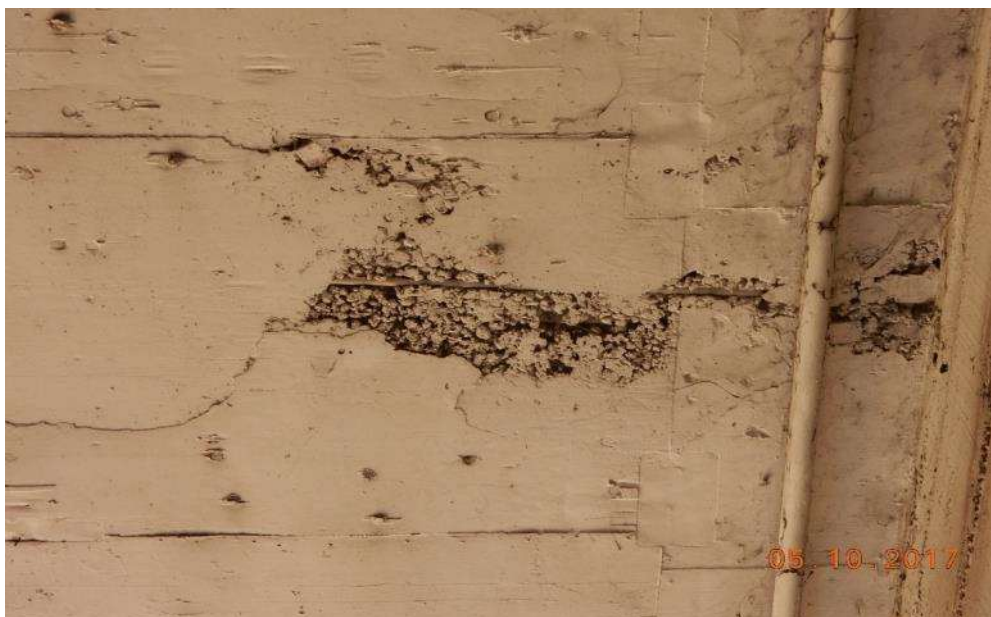
FOTO. 20 – Laje, vista inferior pela Marginal Botafogo, ferragem exposta e oxidada e falha de vibração do concreto.
