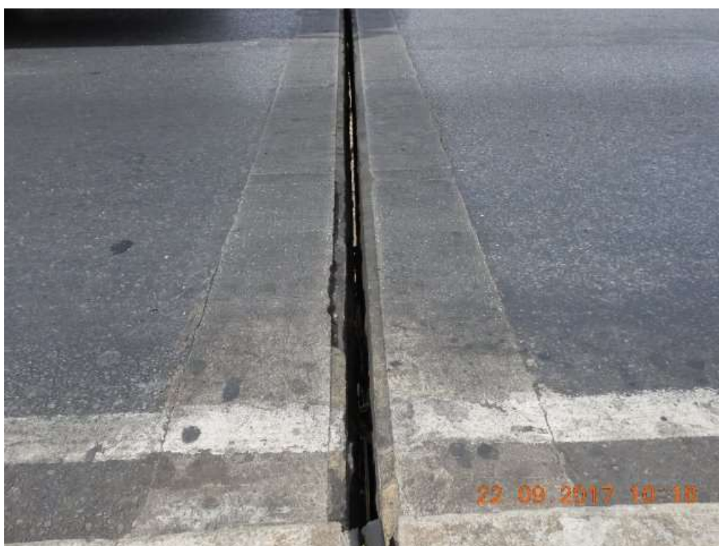
F30/FL – Detalhe para junta localizada na parte central do viaduto, perda total do elemento do sistema de impermeabilização.
