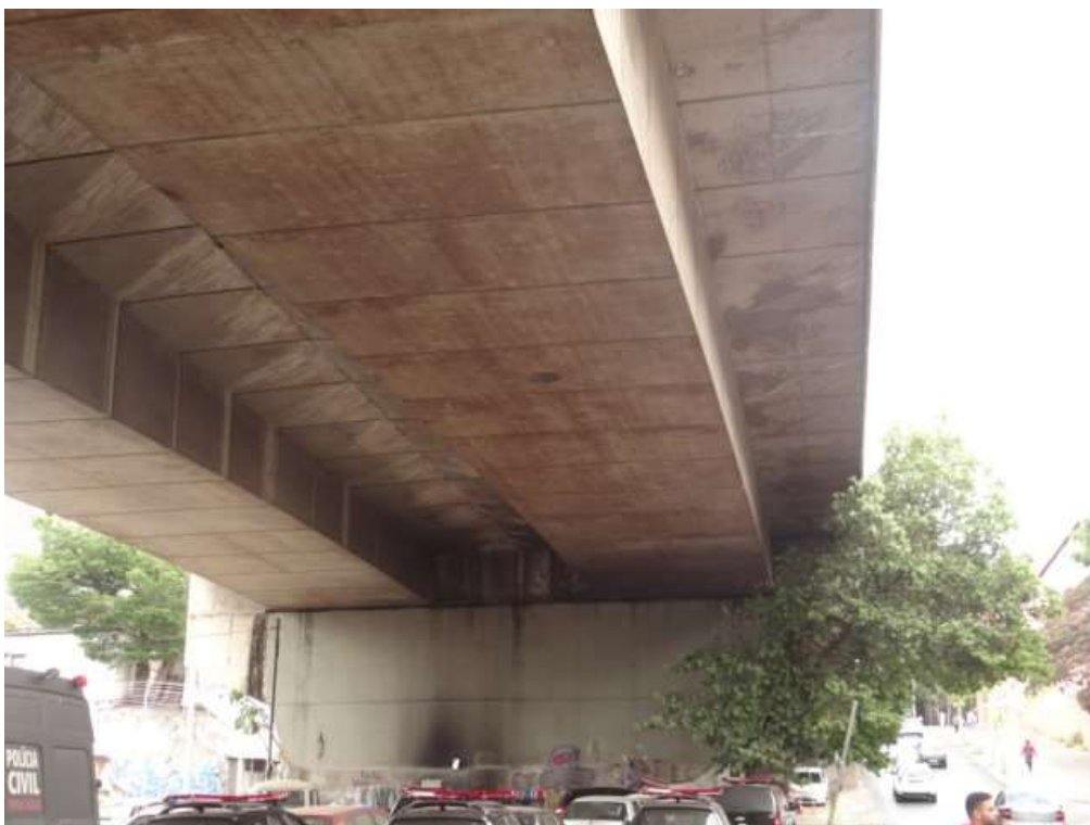
F12/FS – Vista geral de um dos vãos com pilar ao fundo e eflorescências na laje.
