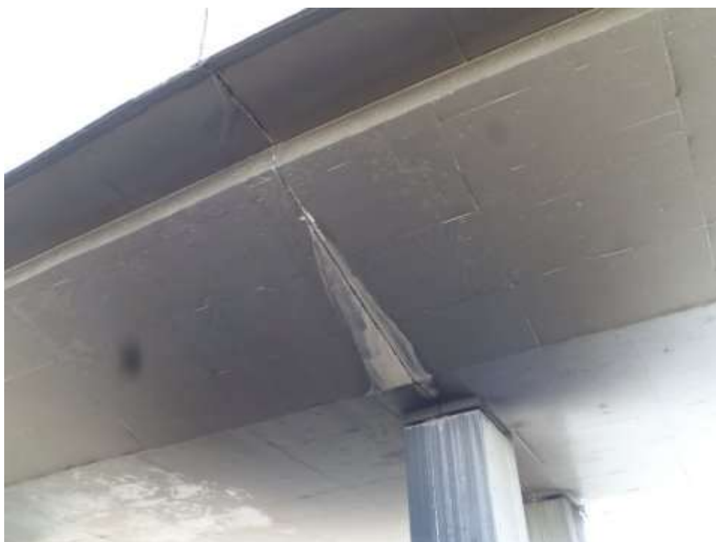
F60/FS – Vista de manchas de infiltrações.
