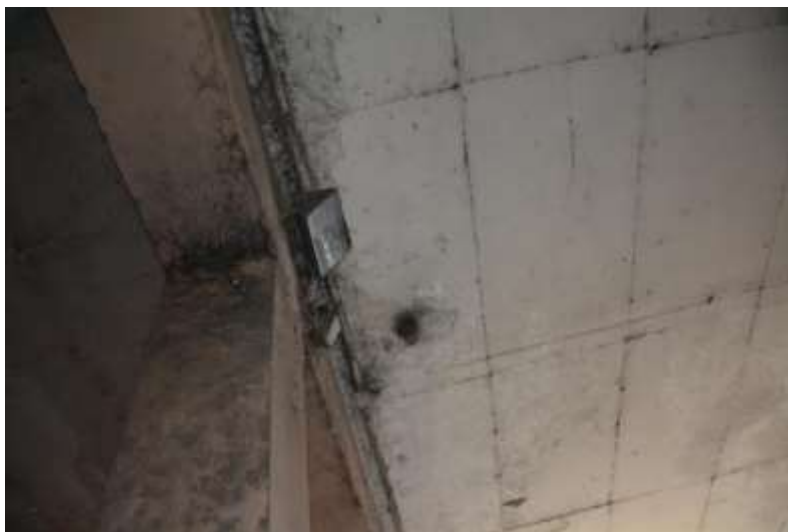
Figura 64 – Indicação de Anomalia:
