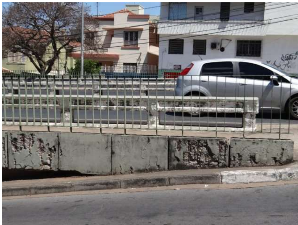
F20/FS – Detalhe da ausência de cobertura da armadura, fato que ocorre em diversos pontos da lateral do viaduto.
