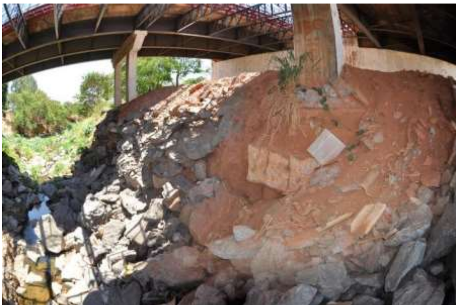
FOTO 38 –Vista de outro ponto da erosão de parte do aterro da fundação dos pilares da ponte podendo comprometer sua estabilidade na pista da Ponte T-63 sobre o córrego Cascavel visualizado da Avenida T-63 sentido Bairro / Centro.
