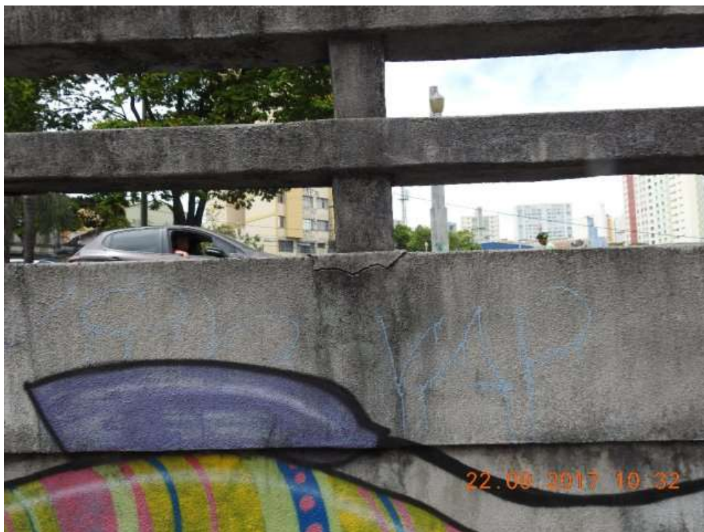
F09/FL – Trinca na base de outro pilar do guarda corpo.
