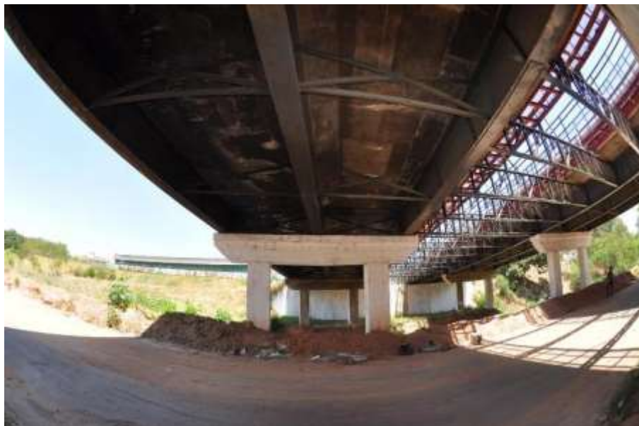
FOTO 29 – Vista da presença de umidade na parte inferior da superestrutura (tabuleiro), já com comprometimento do recobrimento da armadura (aço) na pista da Ponte T-63 sobre o córrego Cascavel visualizado da Avenida T-63 sentido Bairro / Centro.
