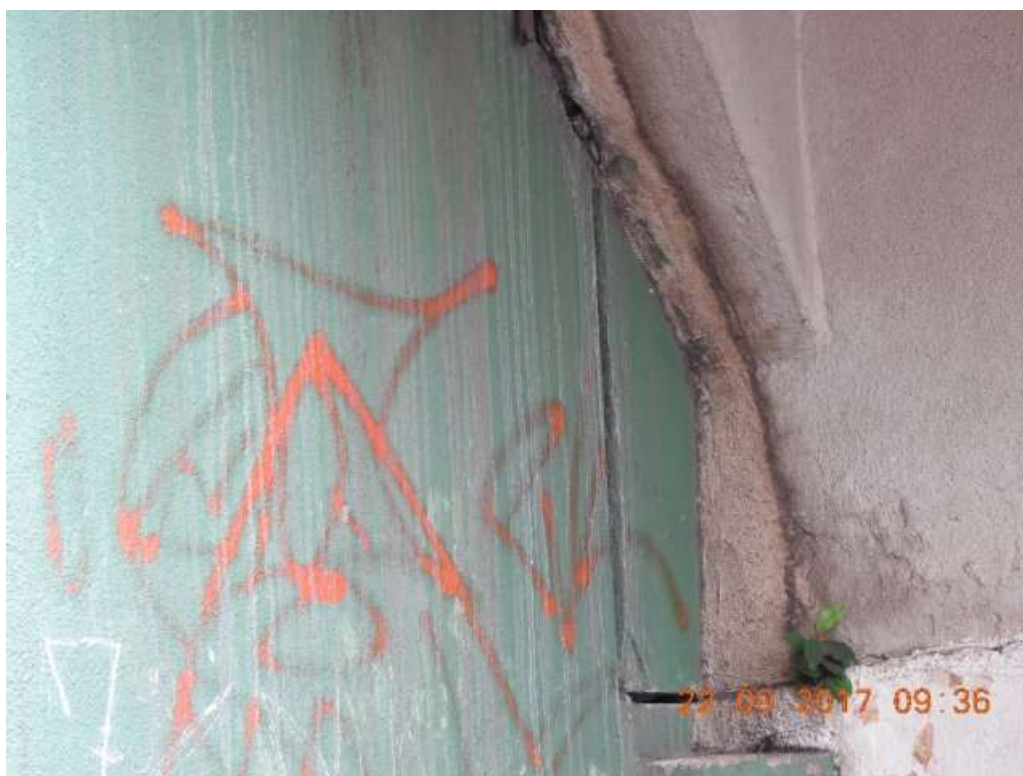
F60/FL – Detalhe da foto anterior, infiltrações na junta e presença de vegetação.
