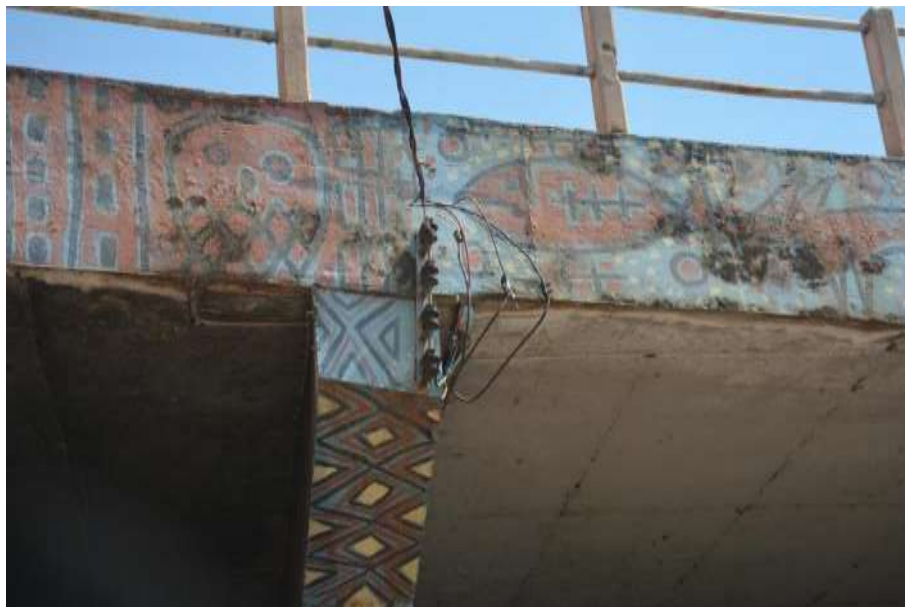
Figura 120 – Indicação de Anomalia:
