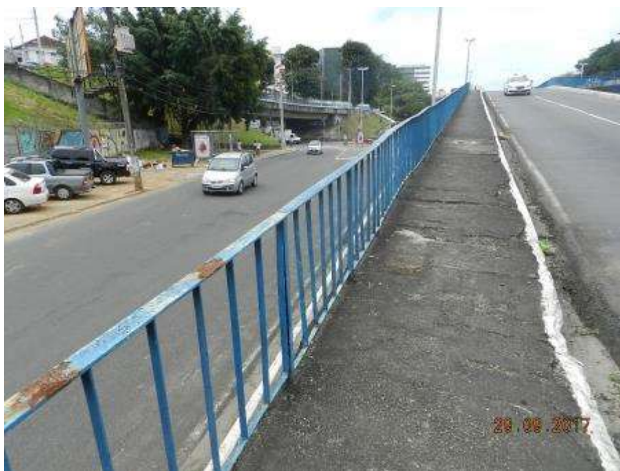
- Corrosão no guarda corpo.
