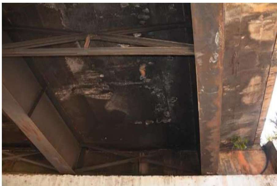
FOTO 42 – Vista de outro ponto da presença de umidade na parte inferior da superestrutura (tabuleiro), já com comprometimento do recobrimento da armadura (aço).
