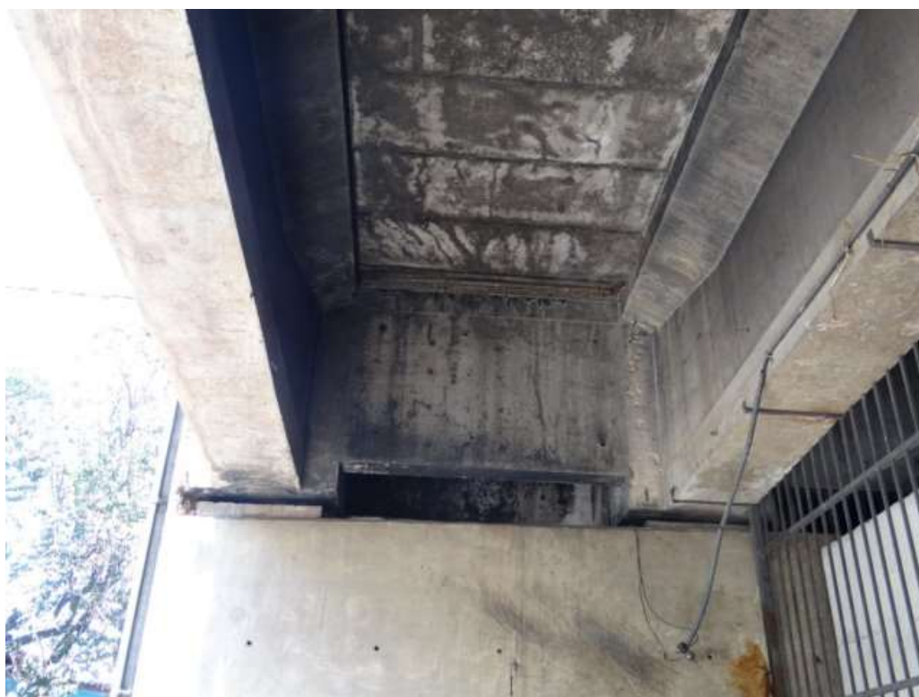
F26/FS – Detalhe da presença de umidade.
