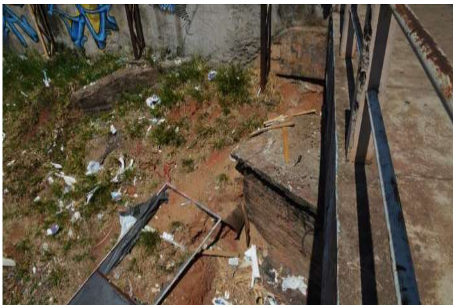
Figura 15 – Indicação de Anomalia:
