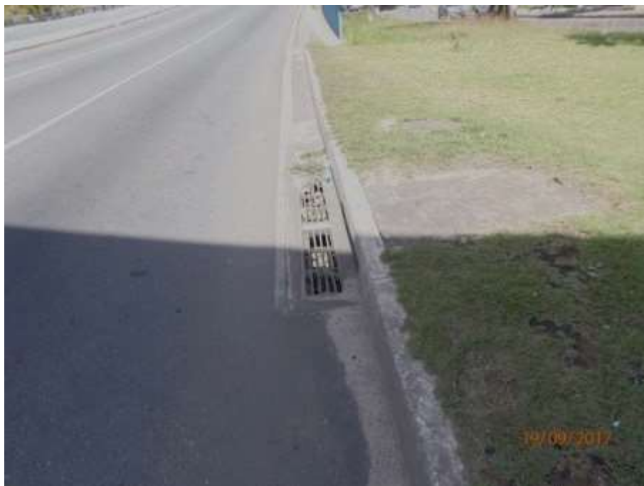
- Bocas de lobo desobstruídas.
