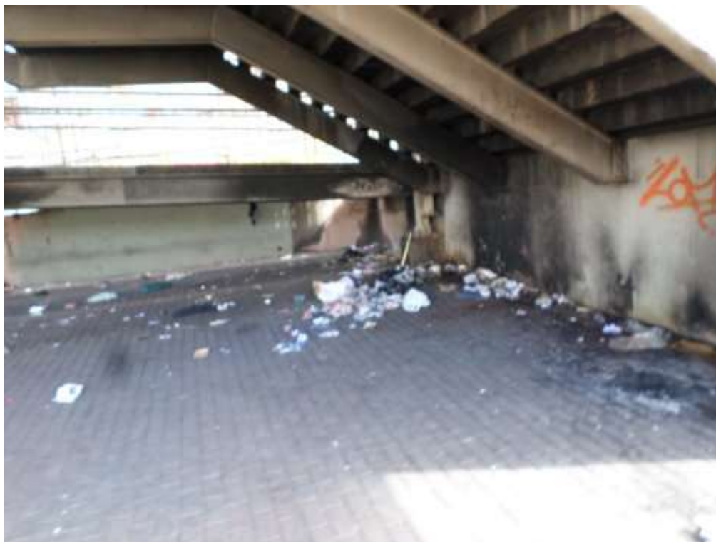
F43/FS – Vista da parte inferior da escada ao final da passarela apresentando manchas de fuligem, sujidades e pichações.
