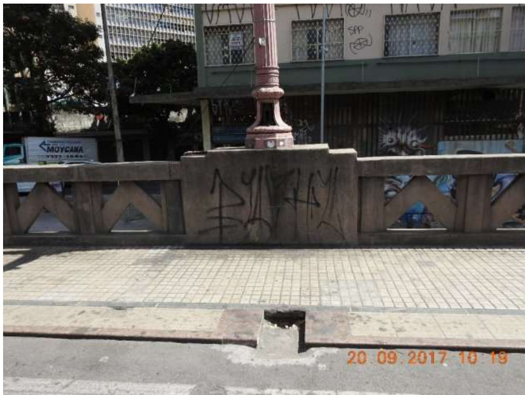
F45/ST – Poste sem tampa, local aonde deveriam passar os condutores de energia para as luminárias. Detalhe para sistema de drenagem obstruído.
