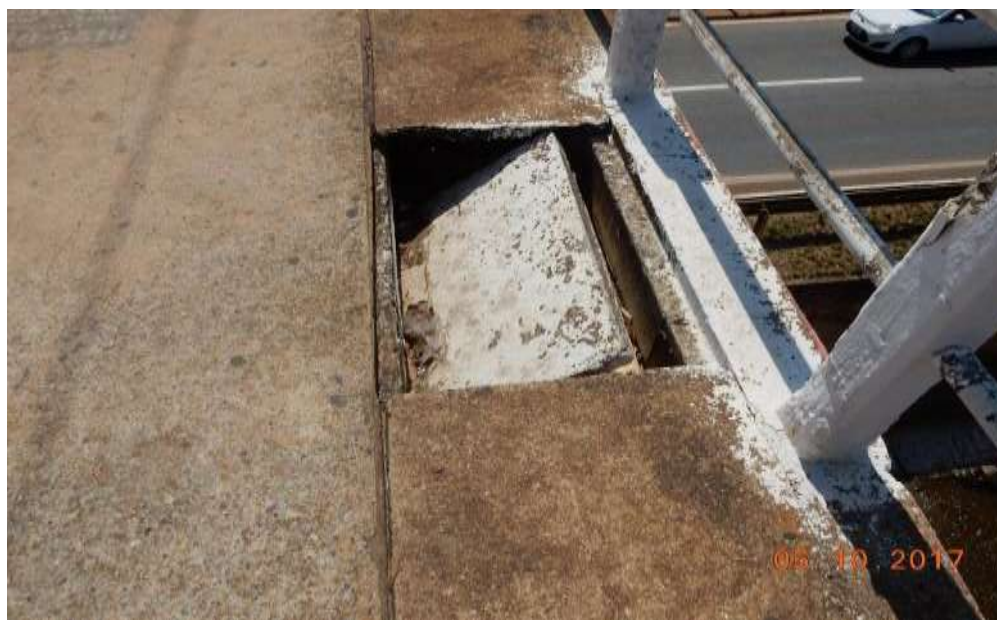
FOTO. 9 – Placa de concreto desconectada e caída dentro da canaleta no passeio da Avenida Universitária.
