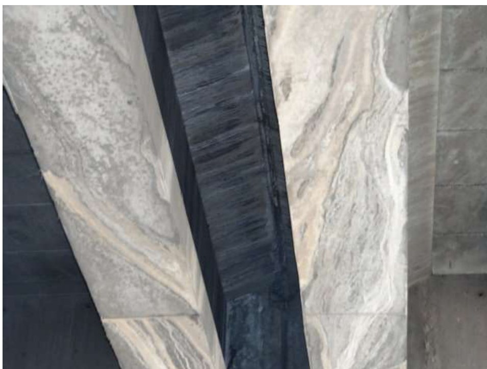
F06/FS – Detalhe de eflorescência no entorno da junta existente entre duas vigas.
