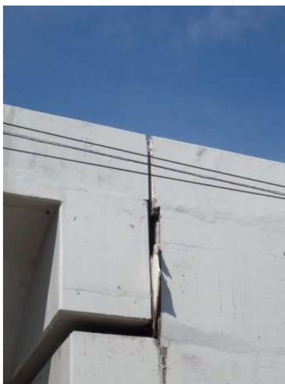
F28/FL –Viaduto Montese, deslocamento do apoio.
