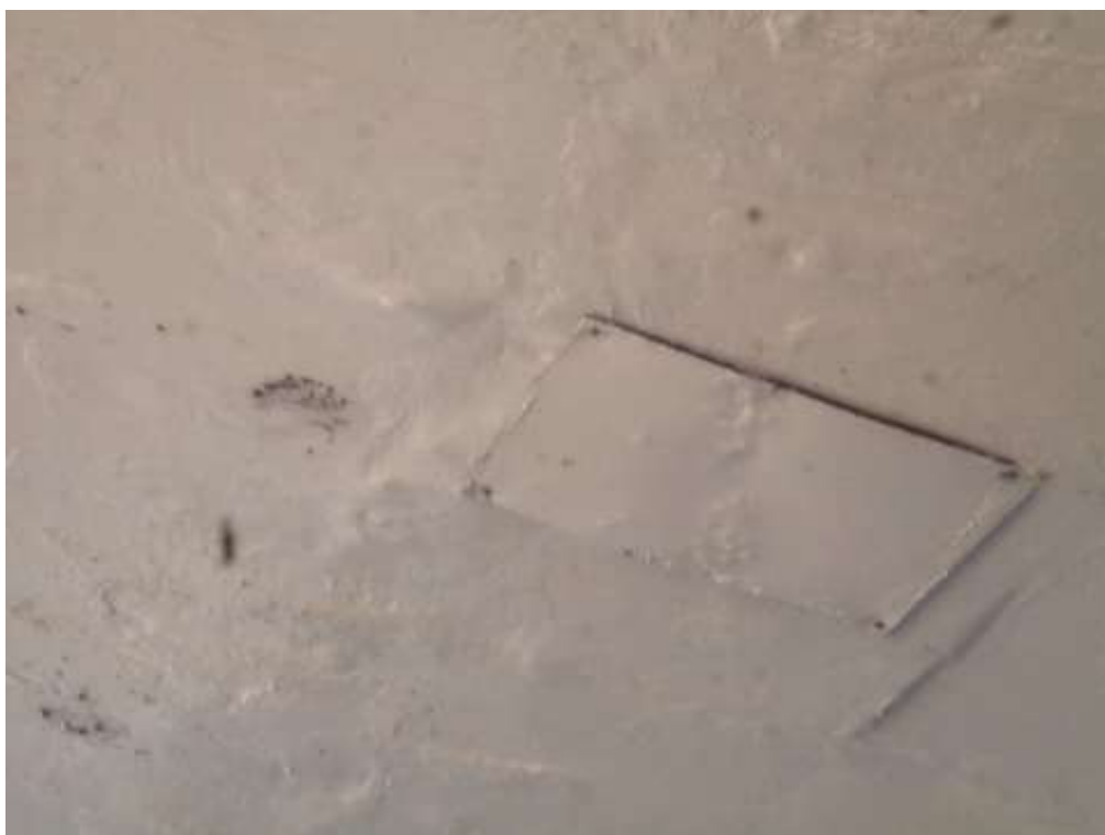
F08/FS – Vista aproximada da mesma base inferior com sinais de deslocamento com pintura por cima.
