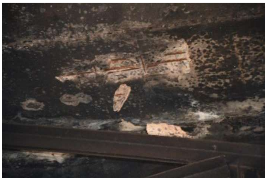
FOTO 44 – Vista de outro ponto da presença de umidade com deslocamento da camada de recobrimento do concreto na parte inferior da superestrutura (tabuleiro), já com comprometimento do recobrimento da armadura (aço).
