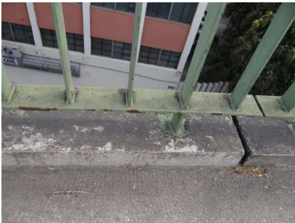
F56/FS – Detalhe pontos de corrosão no guarda corpo.
