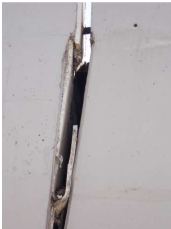
F45/FL –Viaduto Montese, detalhe do deslocamento do apoio direito e das condições precárias, susceptíveis à ação de intempéries.
