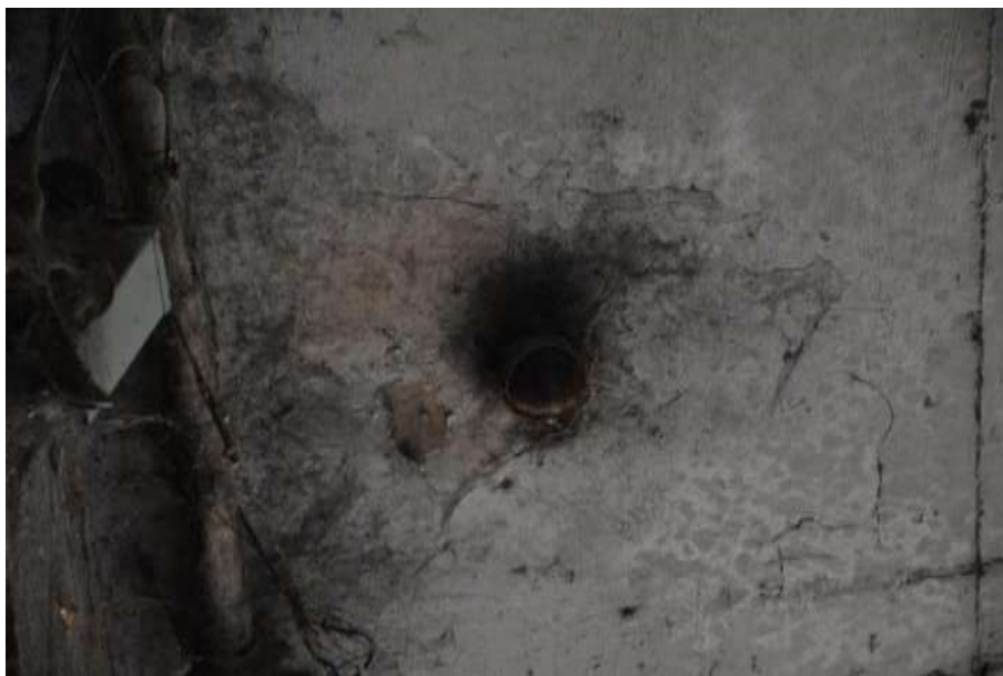
Figura 63 – Indicação de Anomalia:
