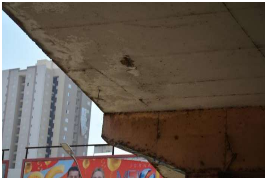
Figura 60 – Indicação de Anomalia:
