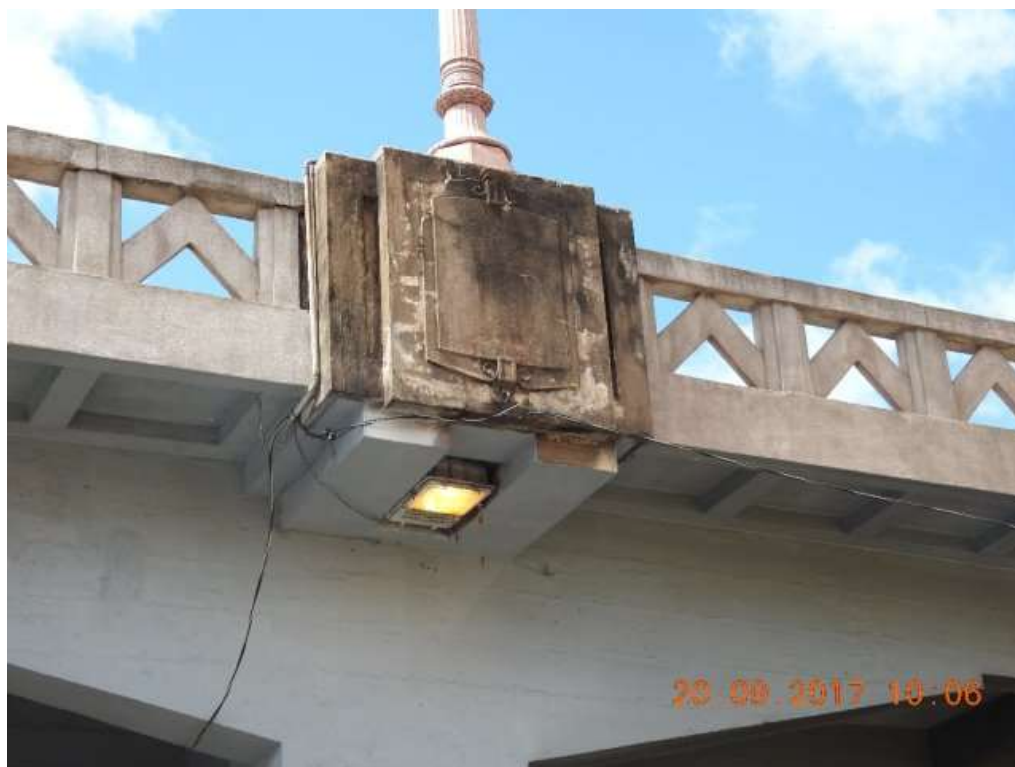
F35/ST – Vista lateral, verifica-se outro ponto em que não revitalização.
