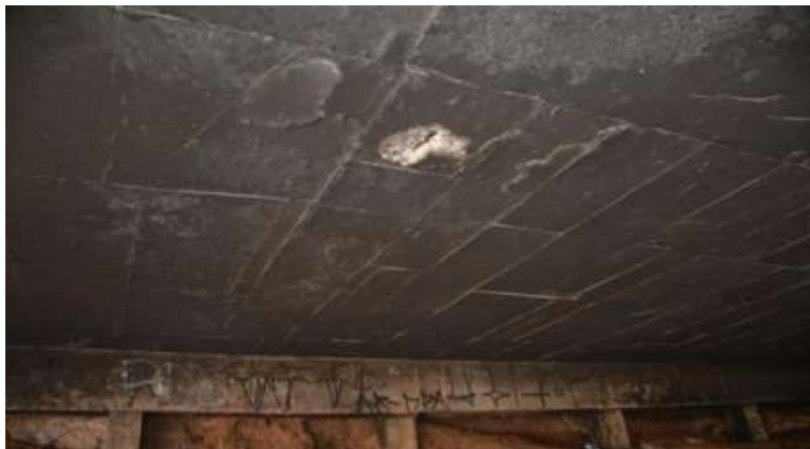
Figura 124 – Indicação de Anomalia:
