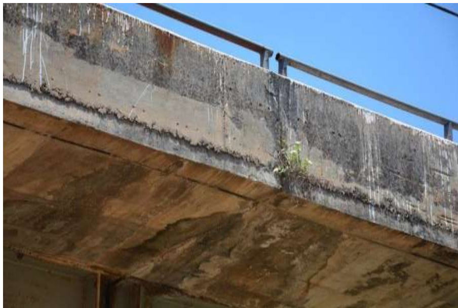
FOTO 23 – Vista do detalhe da lateral do ponte com presença de umidade em diversos pontos. Detalhe de junta de dilatação com excesso de umidade e evidência da falta de manutenção (vegetação).
