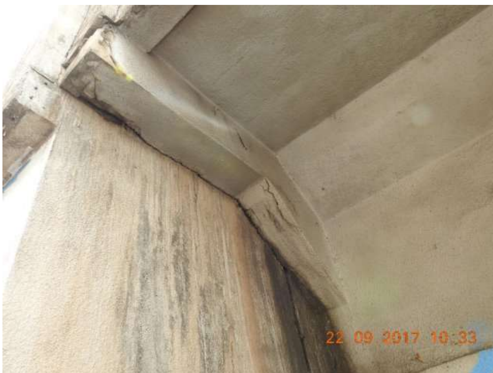
F12/FL – Detalhe foto anterior, observa-se trinca na viga e umidade excessiva.
