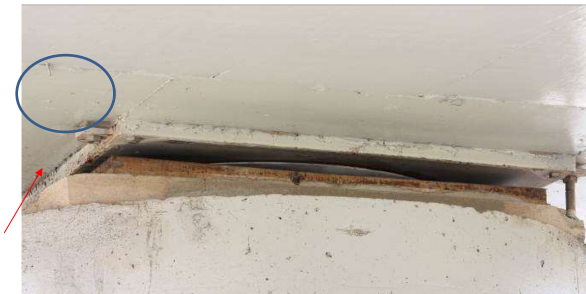
F36/FL – Detalhe de aparelho de apoio, com ausência de um dos parafusos. Notar também evidências de intervenções (reparos) nas quinas da base, com provável utilização de material não estrutural.
