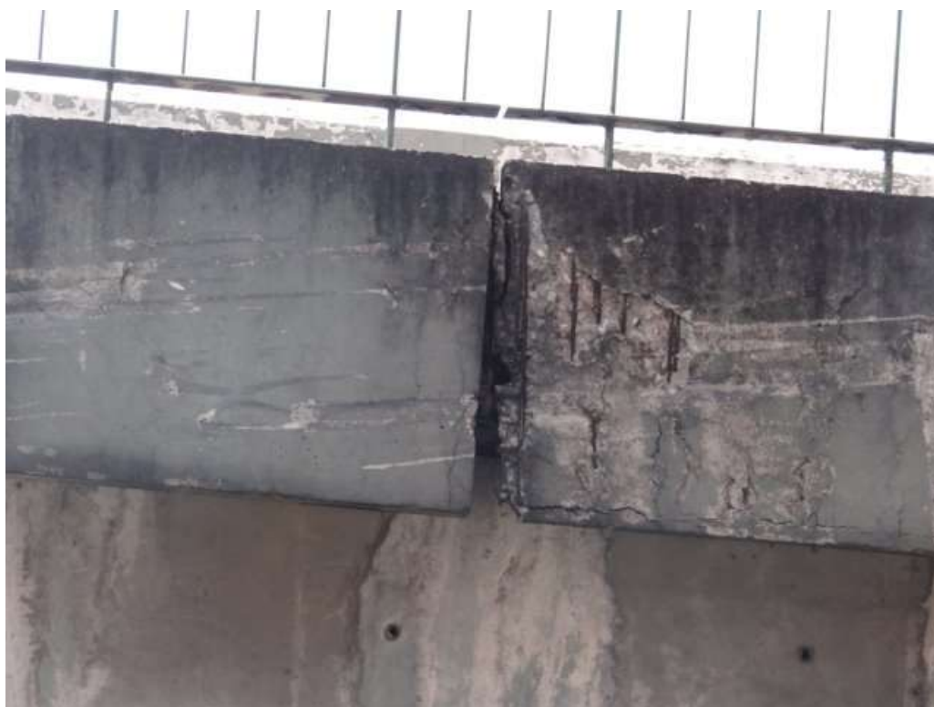
F34/FS – Outro detalhe de ausência de cobrimento, exposição e corrosão de parte da armadura.
