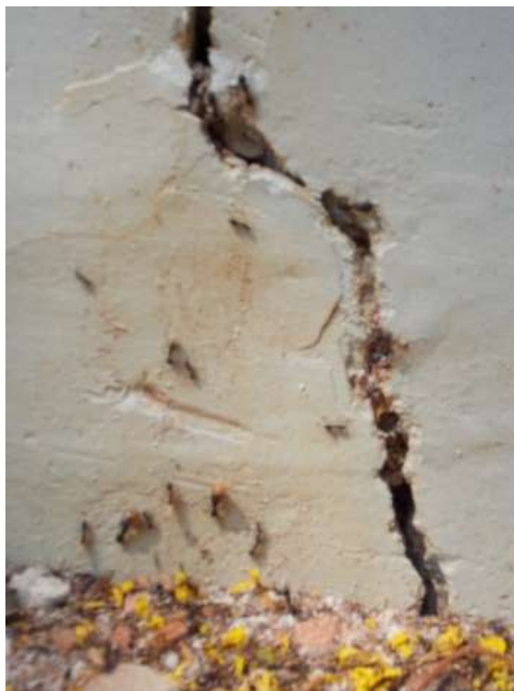
F09/FL – Viaduto Montese, detalhe da junta descrita nas fotografias anteriores, destacando a presença de formigueiro.
