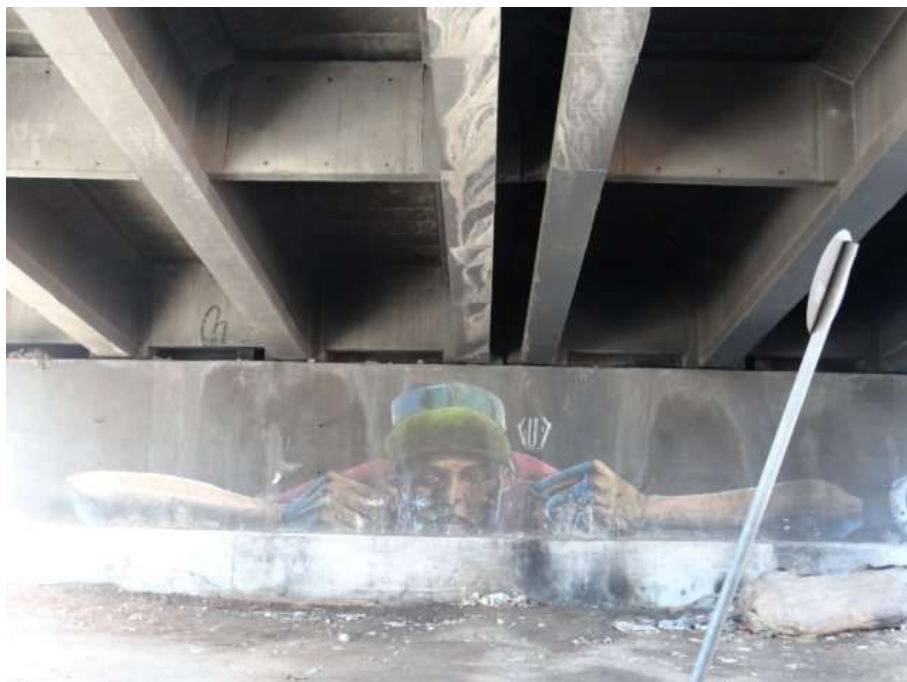
F05/FS – Vista geral de um dos pilares, laje e vigas na região do Bairro Santa Efigênia. Observa-se as marcas de ação de calor proveniente de fogueiras.
