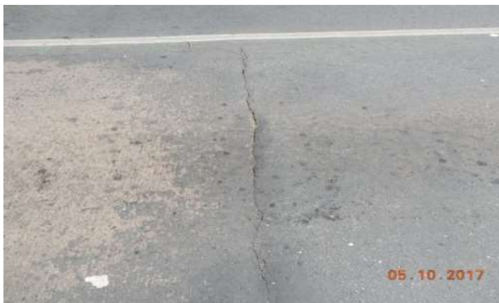
FOTO. 15 – Fissura na cabeceira da pista de rolamento da Avenida Universitária.
