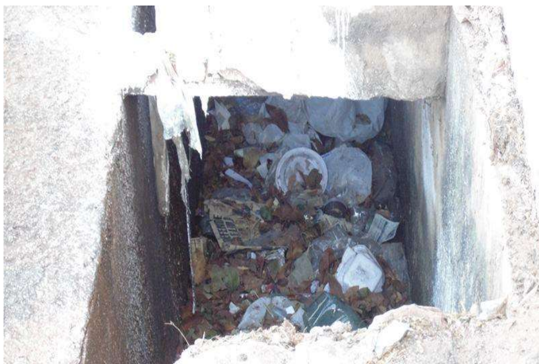
Foto 15 – Bueiros totalmente obstruídos por lixo.
