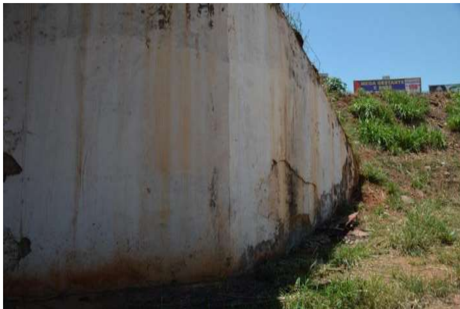
FOTO 55 –Vista de outro ponto do deslocamento da argamassa de proteção dos blocos de contenção do aterro da cabeceira da ponte na Ponte T-63 sobre o córrego Cascavel visualizado da Avenida T-63 sentido Bairro / Centro.
