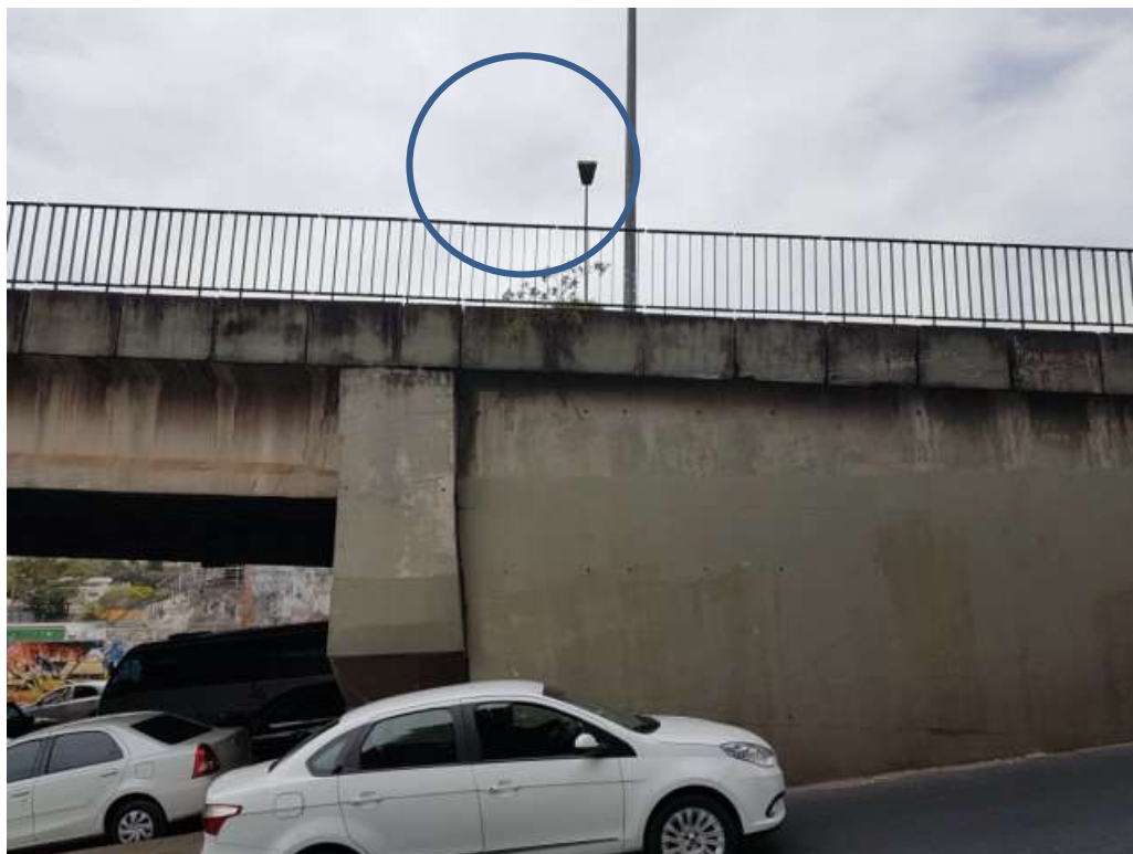
F23/FS – Detalhe de vegetação indicativa de existência de umidade e ausência de manutenção.
