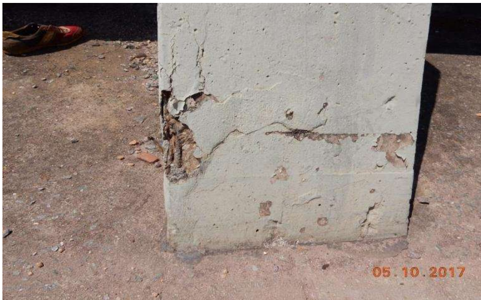
FOTO. 4 – Apoio da tubulação de água na Ilha central da Avenida Universitária, com concreto deslocando, ferragem exposta e oxidada, situação que se repete em outros apoios.
