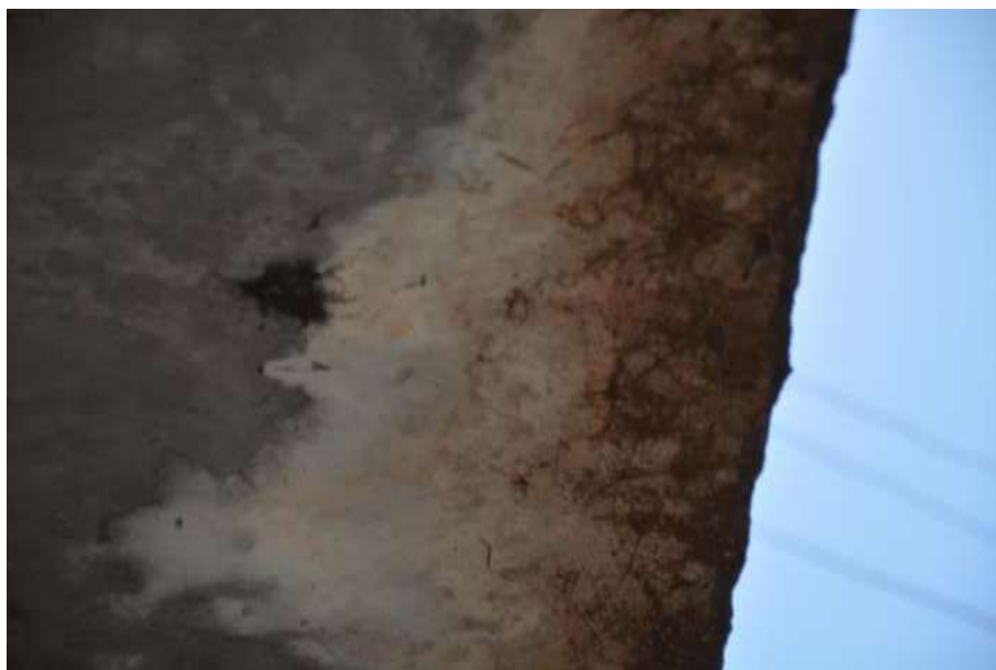
Figura 77 – Indicação de Anomalia:
