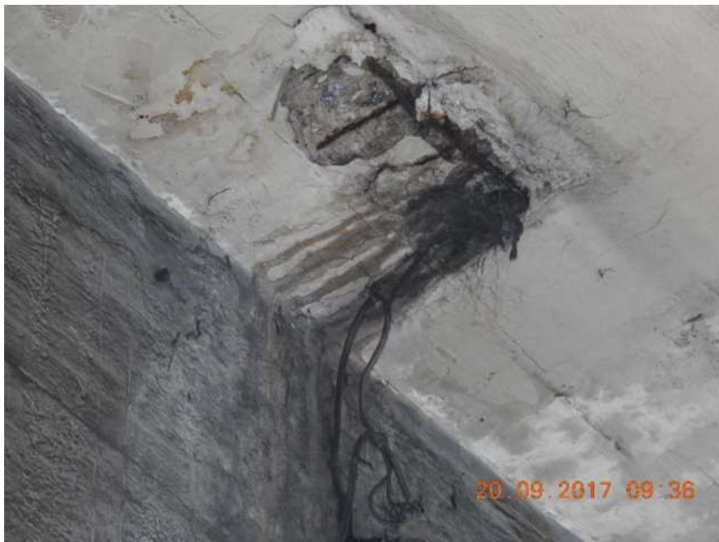
F13/ST – Detalhe da presença de umidade. Oxidação da ferragem.
