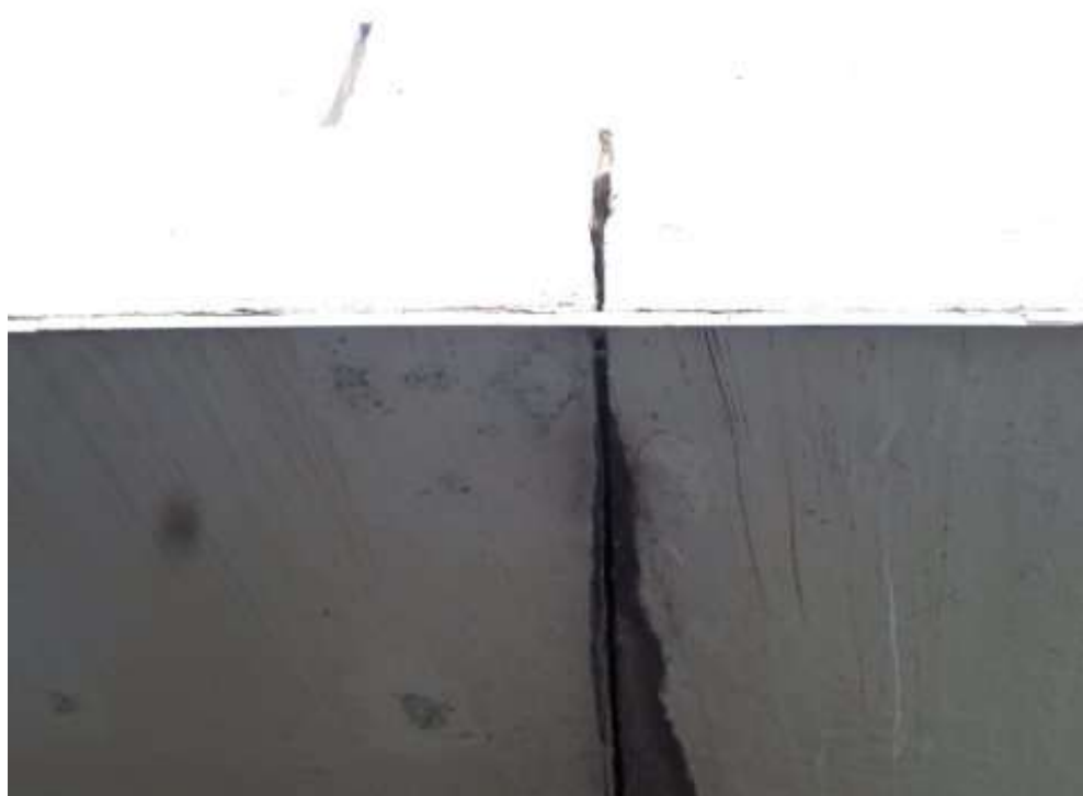
F05/FS – Vista de manchas de infiltrações na junta na lateral esquerda do viaduto 6 .
