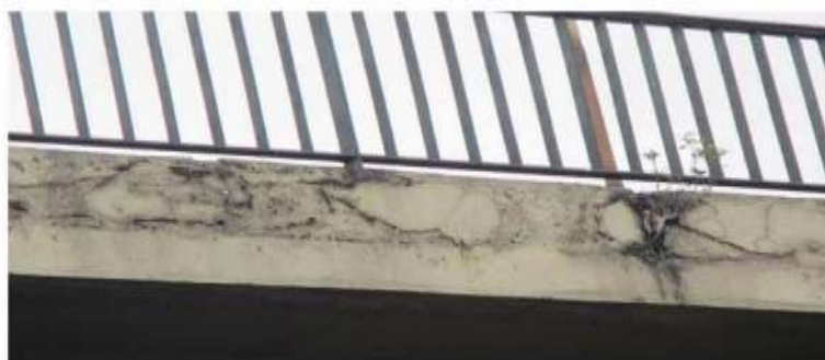
Revestimento de concreto em avançado estado de decomposição
