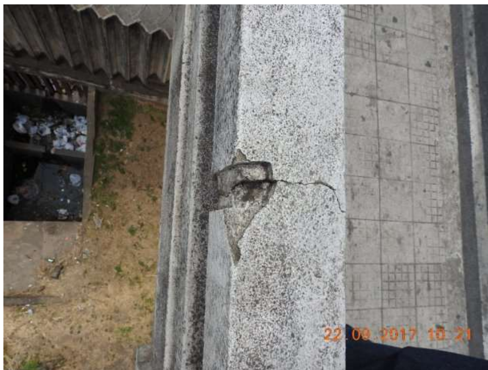
F26/FL – Trinca, deslocamento e perda de parte do recobrimento do guarda-corpo. Observa-se grande acúmulo de lixo no sistema de drenagem no lado esquerdo.
