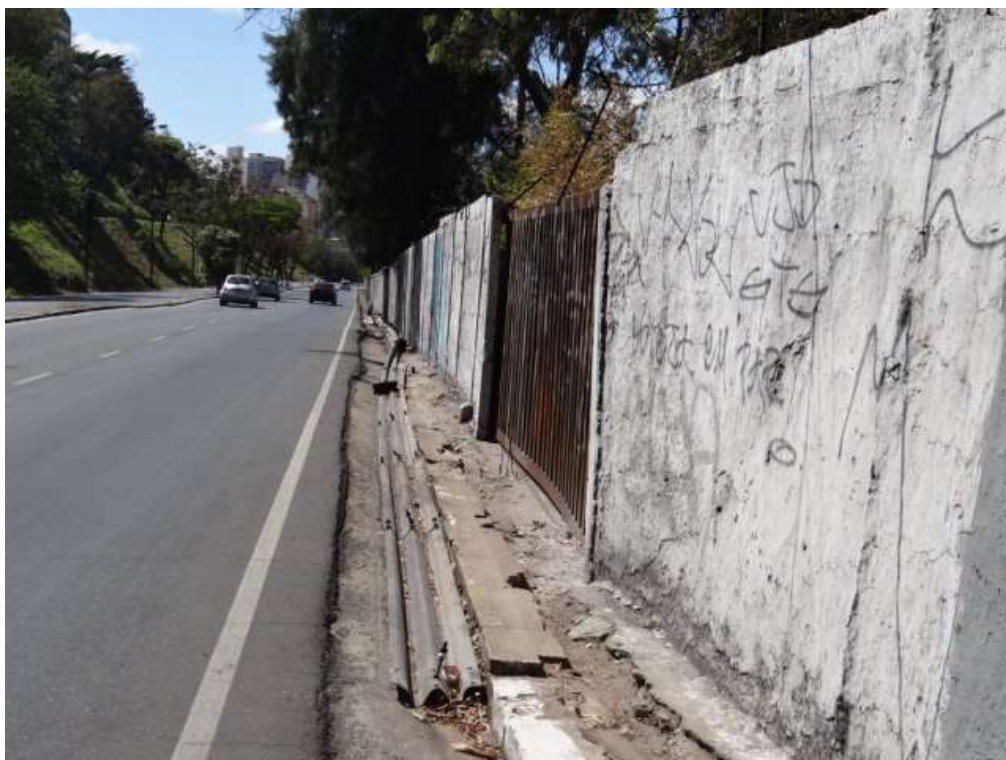
F44/HG – Detalhe de defesa e passeio danificados.
