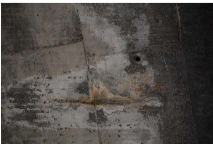
FOTO 26 – Vista do ponto aproximado da presença de umidade, já com comprometimento do recobrimento da armadura (aço).
