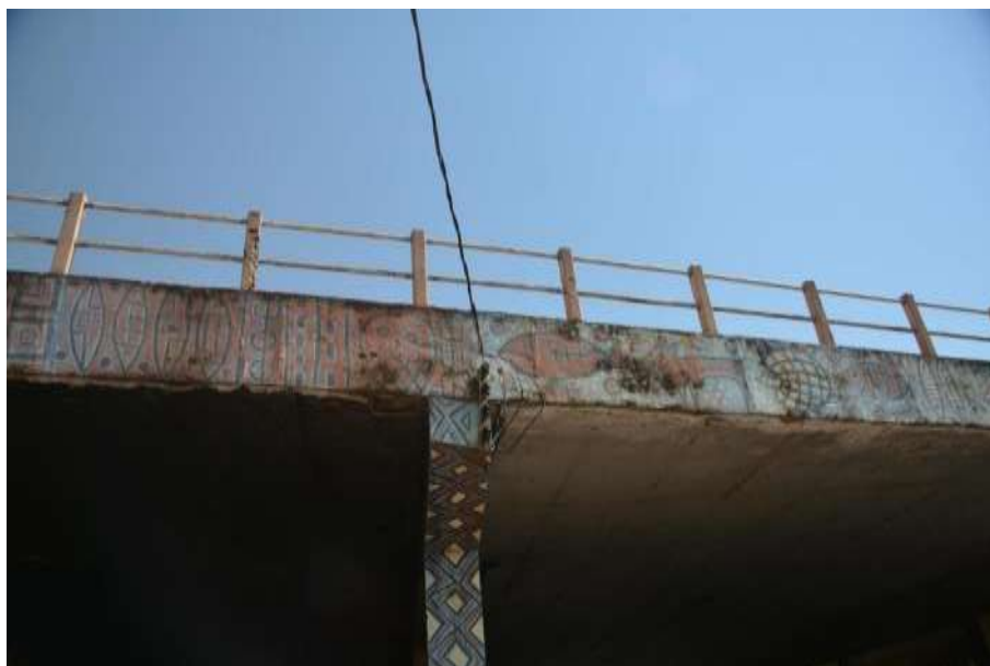
Figura 119 – Indicação de Anomalia:
