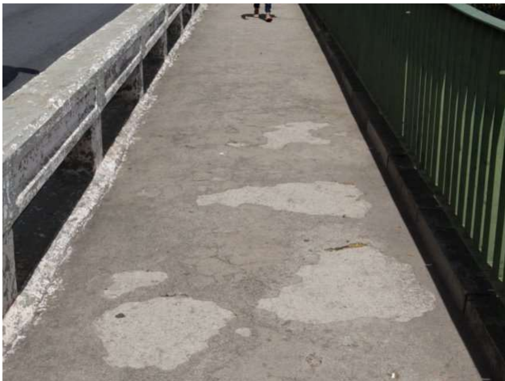
F40/FS – Detalhe do passeio para pedestres danificado.
