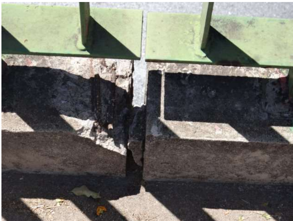
F55/FS – Detalhe de comprometimento do revestimento na base do guarda corpo.
