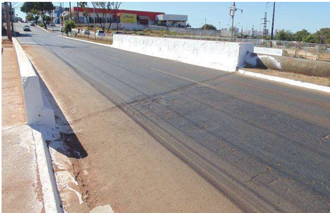
Foto 10 – Recalque do pavimento e trincas na junta de dilatação e ausência de sinalização horizontal.
