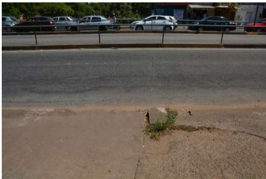
Figura 5 – indicação de anomalia
