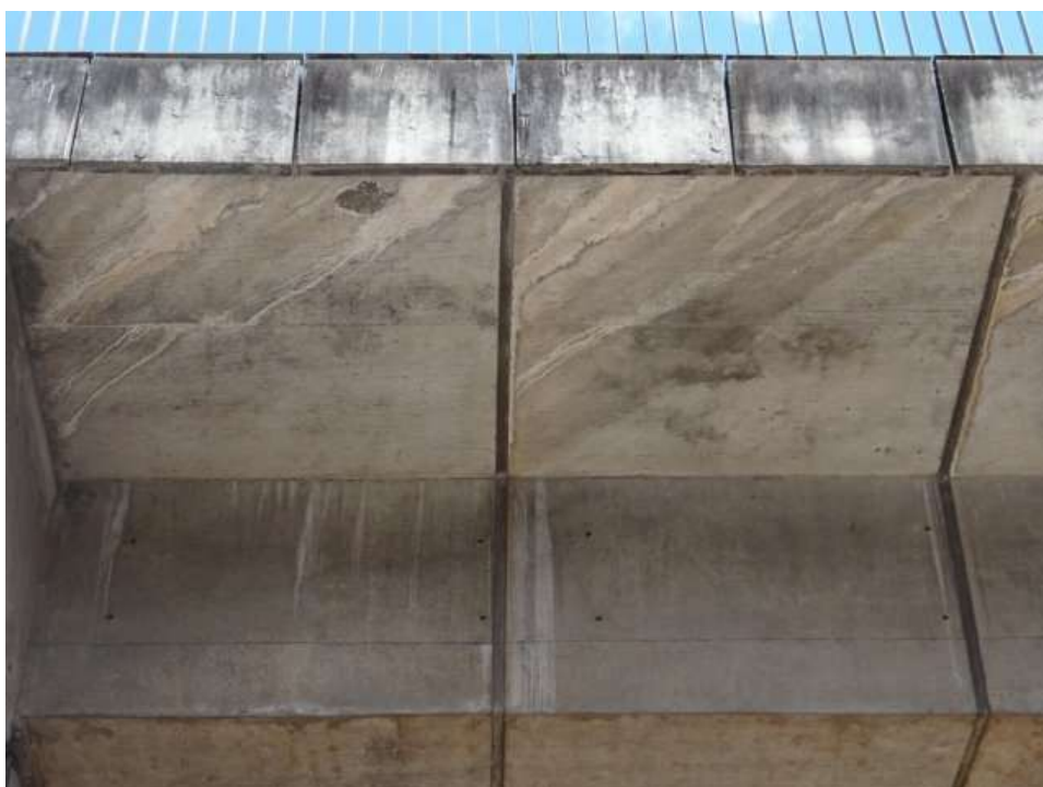
F18/FS – Vista eflorescência na lateral do viaduto.
