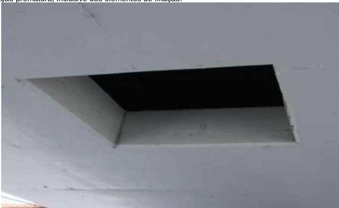
F75/FL – Detalhe escotilha de inspeção, seção no Bairro Itapoã, construída em região de altura não superior a 3,5 metros, aproximadamente. Propicia acesso indiscriminado e ações prejudiciais à estrutura. Foram verificadas na estrutura duas escotilhas, ambas sem proteção, não tendo sido localizados elementos para exaustão.
