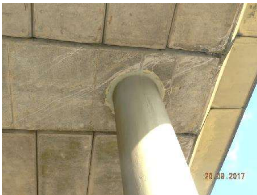
- Estalactites no concreto da face inferior do tabuleiro junto aos elementos de apoio.
