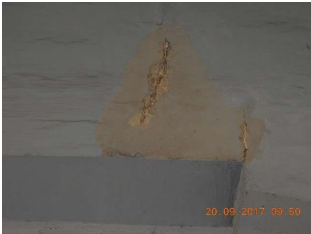
F25/ST – Detalhe da trinca. Local já revitalizado.
