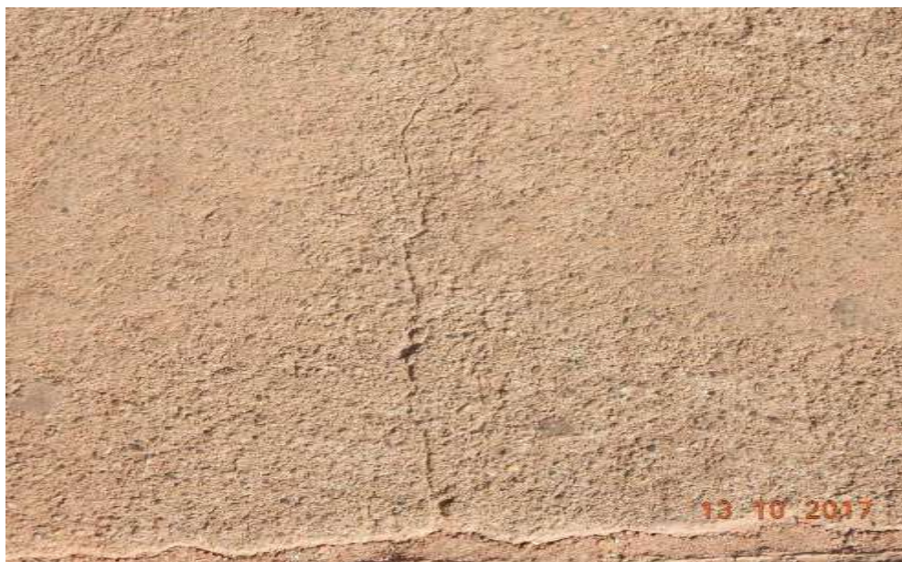
FOTO. 12 – Fissuras no passeio da Avenida Fuad José Sebba.
