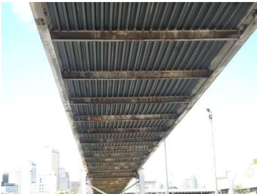
F44/FS – Vista da parte inferior da passarela mostrando sinais de ferrugem e manchas de infiltrações.
