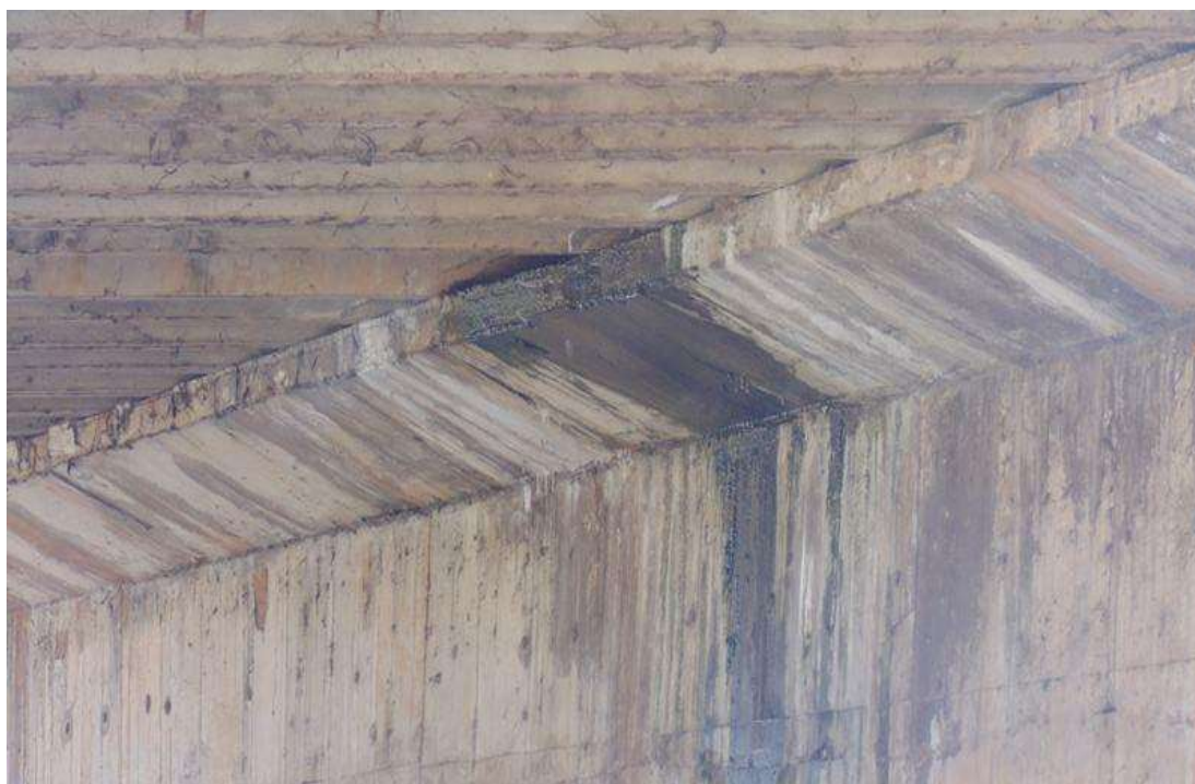
Foto 9 – Ocorrência de infiltração pelo tabuleiro da ponte.
