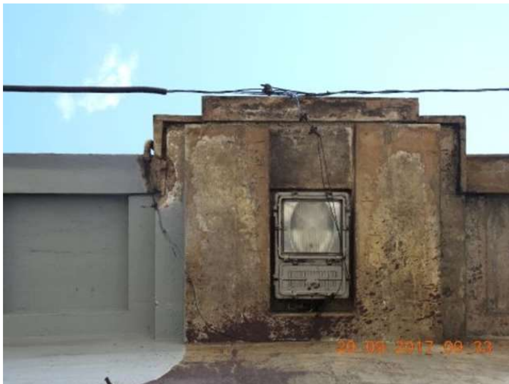
F09/ST – Detalhe para a iluminação na parte inferior do viaduto, alimentação com condutor externo ao eletroduto. Presença de umidade e deslocamento.
