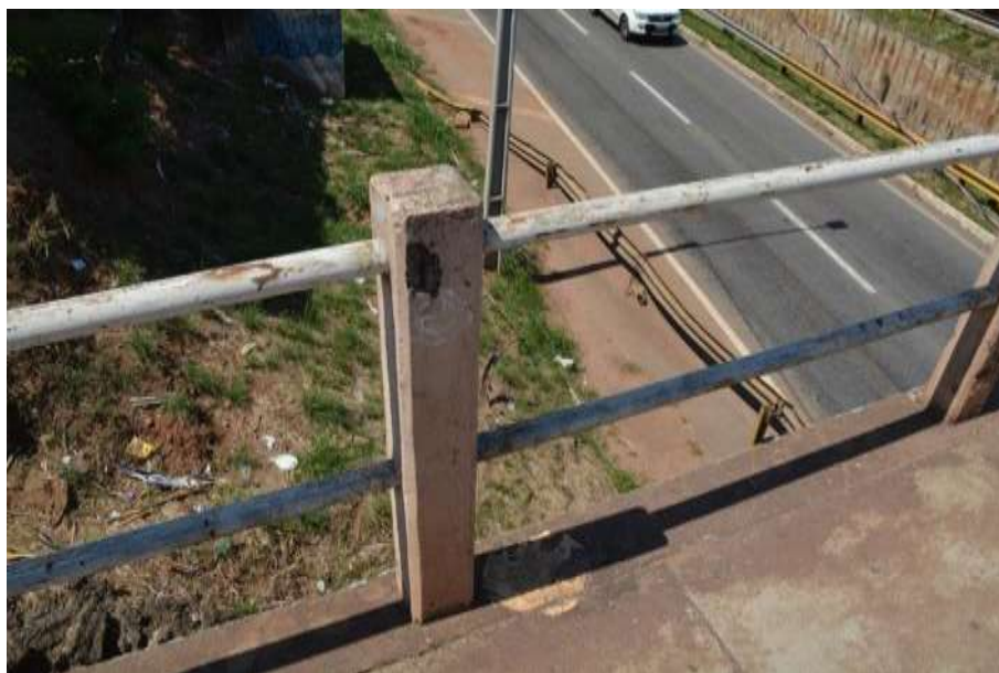
Figura 30 – Indicação de Anomalia:
