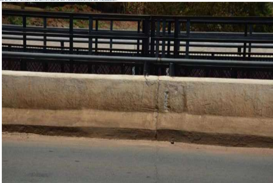
FOTO 15 – Vista de outro ponto de fissuras e trincas no guarda corpo do canteiro central com deslocamento do concreto na Ponte T-63 sobre o córrego Cascavel visualizado da Avenida T-63 sentido Bairro / Centro.
