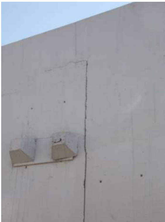
F46/FL –Viaduto Montese, junta de dilatação interrompida antes da conclusão da estrutura de contenção, formando, em consequência, trincas e fissuras.
