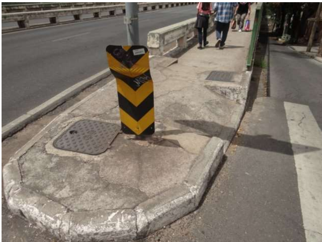
F39/FS – Vista do passeio para pedestres Bairro Floresta. Detalhe da sinalização danificada.
