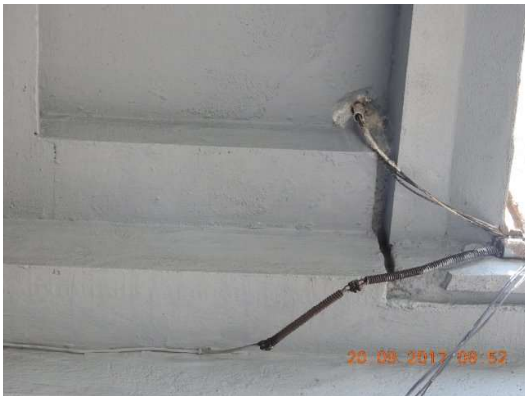
F26/ST – Improvisação na parte elétrica.
