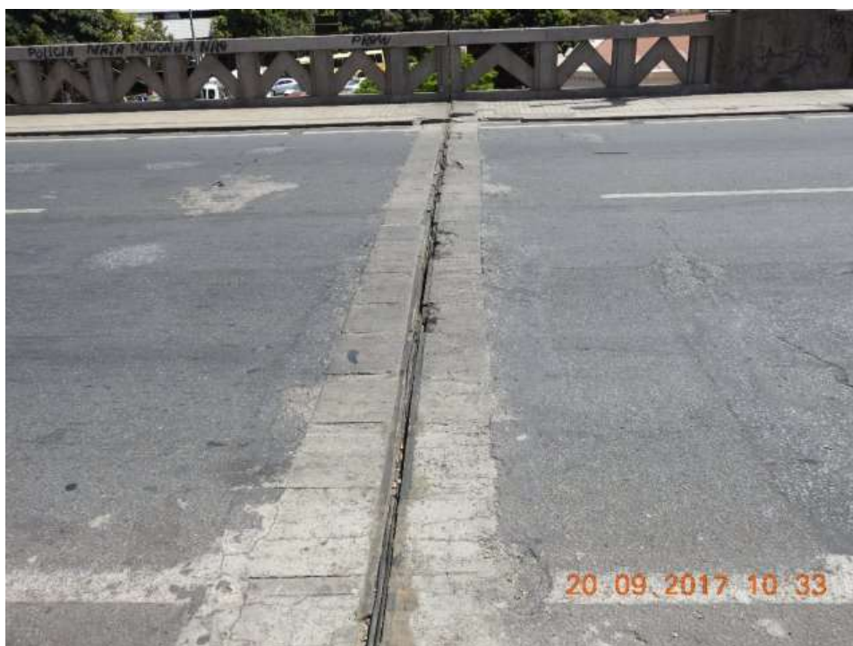
F51/ST – Sistema de impermeabilização com junta danificada, pavimento precisa de reparos.
