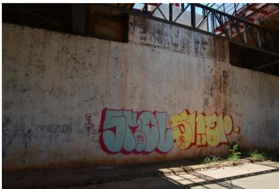
FOTO 50 – Vista de outro ponto de pichação na contenção do aterro da cabeceira da ponte na Ponte T-63 sobre o córrego Cascavel visualizado da Avenida T-63 sentido Bairro / Centro.
