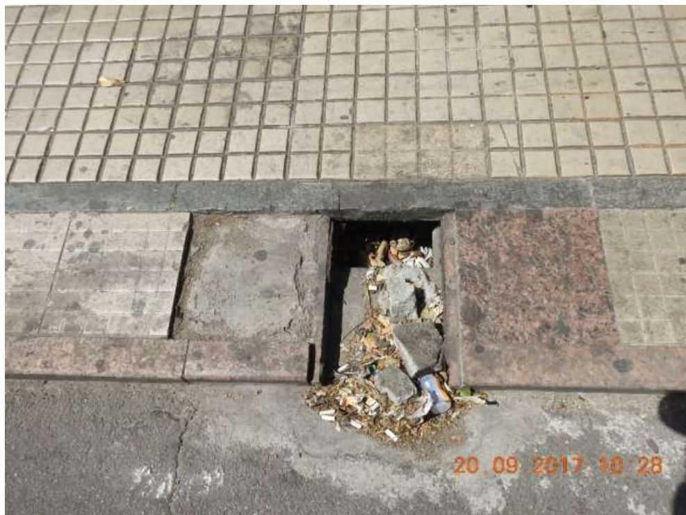
F49/ST – Outros pontos do sistema de drenagem comprometidos, neste ponto existem pedaços de concretos.
