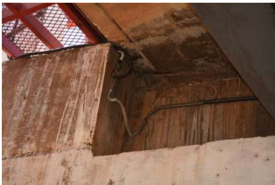
FOTO 52 – Vista aproximada do detalhe do cabeamento do sistema de iluminação na parte inferior da ponte com ligação através de condutor aparente, sem a utilização e ou com a utilização de eletrodutos danificados.
