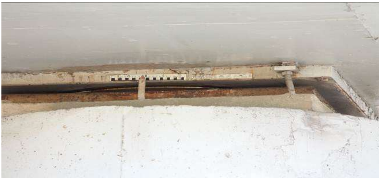
F35/FL – Detalhe de aparelho de apoio, com evidências de deformações em parafusos. Notar também desgaste superficial do aparelho.
