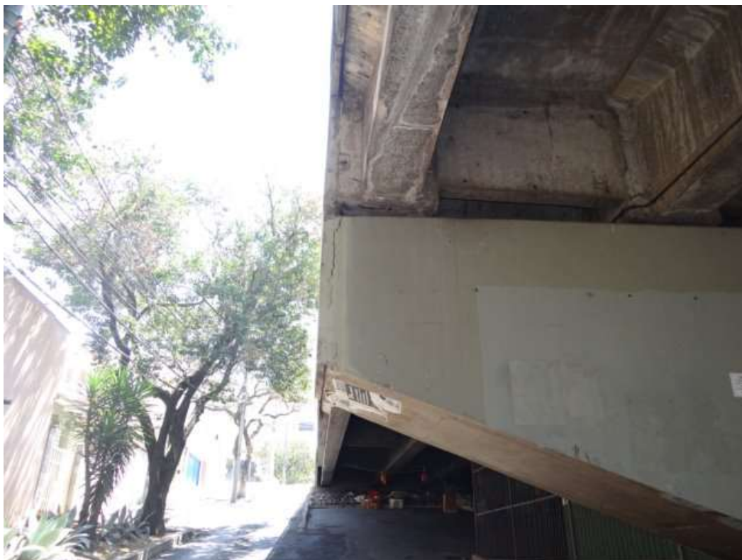
F37/FS – Detalhe de efflorescência e trinca em interface de pilar e viga.
