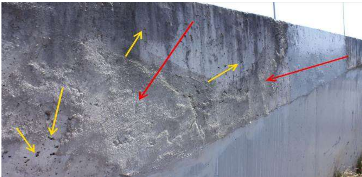
F80/FL – Evidência de utilização de materiais não estruturais em intervenções de reparos de brocas no concreto.
