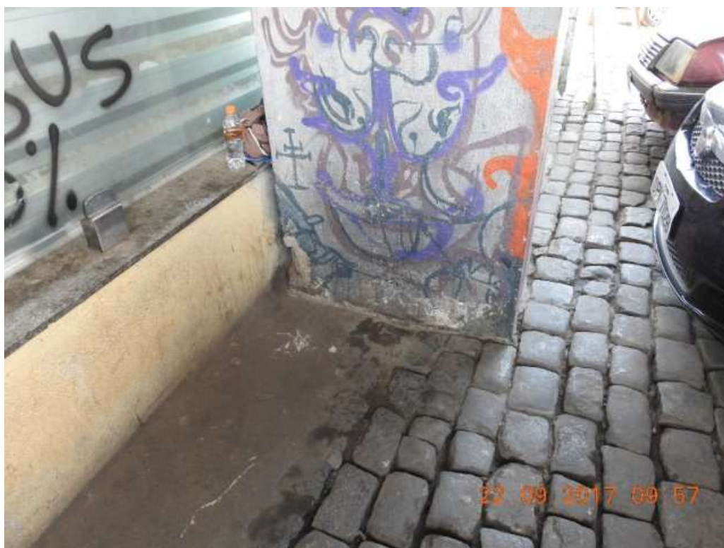
F84/FL – Ocorre em outro pilar, deslocamento e perda do recobrimento na base.
