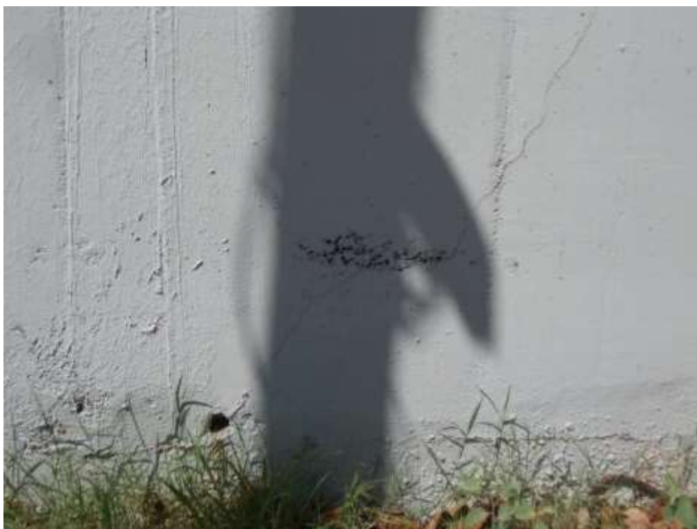
F21/FL –Viaduto Montese, detalhe de fissura na estrutura de contenção.
