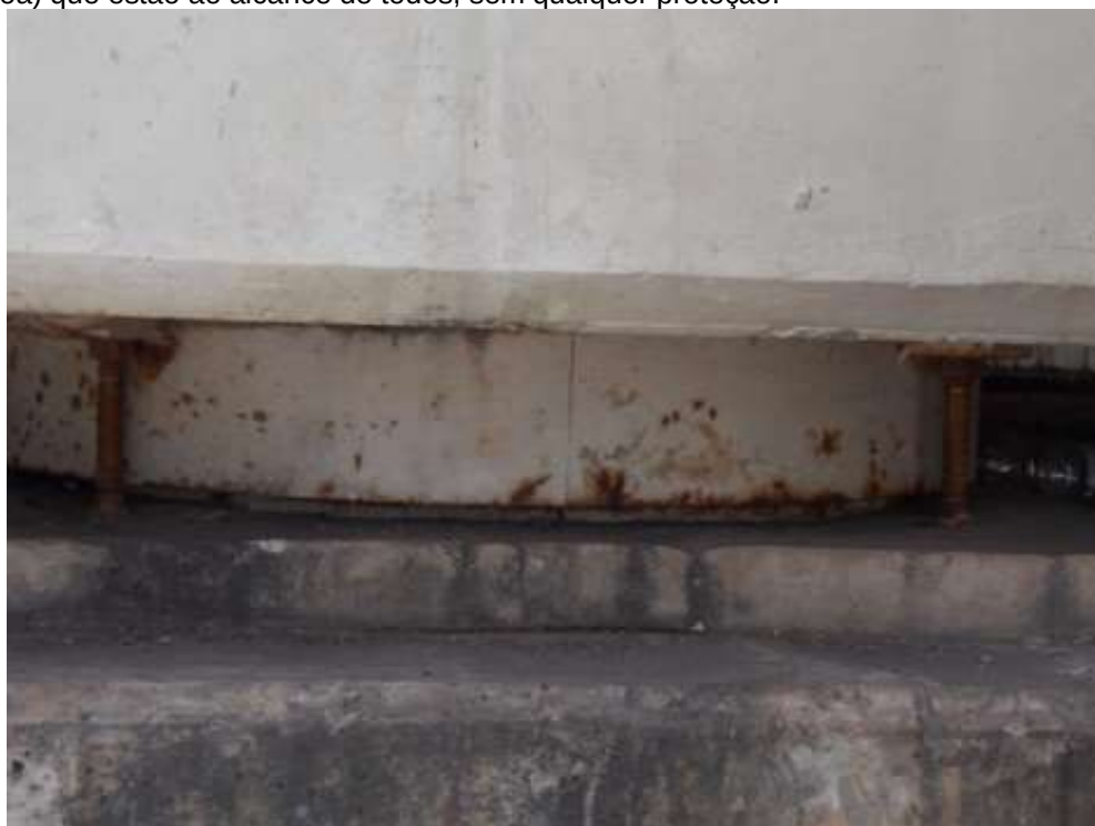
F73/FL – Detalhe do aparelho de apoio (Neoprene) da estrutura do viaduto Montese, que estão ao alcance de todos, sem qualquer proteção. Verifica-se oxidação prematura, inclusive, dos elementos de fixação.
