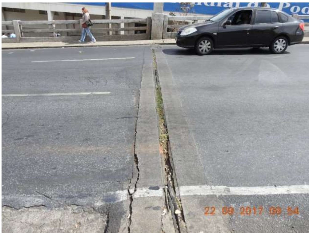
F47/FL – Outro detalhe da junta, presença de vegetação no meio, local aonde deveria ter o elemento de impermeabilização.
