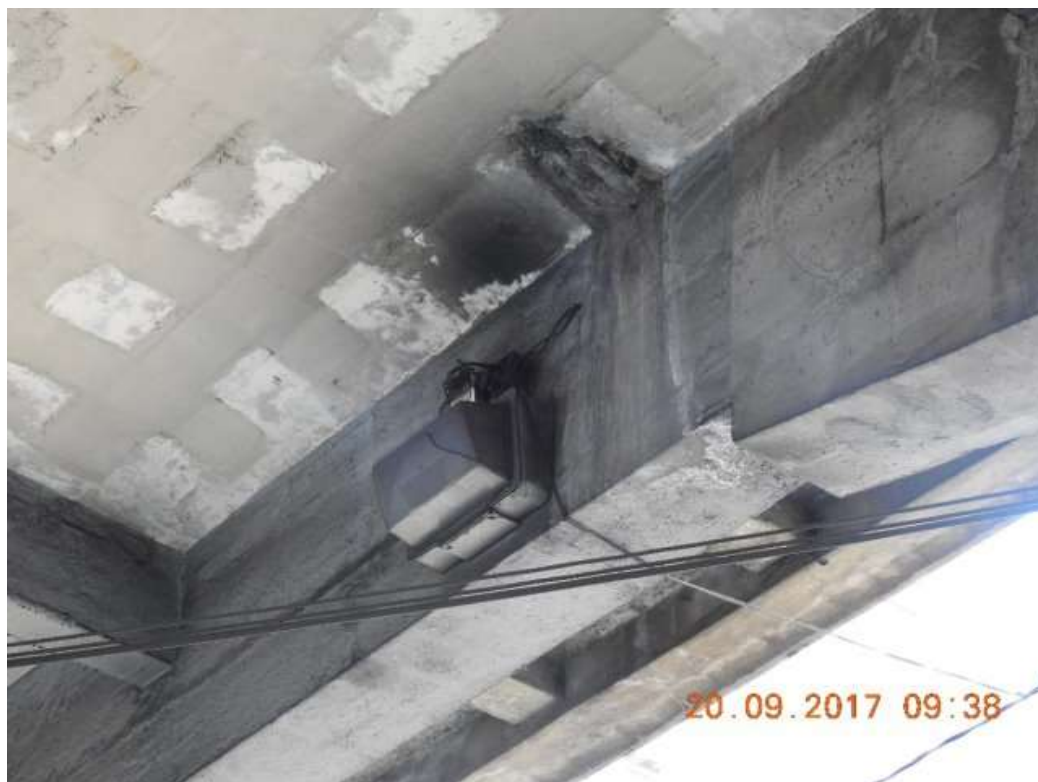
F18/ST – Outro ponto com eflorescência no tabuleiro e viga próximo a luminária.
