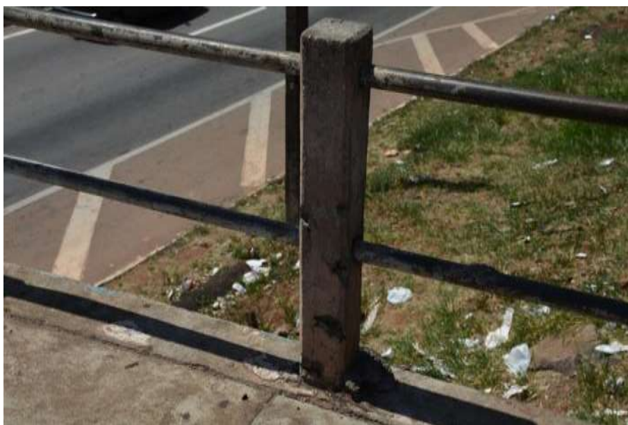
Figura 19 – Indicação de Anomalia:
