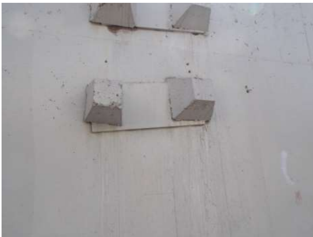
F54/FL – Viaduto Montese, deficiência no prumo dos tirantes. Detalhe para ausência de alinhamento/prumo destes.
