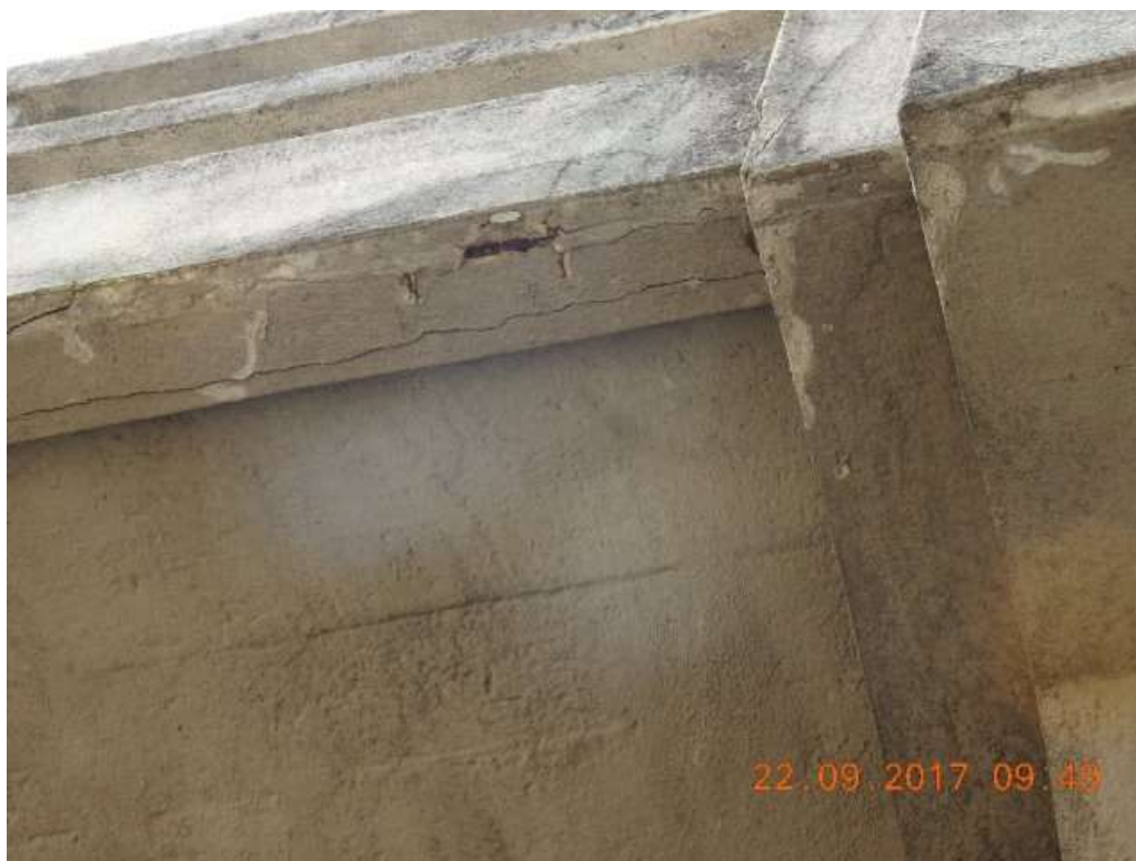
F81/FL – Trincas e desprendimento do recobrimento da armadura.
