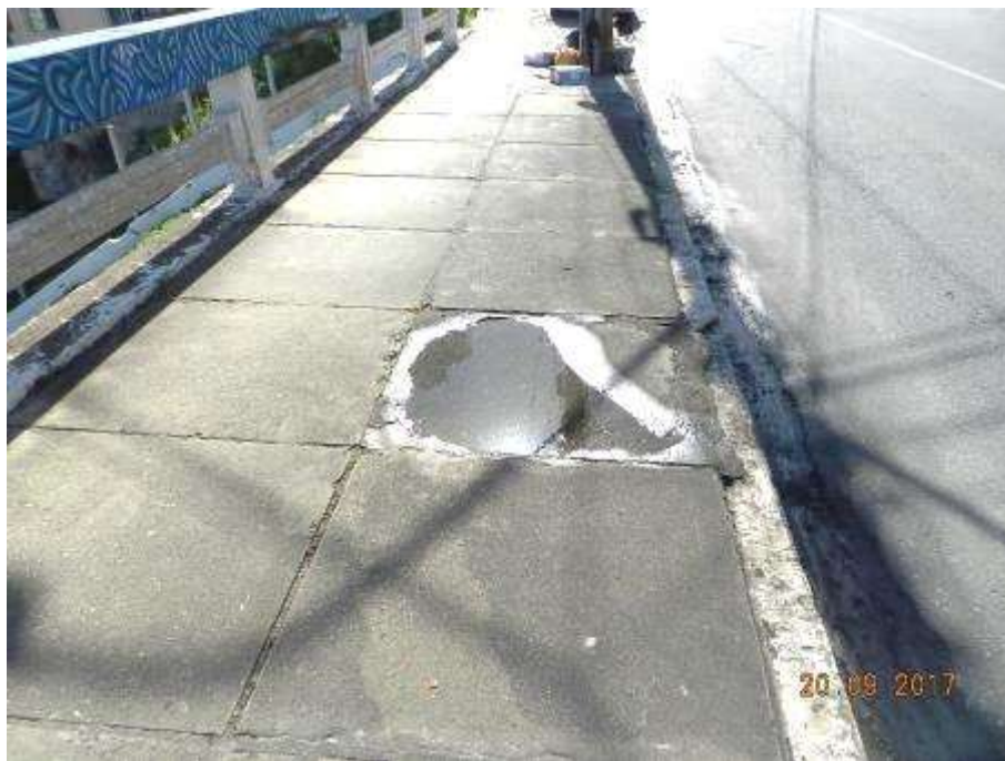
- Empoçamento de água no passeio.
