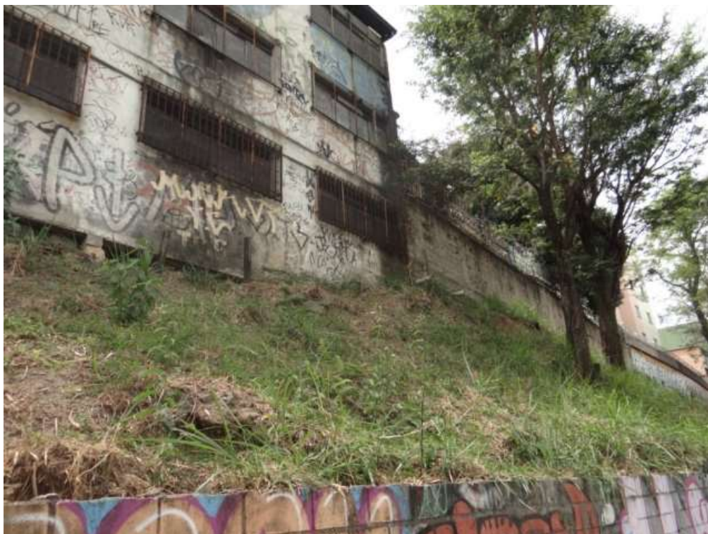
F19/HG – Vista dos diversos pontos de lançamento de efluentes pluviais sobre o terreno desprotegido, seção anterior à contenção.
