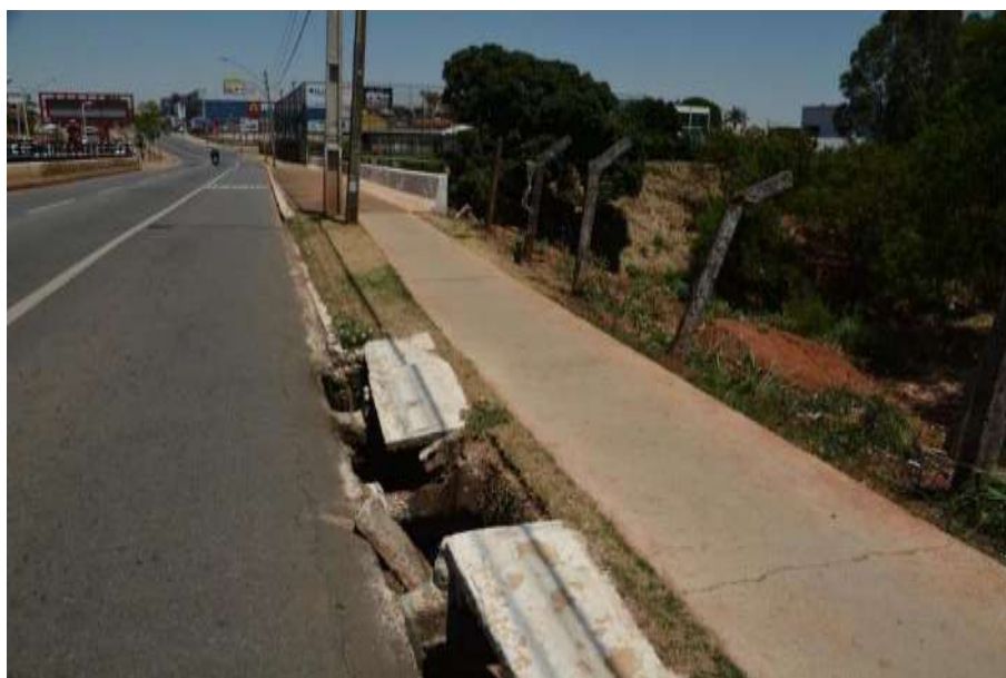
FOTO 46 – Vista de outro ângulo da tampa quebrada de um dos pontos de drenagem pluvial lateral na pista de rolamento que antecede a pista da Ponte T-63 sobre o córrego Cascavel visualizado da Avenida T-63 sentido Centro / Bairro.
