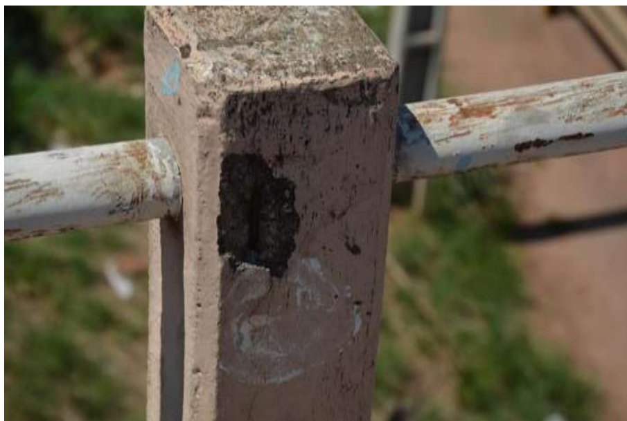
Figura 31 – Indicação de Anomalia:
