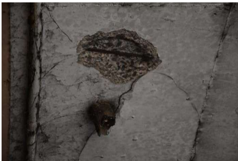
Figura 121 – Indicação de Anomalia:
