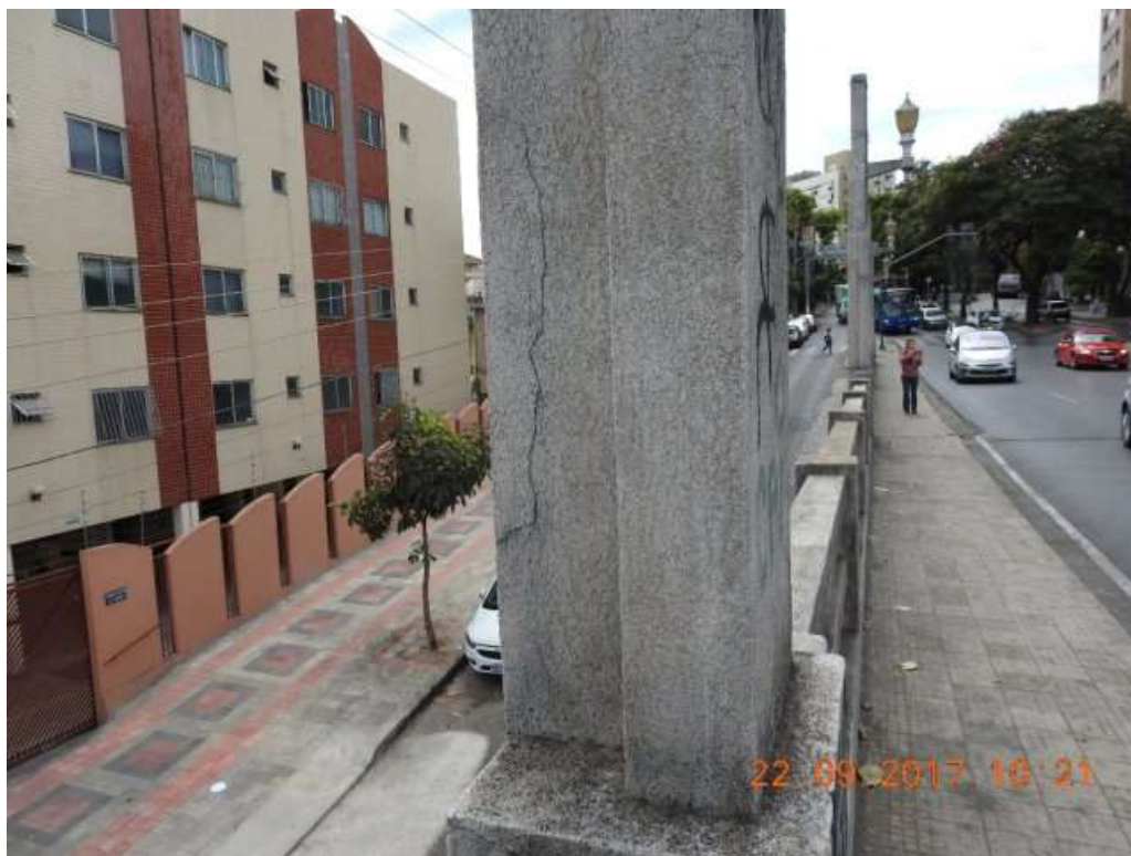
F25/FL – Trinca no poste de iluminação. Observa-se que abaixo há trânsito de pedestre e veículos.
