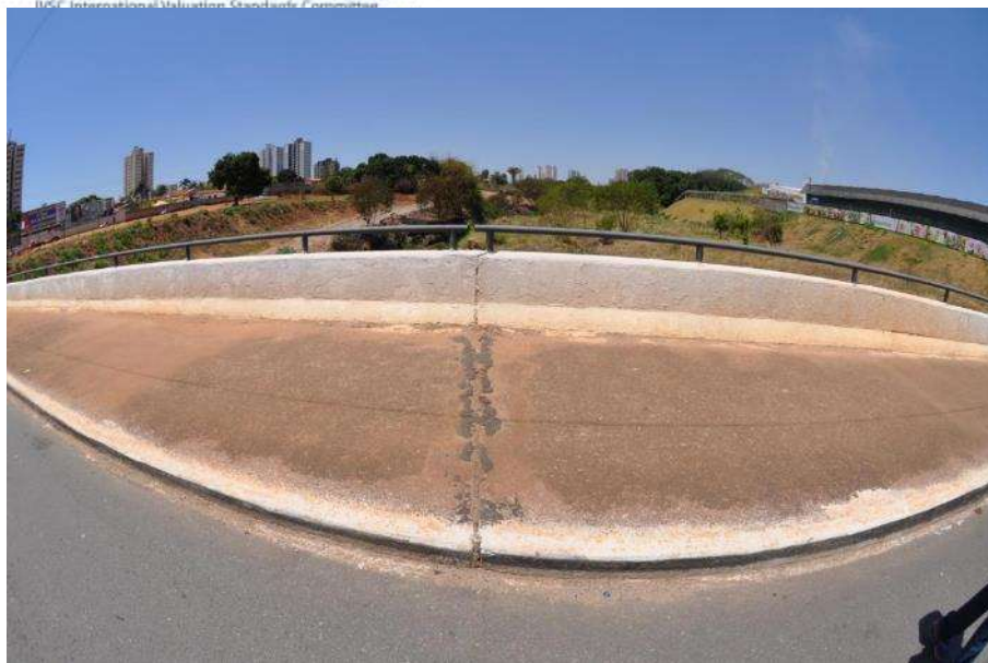
FOTO 17 –Vista da junta de dilatação preenchida com asfalto betuminoso e com rebarba no contrapiso da passagem de pedestre na lateral da pista da Ponte T-63 sobre o córrego Cascavel visualizado da Avenida T-63 sentido Bairro / Centro.
