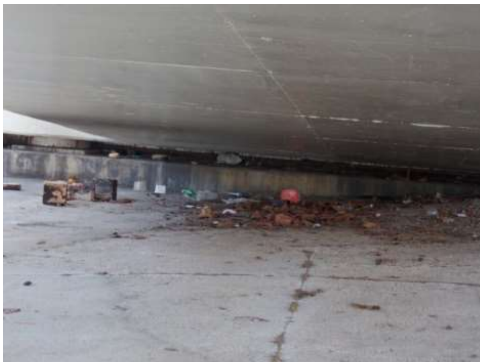
F72/FL – Viaduto Montese, detalhe do lixo presente na região dos elementos de apoio do viaduto, (Bairro Itapoã) que estão ao alcance de todos, sem qualquer proteção.
