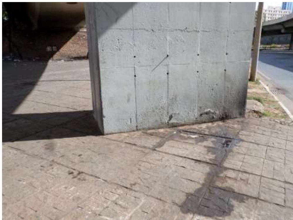
F53/FS – Vista de pilar apresentando deslocamento de pintura. A umidade evidente é provocada por urina.
