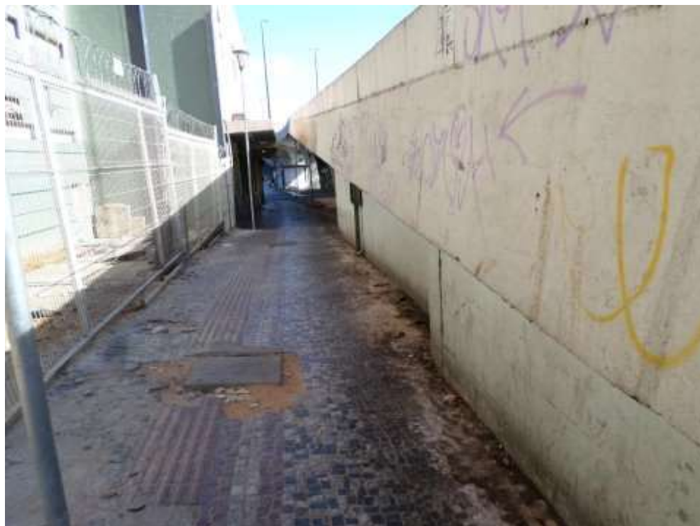
F03/FS – Vista da lateral esquerda - Cabeceira 1: Pichações e passeios completamente deteriorados.
