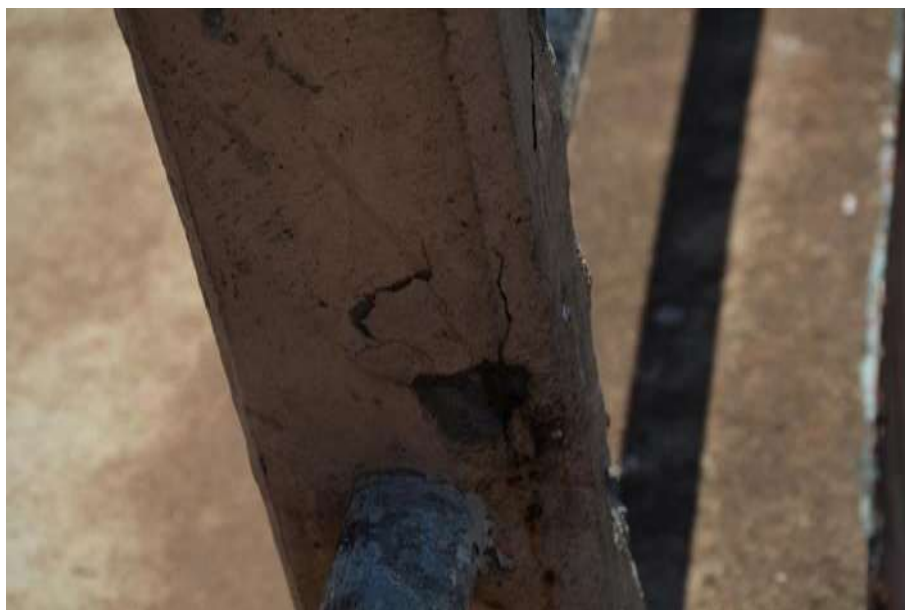
Figura 12 – Indicação de Anomalia:
