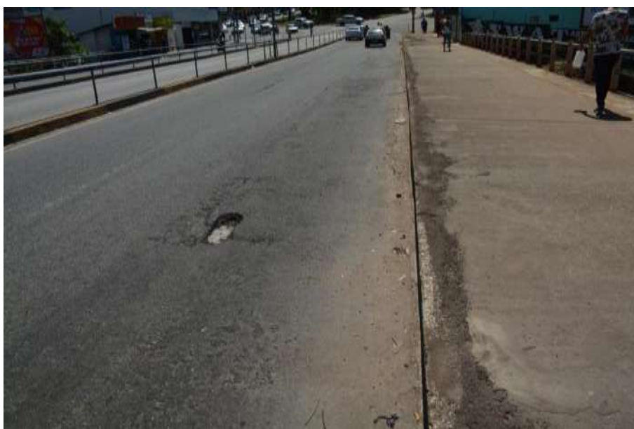
Figura 21 – Indicação de Anomalia:
