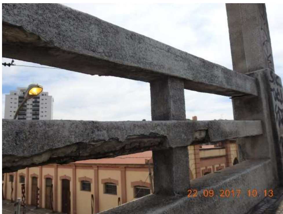
F36/FL – Outro ponto aonde ocorre deslocamento e perda do recobrimento, e oxidação da ferragem no guarda corpo, abaixo local aonde ocorre transito de pessoas.
