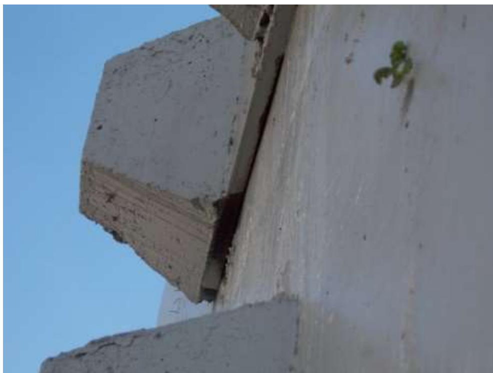
F56/FL – Viaduto Montese, detalhe na oxidação presente nos tirantes.
