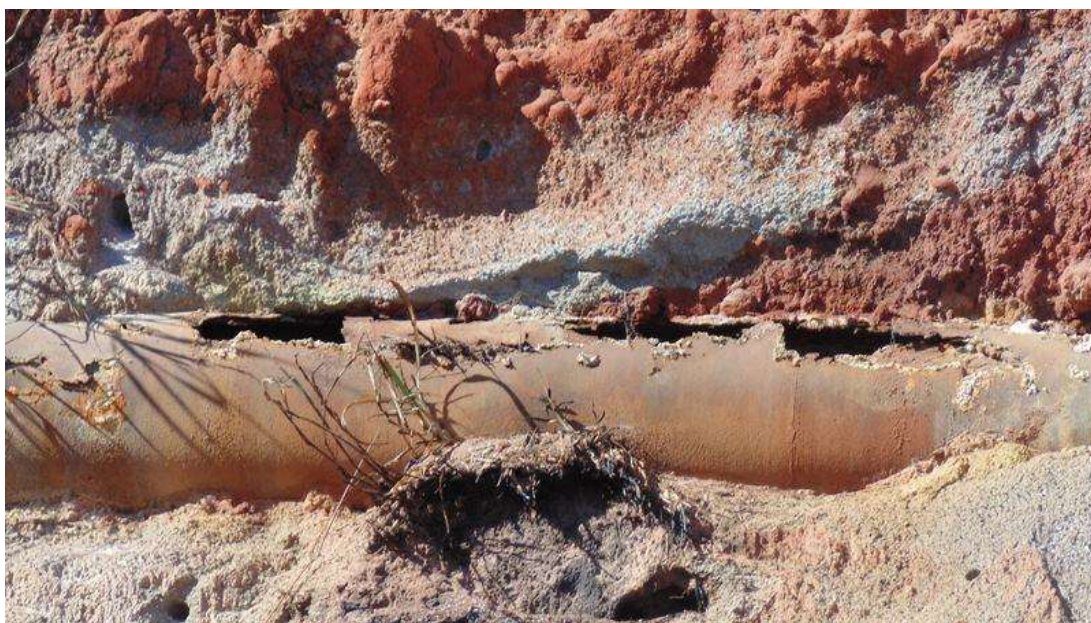
Foto 2 – Corrosão em estado avançado da tubulação de água potável que passa pela lateral da ponte, que não possui pintura protetiva.
