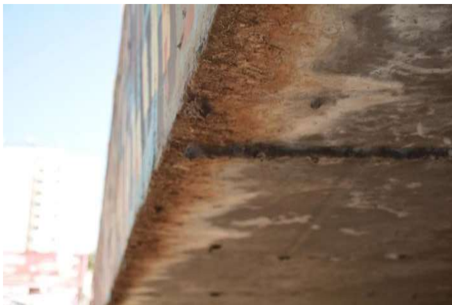
Figura 76 – Indicação de Anomalia:
