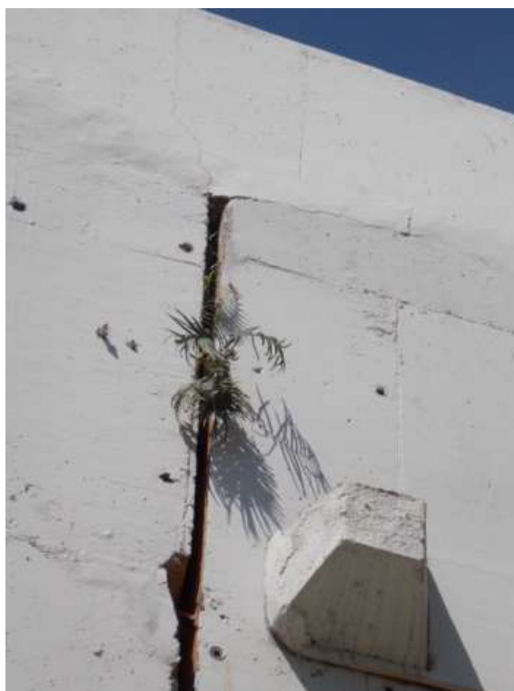
F27/FL –Viaduto Montese, detalhe da junta com presença de gramíneas.
