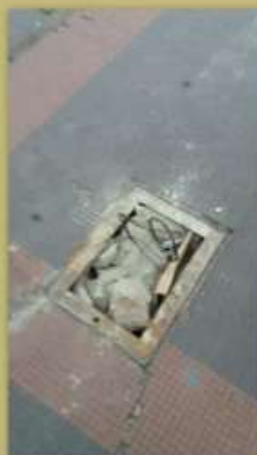
Caixa de Passagem de fiação no piso (sem tampa)
