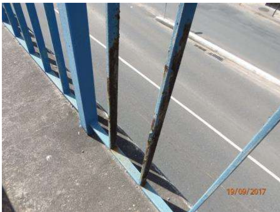
- Guarda corpo em processo de corrosão.
