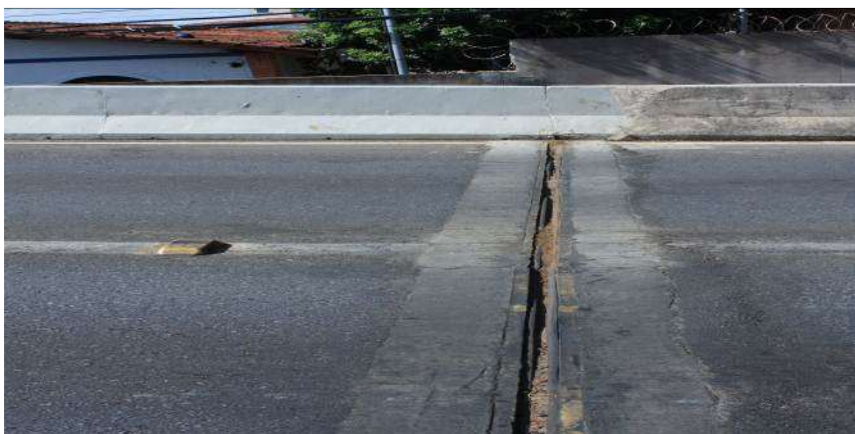
F77/FL – Detalhe junta de dilatação em situação análoga à da fotografia anterior, destacando a descontinuidade nas defensas.
