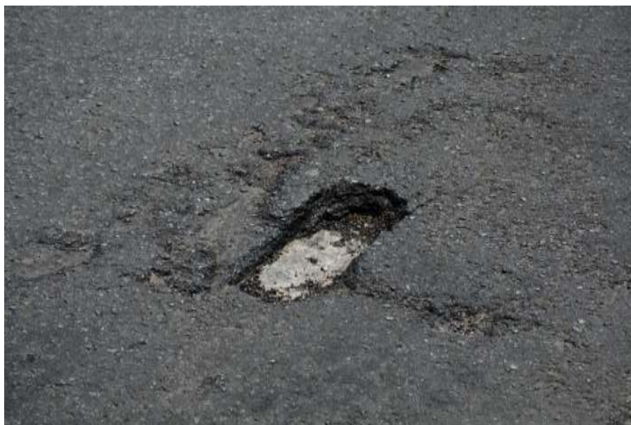
Figura 22 – Indicação de Anomalia:
