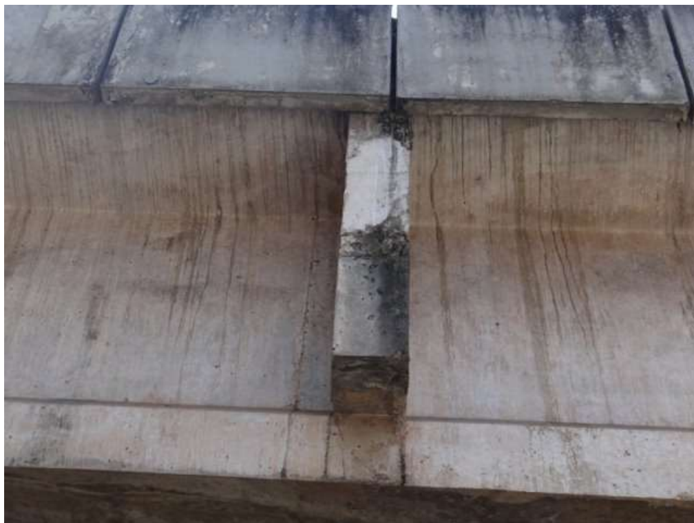
F19/FS – Outro detalhe de eflorescência na lateral do viaduto.
