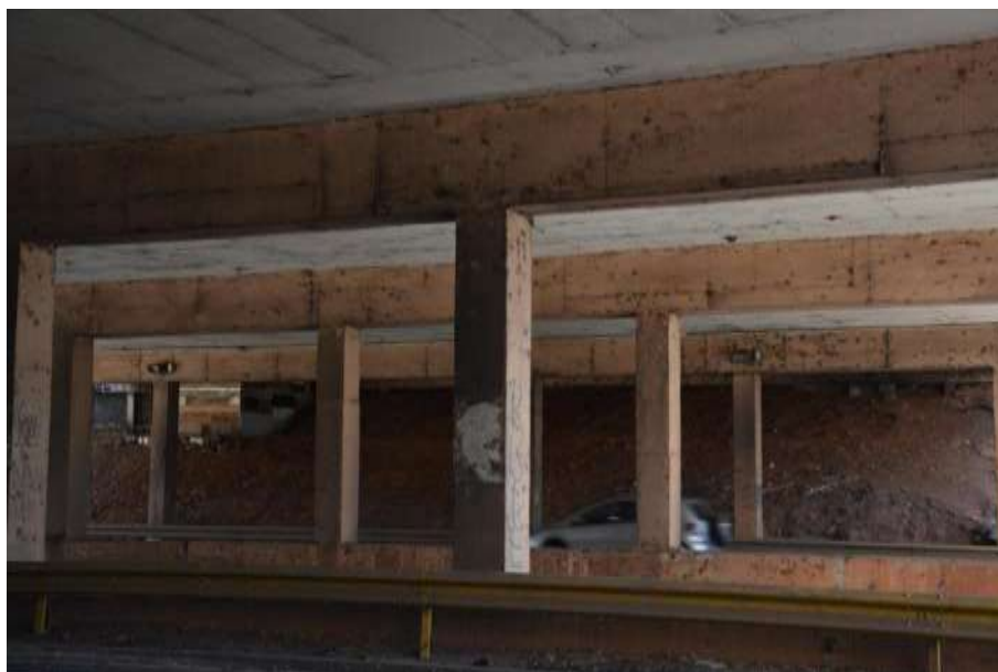
Figura 67 – Indicação de Anomalia:
