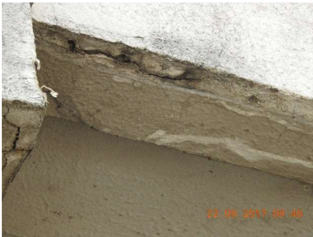
F80/FL – Trincas na base do pilar do guarda corpo e viga.
