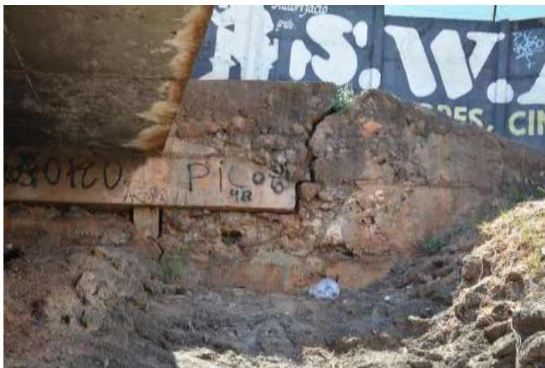
Figura 80 – Indicação de Anomalia:
