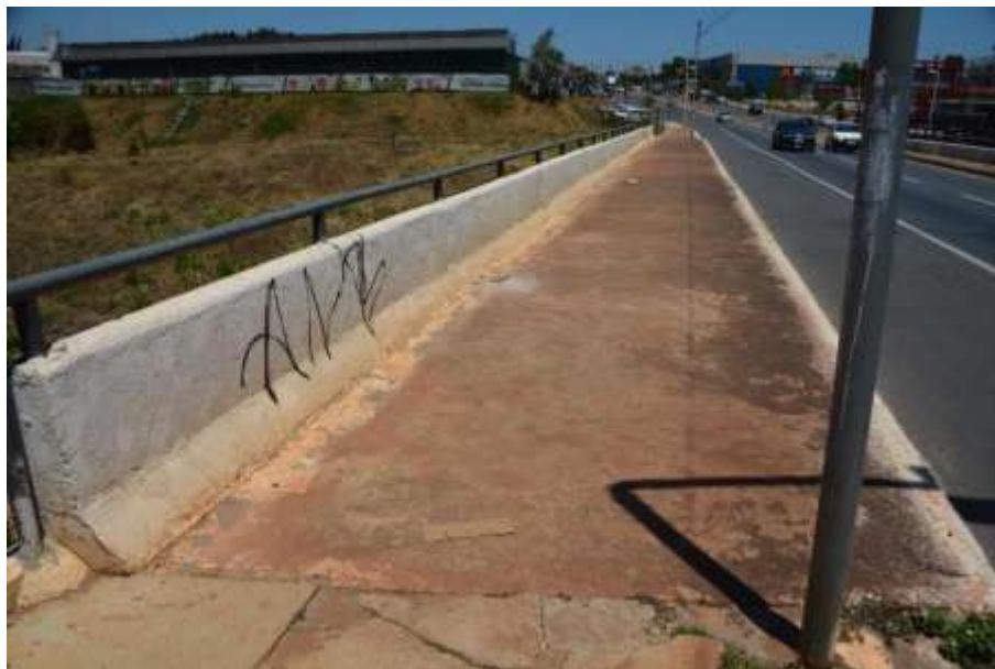
FOTO 49 – Vista de pichação no guarda corpo em um dos pontos da Ponte T-63 sobre o córrego Cascavel visualizado da Avenida T-63 sentido Bairro / Centro.
