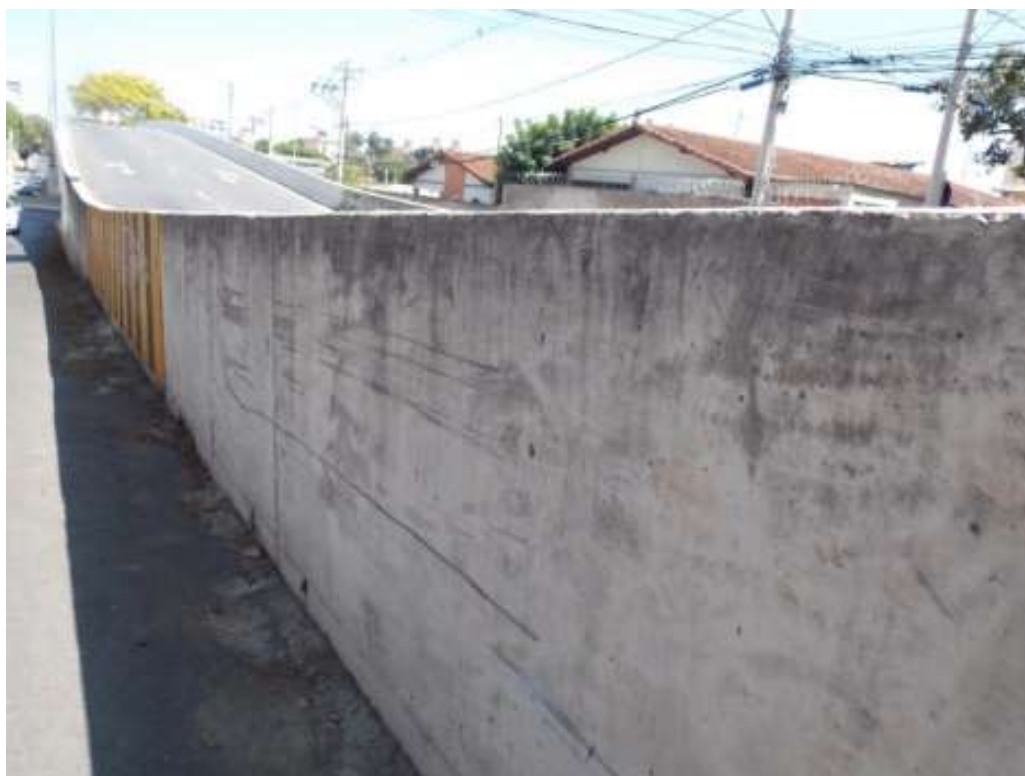
F63/FL – Viaduto Montese, detalhe de marcas de impacto de veículos.
