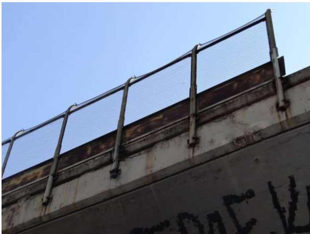
F27/HG – Vista de proteção (para evitar o lançamento de objetos na linha férrea) e guarda corpo do viaduto. Observa-se o processo de corrosão na proteção, deslocamento e armadura exposta na estrutura do viaduto.
