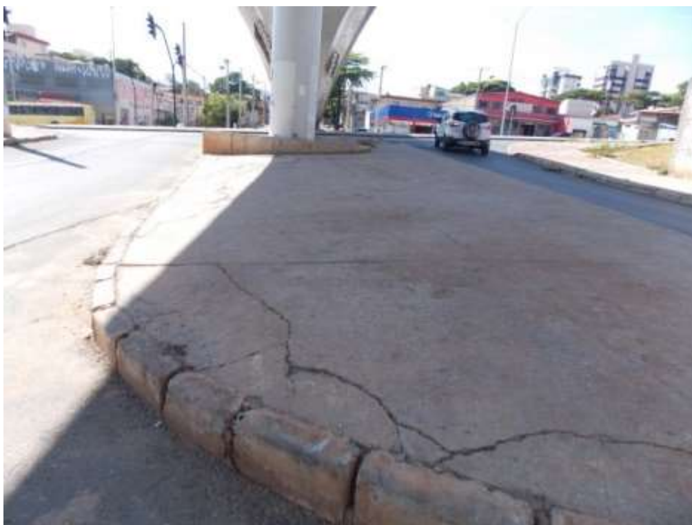
F40/FL –Viaduto Montese, trincas no piso do passeio, no entorno dos pilares).
