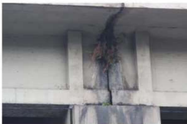
Infiltrações d'água através das juntas de dilatações
