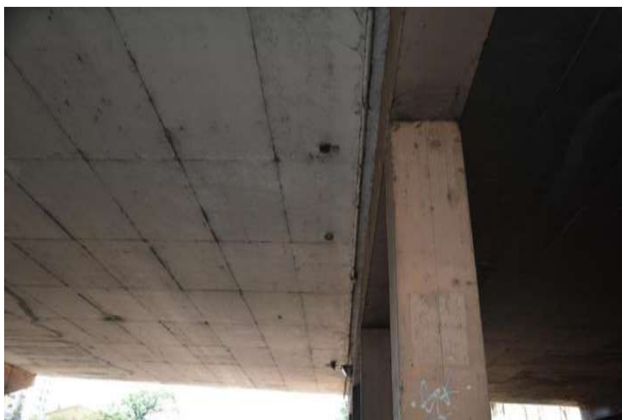
Figura 61 – Indicação de Anomalia:
