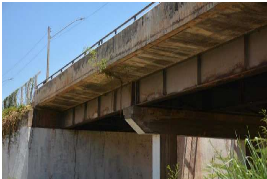
FOTO 33 –Vista de outro ponto do detalhe da lateral da ponte com presença de umidade em diversos pontos. Detalhe de junta de dilatação com excesso de umidade e evidência da falta de manutenção (vegetação).
