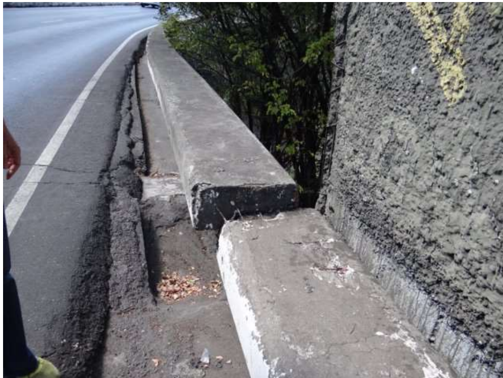
F46/HG – Defesa 1 danificada.
