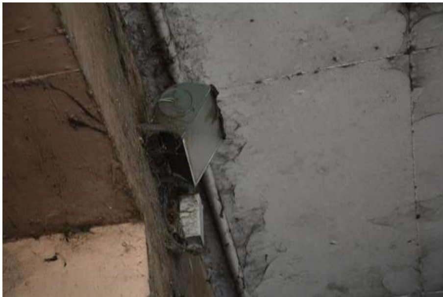
Figura 68 – Indicação de Anomalia:
