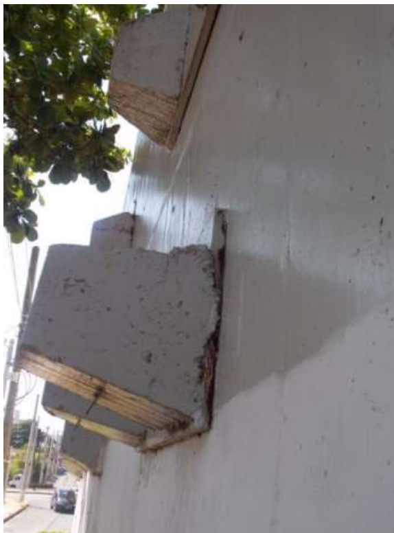
F17/FL –Viaduto Montese, fixação dos tirantes com oxidação.
