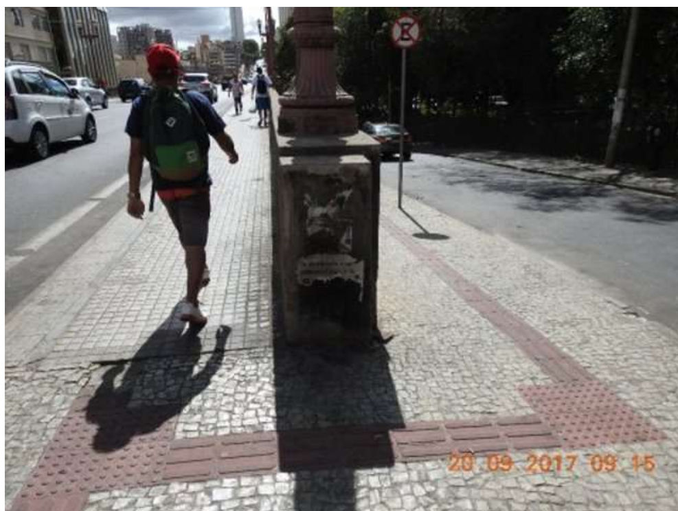
F02/ST – Danos no passeio e falta de padronização do ladrilho hidráulico tátil de direcionamento e alerta. Não prosseguiu no passeio sobre o viaduto.
