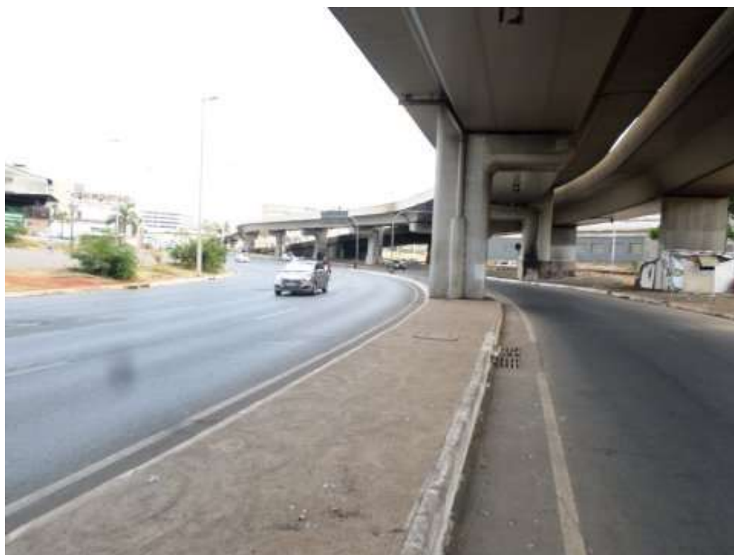
F64/FS – Vista geral da alça para Av. Pres. Antônio Carlos, várias luminárias danificadas.
