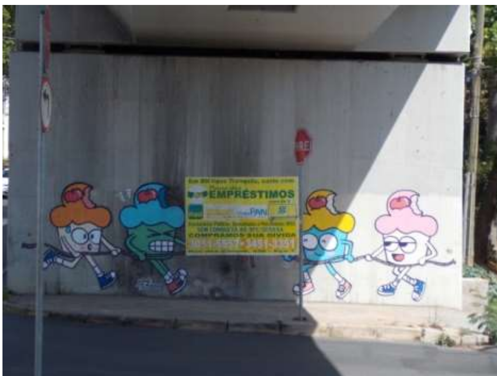
F41/FL –Viaduto Montese, pichações.
