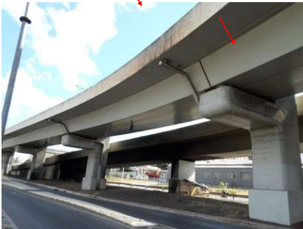
F65/FS – Vista de sinais de manchas de fuligens, a parte inferior apresenta evidências de intervenção de pintura recente.
