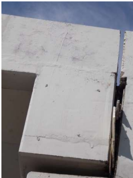
F29/FL –Viaduto Montese, detalhe do deslocamento na região do apoio.
