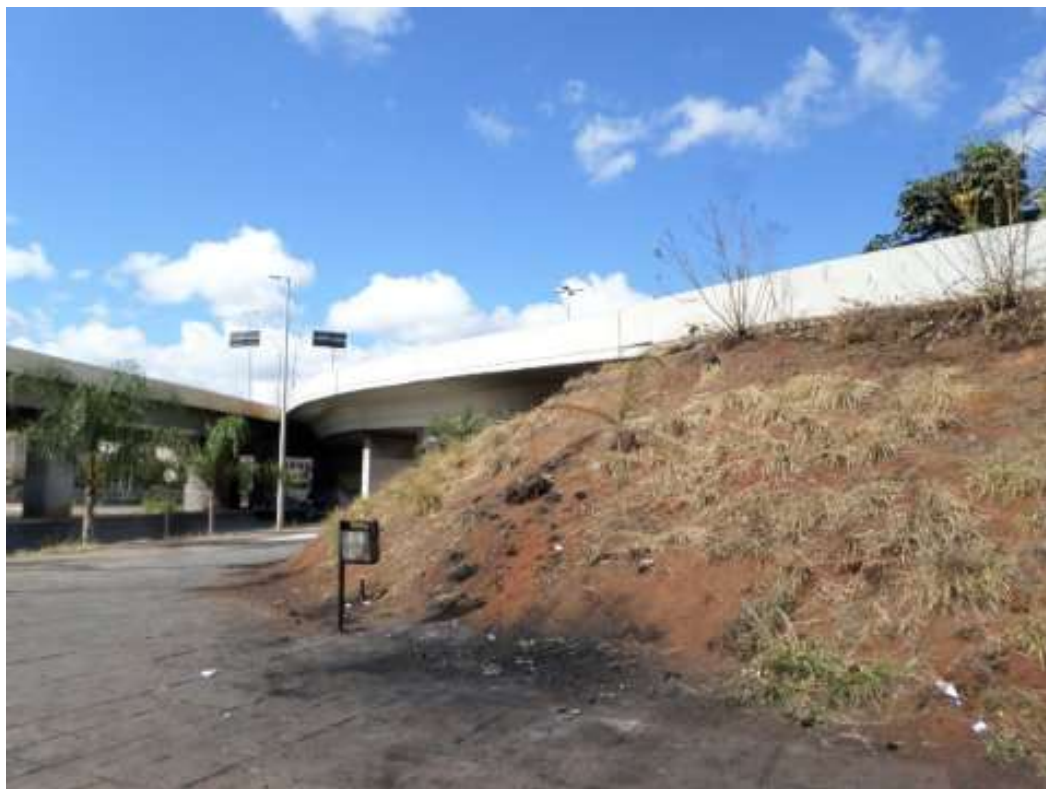
F51/FS – Vista geral das alças mostrando maciço sem tratamento.
