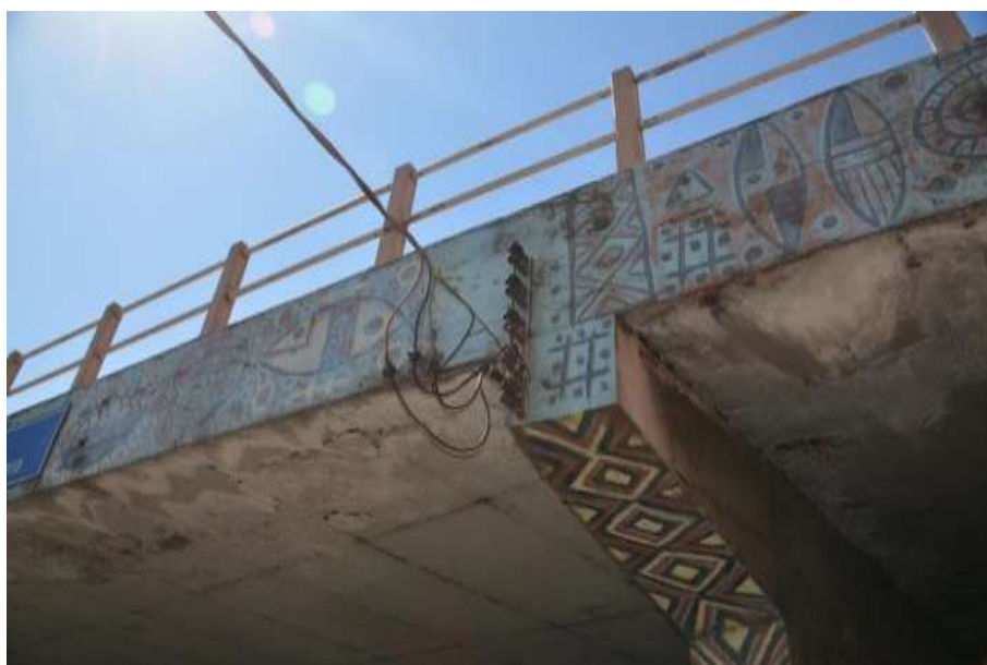
Figura 51 – Indicação de Anomalia: Instalação elétrica antiga, em condições precárias de uso.
