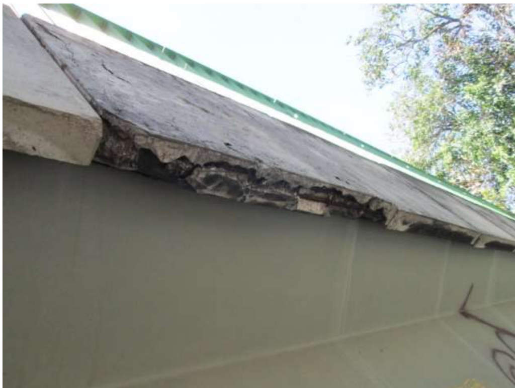
F35/FS – Outro detalhe da ausência de cobrimento, exposição e corrosão de parte da armadura.
