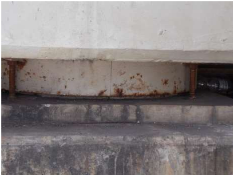
F74/FL – Detalhe do aparelho de apoio (Neoprene) da estrutura do viaduto Montese. Verifica-se oxidação prematura, inclusive dos elementos de fixação.
