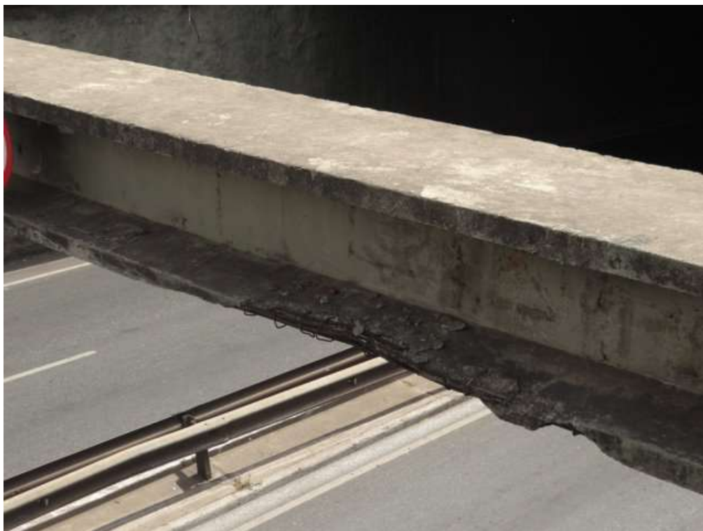
F07/HG – Detalhe da foto anterior com existência de armadura exposta.
