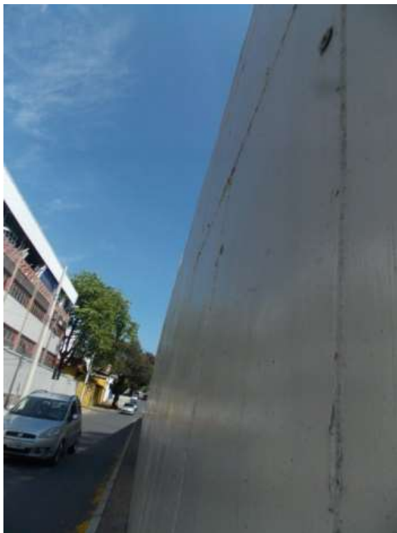
F58/FL – Viaduto Montese, abaulamento na estrutura de contenção do viaduto.
