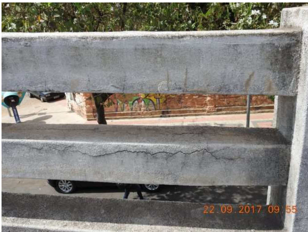
F50/FL – Outro ponto, trinca no recobrimento do guarda corpo.
