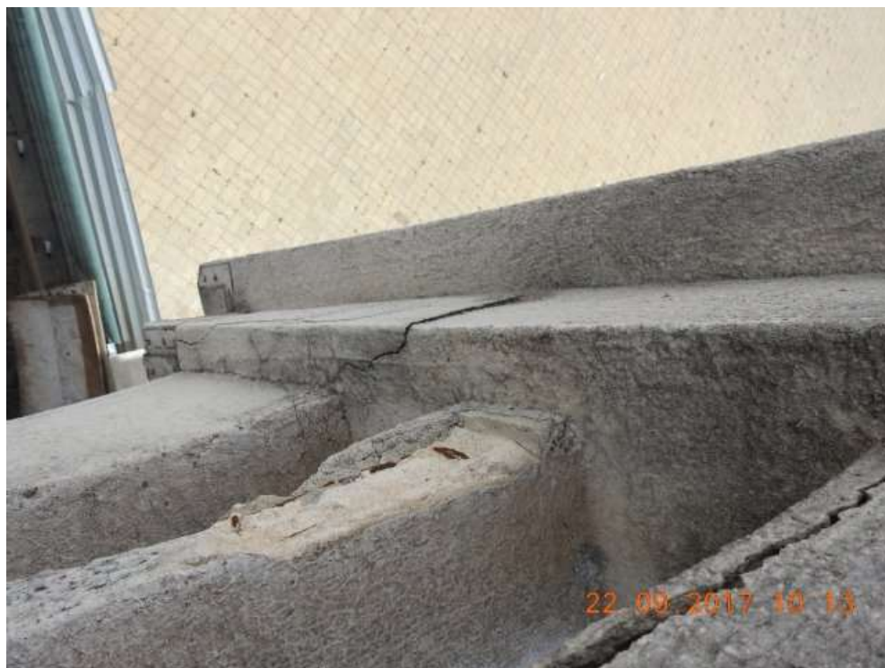
F35/FL – Outro ponto, trincas e início de deslocamento e perda de parte do recobrimento no pilar e no guarda corpo, observa-se que abaixo, local aonde ficam carros estacionados e presença de pedestres.
