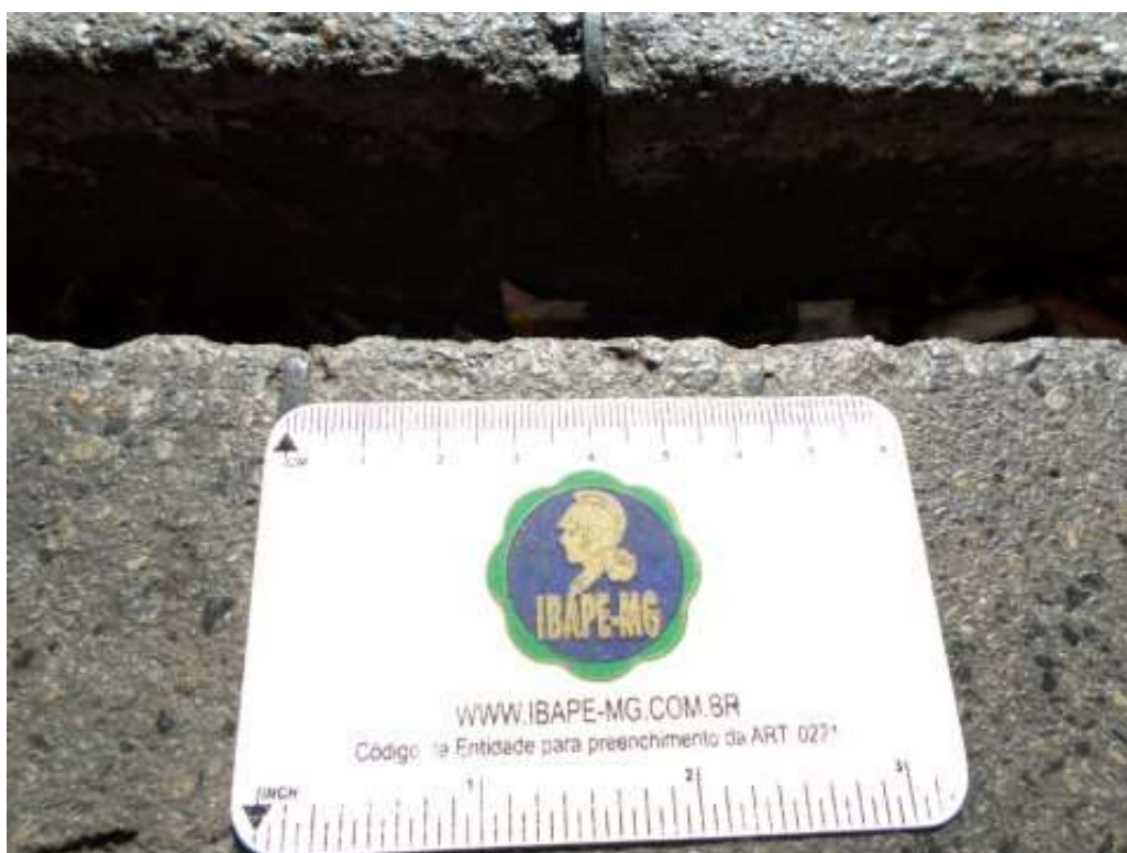
F36/FS – Vista aproximada do deslocamento.
