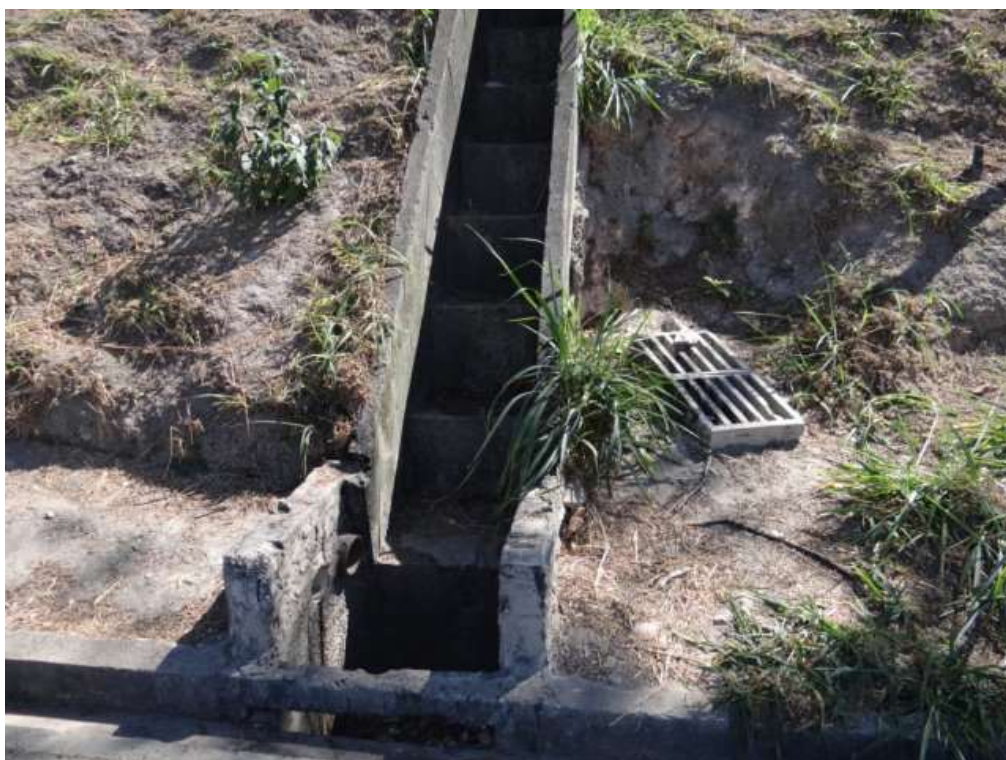
F16/HG – Detalhe de sistema de drenagem que passa sob o passeio, apresenta-se desobstruído, mas sem a tampa.
