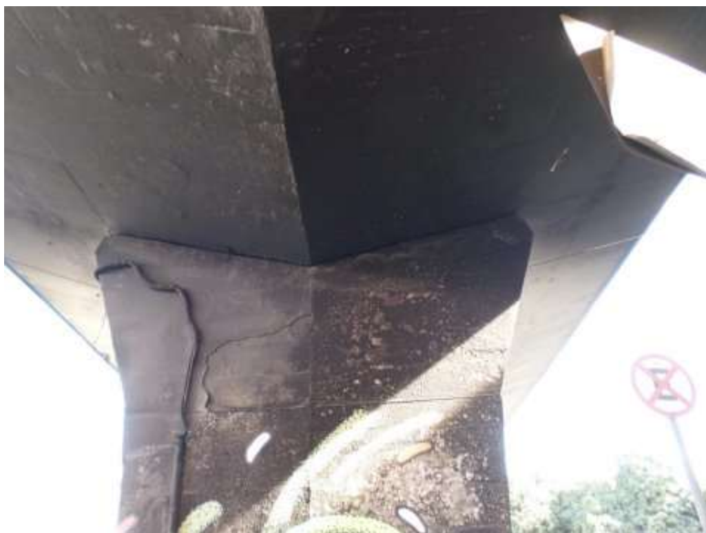
F11/FS – Vista aproximada do pilar mostrando deslocamento.
