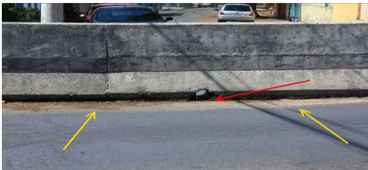
F83/FL – Rampa de acesso do Bairro Itapoã: tubo de drenagem instalado acima do nível dos trechos indicados pelas setas amarelas, propiciando acúmulo e consequente infiltração de efluentes.
