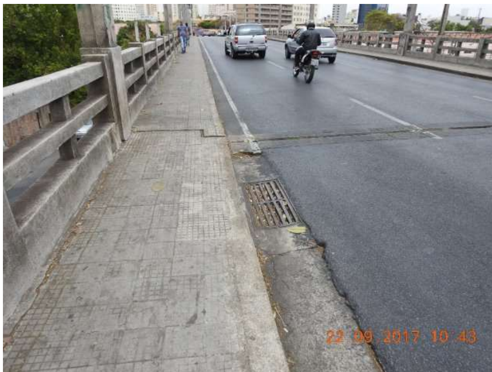
F21/FL – Vista geral do guarda corpo e parte do sistema de drenagem, sujeira, danos na sarjeta e junta.
