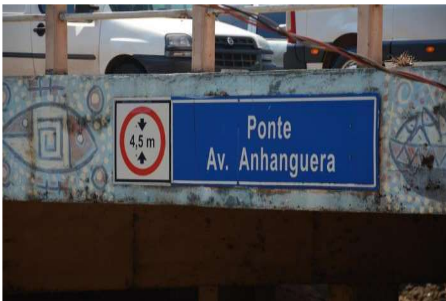
Figura 39 – Indicação de Anomalia:
