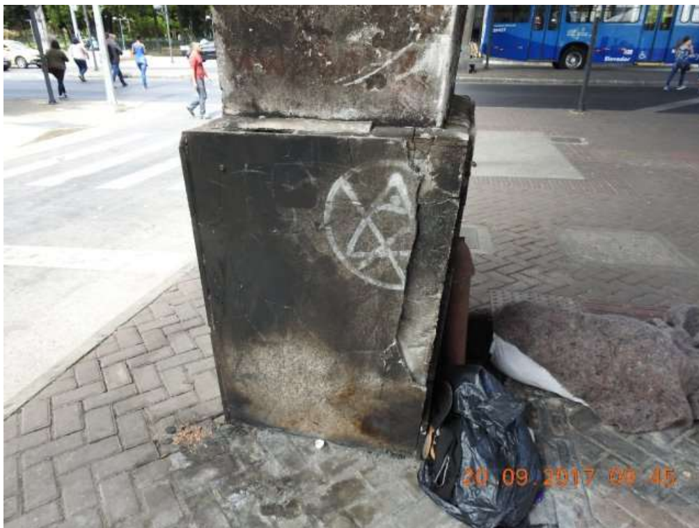
F21/ST – Base dos pilares revestida em granito com cor escura. Notam-se indícios de fogueira.
