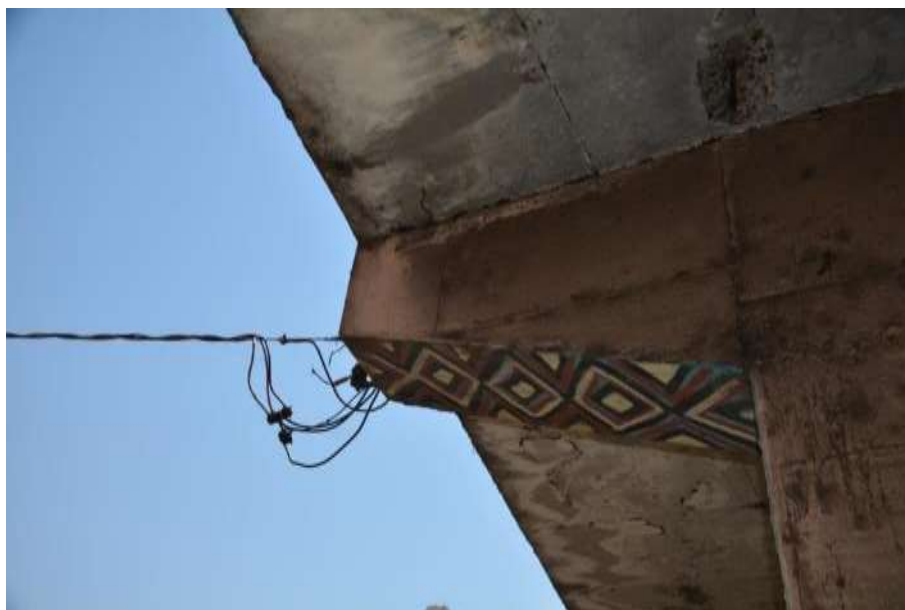
Figura 52 – Indicação de Anomalia:
