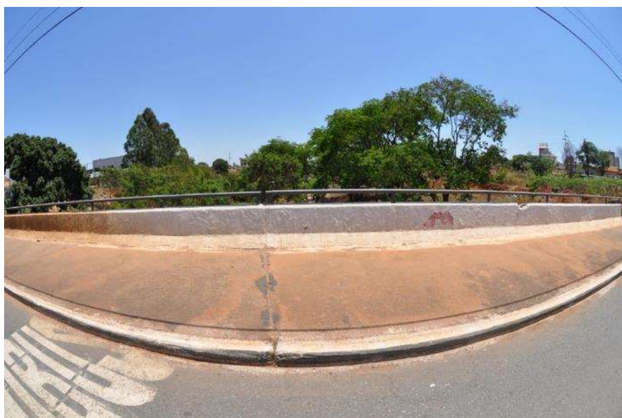
FOTO 12 – Vista da junta de dilatação preenchida com asfalto betuminoso e com rebarba no contrapiso da passagem de pedestre da Ponte T-63 sobre o córrego Cascavel visualizado da Avenida T-63 sentido Centro / Bairro.
