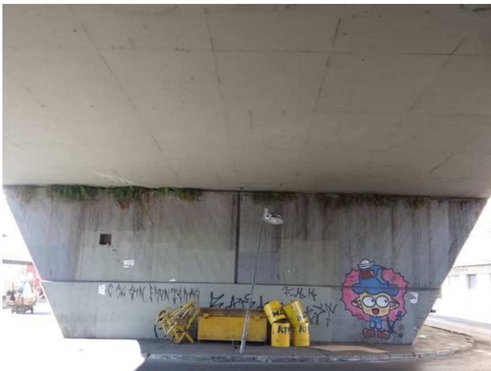
F34/HG – Detalhe de vegetação indicativa de existência de umidade e de falta de manutenção.
