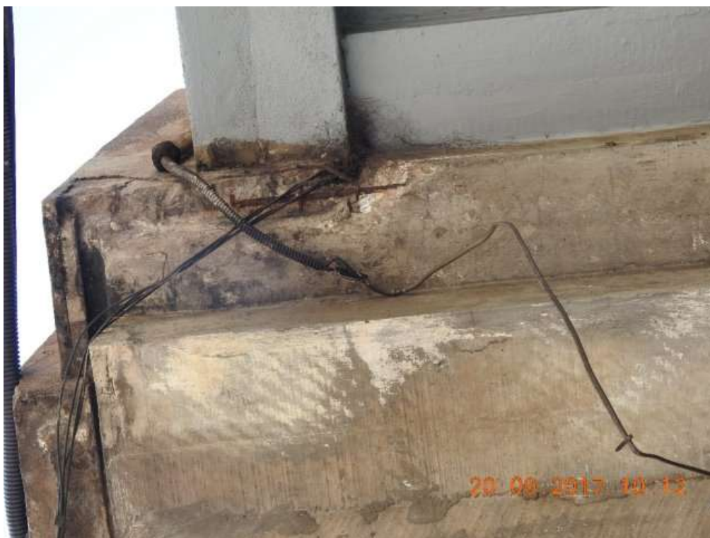
F40/ST – Falta de cobrimento, ferragem exposta em processo de oxidação. Improviso dos condutores de energia.
