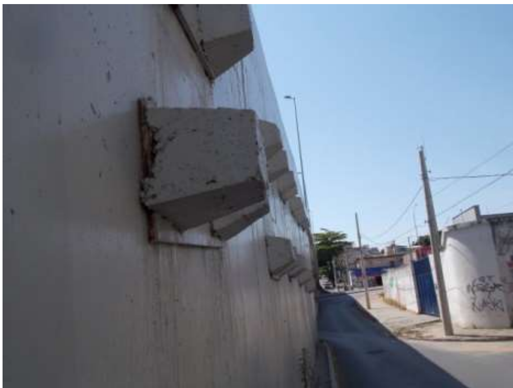
F55/FL – Viaduto Montese, deficiência no prumo dos tirantes. Detalhe para o alinhamento destes.
