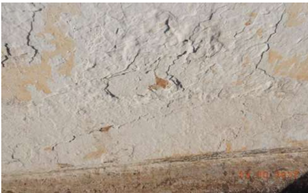
FOTO. 9 – Guarda corpo no passeio da Avenida Fuad José Sebba, com trinca e deslocamento.
