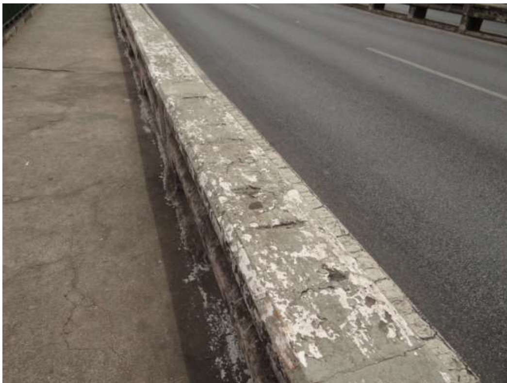
F50/FS – Defesa necessitando reparos.
