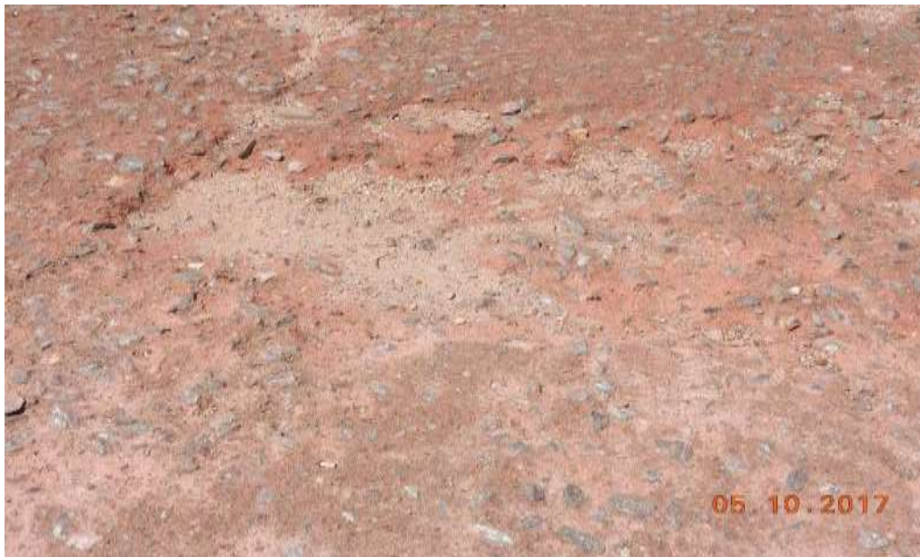
FOTO. 11 – Passeio com pavimento de concreto quebrado, destacando e com depressão na Ilha central da Avenida Universitária.
