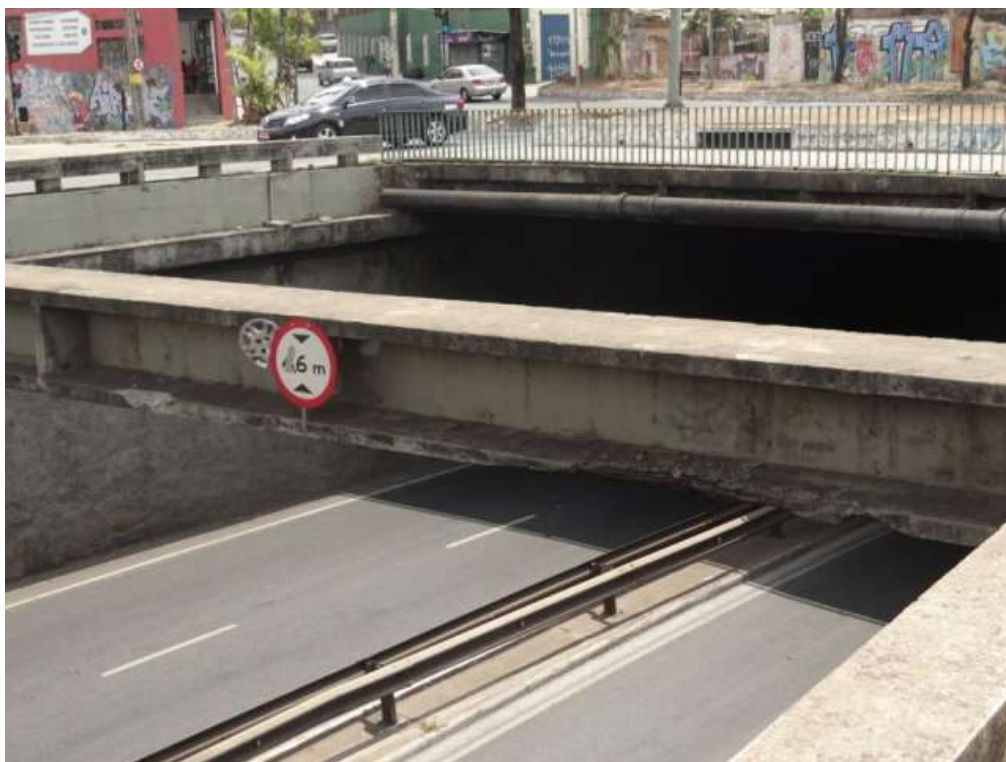
F06/HG – Impacto causado por veículos de maior porte em estrutura.
