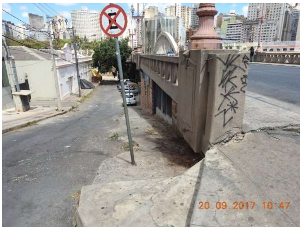
F56/ST – Vista da lateral do viaduto na esquina da Rua Itambé com Avenida Assis Châteaubriant. Danos e falta de padronização no passeio, pichações.
