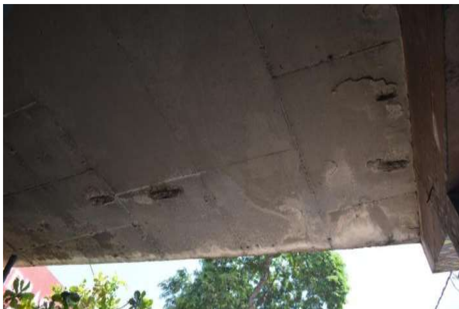
Figura 58 – Indicação de Anomalia:
