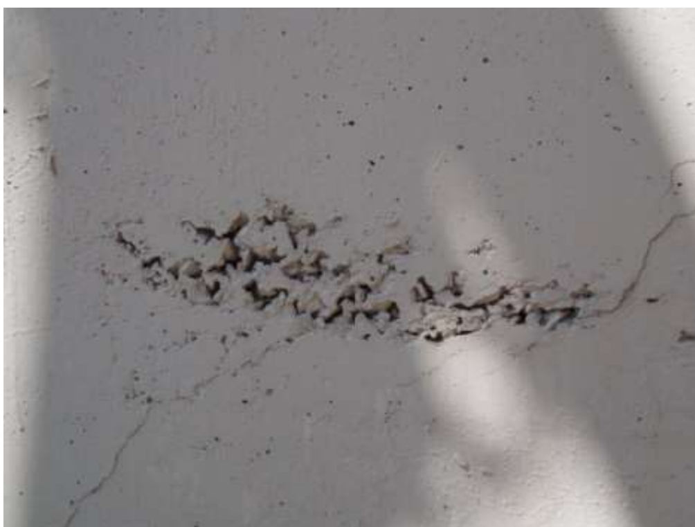
F24/FL –Viaduto Montese, deficiência na concretagem na estrutura de contenção.
