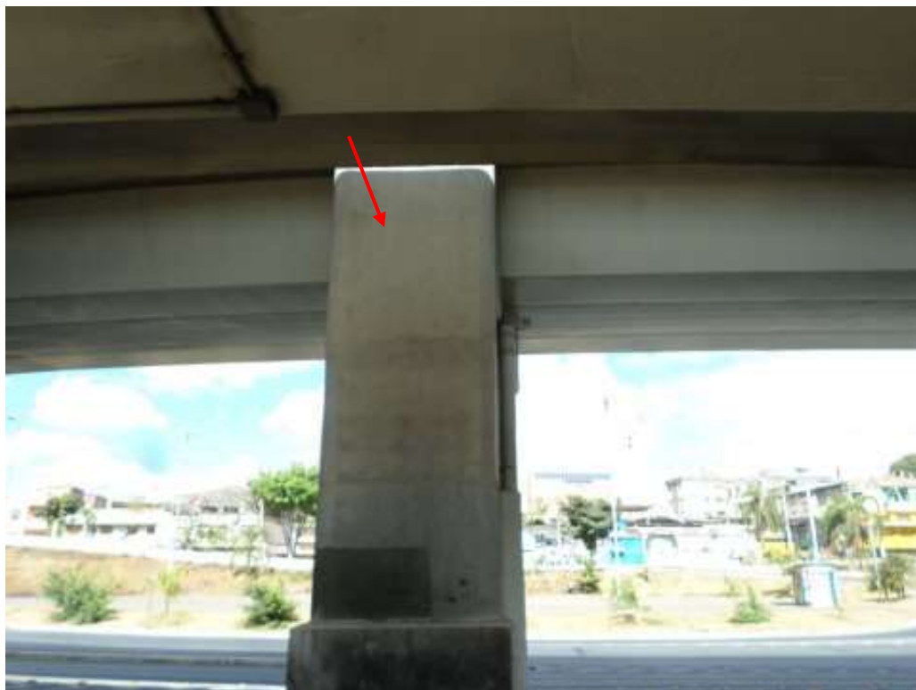
F67/FS – Vista da trinca horizontal no pilar.
