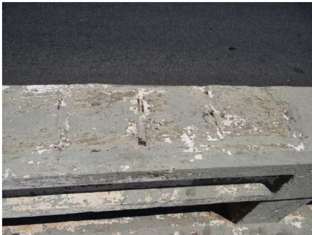
F51/FS – Detalhe de defesa com armadura exposta.
