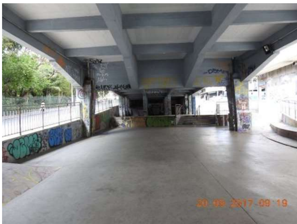
F04/ST – Espaço revitalizado na parte inferior do viaduto. Notam-se pichações.
