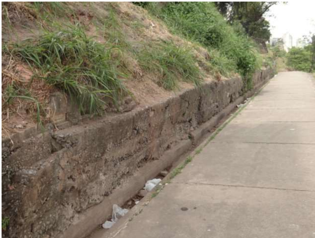
F15/HG – Detalhe de contenção lateral do passeio com inclinação importante. Canaleta de drenagem com acúmulo de lixo.
