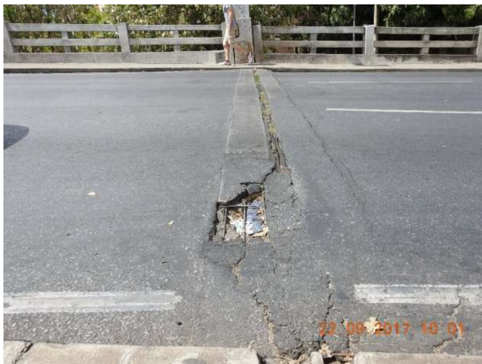
F45/FL – Trincas e necessidade de recomposição da pavimentação, próximo a junta da outra cabeceira do viaduto, no Complexo da Praça da Estação.
