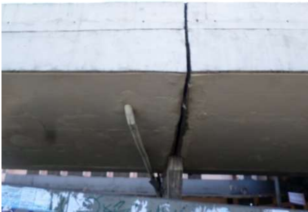
F29/FS – Vista da junta de dilatação com manchas de infiltrações e alguns deslocamento.
