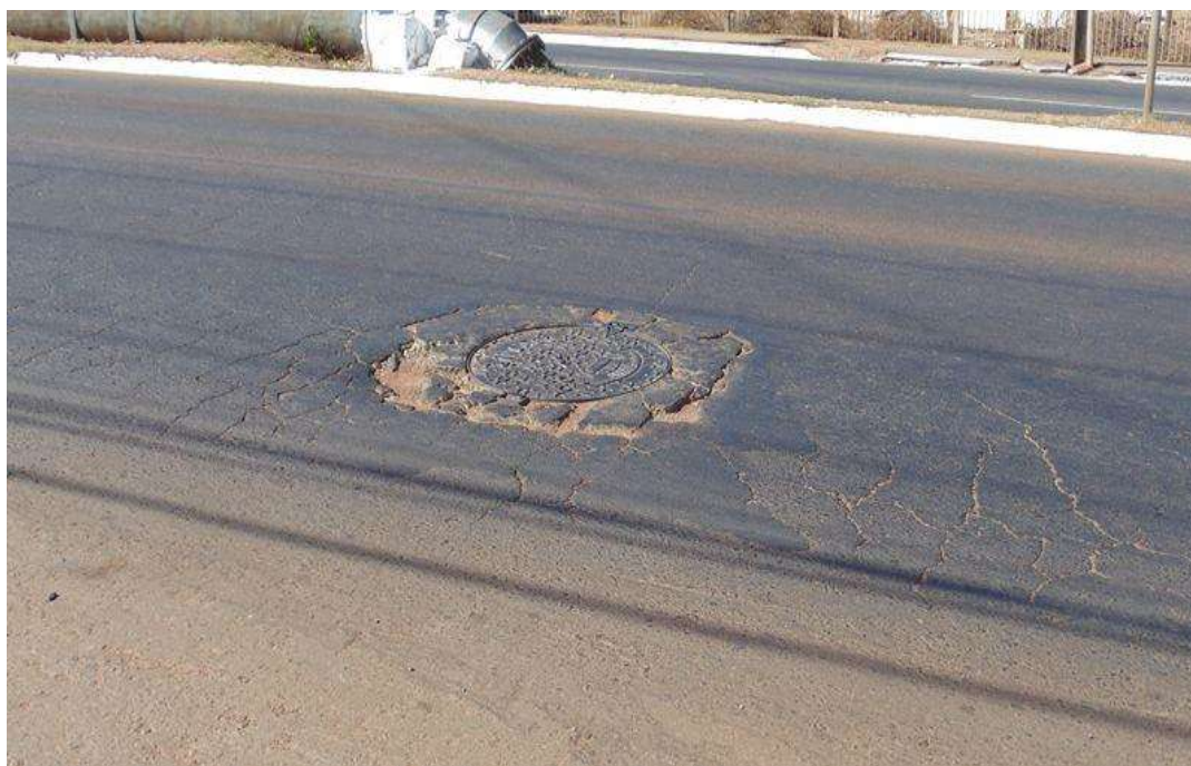
Foto 11 – Trincas e buracos no pavimento.
