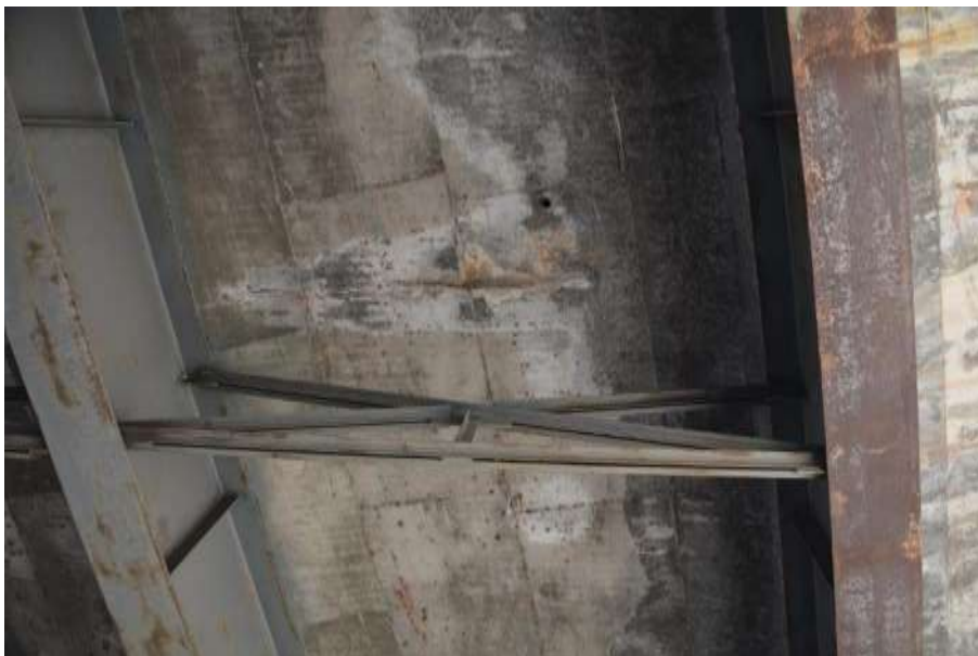
FOTO 25 – Vista da presença de umidade, já com comprometimento do recobrimento da armadura (aço).
