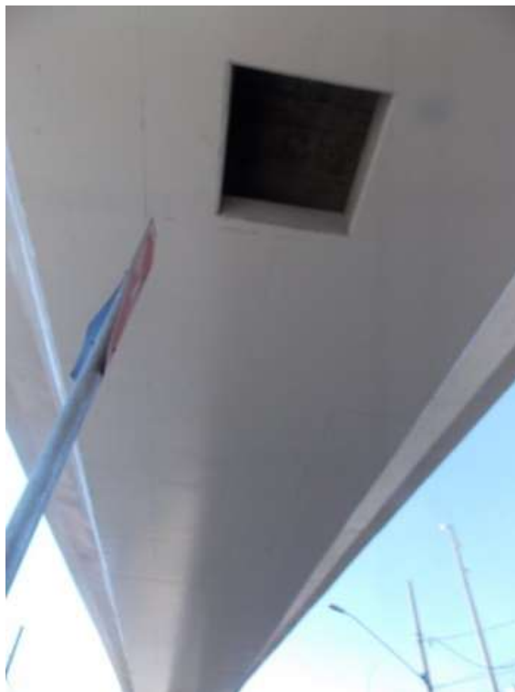
F38/FL –Viaduto Montese, seção inferior do tabuleiro. Ausência de vedação da escotilha de acesso ao caixão perdido.
