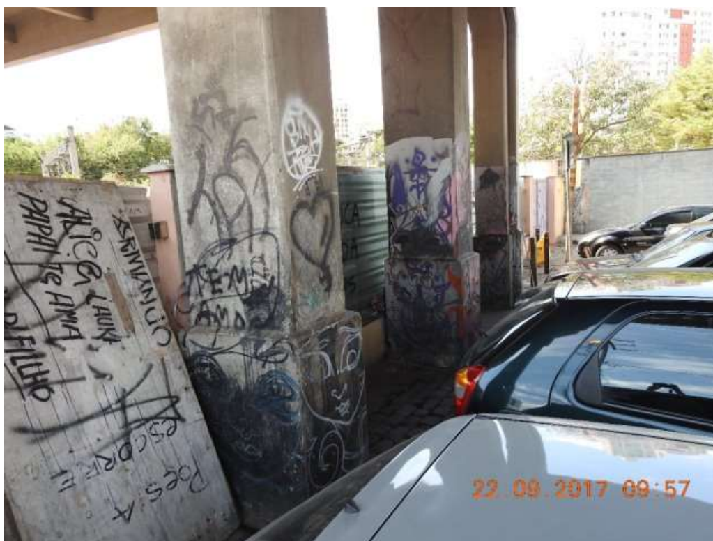
F82/FL – Vista dos pilares, trincas, pichações.
