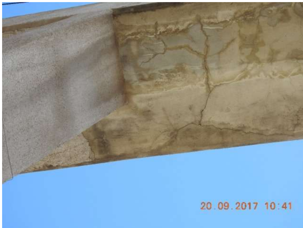
F55/ST – Detalhe das trincas da foto anterior.
