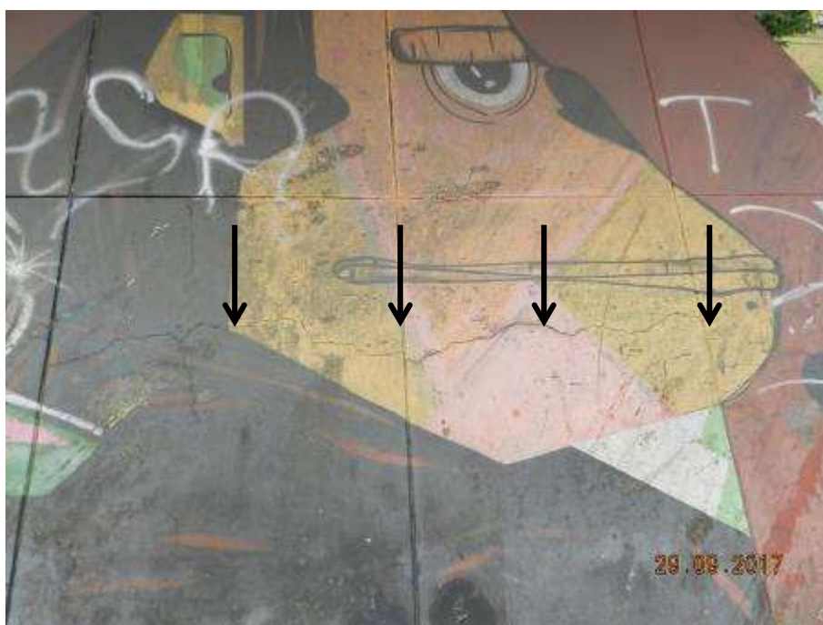
- Trincas na parede da contenção.
