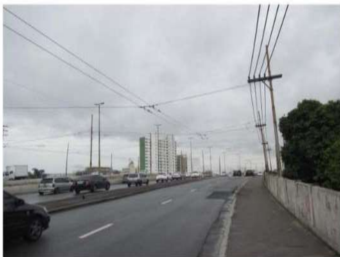
Poste inclinado para dentro da pista
