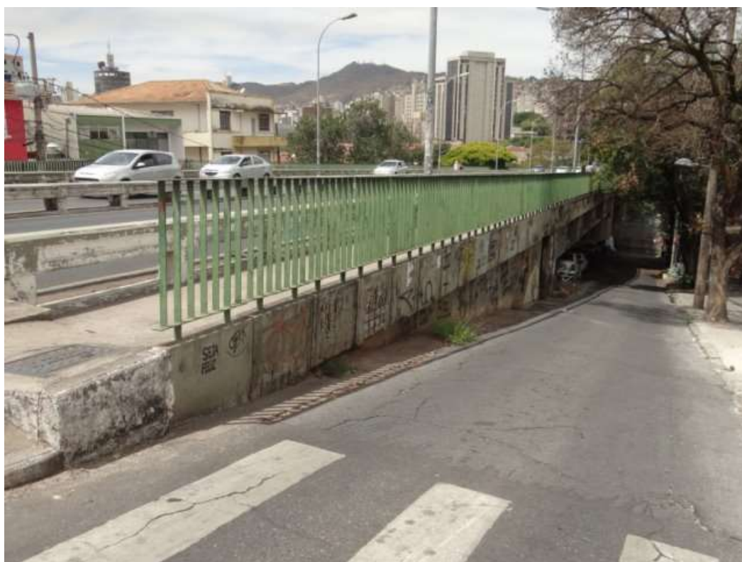
F38/FS – Vista lateral do viaduto bairro Floresta. Detalhe das pichações em toda a sua extensão.
