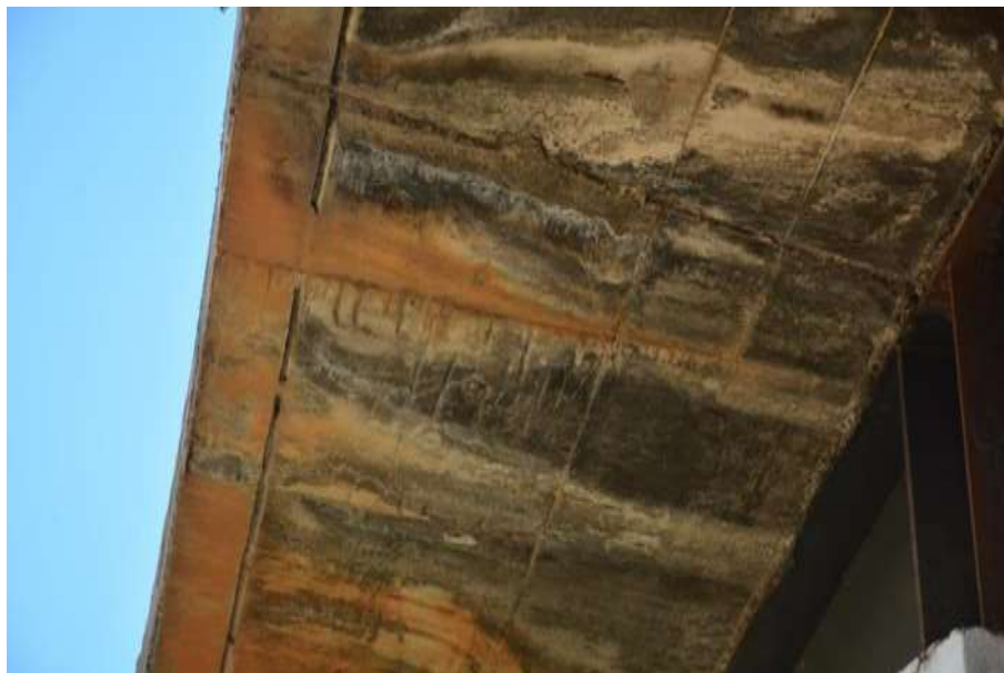
FOTO 32 – Vista de outro ângulo da presença de umidade no balanço da parte inferior da superestrutura (tabuleiro), na pista da Ponte T-63 sobre o córrego Cascavel visualizado da Avenida T-63 sentido Bairro / Centro.
