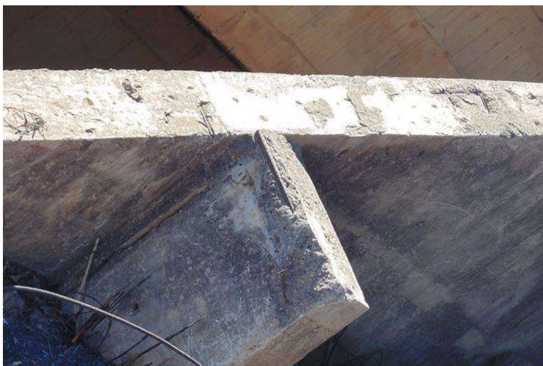
Foto 5 – Cobrimento da armadura insuficiente.
