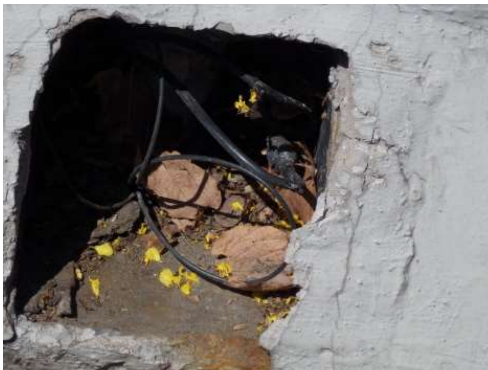
F79/FL – Nicho sob a projeção de um dos postes de iluminação com depósito de materiais diversos, fiação desorganizada e com emendas susceptíveis a ação de intempéries e ausência de elemento de vedação.
