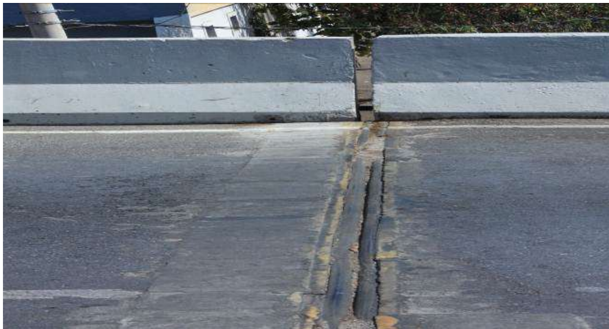
F76/FL – Detalhe junta de dilatação com material acumulado e desgaste do sistema.
