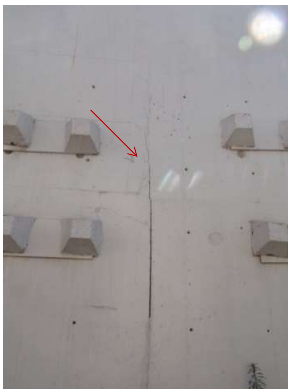
F52/FL – Viaduto Montese, deficiência na junta.
