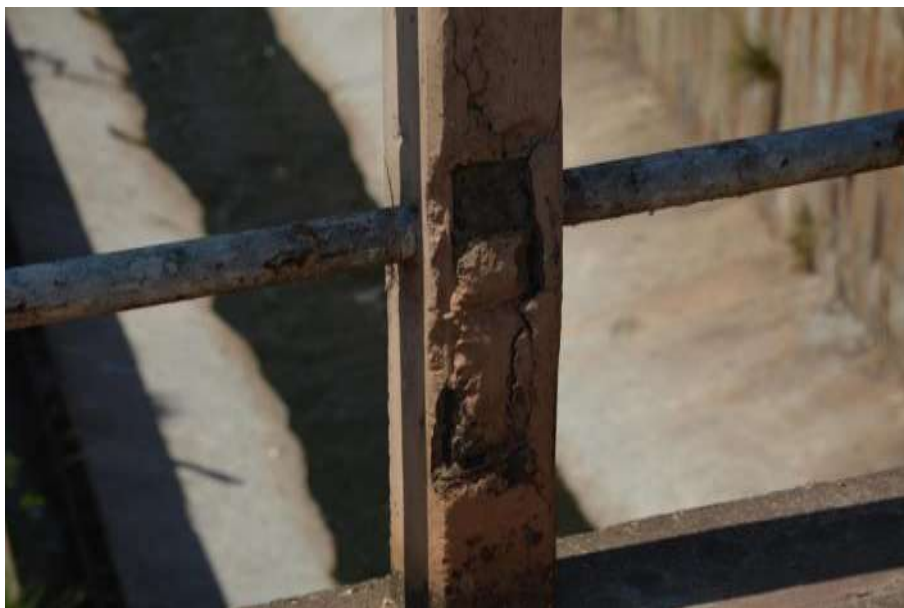
Figura 26 – Indicação de Anomalia:
