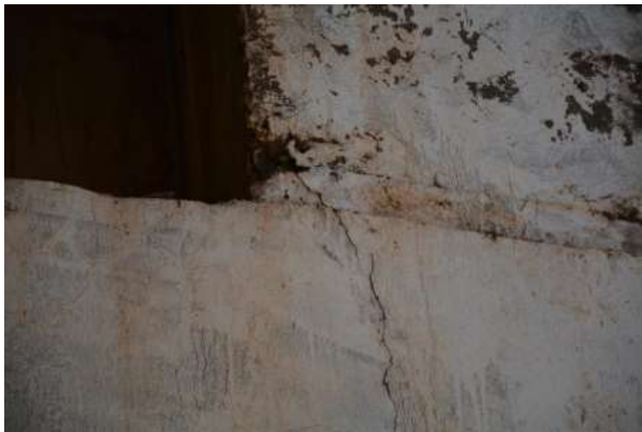
FOTO 57 – Vista aproximada da trinca na estrutura de contenção do aterro da cabeceira da ponte na Ponte T-63 sobre o córrego Cascavel visualizado da Avenida T-63 sentido Centro / Bairro
