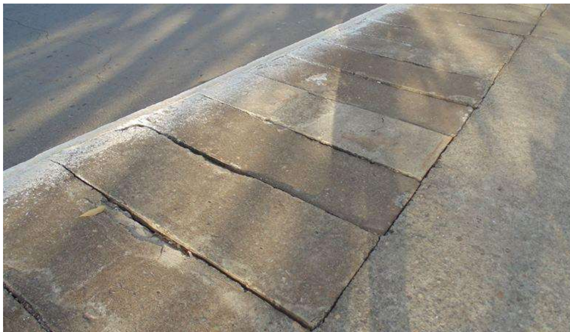
Foto 8 – Revestimento do passeio se soltando.
