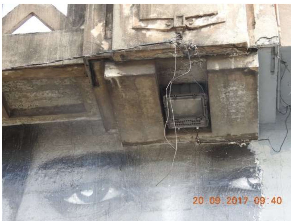
F20/ST – Mostra a lateral do viaduto, deslocamento e parte elétrica improvisada.
