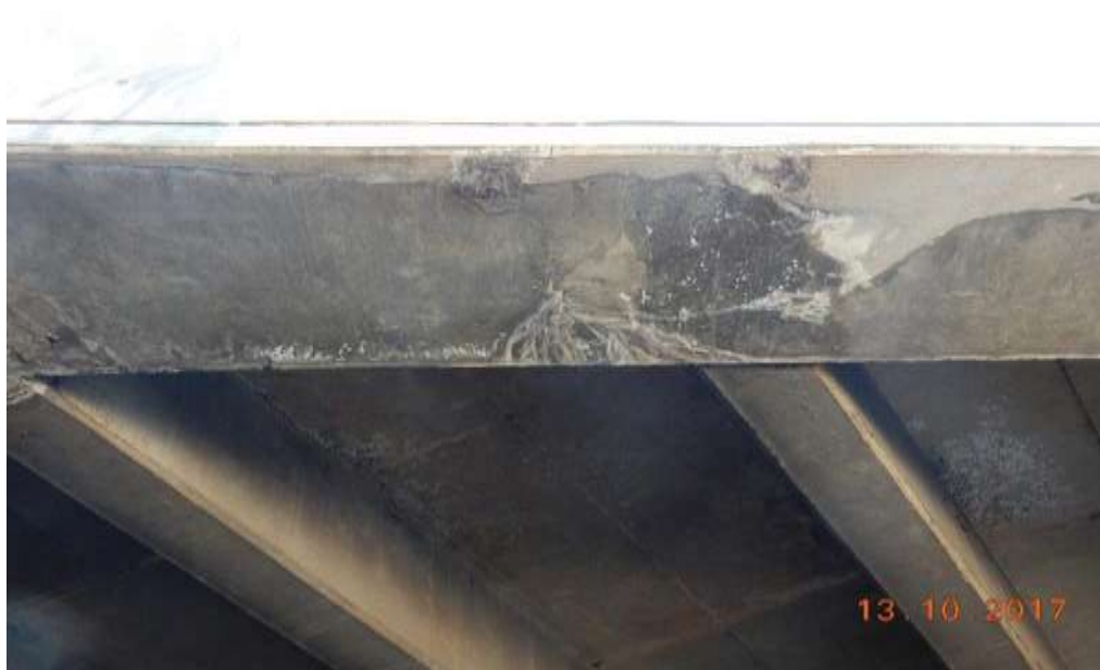
FOTO. 13 – Eflorescência na viga da ponte e guarda corpo, vista pela Marginal Botafogo.
