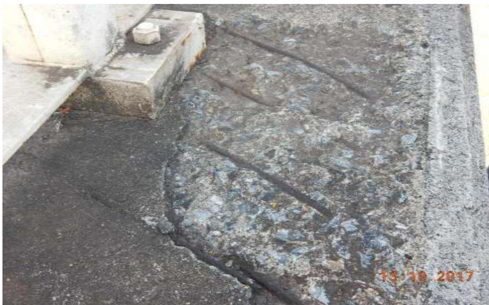
FOTO. 10 – Guarda corpo no passeio da Avenida Fuad José Sebba com deslocamento do revestimento de concreto e ferragem exposta.
