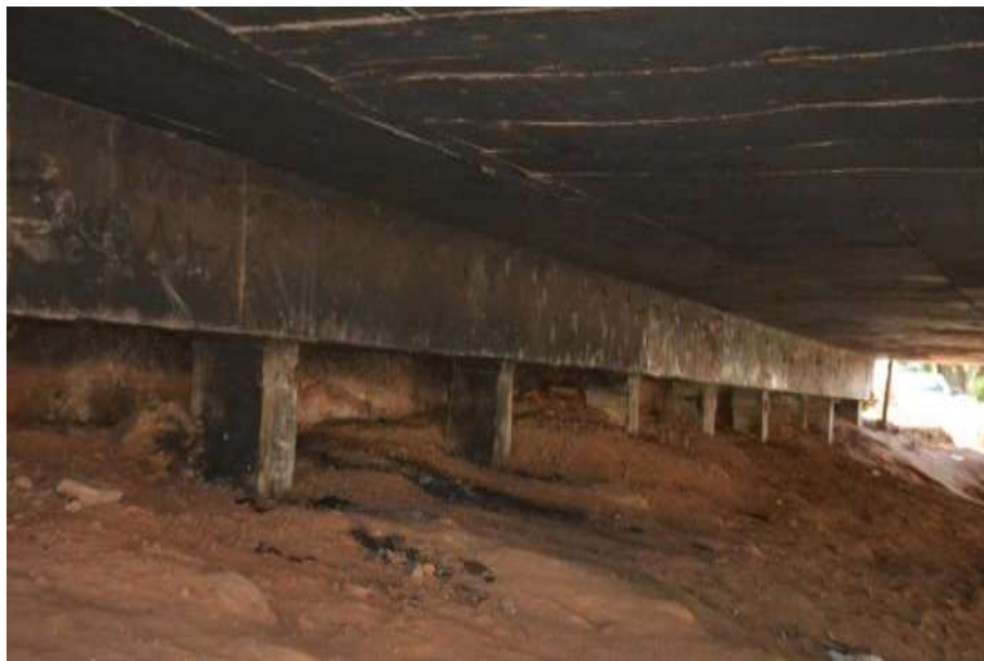
Figura 128 – Indicação de Anomalia:
