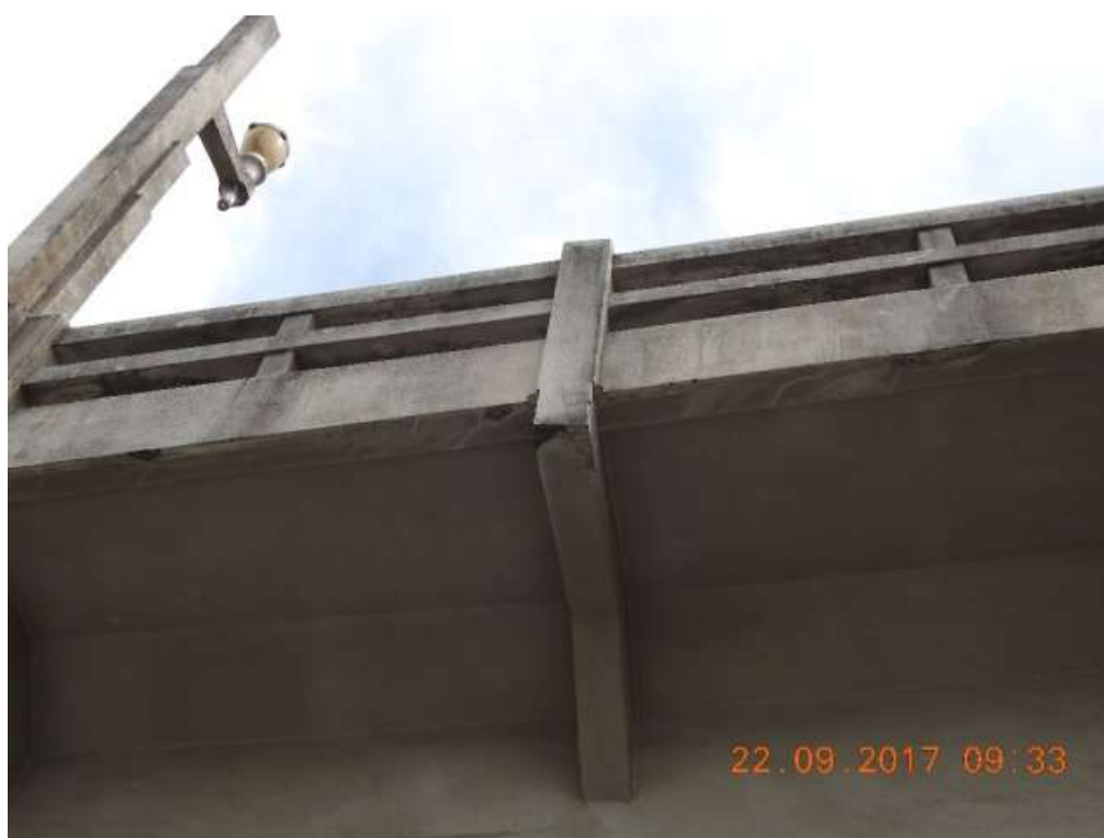
F54/FL – Lateral do viaduto e do guarda corpo visualizado da rua, deslocamento e perda de parte do recobrimento na base do pilar, neste ponto fluxo de veículos e pedestres.
