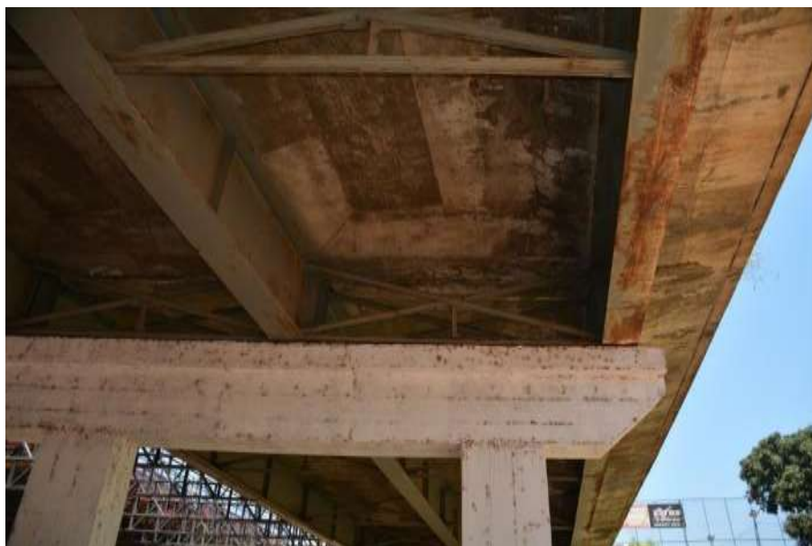
FOTO 27 – Vista da presença de umidade na parte inferior da junta de dilatação da superestrutura (tabuleiro), já com comprometimento do recobrimento da armadura (aço).
