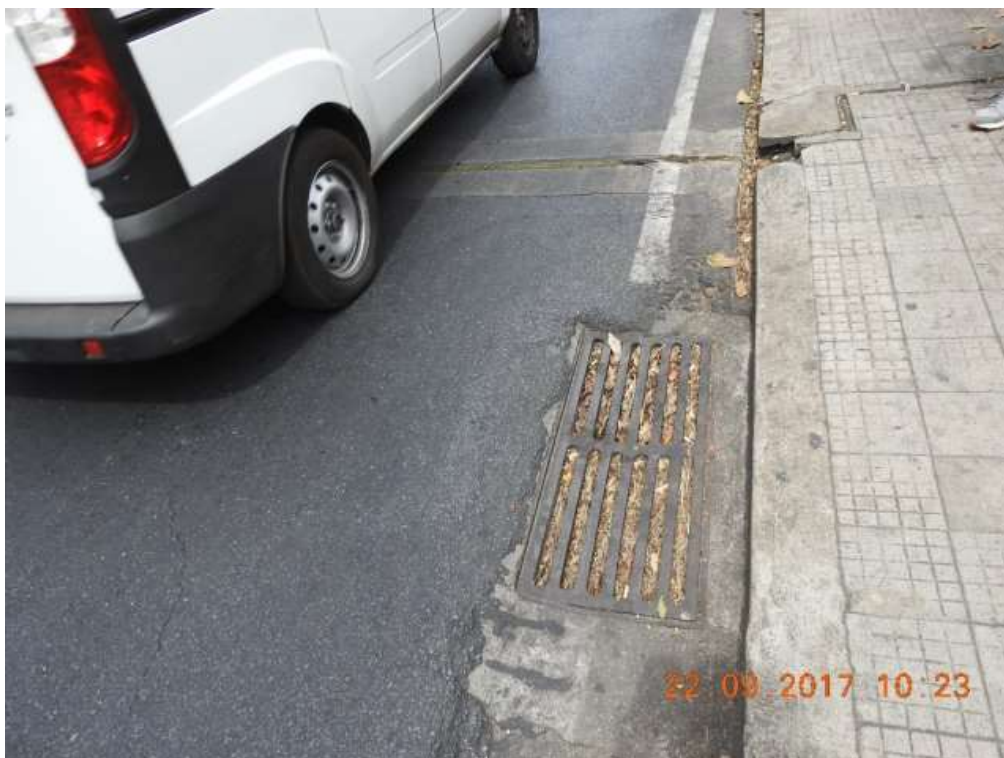
F23/FL – Detalhe sistema de drenagem com excesso de sujeira, indica falta de manutenção, dano no meio fio a direita.
