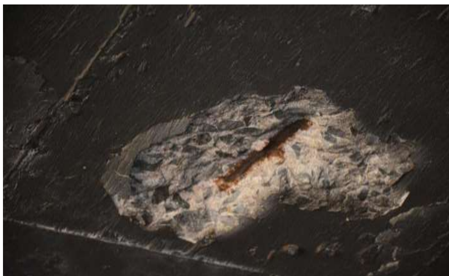
Figura 123 – Indicação de Anomalia:
