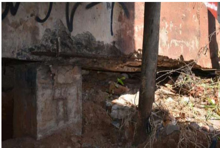
Figura 132 – Indicação de Anomalia:
