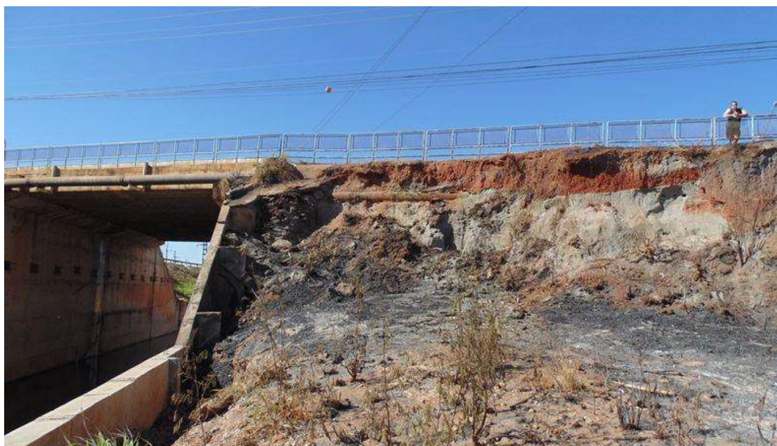
Foto 3 – Infiltração, causando processo erosivo nos taludes das cabeceiras à jusante.
