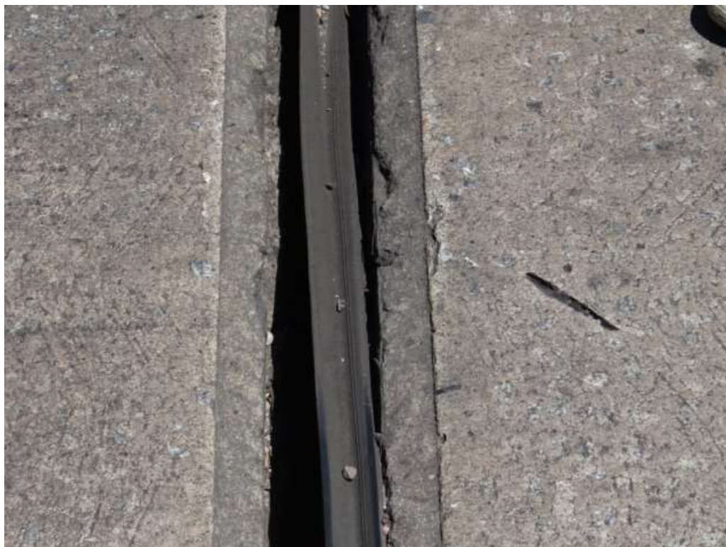
F47/FS – Detalhe de sistema de impermeabilização, em outro ponto de junta de dilatação, com vida útil ultrapassada.
