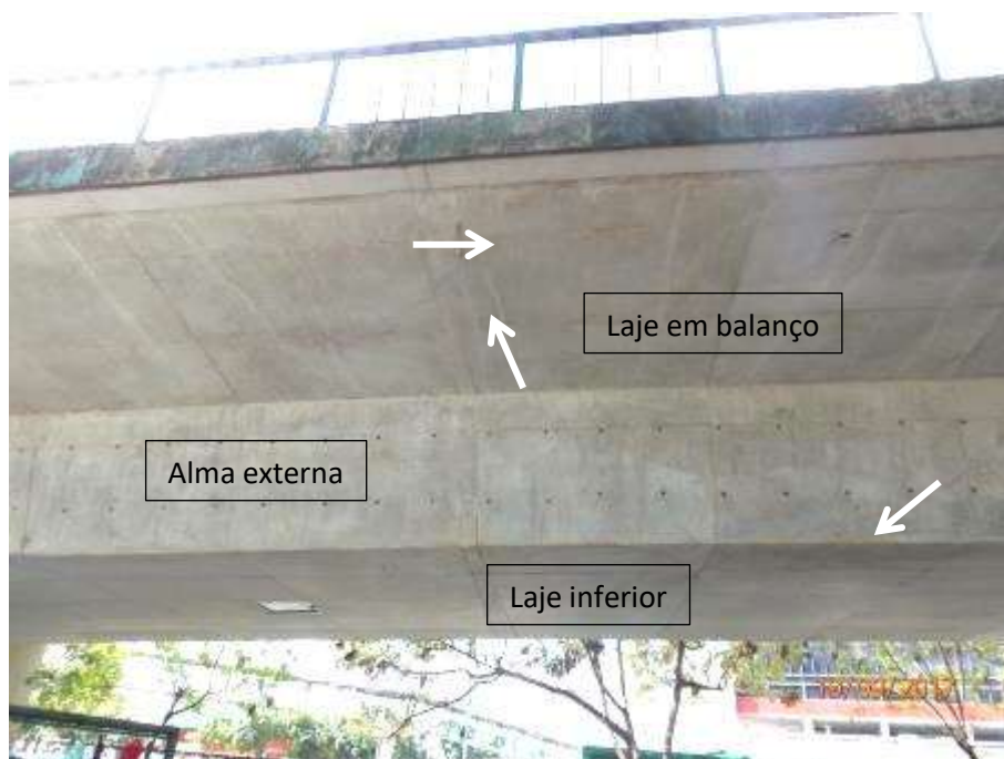
- Trincas e sinais de infiltração.
