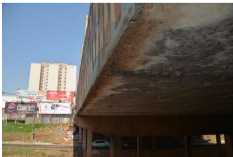
Figura 75 – Indicação de Anomalia:
