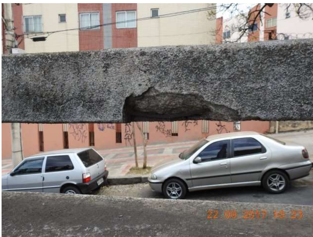
F24/FL – Desprendimento e perda de parte do revestimento, e oxidação da ferragem no guarda-corpo, nota-se que abaixo existe fluxo de veículos e pedestres.
