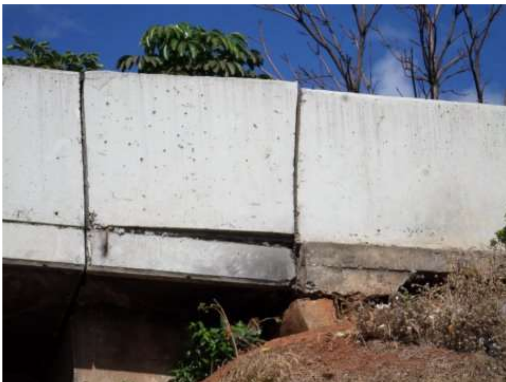
F50/FS – Vista aproximada do mesmo deslocamento da defesa ( Guard rail )
