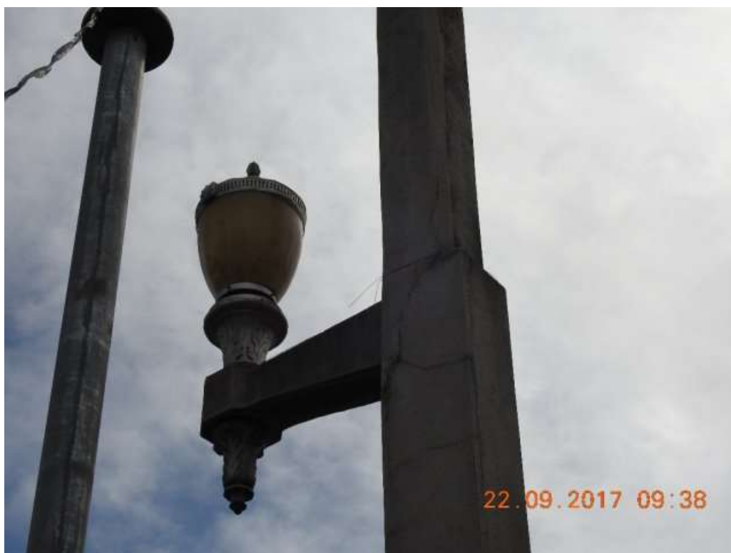
F64/FL – Trincas no poste de sustentação das luminárias do sistema de iluminação.
