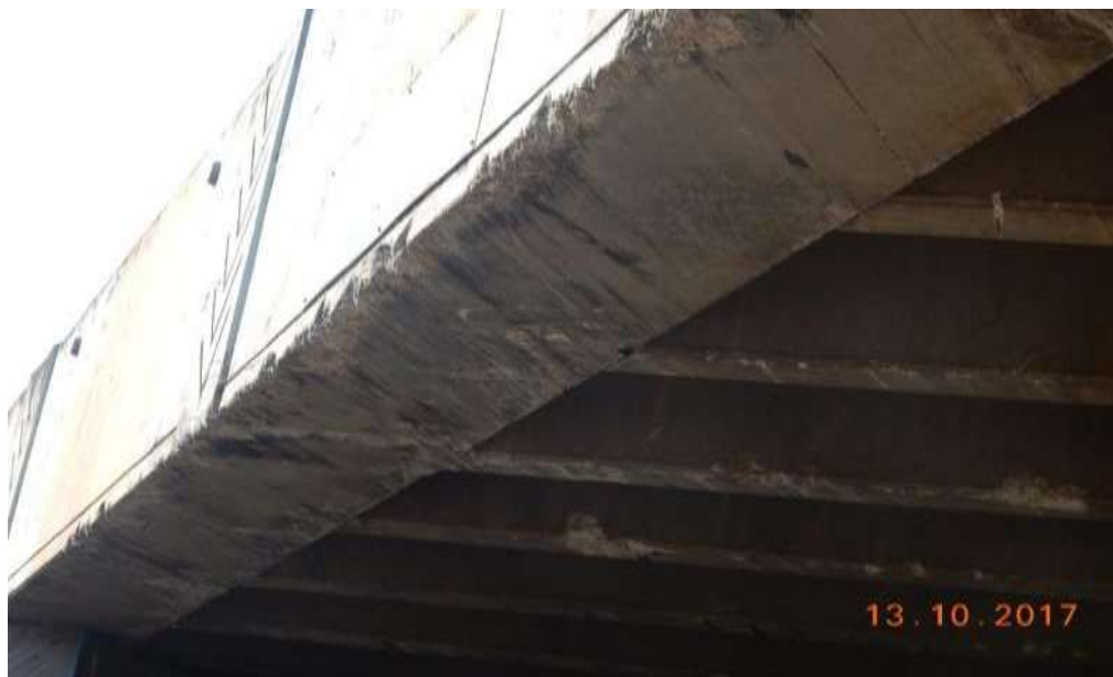
FOTO. 18 – Viga longitudinal da cabeceira 01, concreto com quebrado (consequência da deficiência da sinalização vertical).
