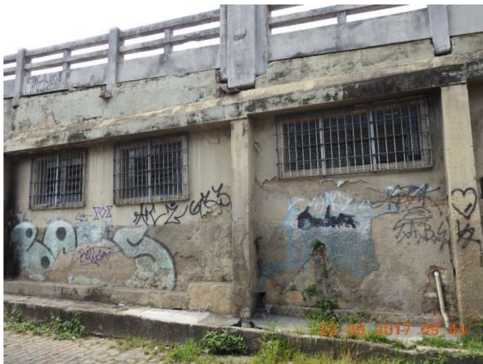
F75/FL – Outra vista parcial da lateral do viaduto e do local utilizado pela SLU, infiltrações, deterioração de total do recobrimento, presença de vegetação, improvisação no sistema de drenagem, danos no passeio.
