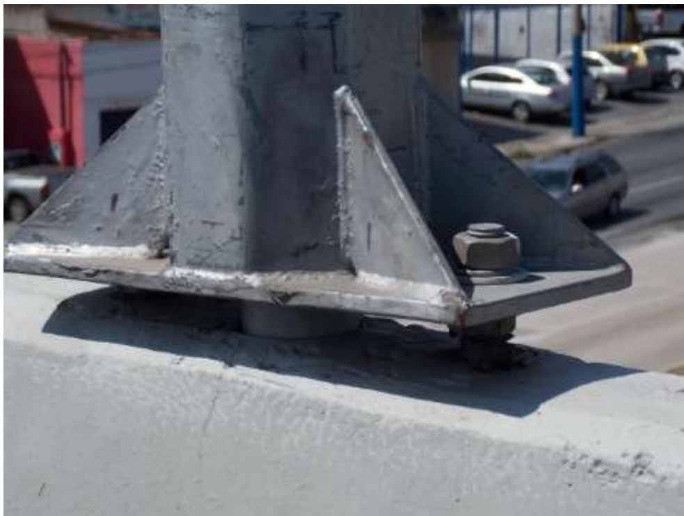
F78/FL – Base de poste de iluminação com apoio inadequado, com diversos pontos que permitem a infiltração de efluentes.
