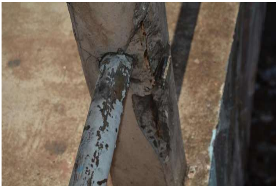
Figura 17 – Indicação de Anomalia:
