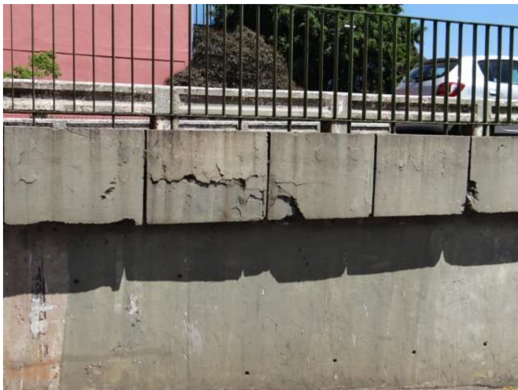
F24/FS – Detalhe do deslocamento do cobrimento na lateral do viaduto.
