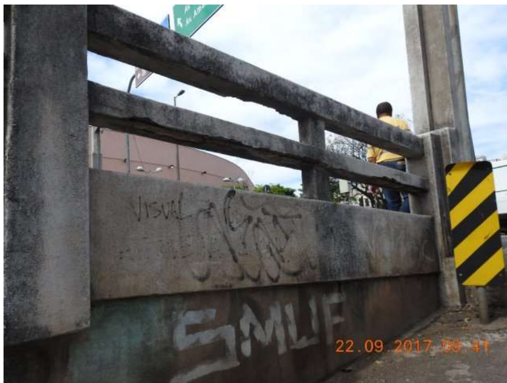
F69/FL – Degradação do recobrimento do guarda corpo, pichações.
