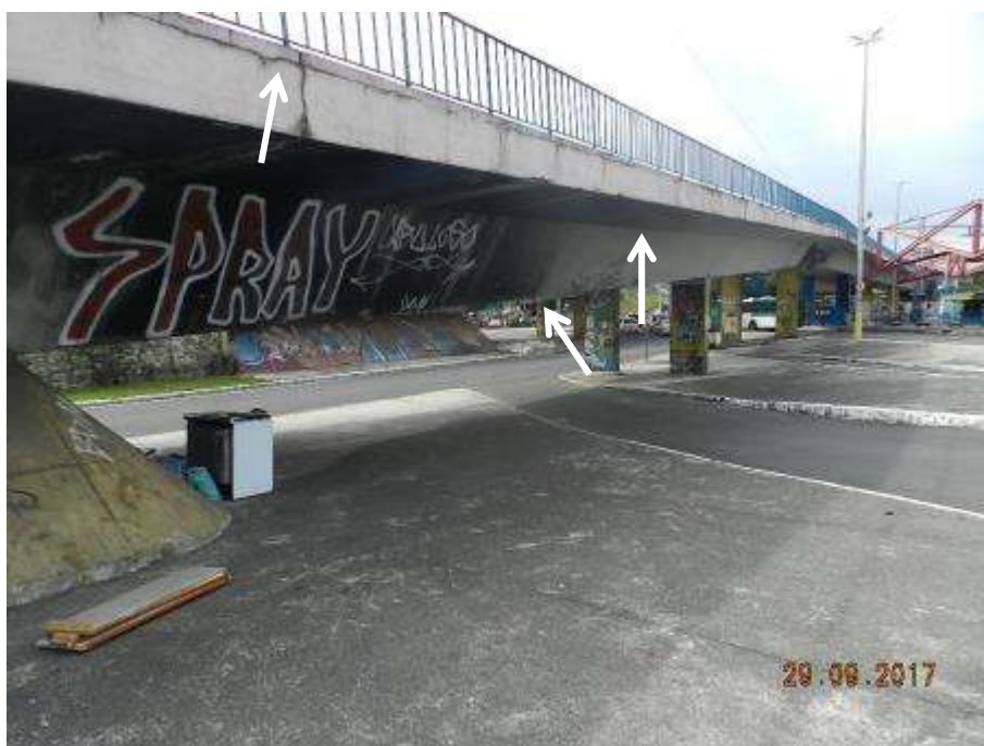
- Trincas na borda do tabuleiro, pichações, sinais de queimadas.
