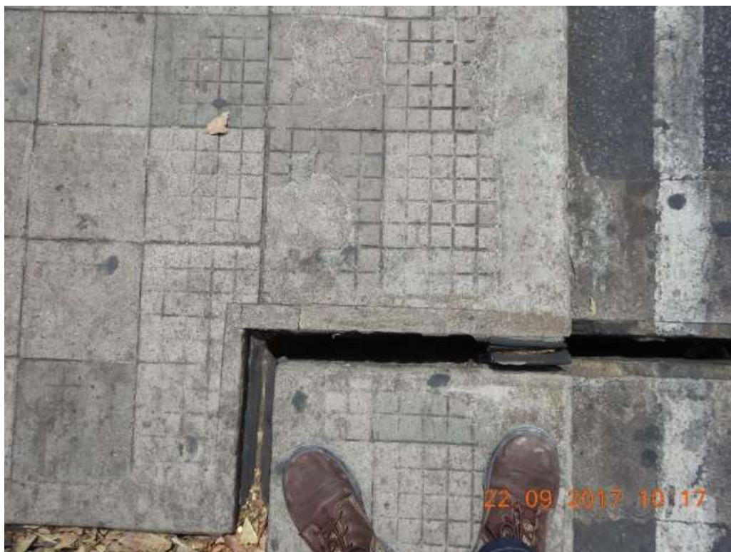
F31/FL – Outro ponto da junta, no passeio, perda do elemento do sistema de impermeabilização, ainda na parte central do viaduto.
