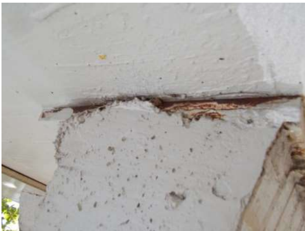
F19/FL –Viaduto Montese, detalhe da fixação do tirante com oxidação.
