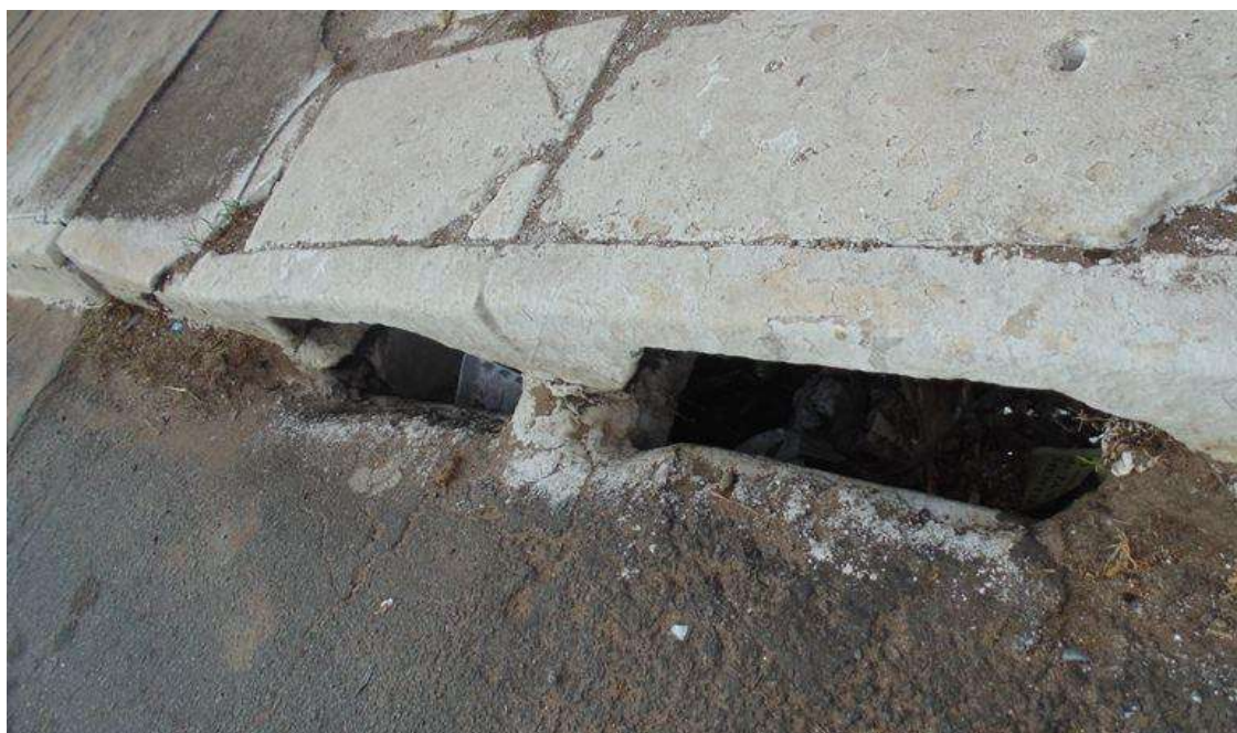
Foto 2 – Bocas de lobo obstruídas por lixo.
