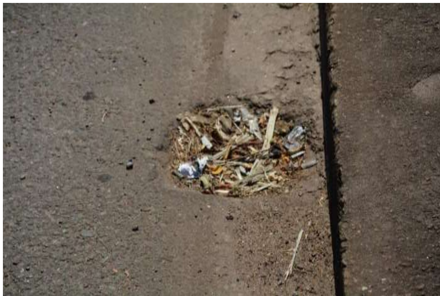
Figura 24 – Indicação de Anomalia:
