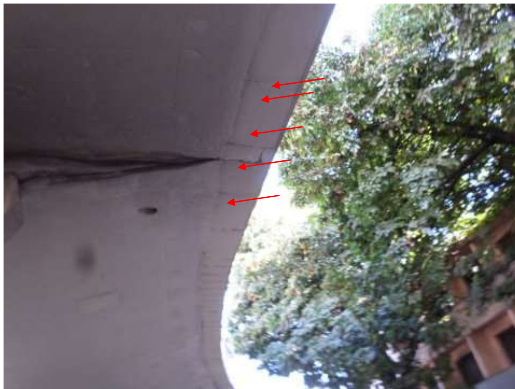
F21/FS – Vista aproximada de manchas de infiltrações, bem como trincas no concreto de sua extremidade.
