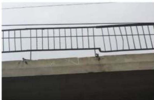
Guarda corpo com apoios danificados e corridos
