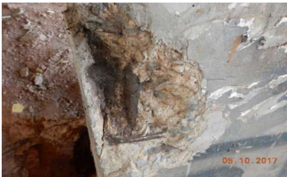
FOTO. 21 – Na Marginal Botafogo, pilar com ferragem exposta e concreto deslocando.
