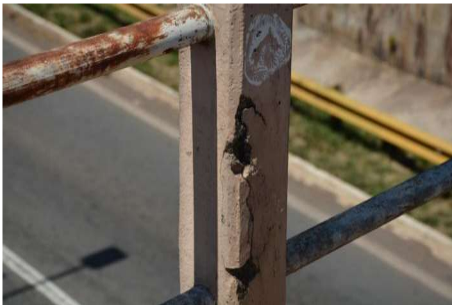
Figura 29 – Indicação de Anomalia:
