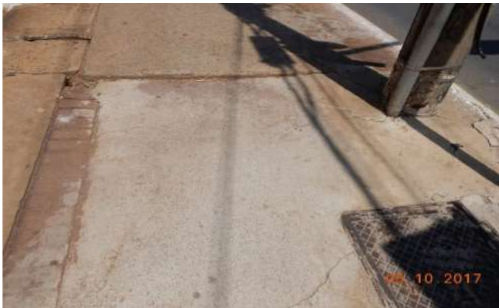
FOTO. 10 – Passeio no encabeçamento da ponte, com pavimento de concreto apresentando trinca e depressão.
