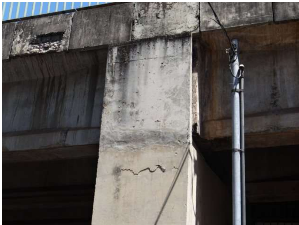
F29/FS – Detalhe do comprometimento da estrutura devido a umidade. Observa-se movimentação na estrutura.
