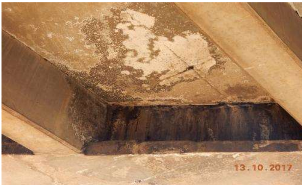
FOTO. 20 – Infiltração na laje e viga da ponte.
