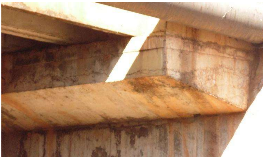
Foto 7 – Trinca na horizontal em uma viga de apoio do tabuleiro, localizada na cabeceira leste, sem evidência de infiltração.
