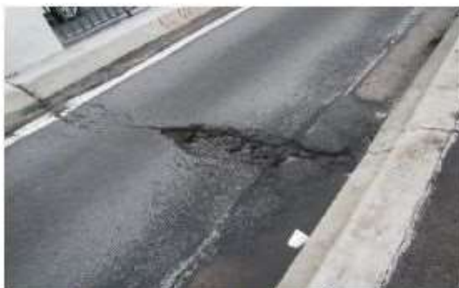
Detalhe do "buraco" na junta de dilatação
