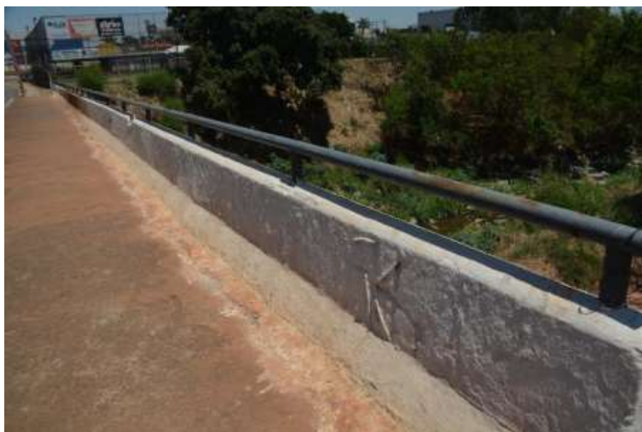
FOTO 8 – Vista de outro ponto do guarda corpo com deslocamento do concreto na lateral da pista deixando a ferragem exposta da Ponte T-63 sobre o córrego Cascavel visualizado da Avenida T-63 sentido Centro / Bairro.
