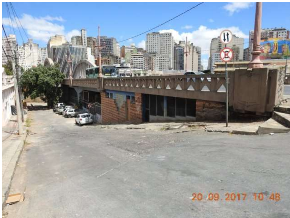
F57/ST – Vista da lateral do viaduto da esquina da Rua Itambé com Avenida Assis Chateaubriant. Na parte inferior do viaduto, local aonde armazenam materiais e tem uma oficina. Falta de acessibilidade e padronização dos passeios.
