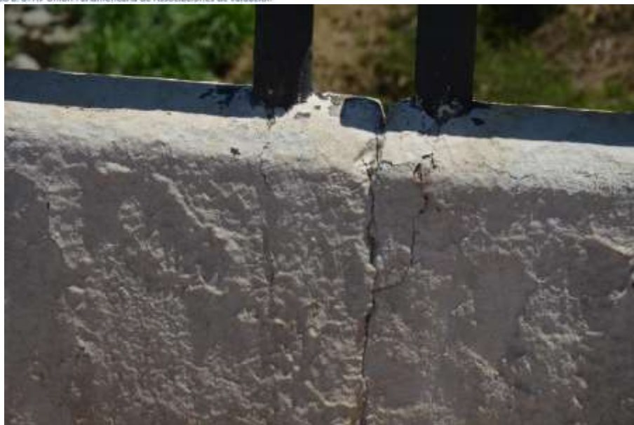
FOTO 13 – Vista de fissuras e trincas no guarda corpo com deslocamento do concreto na lateral da pista na Ponte T-63 sobre o córrego Cascavel visualizado da Avenida T-63 sentido Bairro / Centro.
