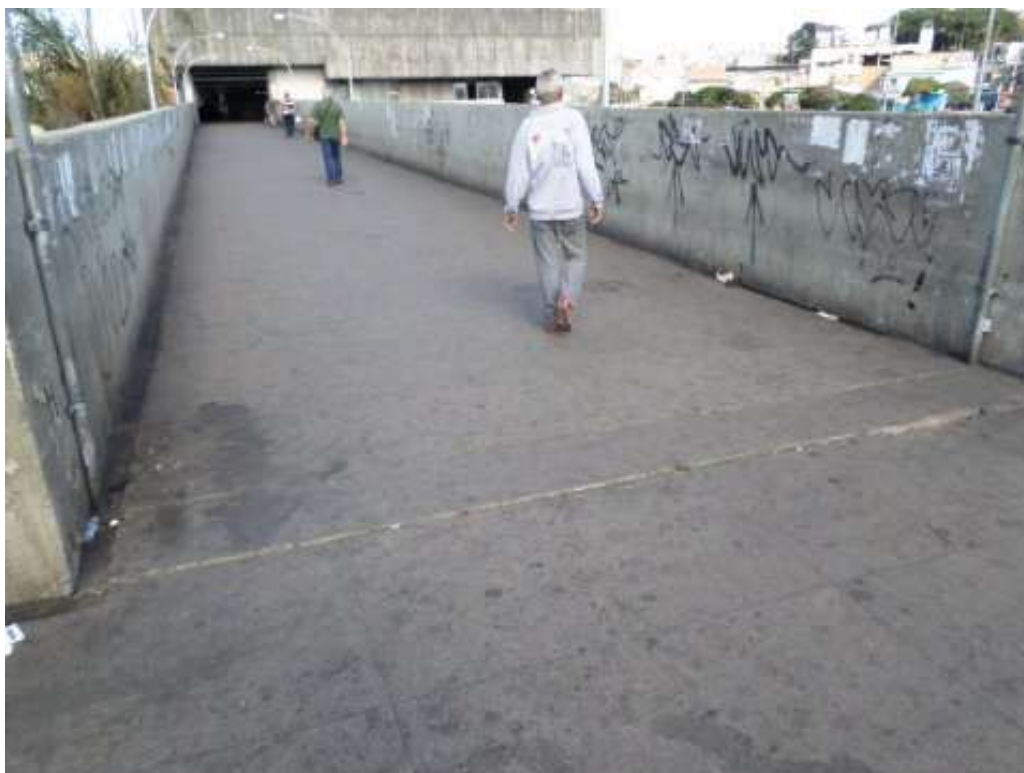
F32/FS – Vista conexão da passarela com a Estação do Metrô, apresentando pichações nas laterais
