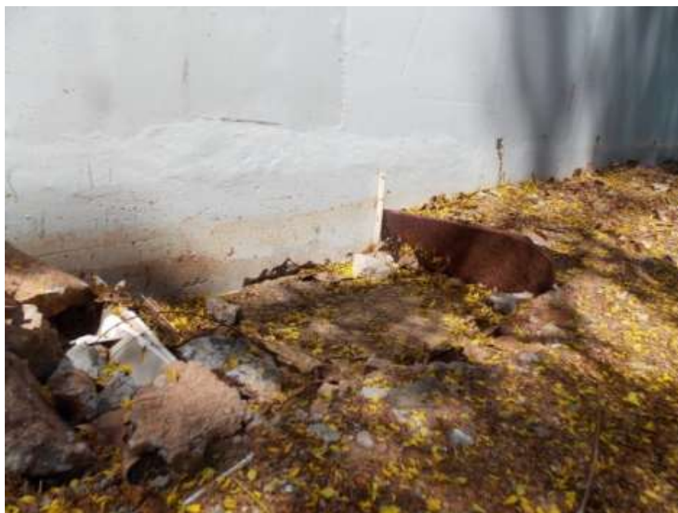
F10/FL – Viaduto Montese, detalhe da caixa telefonica, inadequadamente instalada. Verifica-se no local evidências de infiltrações e falha na concretagem.
