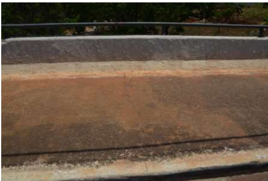
FOTO 10 – Vista da desagregação na junta fria do contrapiso da passagem de pedestre na lateral da pista na Ponte T-63 sobre o córrego Cascavel visualizado da Avenida T-63 sentido Centro / Bairro.
