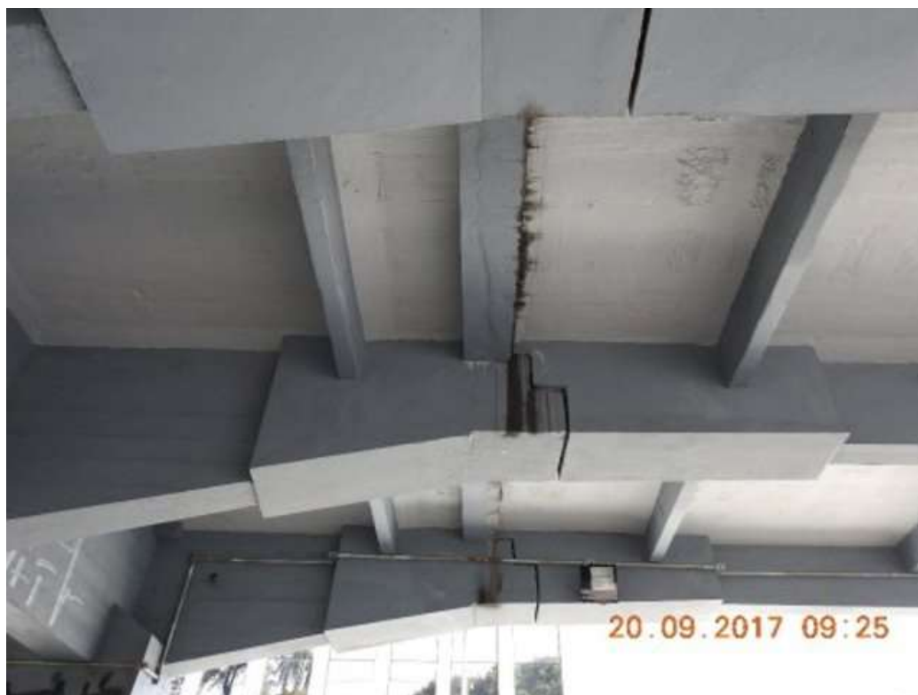
F05/ST – Presença de umidade na junta de dilatação.
