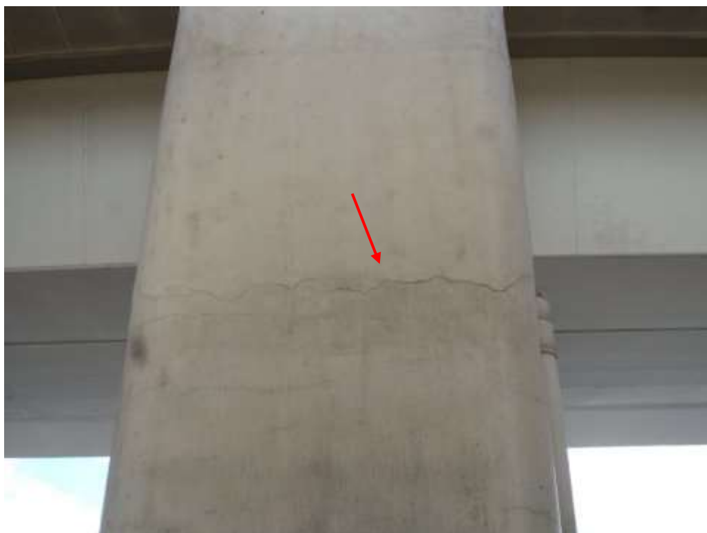
F68/FS – Vista aproximada da mesma trinca.
