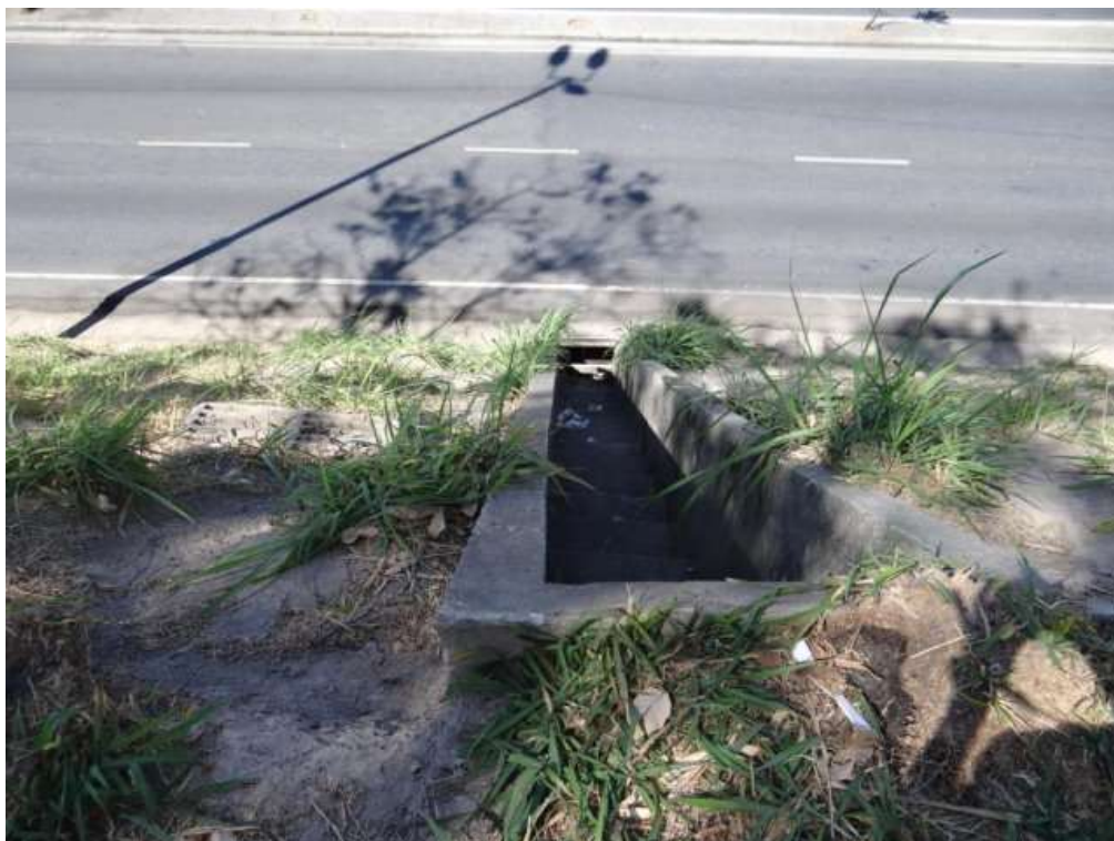
F17/HG – Sistema de drenagem que passa sob o logradouro, sem tampa e com acúmulo de lixo.
