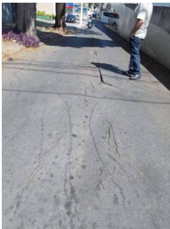
F66/FL – Viaduto Montese, detalhe do recalque da vala RCE.
