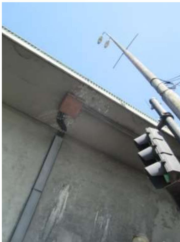
F39/HG – Caixa de passagem de eletricidade posicionada em local com umidade.
