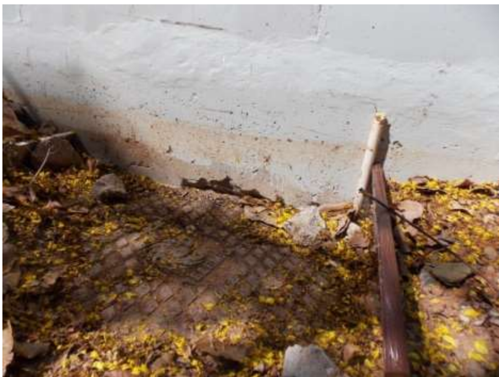
F11/FL –Viaduto Montese, detalhe da fotografia anterior. Notar manchas provocadas pelo acúmulo de efluentes.
