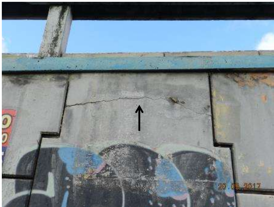
- Placas de concreto com trincas e fissuras.
