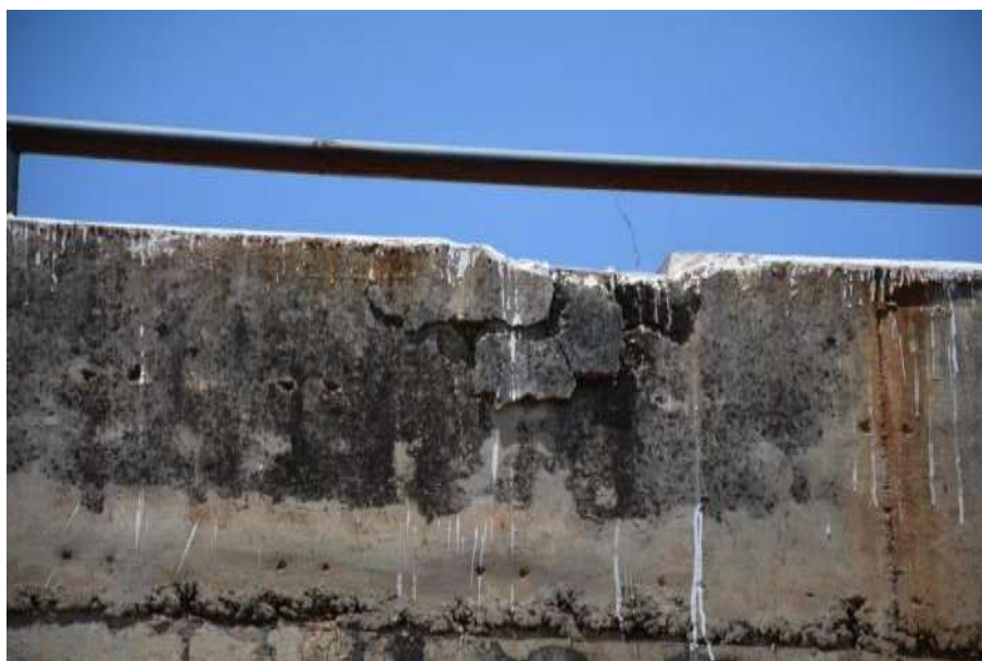
FOTO 24 – Vista de outro detalhe da lateral de concreto do guarda corpo do ponte com degradação e deslocamento de parte do concreto.
