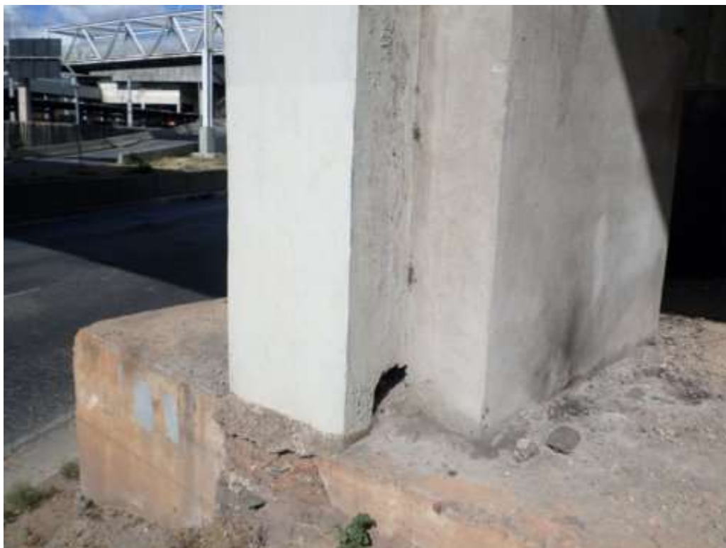
F61/FS – Vista da base do pilar com buraco/broca.
