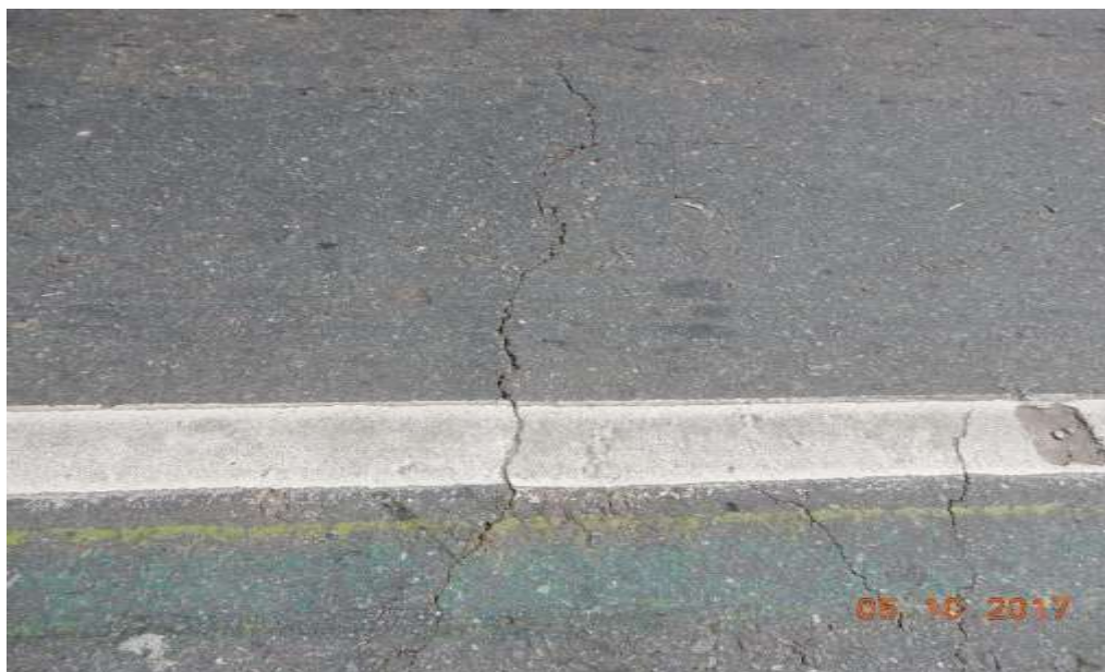
FOTO. 16 – Fissura na cabeceira, na pista de rolamento da Avenida Universitária.
