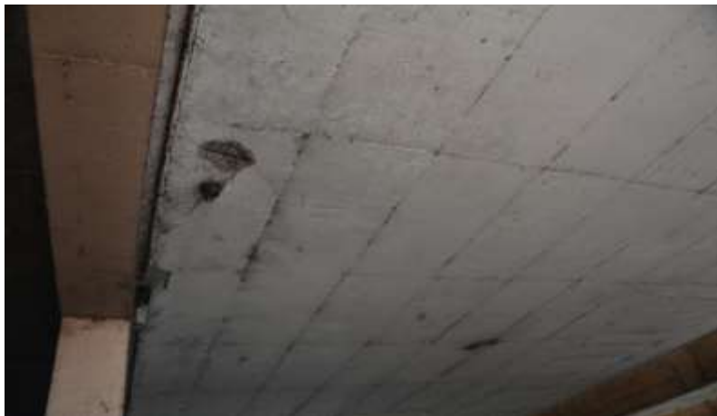
Figura 122 – Indicação de Anomalia:
