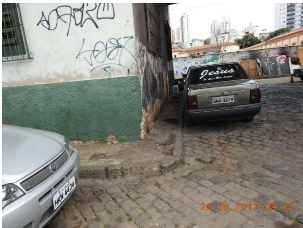
F53/FL – Outro detalhe da foto anterior, danos no passeio, pichações e perda de parte do recobrimento das paredes.
