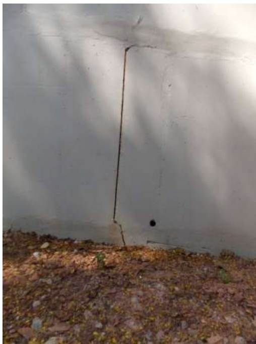
F06/FL – Viaduto Montese, trinca vertical na base e seção posterior em “junta” de dilação, interrompida em altura aproximada e 1,20 metro.
