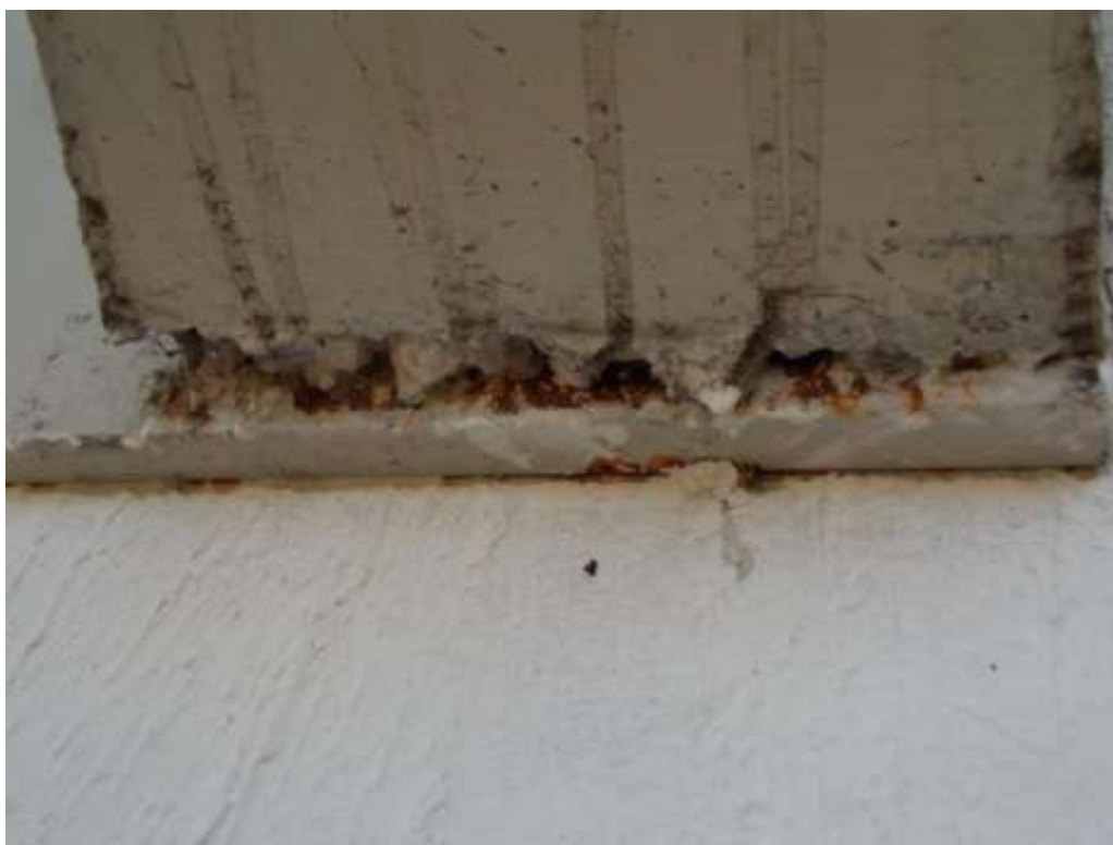
F18/FL –Viaduto Montese, detalhe da fixação do tirante com oxidação.
