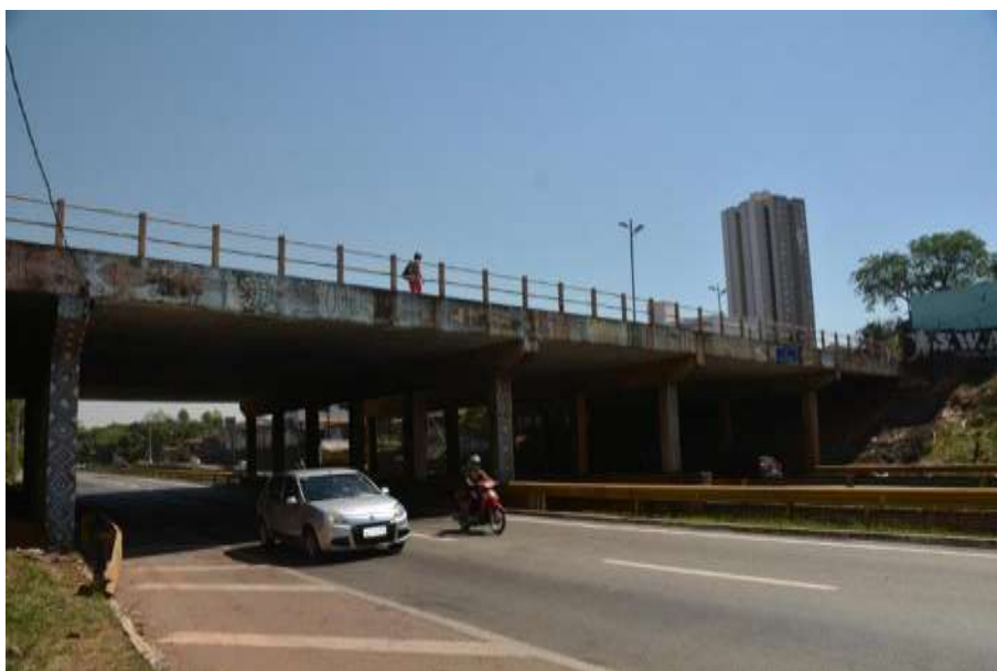
Figura 117 – Indicação de Anomalia:
