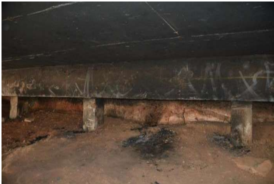
Figura 130 – Indicação de Anomalia:
