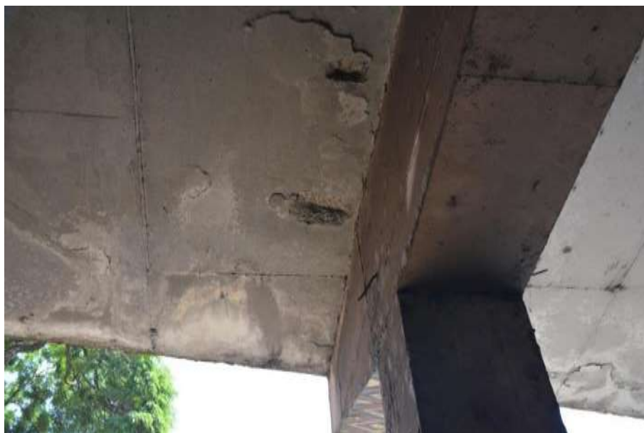
Figura 55 – Indicação de Anomalia:
