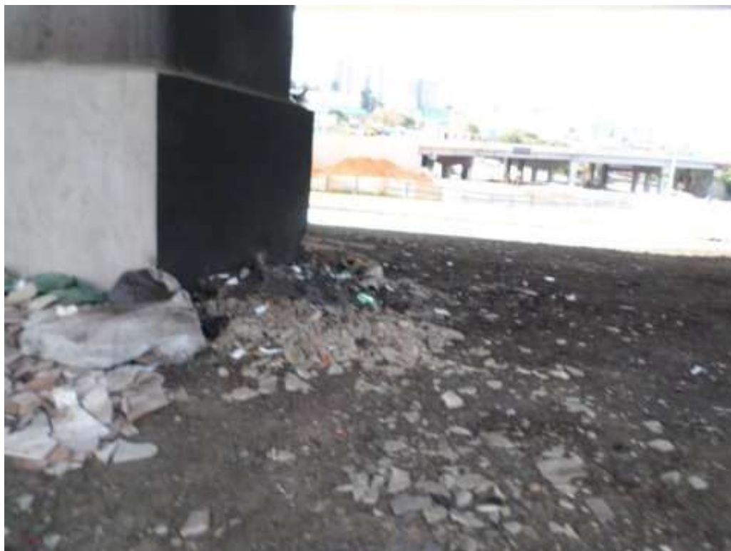
F59/FS – Vista do pilar com manchas de fuligem.
