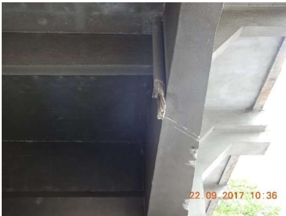
F19/FL – Outro ponto em que ocorre impacto de veículos com a estrutura do viaduto, lixo no sistema de drenagem.
