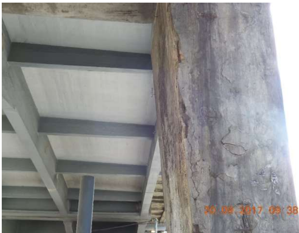
F16/ST – Deslocamento do concreto e ferragem exposta em processo de oxidação no pilar.
