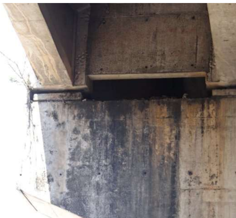
F10/FS – Detalhe presença de umidade.
