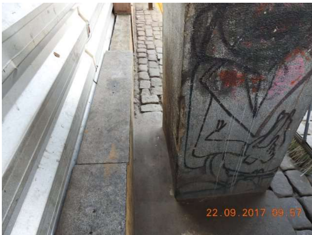
F83/FL – Deslocamento e perda do recobrimento na base do pilar.
