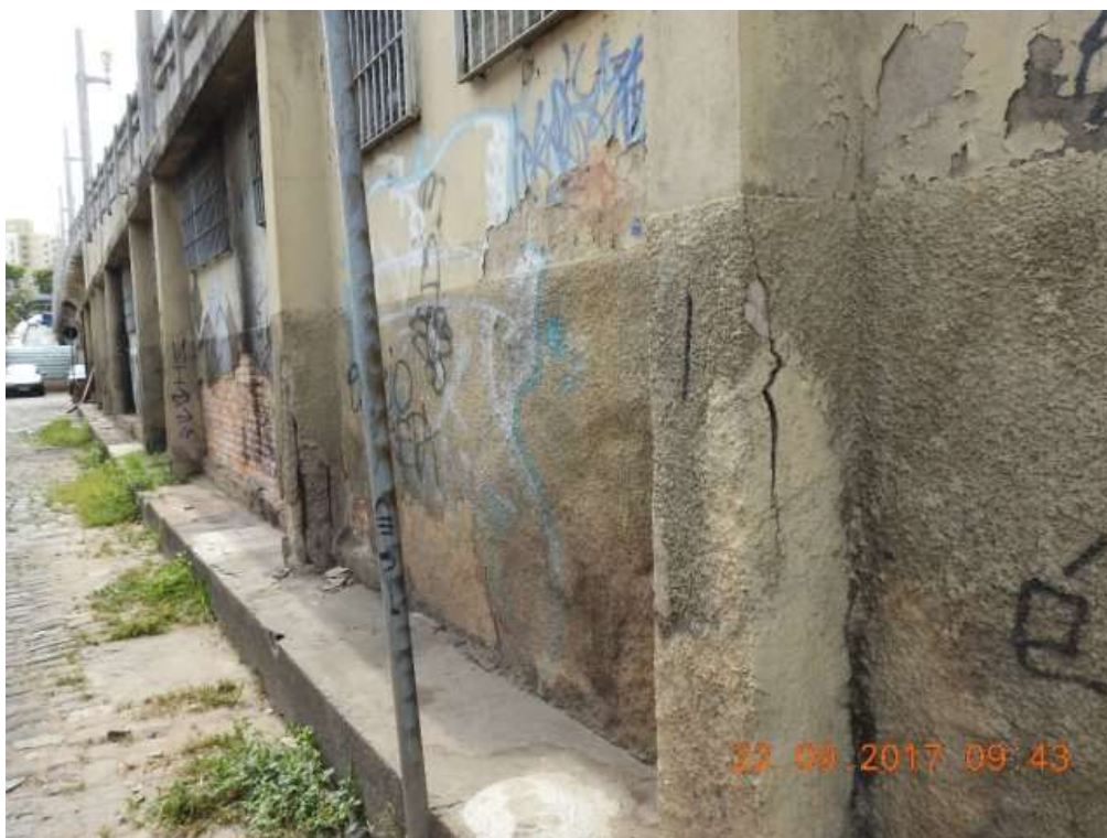
F73/FL – Deterioração do recobrimento dos pilares e paredes. Este local é utilizado pela SLU. Pichações e presença de vegetação no entorno.
