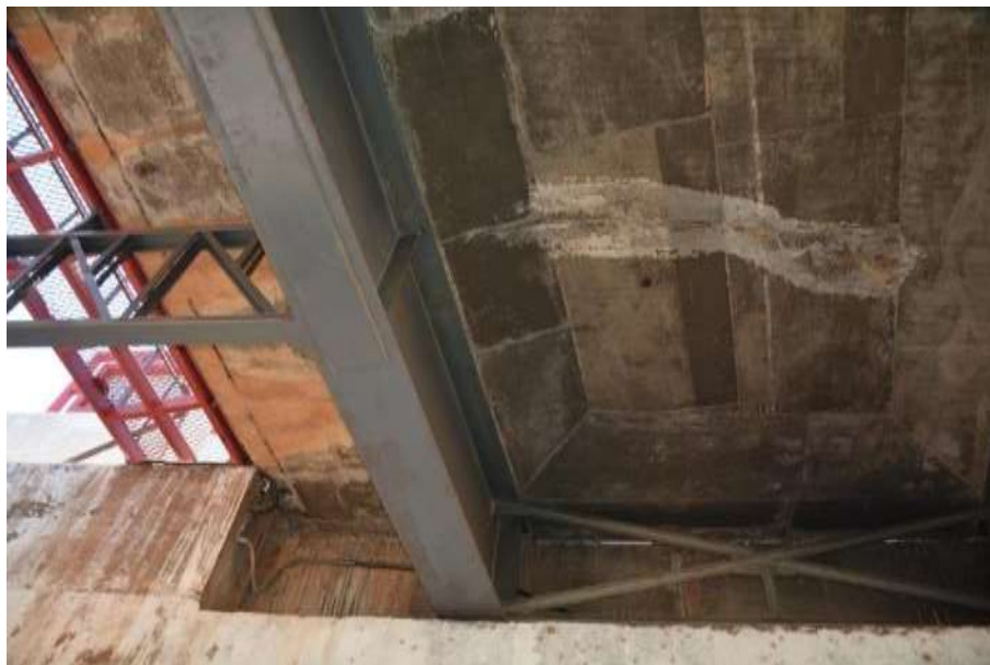
FOTO 51 – Vista do detalhe do cabeamento do sistema de iluminação na parte inferior da ponte com ligação através de condutor aparente, sem a utilização e ou com a utilização de eletrodutos danificados.
