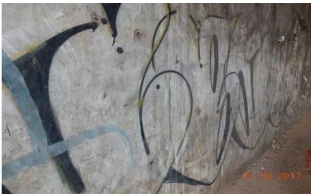
FOTO. 15 – Pichação no arrimo.
