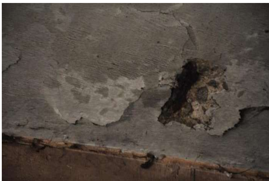
Figura 53 – Indicação de Anomalia:
