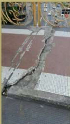
Rachadura no piso do passeio
