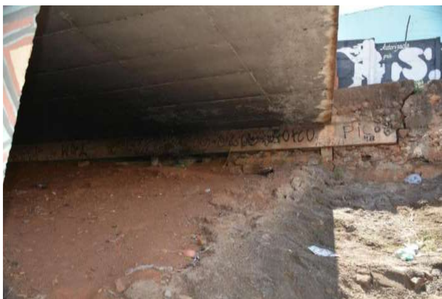
Figura 79 – Indicação de Anomalia:
