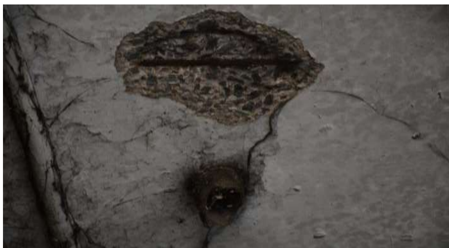
Figura 69 – Indicação de Anomalia:
