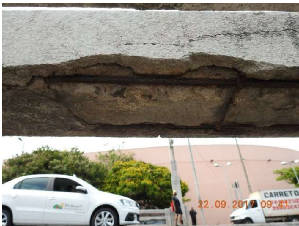
F70/FL – Deslocamento e perda de parte do recobrimento e oxidação da ferragem do guarda corpo.
