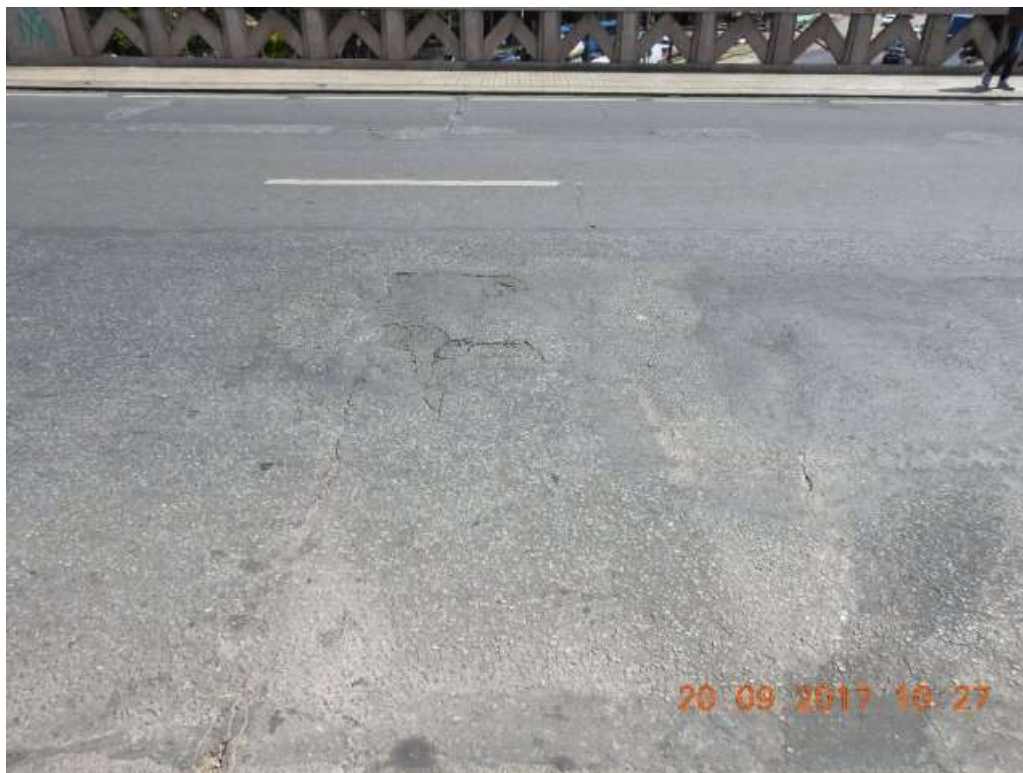
F43/ST – Outro ponto em que o asfalto precisa de reparos.
