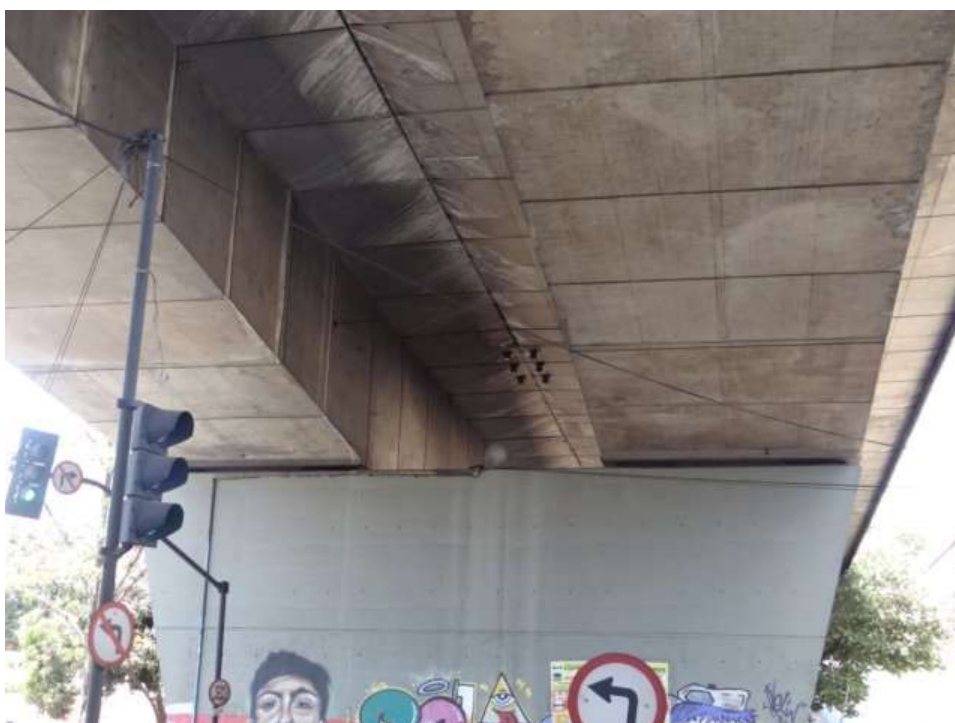
F08/FS – Detalhe de eflorescência na parte inferior da laje.
