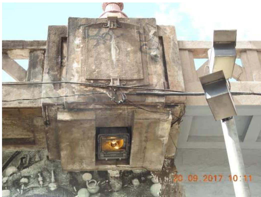
F38/ST – Falta do vidro da luminária e deslocamento na base do poste de iluminação
