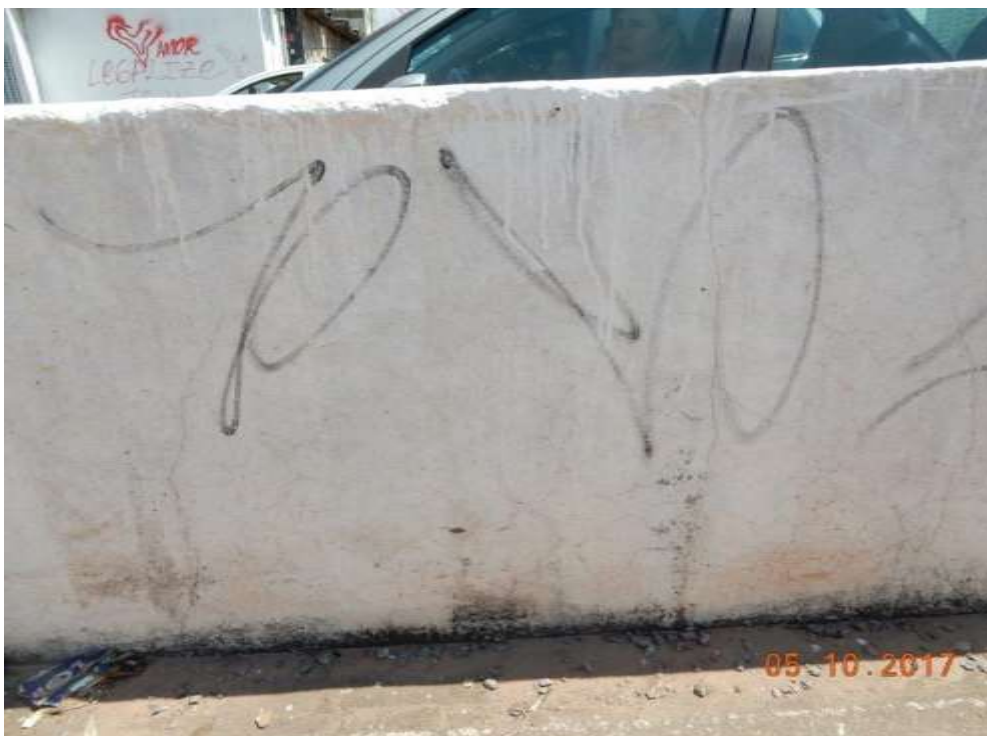
FOTO. 6 – Guarda corpo da ilha central concreto com pichação.
