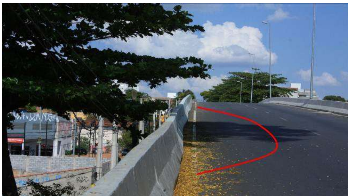
F51/FL – Viaduto Montese, Desnívelamento no piso da pista de rolamento, na região ilustrada nas fotografias nº *** e ***, acima.
