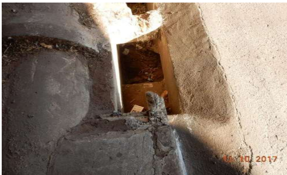
FOTO. 19 – Boca de lobo sem tampa e com sujeira depositada, na Marginal Botafogo.
