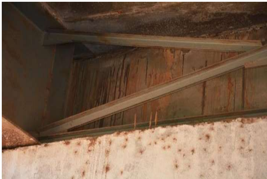
FOTO 60 – Vista de outro ponto da ferragem oxidada e sem proteção nos pilares de travamento da estrutura de contenção do aterro da cabeceira da ponte na Ponte T-63 sobre o córrego Cascavel visualizado da Avenida T-63 sentido Centro / Bairro e sentido Bairro / Centro.
