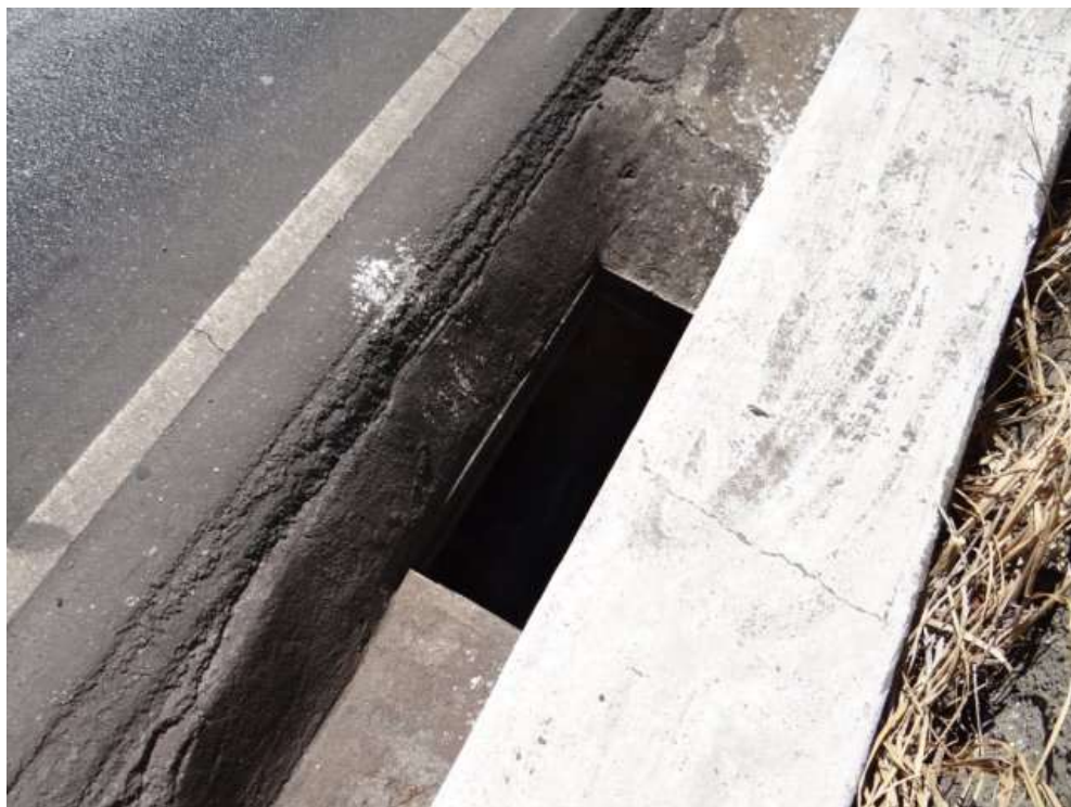
F45/HG – Boca de lobo situada no logradouro sem tampa.
