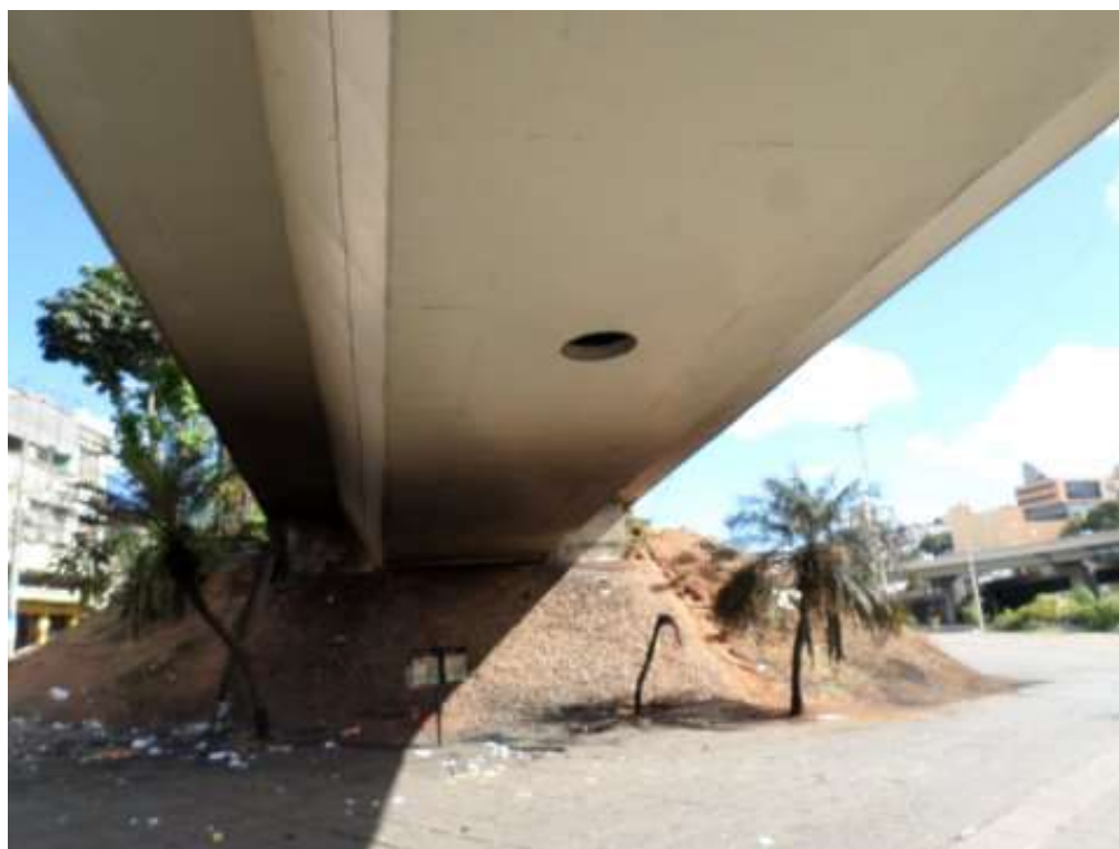
F48/FS – Vista aproximada da alça mostrando manchas de fuligem, e escotilha para acesso em inspeções sem vedação.
