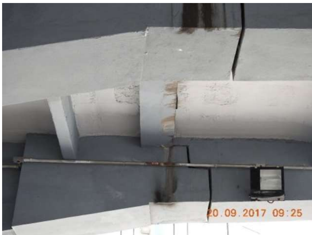
F06/ST – Presença de umidade na junta de dilatação. Eflorescência.
