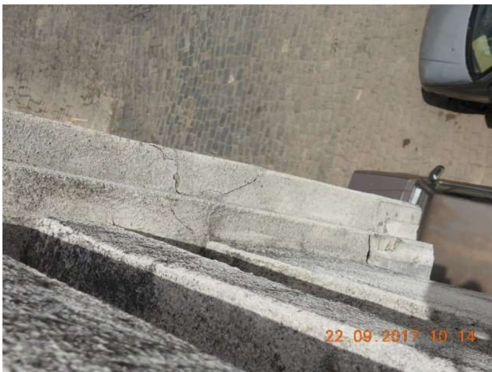
F34/FL – Trincas e início de deslocamento e perda de parte do recobrimento no pilar do guarda corpo, observa-se que abaixo, local aonde ficam carros estacionados e presença de pedestres.
