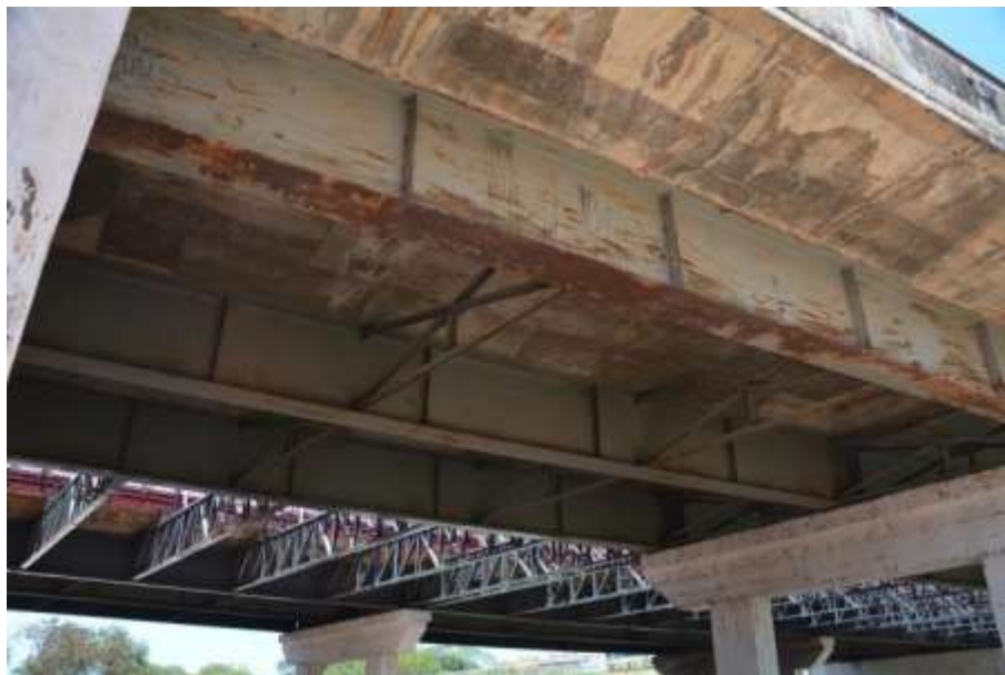
FOTO 21 – Vista de oxidação na parte inferior das vigas metálicas da superestrutura na pista da Ponte T-63 sobre o córrego Cascavel visualizado da Avenida T-63 sentido Centro / Bairro.
