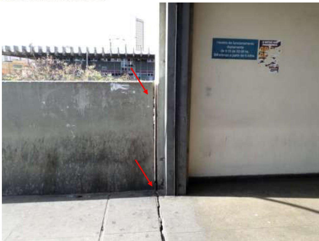
F33/FS – Vista da interface entre passarela e Estação do Metrô, abertura da junta excessiva.
