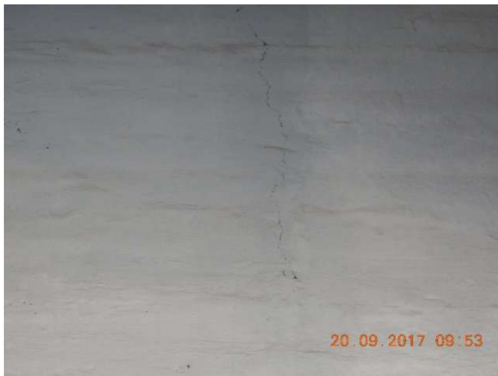
F29/ST – Detalhe da trinca.
