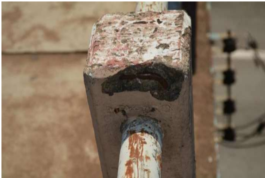
Figura 14 – Indicação de Anomalia:
