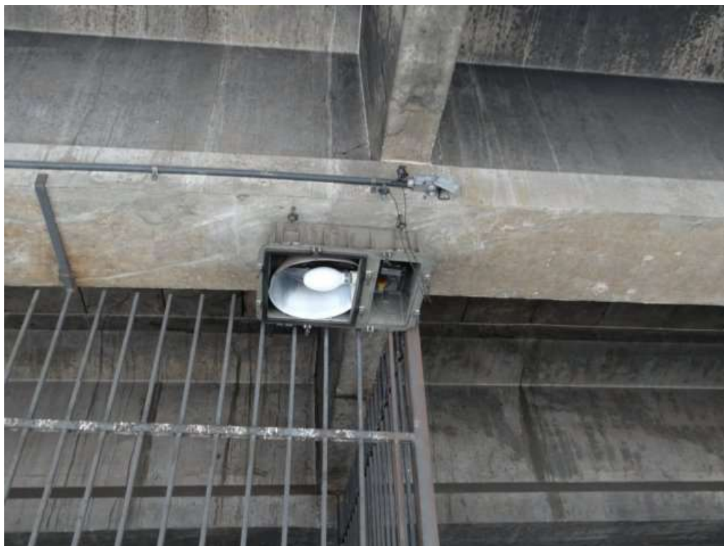
F27/FS – Luminária danificada sob o viaduto.
