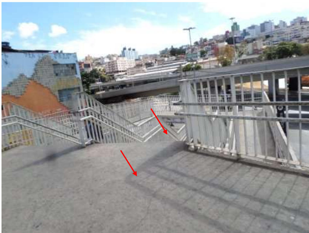
F41/FS – Vista de fissura no piso cimentado no final da passarela já na Av. Pres. Antônio Carlos.
