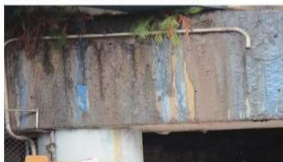
Tubulações de elétricas danificadas
