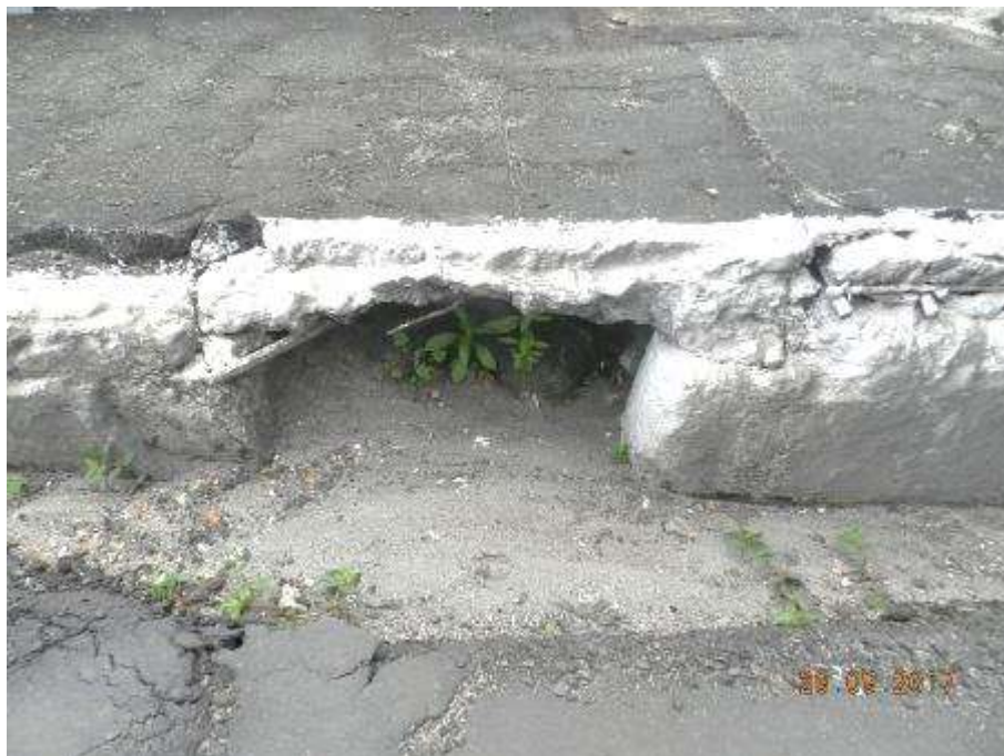
- Drenagem com obstrução parcial por vegetação.
