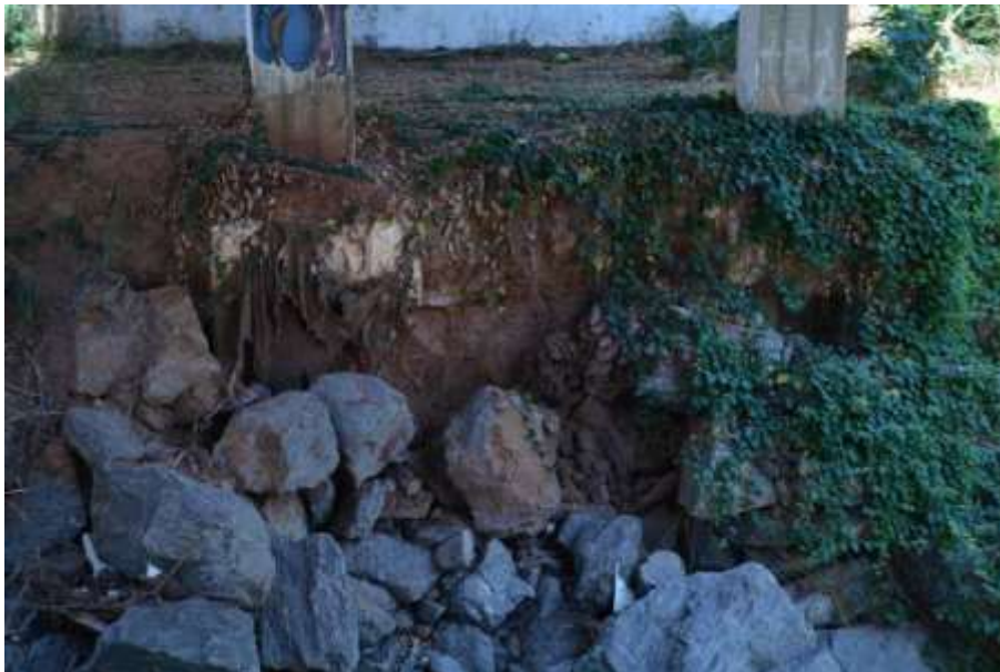
FOTO 37 –Vista da erosão de parte do aterro da fundação dos pilares da ponte podendo comprometer sua estabilidade na pista da Ponte T-63 sobre o córrego Cascavel visualizado da Avenida T-63 sentido Centro / Bairro.
