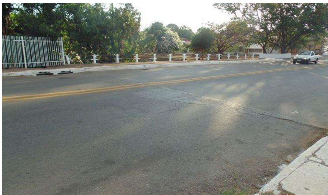
Foto 1 – Trincas no pavimento e recalque na junta de dilatação.
