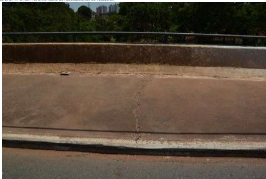
FOTO 11 – Vista de outro ponto da desagregação na junta fria do contrapiso da passagem de pedestre da Ponte T-63 sobre o córrego Cascavel visualizado da Avenida T-63 sentido Centro / Bairro.
