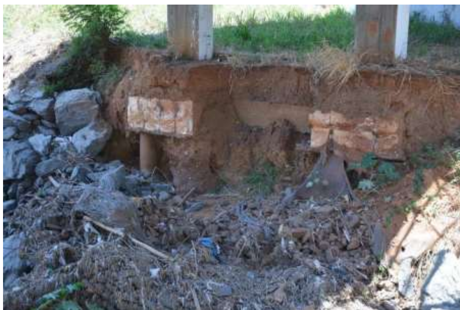
FOTO 36 – Vista aproximada da erosão de parte do aterro da fundação dos pilares da ponte podendo comprometer sua estabilidade na pista da Ponte T-63 sobre o córrego Cascavel visualizado da Avenida T-63 sentido Bairro / Centro
