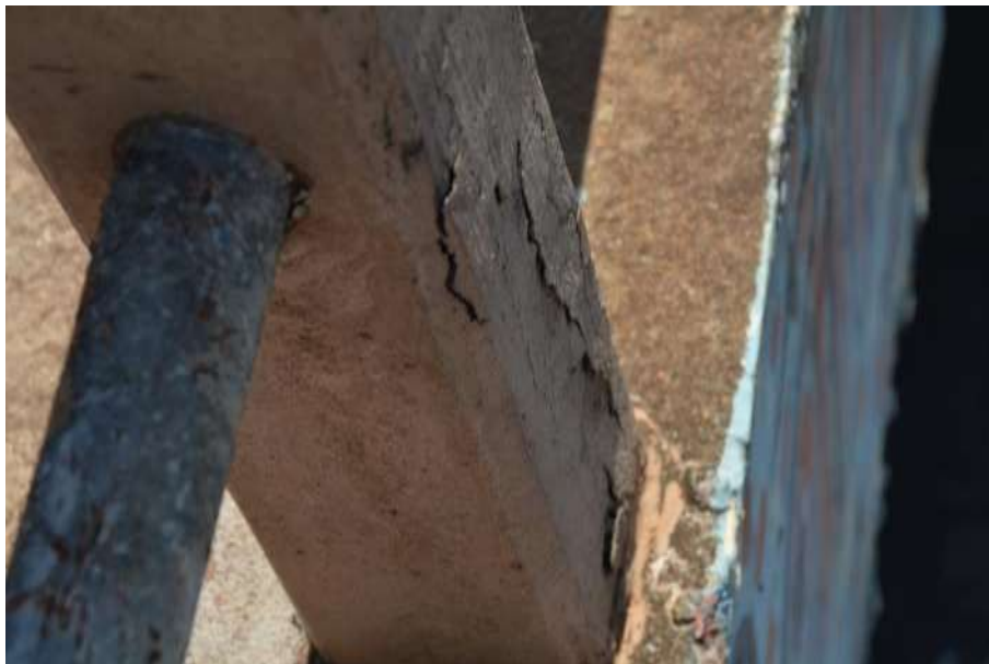
Figura 10 – Indicação de Anomalia:
