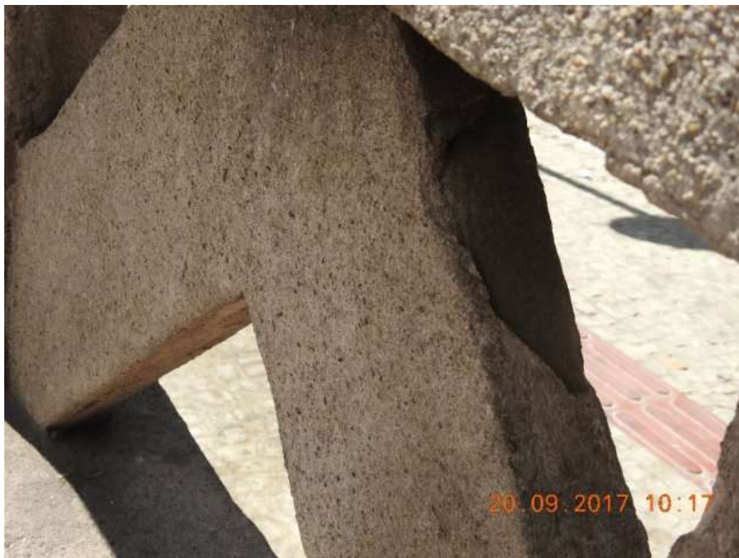
F41/ST – Dano no corrimão, deslocamento.
