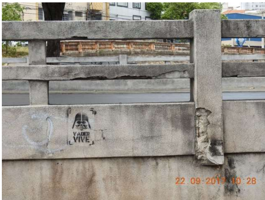
F06/FL – Outro ponto com trincas, desprendimento e perda do recobrimento na base do pilar e no guarda corpo, oxidação da ferragem.
