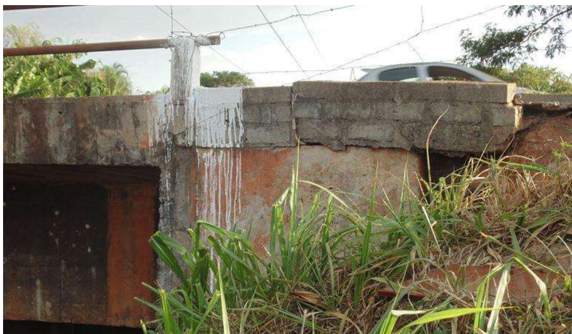
Foto 7 – Deslocamento da estrutura.
