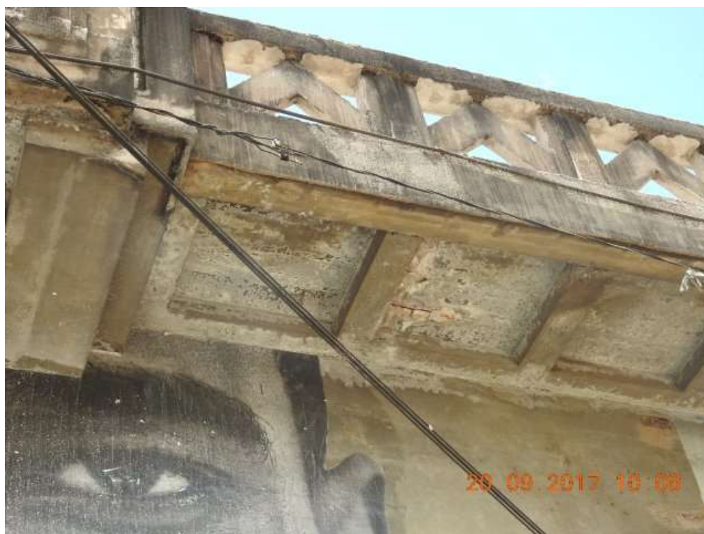
F36/ST – Vista lateral na parte inferior do viaduto, verifica-se eflorescência, presença de umidade e armadura sem cobrimento. Detalhe para os condutores de energia.
