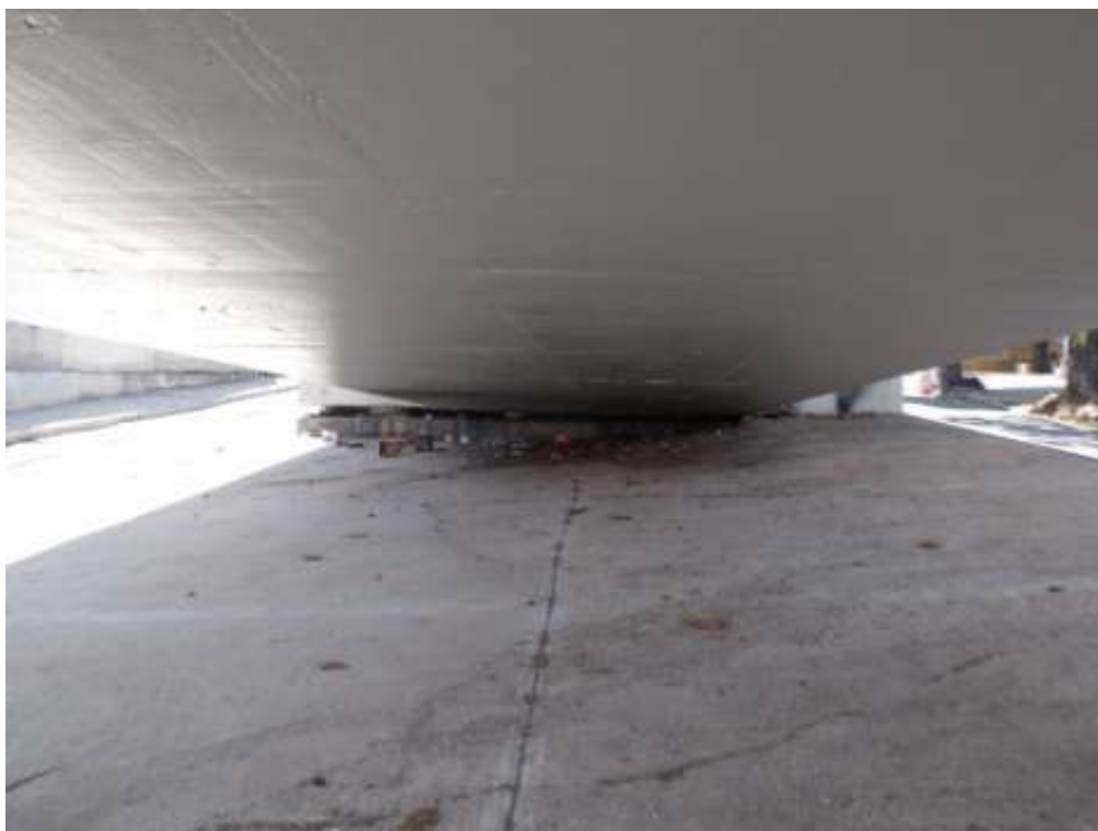
F71/FL – Viaduto Montese, detalhe do lixo presente na região dos elementos de apoio do viaduto, (Bairro Itapoã) que estão ao alcance de todos, sem qualquer proteção.
