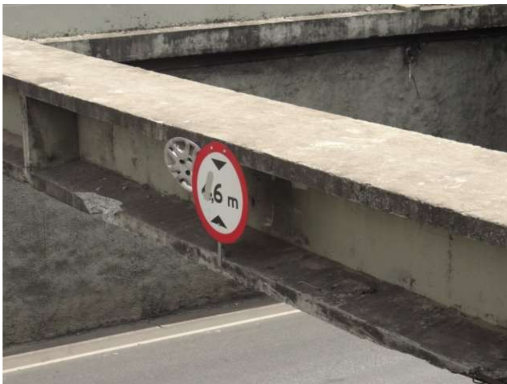
F08/HG – Placa indicativa de altura máxima com leitura comprometida por pintura sobreposta ao número.
