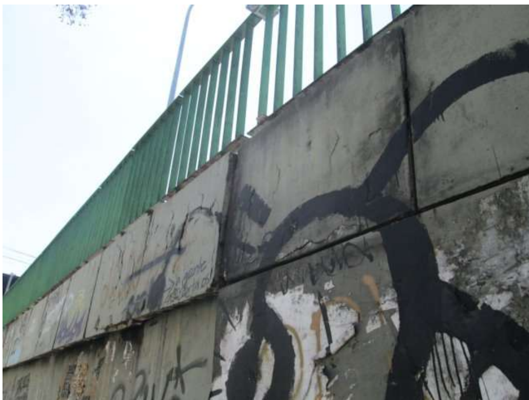
F32/FS – Detalhe deslocamento das placas de concreto na lateral do viaduto.
