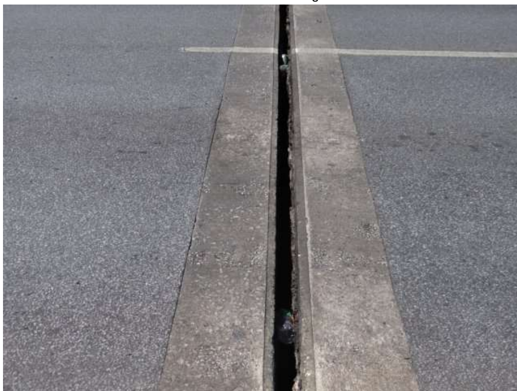
F46/FS – Detalhe da junta de dilatação sem sistema de impermeabilização.
