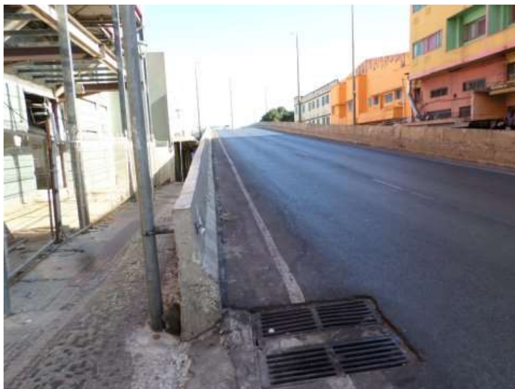
F02/FS – Vista da Cabeceira: Boca de lobo, abaixo do nível do asfalto
