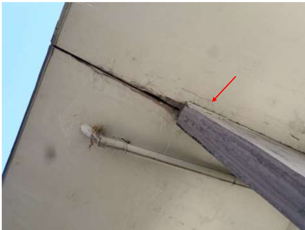
F27/FS – Vista aproximada da seção inferior do tabuleiro próximo à passarela com manchas de infiltrações.
