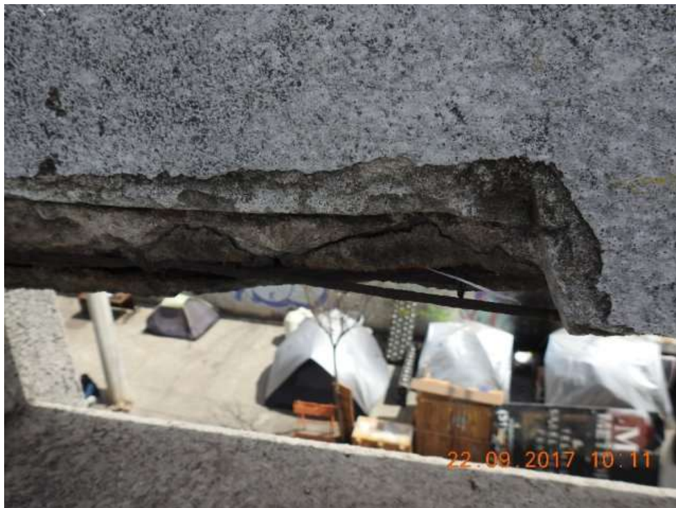
F39/FL – Outro ponto aonde ocorre deslocamento e perda do recobrimento, e oxidação da ferragem do guarda corpo, observa-se que abaixo fluxo de pedestres e veículos.
