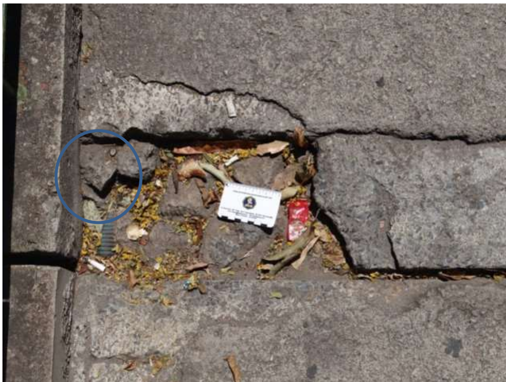
F41/FS – Detalhe de danos existentes no passeio e duto de eletricidade exposto.
