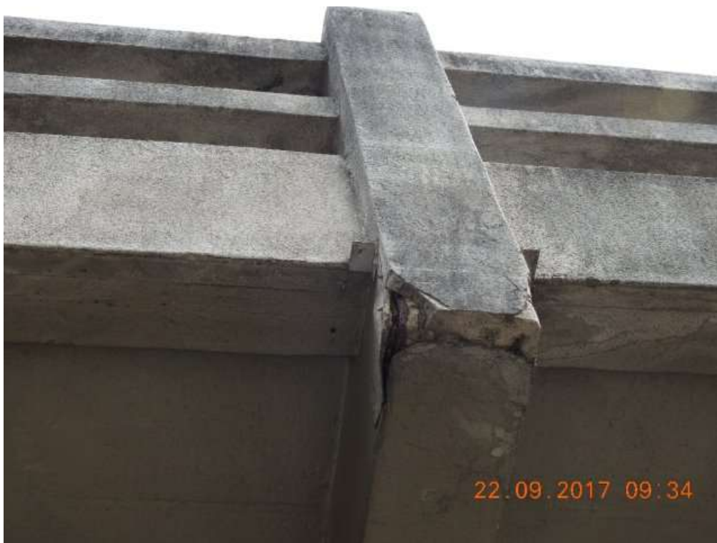
F57/FL – Outro ponto de deslocamento e perda do revestimento na base de outro pilar do guarda corpo.
