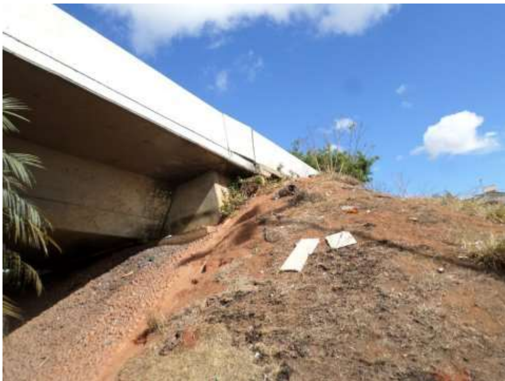
F49/FS – Vista da mesma cabeceira pelo lado oposto com deslocamento de defesa ( guard rail ) e sinais de fuligem.
