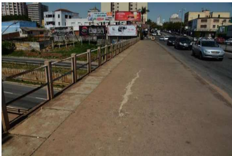
Figura 32 – Indicação de Anomalia:
