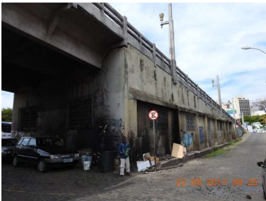
F77/FL – Outra vista da lateral do viaduto e do local utilizado pela SLU. Trincas, desprendimento do recobrimento dos pilares do guarda corpo. Parede escura, indício de fogueira. Presença de lixo e vegetação.
