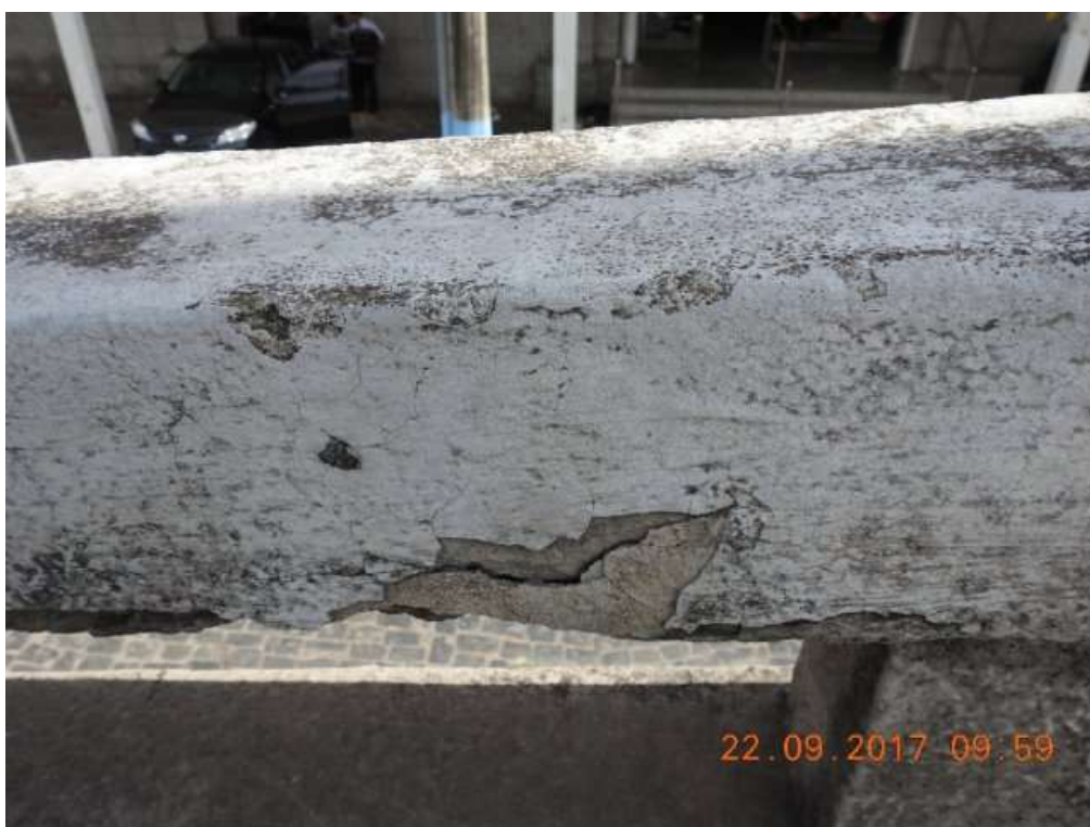
F48/FL – Trinca, deslocamento e perda de parte do revestimento do guarda corpo.
