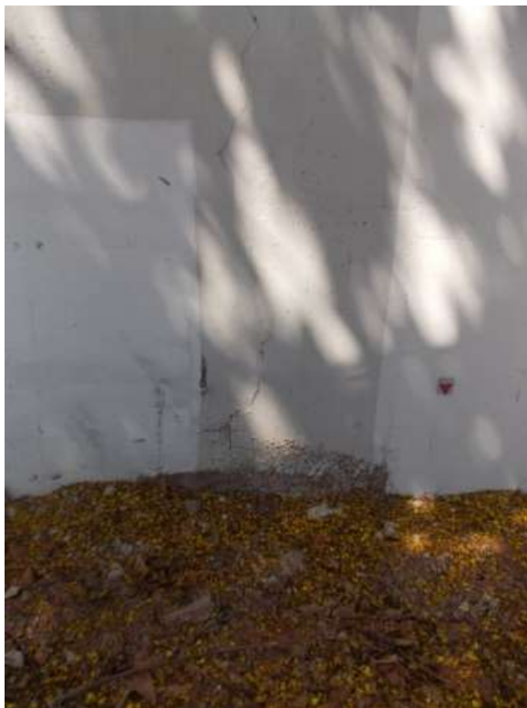
F15/FL –Viaduto Montese, trincas verticais na estrutura de contenção.
