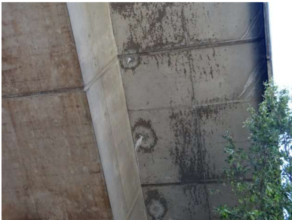
F17/FS – Formação de estalactites na parte inferior da laje do viaduto (próximo a Avenida dos Andradas).
