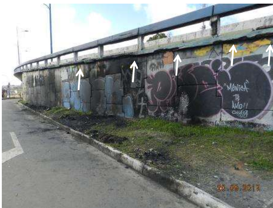
- Cabeceira 02, observa-se concreto danificado.
