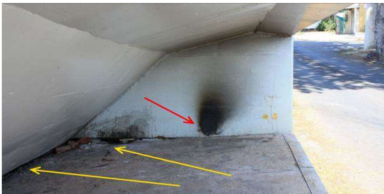
F69/FL – Viaduto Montese, Pontos de infiltração de efluentes - inclinação do revestimento final de piso invertida. Danos decorrentes da exposição ao calor provocado por fogueiras acendidas no local.
