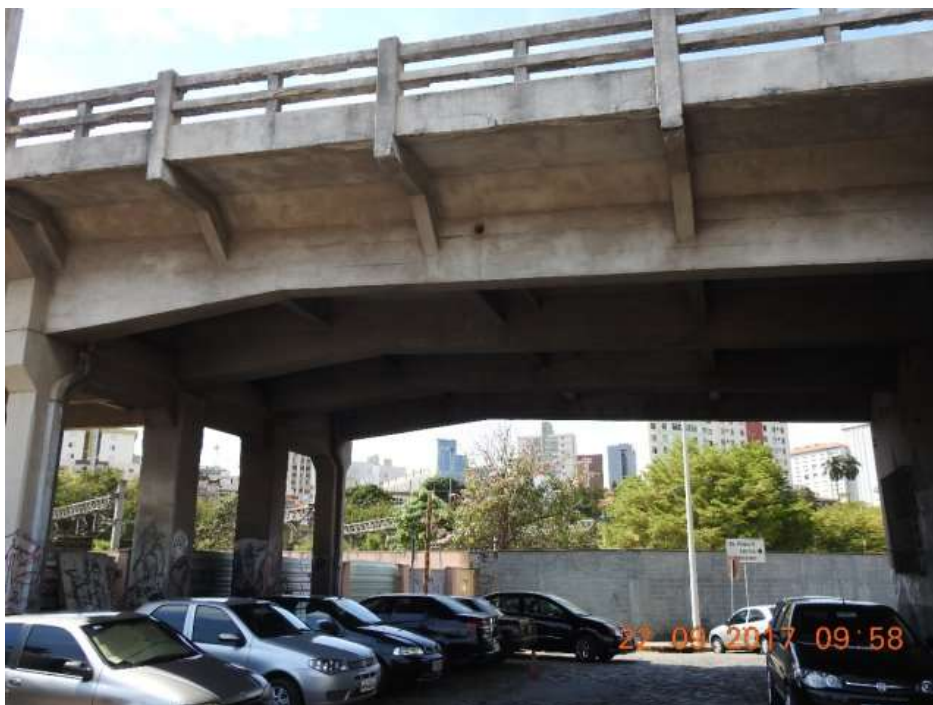
F78/FL – Vista da lateral e do tabuleiro do viaduto de outro ponto, observa-se que local é utilizado para estacionamento de veículos e passagem de pedestres. Deterioração do recobrimento do guarda corpo.
