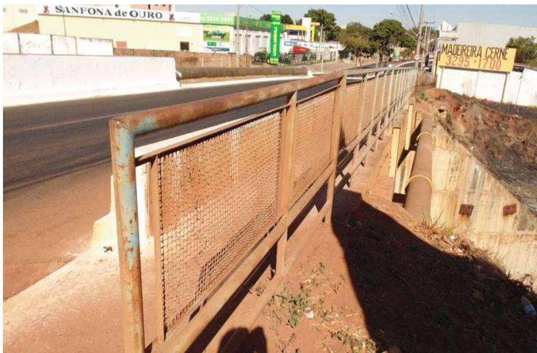
Foto 14 – Guarda-corpo mal fixado e com corrosão acentuada.
