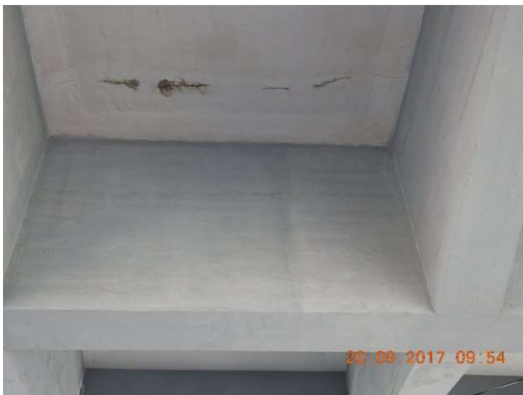
F28/ST – Detalhe da trinca do outro lado da viga, armadura do tabuleiro em processo de oxidação.
