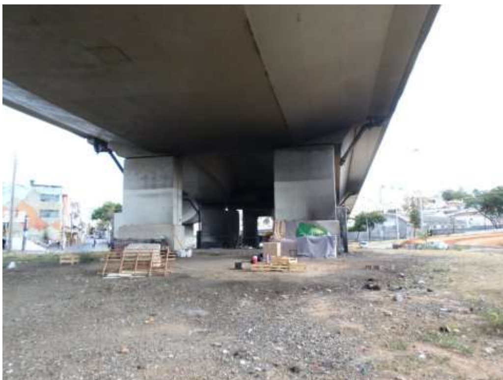
F62/FS – Vista da base dos pilares com ocupação irregular.
