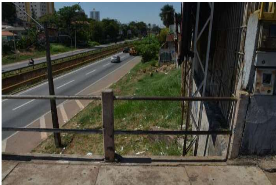
Figura 20 – Indicação de Anomalia:
