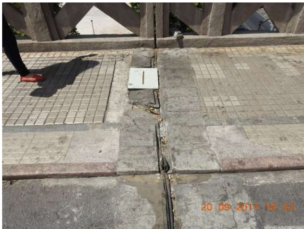
F50/ST – Detalhe para dano no passeio com tampa improvisada. Sistema de impermeabilização com junta danificada.
