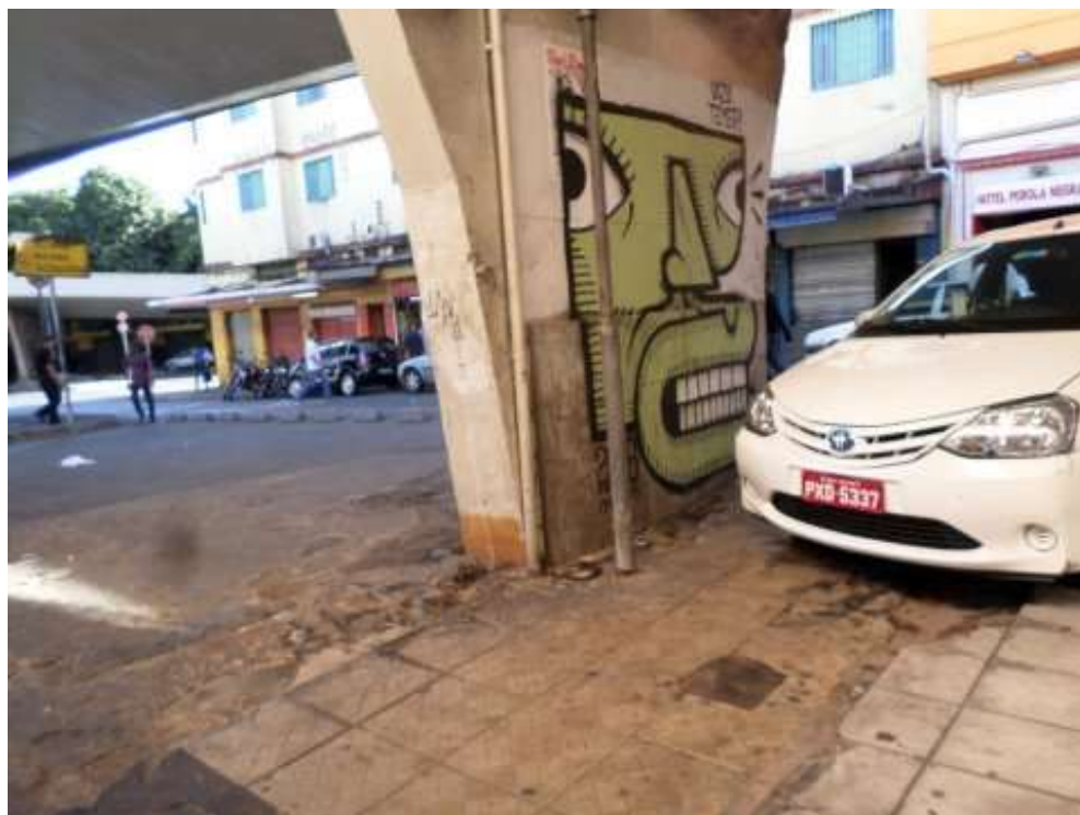
F06/FS – Vista do pilar em bom estado, mas com pichações.
