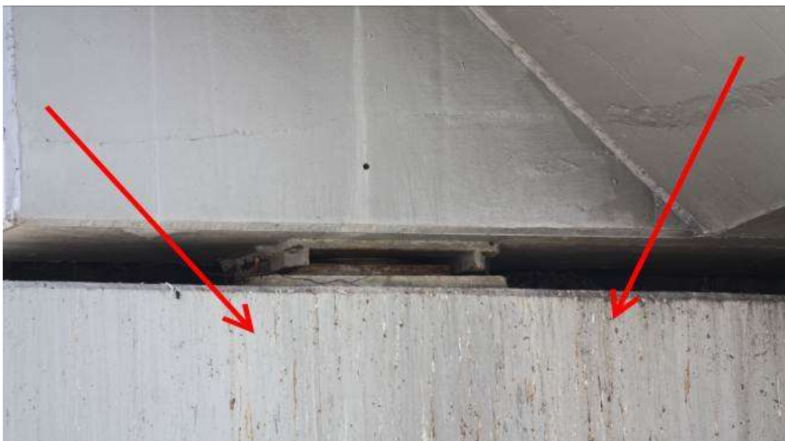
F32/FL – Dejetos de animais na viga posterior. Destaque para o risco de danos ao aparelho de apoio, decorrentes das reações químicas provocadas pela decomposição do material.
