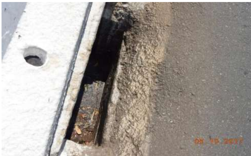
FOTO. 14 – Boca de lobo junto a ilha central, sem tampa/grelha. Situação que se repete em outras bocas de lobo da Avenida Universitária.
