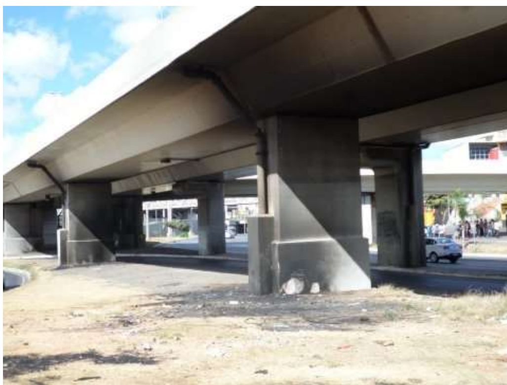
F56/FS – Vista aproximada dos pilares manchados com fuligens.
