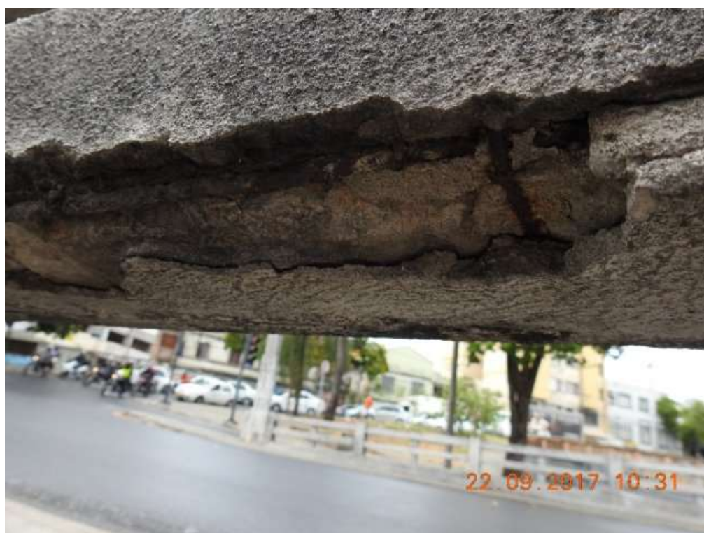
F08/FL – Outro detalhe de desprendimento e perda do recobrimento, e oxidação da ferragem exposta do guarda corpo.
