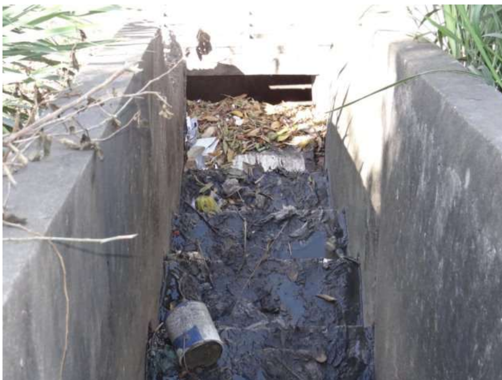
F18/HG – Detalhe do lixo acumulado no sistema de drenagem.
