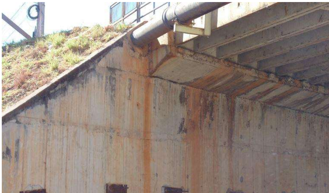
Foto 6 – Sinais de infiltração de baixo comprometimento à vida útil dos elementos. Ocorrência de eflorescência.
