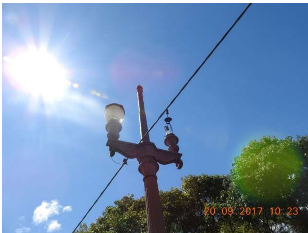
F44/ST – Falta de luminária no lado direito e luminária danificada do lado esquerdo, condutor de energia externo aos eletrodutos, improvisação.
