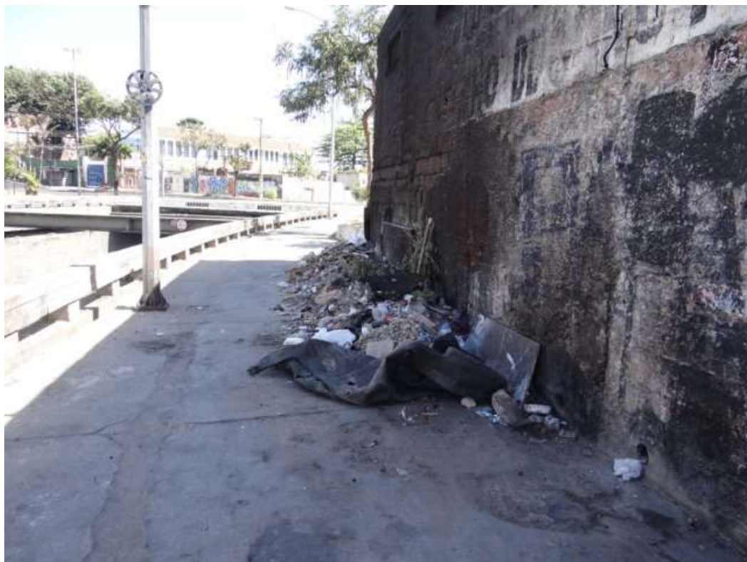
F09/HG – Detalhe do lançamento de lixo ao lado do viaduto.
