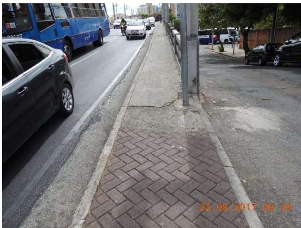
F66/FL – Vista do passeio ao lado do Centro de Referência da Juventude esquina da Avenida do Andradas. Danos, falta de padronização, falha na sinalização, falta do ladrilho tátil de direcionamento e alerta.
