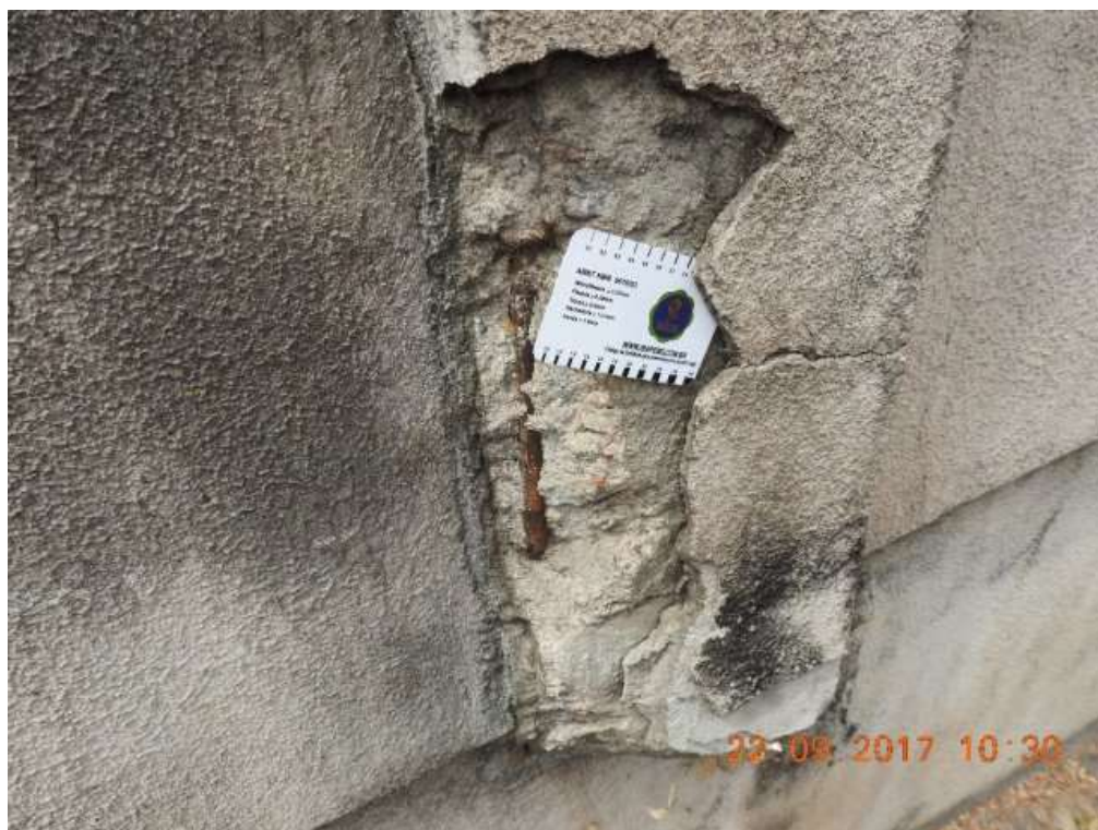
F07/FL – Detalhe da foto anterior, observa-se oxidação da ferragem.
