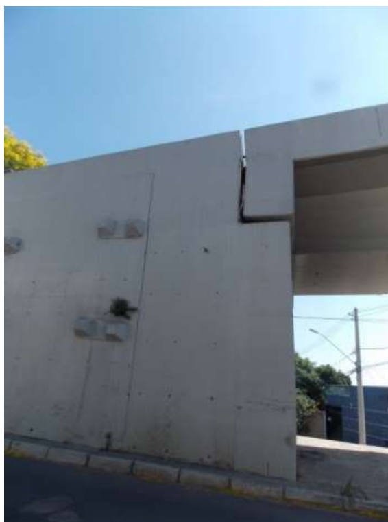
F43/FL – Viaduto Montese, deslocamento do apoio direito (Dente Gerber), rampa do lado do Bairro Santa Branca.
