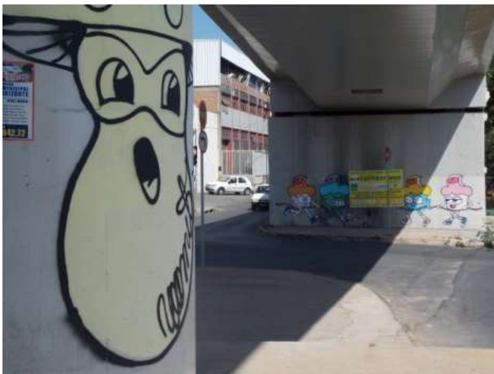
F42/FL – Viaduto Montese, pichações.
