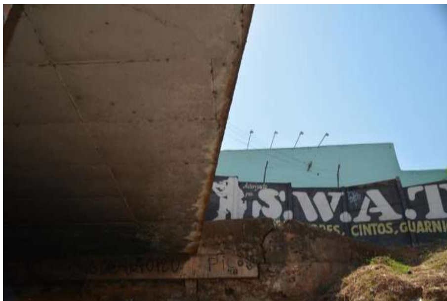
Figura 78 – Indicação de Anomalia:
