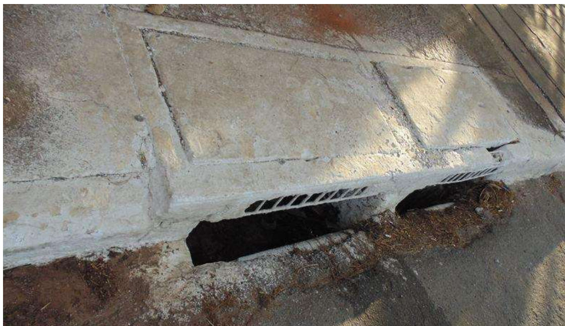
Foto 11 – As sarjetas não apresentam rebaixo em virtude dos seguidos recapeamentos recebidos.
