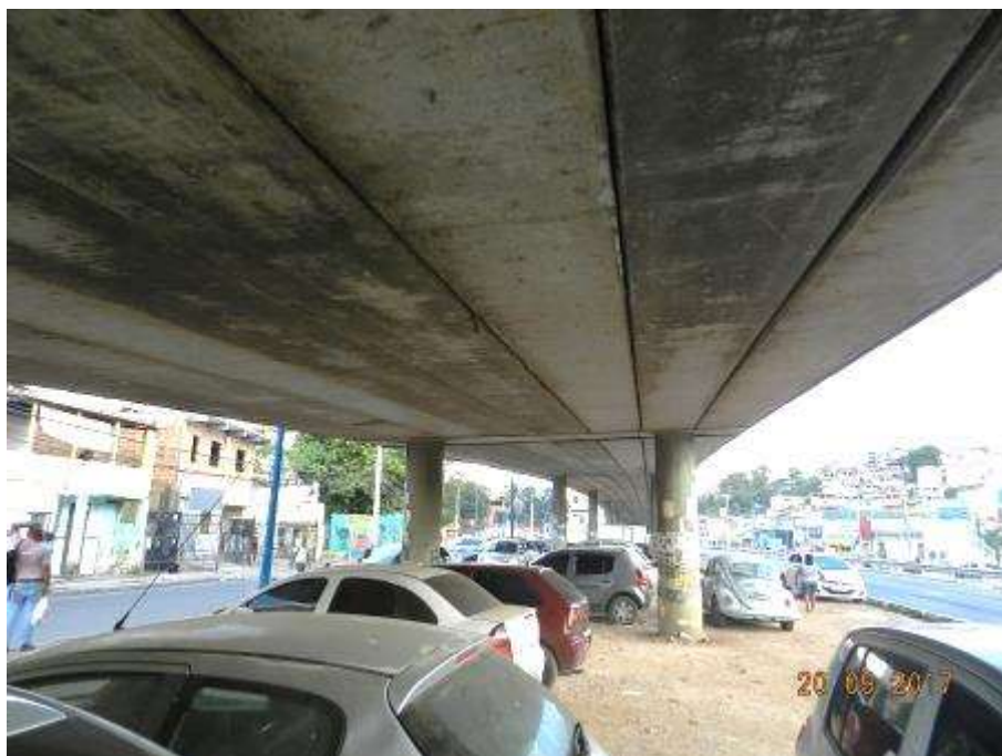
- Concreto da face inferior do tabuleiro com infiltrações.
