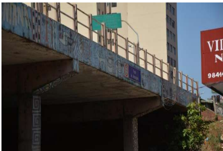
Figura 41 – Indicação de Anomalia:
