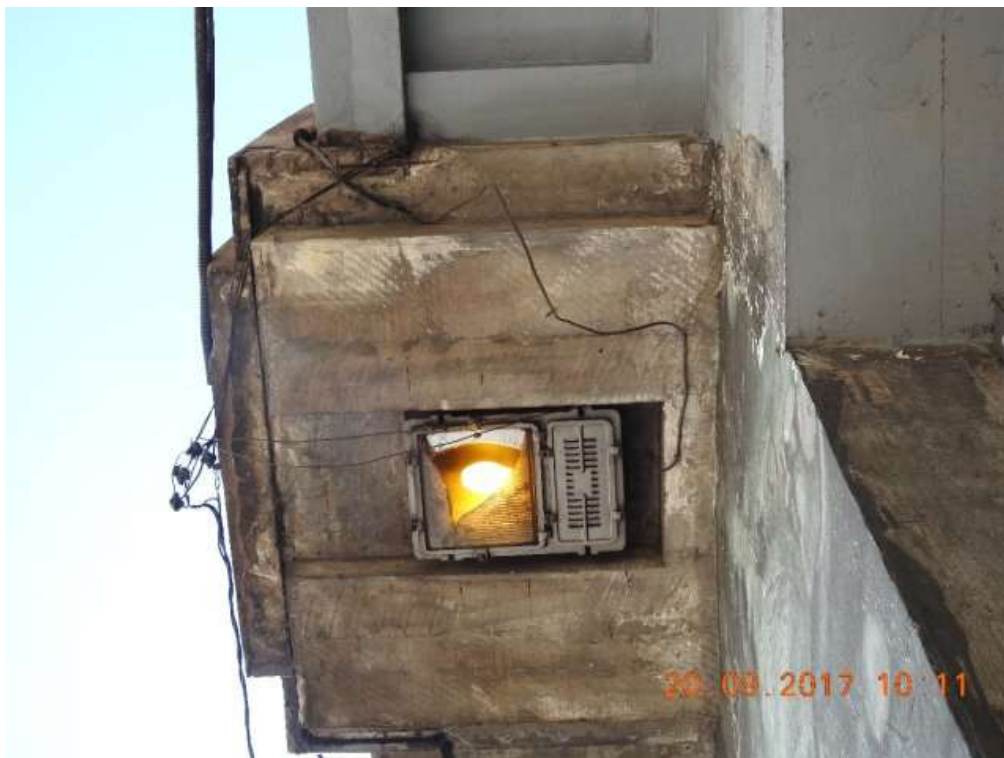
F39/ST – Mostra deslocamento na parte inferior do viaduto. Ferragem exposta.
