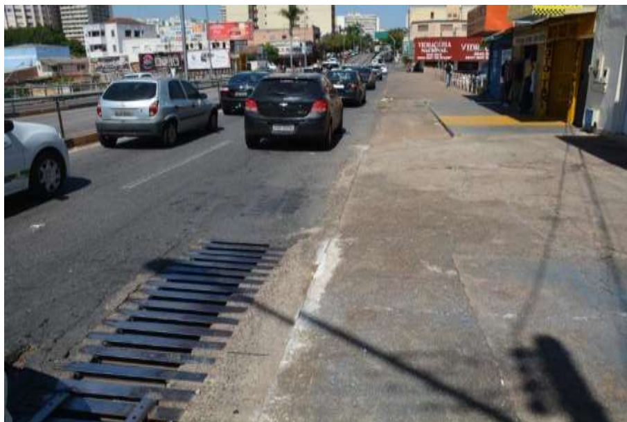
Figura 3 – Indicação de Anomalia:
