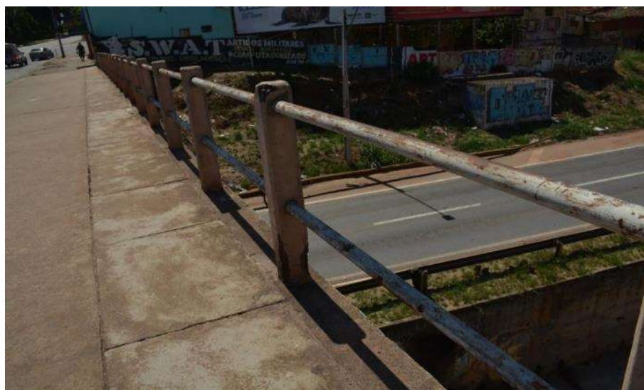
Figura 6 – Indicação de Anomalia:
