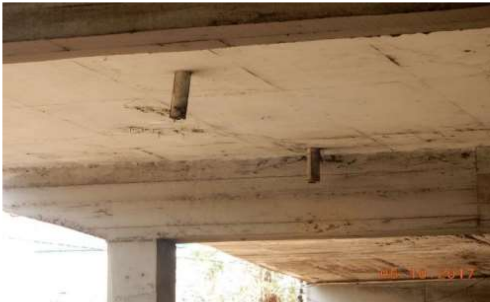
FOTO. 23 – Buzinote localizado na sarjeta da Avenida Universitária obstruído, vista inferior pela Marginal Botafogo.
