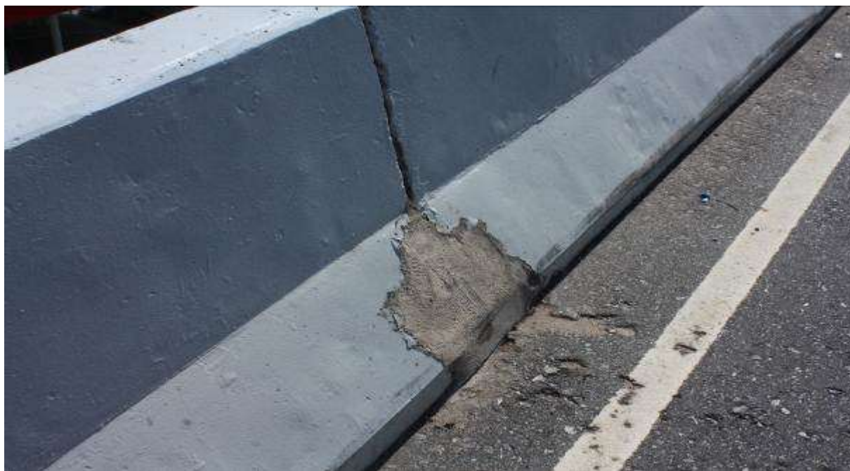
F81/FL – Evidências de utilização de materiais não estruturais em reparo e a não observação da junta de dilatação entre as peças de concreto.
