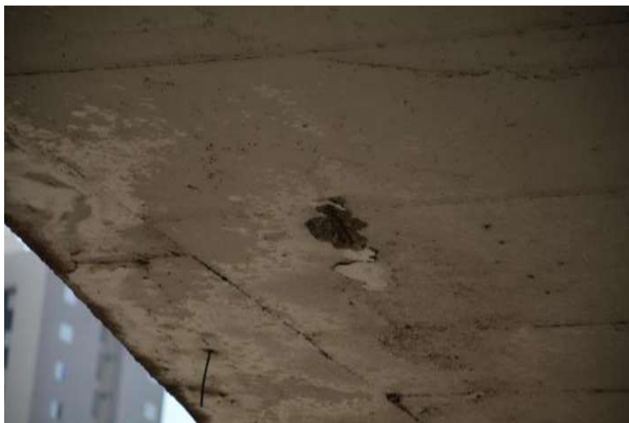
Figura 59 – Indicação de Anomalia:
