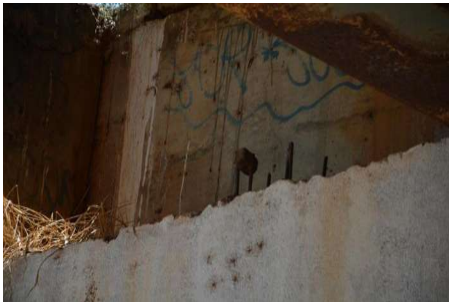
FOTO 59 – Vista aproximada da ferragem oxidada e sem proteção nos pilares de travamento da estrutura de contenção do aterro da cabeceira da ponte na Ponte T-63 sobre o córrego Cascavel visualizado da Avenida T-63 sentido Centro / Bairro e sentido Bairro / Centro
