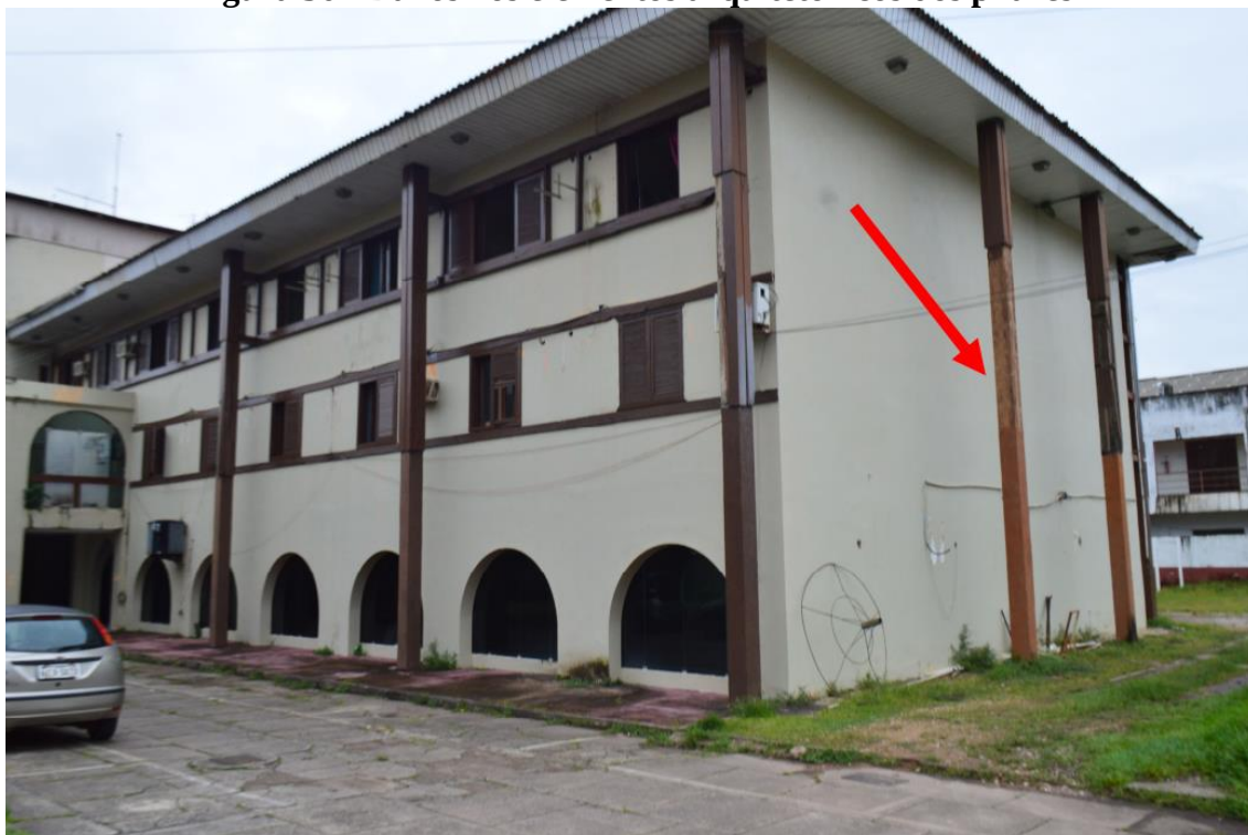
Figura 56 - Danos nos elementos arquitetônicos dos pilares
