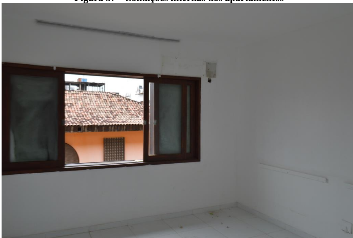
Figura 57 - Condições internas dos apartamentos
