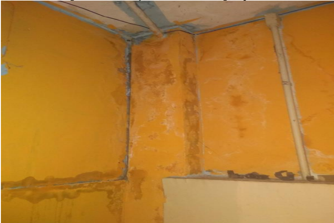
Figura 54 - Infiltrações decorrentes de águas pluviais
