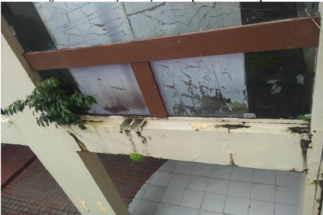
Figura 55 - Infiltração avançada na esquadria do hall superior
