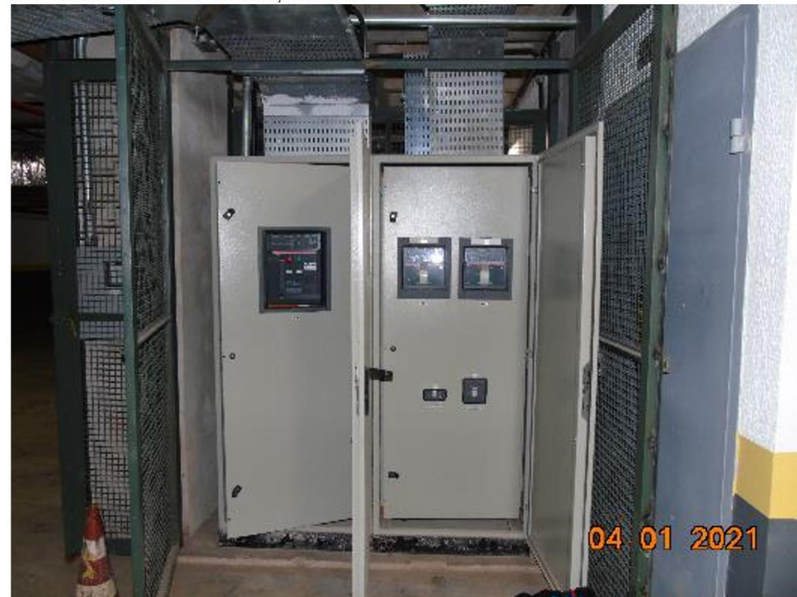
FOTO 7-CUBÍCULOS DE ENERGIA - DISTRIBUIÇÃO PRIMÁRIA
