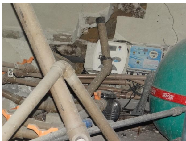
Figura 06 – Equipamento trocador de calor instalado pelo condomínio
