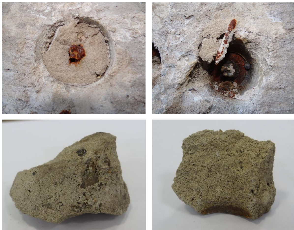
Figura 21 – Ausência de tamponamento adequado nas cordoalhas
