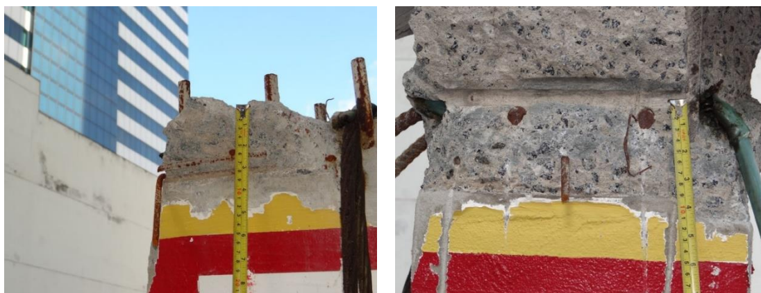
Figura 19 – Cordoalhas de protensão passando com excentricidade inferior ao determinado
