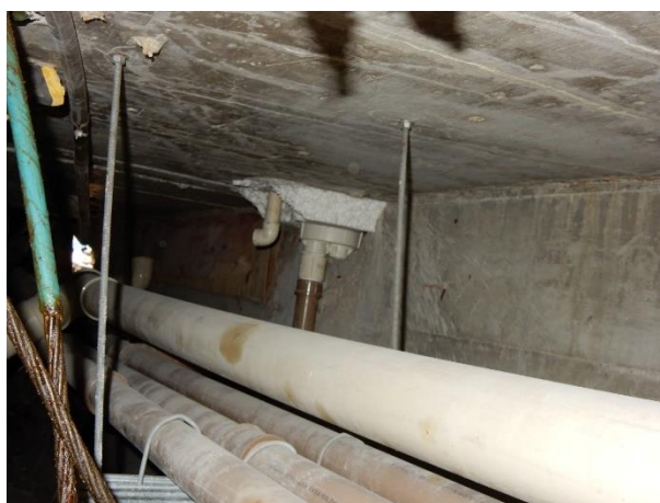
Figura 07 – Skimmer instalado pelo condomínio
