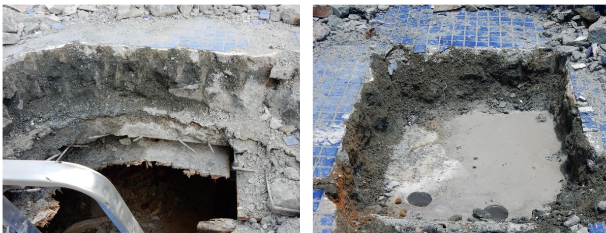
Figura 13 – Espessura excessiva da argamassa de regularização no piso
