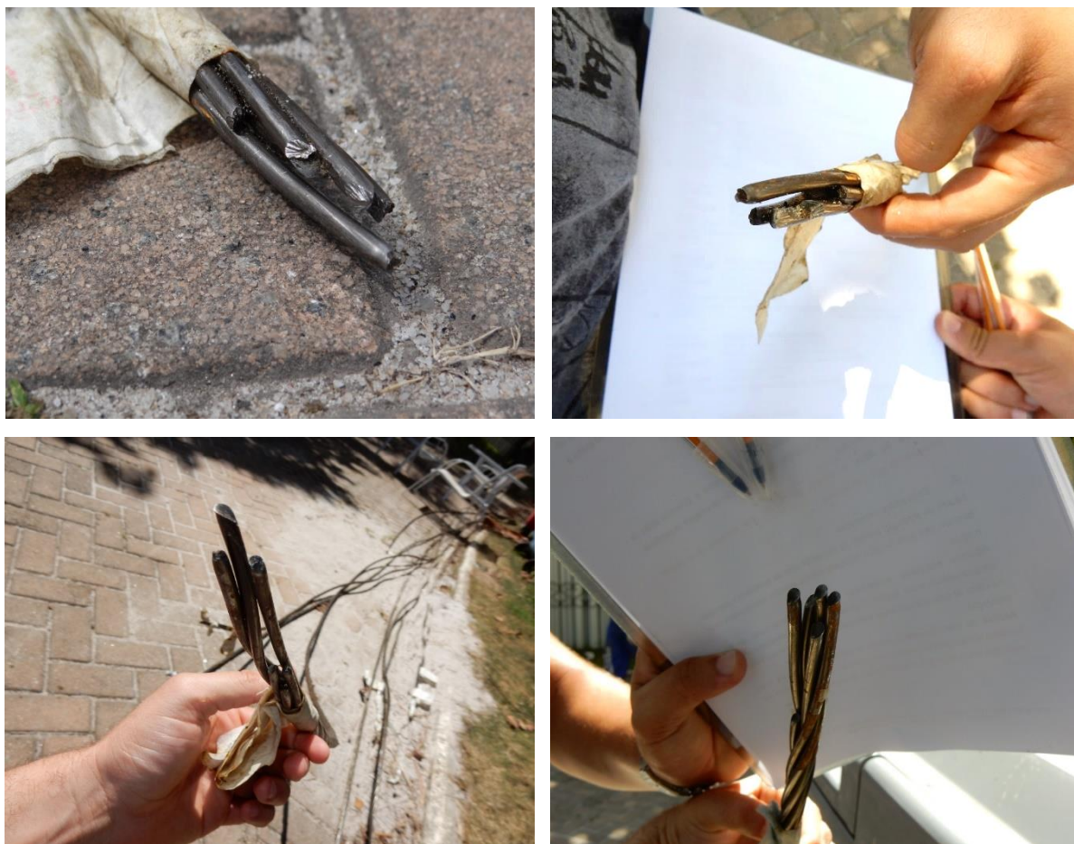
Figura 24 – Forma de rompimento das cordoalhas na queda
