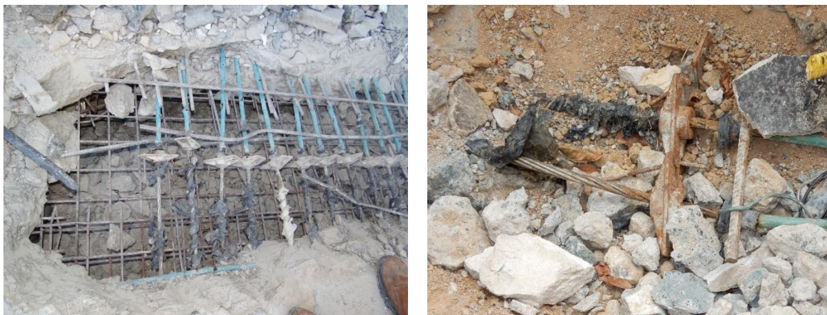
Figura 12 – Ausência de proteção adequada nas cordoalhas
