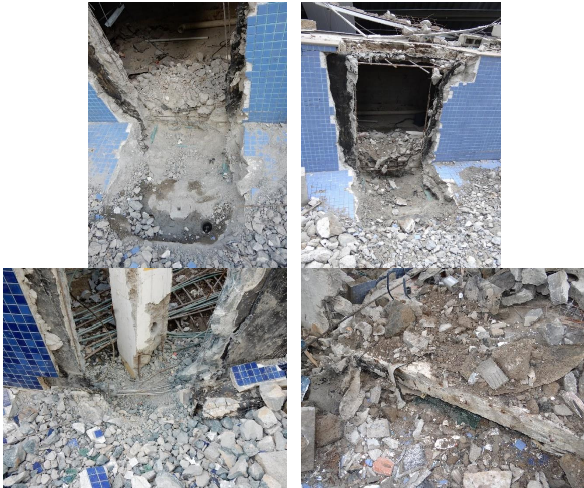
Figura 22 – Ausência de engastamento entre a laje e a parede da piscina
