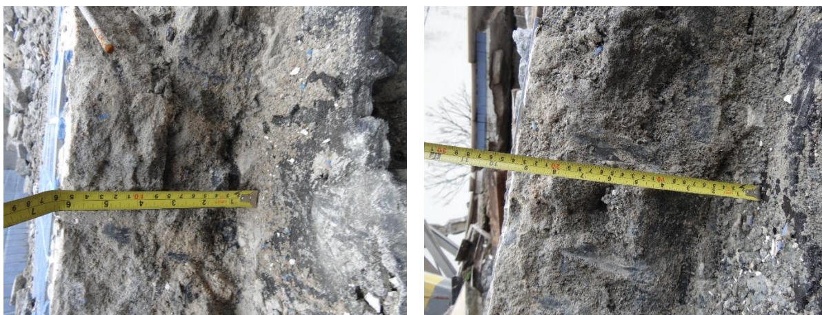
Figura 14 – Espessura excessiva da argamassa de regularização no piso
