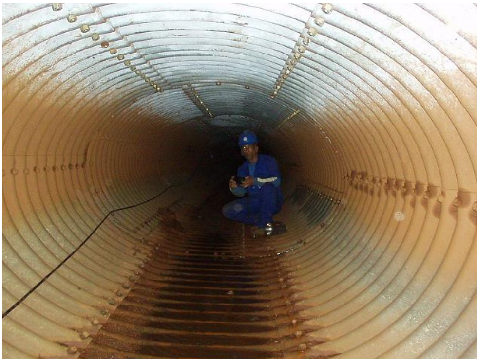
Figura 25 – Deformação diametral excessiva da tubulação de drenagem. Fonte: Elaborada pelos autores.
