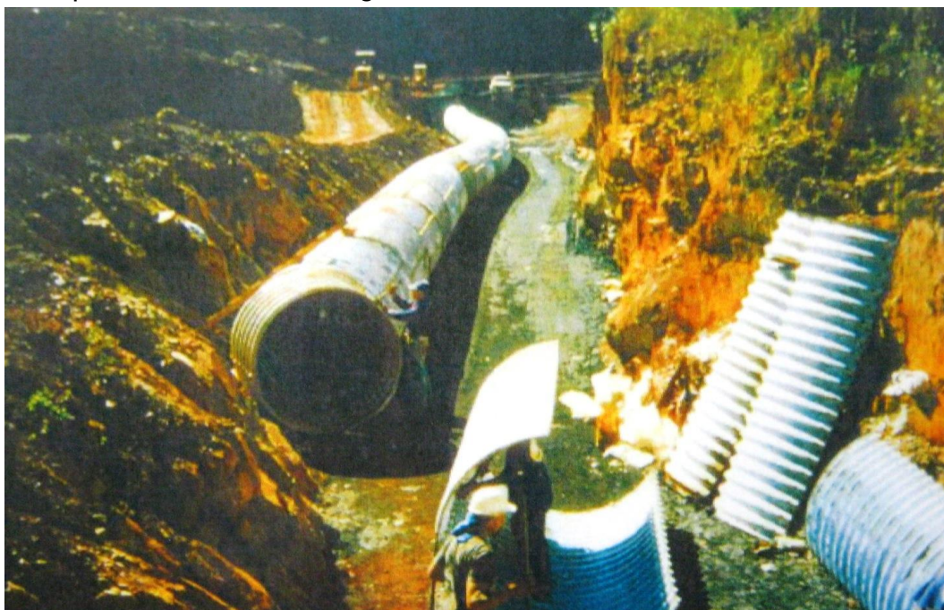
Figura 21 – Execução do aterro envoltório em desacordo com o projeto. Fonte: Elaborada pelos autores.
