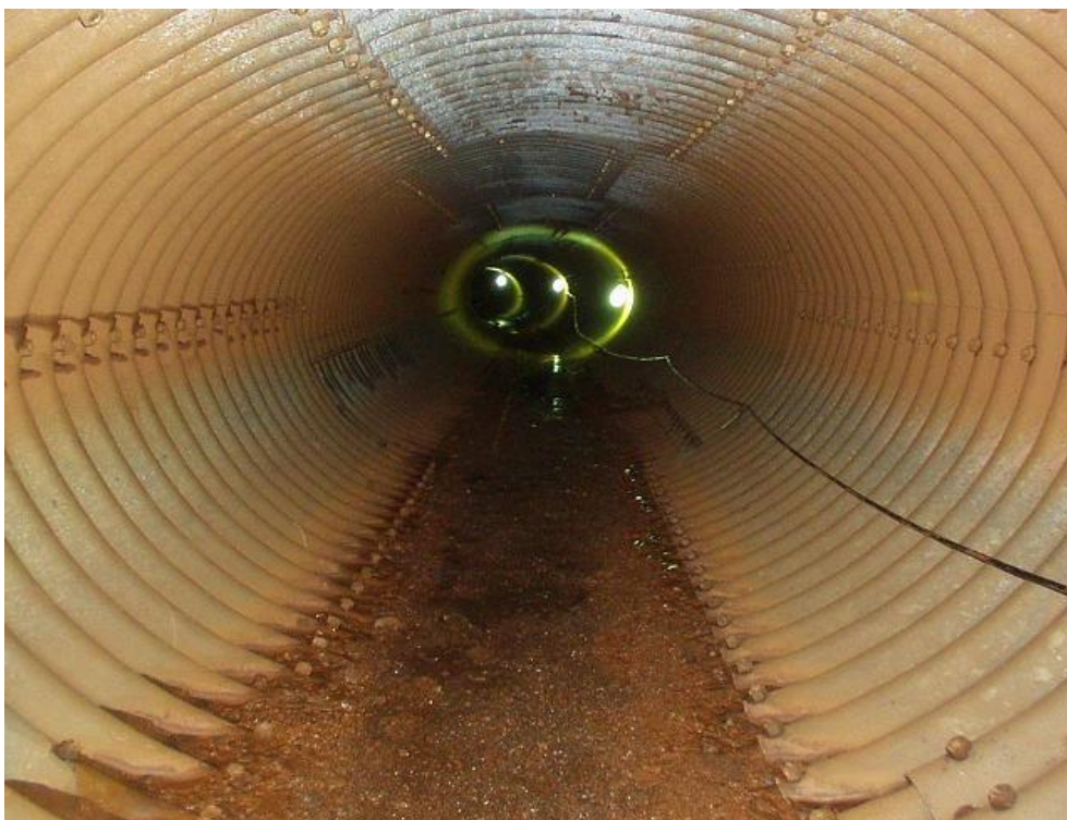
Figura 26 – Deformação diametral excessiva da tubulação de drenagem. Fonte: Elaborada pelos autores.
