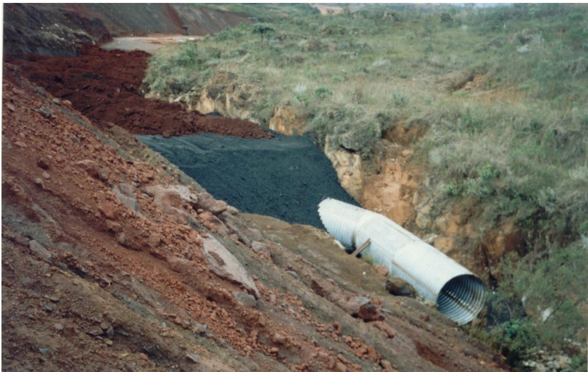
Figura 19 – Execução do aterro envoltório em desacordo com o projeto. Fonte: Elaborada pelos autores.
