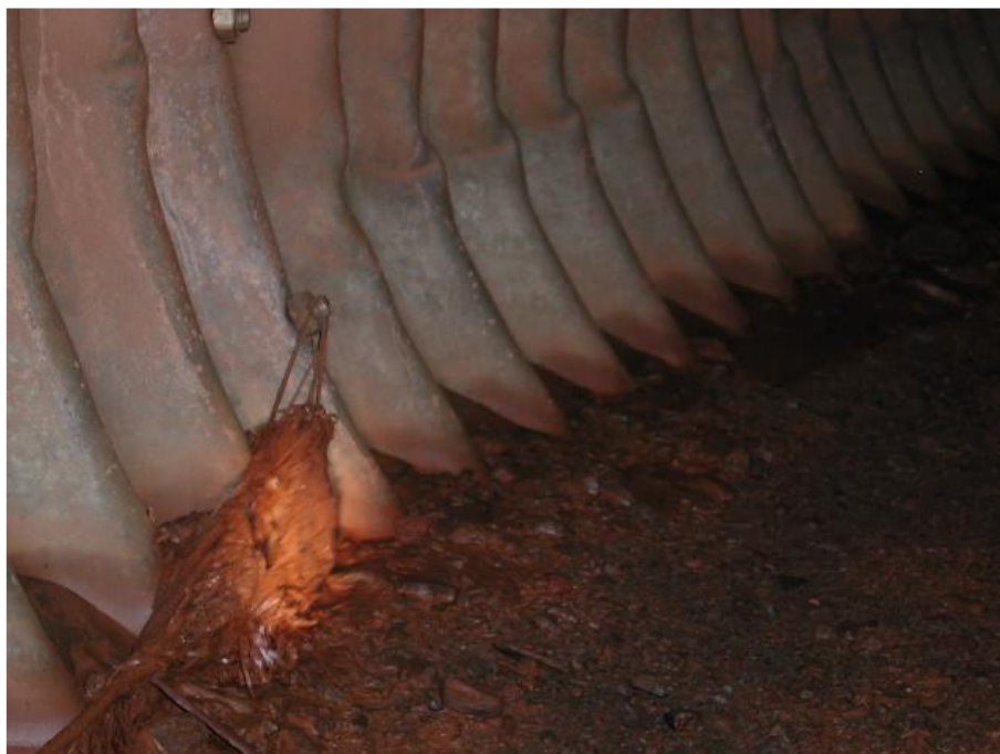
Figura 28 – Plastificação generalizada da chapa do tubo ao longo da geratriz por flexo-compressão e assoreamento da tubulação de aço.
