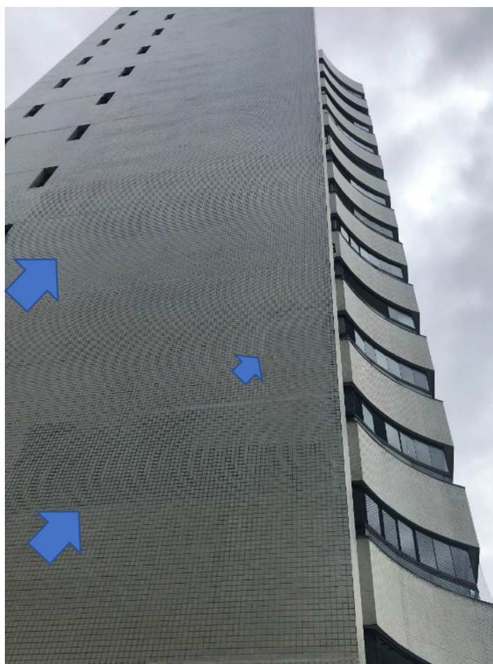
Figura 07 – Descolamento de pastilhas na fachada
