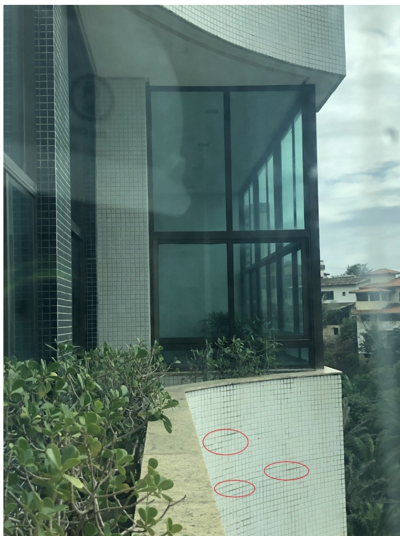
Figura 06 – Patologias no revestimento cerâmico
