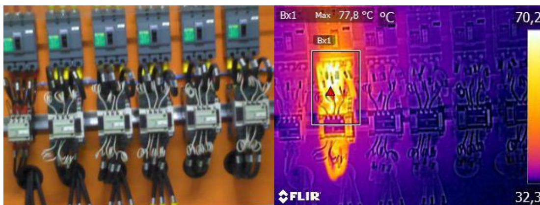
Figura 5 - Identificação de anomalia em disjuntor.
