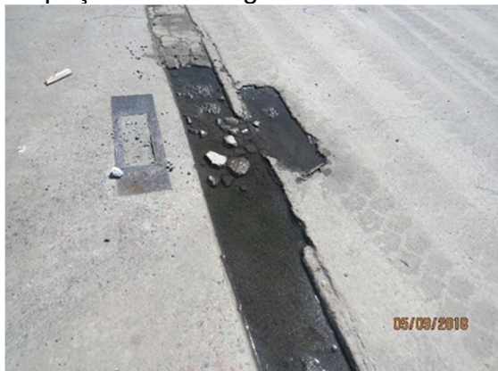
Figura 26 – PORÇÃO SUPERIOR. Observar falha no concreto causando empoçamento de água
