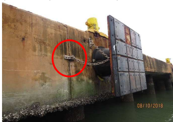
Figura 39 – PORÇÃO INFERIOR. Notar junta de dilatação sendo travada por parafusos (círculo vermelho)
