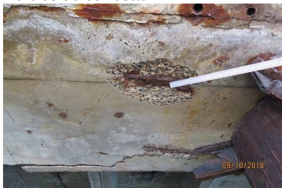
Figura 65 – PORÇÃO INFERIOR. Notar laje da borda da extremidade do Sistema A com armadura exposta e indícios de corrosão
