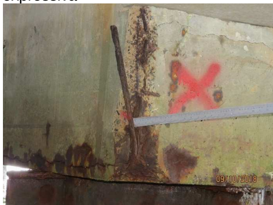
Figura 57 – PORÇÃO INFERIOR. Notar quina da viga de travamento do Sistema A na região das defensas, com armadura exposta e em corrosão expressiva
