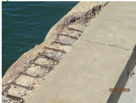
Figura 27 – PORÇÃO SUPERIOR. Concreto danificado com armadura exposta na borda do Píer (Sistema A)
