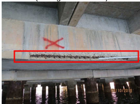
Figura 53 – PORÇÃO INFERIOR. Notar viga principal do Sistema A, com armadura exposta e com indícios de corrosão (retângulo vermelho)
