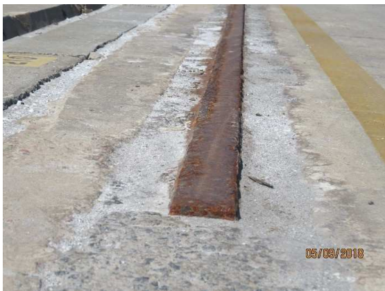
Figura 30 – FACE SUPERIOR. Detalhe da figura anterior. Notar trilho oxidado e sem uso
