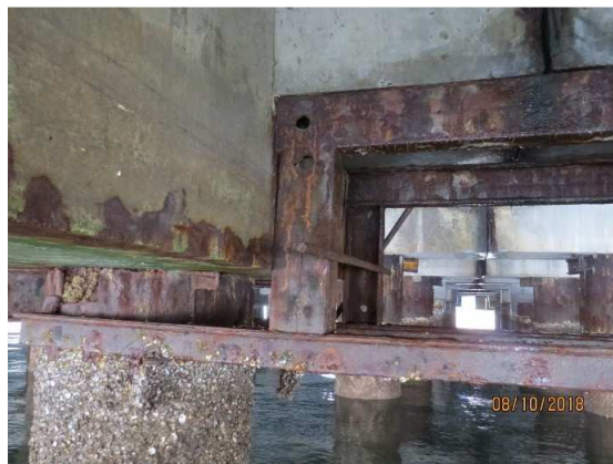
Figura 48 – PORÇÃO INFERIOR. Detalhe da figura anterior. Nota: a peça metálica não possui mais função estrutural.
