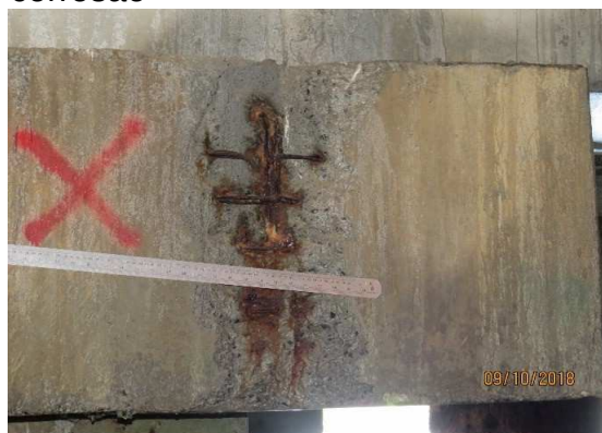
Figura 64 – PORÇÃO INFERIOR. Notar bloco de coroamento do Sistema B com armadura exposta e já em corrosão
