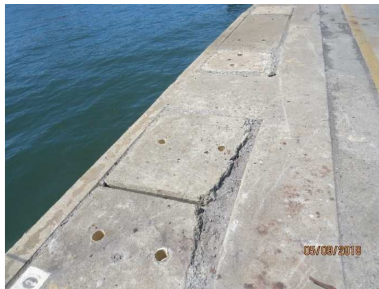
Figura 25 – PORÇÃO SUPERIOR. Observar concreto danificado
