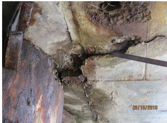
Figura 67 – PORÇÃO INFERIOR. Notar laje da borda da extremidade do Sistema A com deslocamento do concreto
