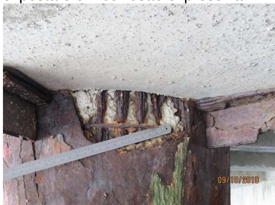
Figura 59 – PORÇÃO INFERIOR. Notar estaca do Sistema A com armadura exposta e em corrosão expressiva
