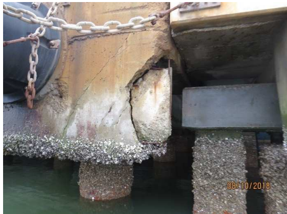
Figura 37 – PORÇÃO INFERIOR. Notar paramento com concreto danificado, armadura rompida, exposta e com indícios de corrosão
