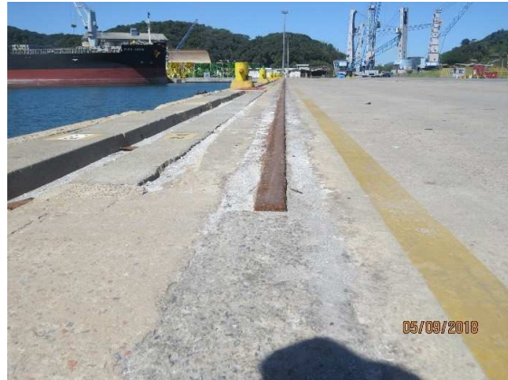
Figura 29 – FACE SUPERIOR. Observar trilho em desuso
