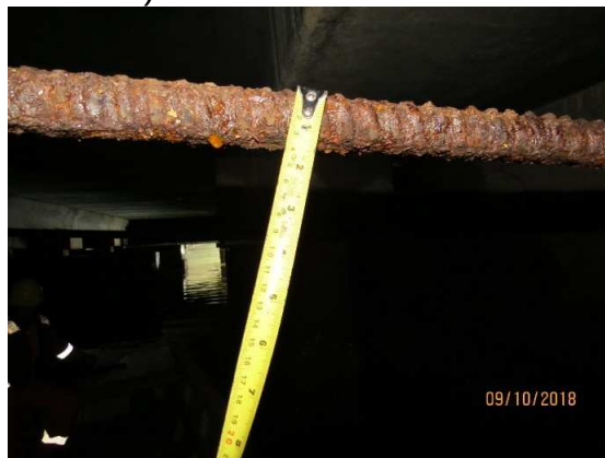
Figura 46 – PORÇÃO INFERIOR. Notar tirante encontrado na região da ponte de acesso (com 4cm de diâmetro)
