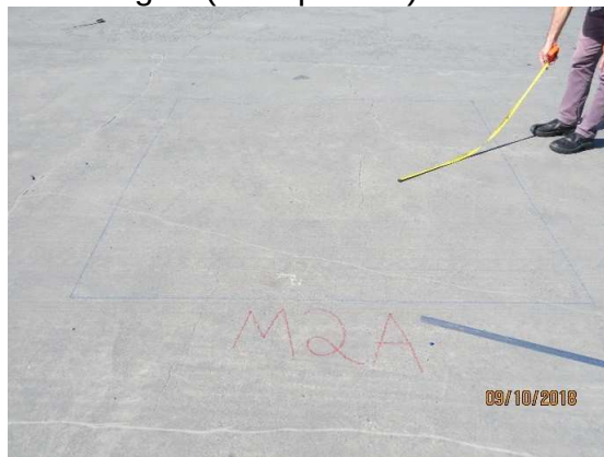
Figura 17 – PORÇÃO SUPERIOR. Levantamento de fissuras por amostragem (área-padrão)
