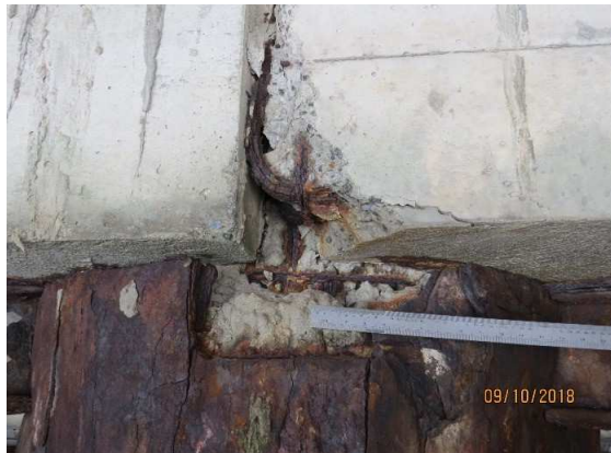
Figura 55 – PORÇÃO INFERIOR. Notar encontro da viga principal do Sistema A com armadura exposta e apresentando corrosão
