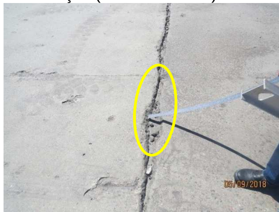
Figura 23 – PORÇÃO SUPERIOR. Ocorrência de esborcinamento na junta de dilatação (círculo amarelo)
