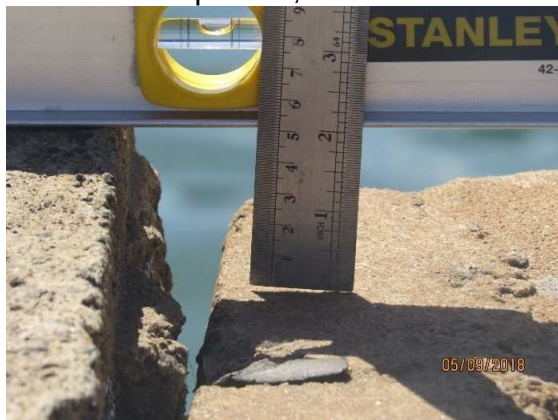
Figura 22 – PORÇÃO SUPERIOR. Detalhe da figura anterior. Observar desnível de aprox. 5,5cm
