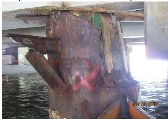
Figura 61 – PORÇÃO INFERIOR. Notar estaca do Sistema A com perda de seção de concreto, armadura exposta e rompida, devida a corrosão expressiva
