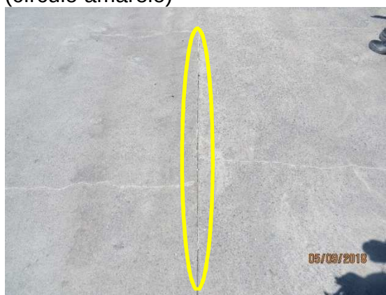
Figura 13 – PORÇÃO SUPERIOR. Junta de concretagem observada in loco (círculo amarelo)
