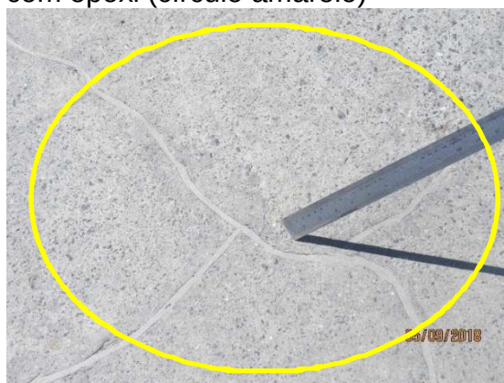
Figura 15 – PORÇÃO SUPERIOR. Fissuras encontradas e com tratamento com epóxi (círculo amarelo)
