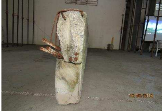
Figura 8 – Viga VP-02 Eixo 02. Vista frontal do dente Gerber com detalhe das armaduras retorcidas
