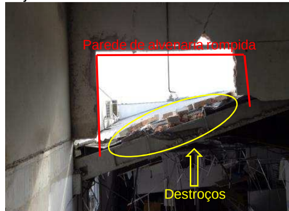
Figura 48 – Parede de fechamento do compartimento dos reservatórios rompida com destroços sobre a cobertura adjacente
