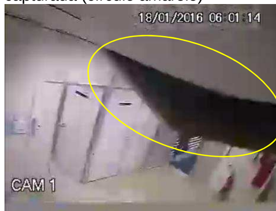
Figura 60 – Colapso em curso. Notar forro desabando, na última imagem capturada (círculo amarelo)
