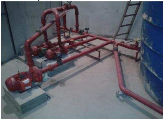
Figura 53 – Disposição das bombas elétricas do sistema Preventivo de Incêndio (datada de 12/03/2015)
