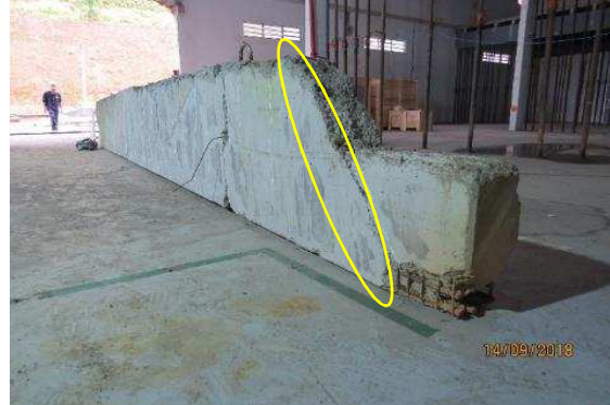
Figura 9 – Viga VP-02 Eixo 02. Detalhe da viga sem o dente Gerber, rompido em fissura de 45° (círculo amarelo)
