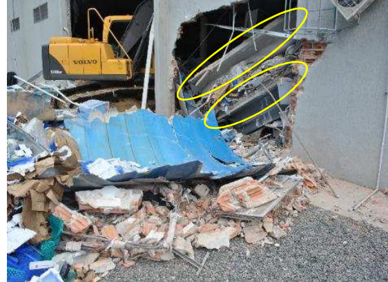
Figura 46 –Capa das lajes com deslocamento na parte adjacente à parede (elipses amarelas)
