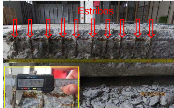
Figura 21 – Viga VP02 Eixo 02 com estribos medindo 5,27 mm a cada 5 cm, aproximadamente (setas vermelhas)
