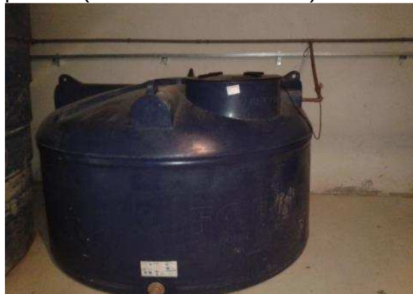
Figura 54 – Reservatório de 5.000 litros adicionado posteriormente, próximo à parede (datada de 15/07/2015).
