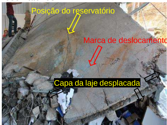
Figura 43 – Destroços das lajes. Capa da laje do nível dos reservatórios deslocada e com marca dos reservatórios
