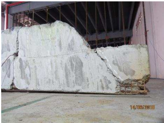
Figura 10 – Viga VP-02 Eixo 02. Detalhe das fissuras ressaltadas nos pontilhados em branco
