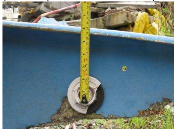
Figura 31 – Tubo de alimentação de água (distante aprox. 12,50 cm, da borda)
