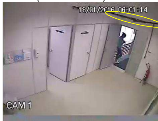
Figura 56 – Imagens do circuito de câmeras. Notar placa do forro, fixada na laje e se desprendendo, próximo à porta externa (círculo amarelo)
