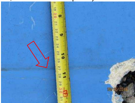
Figura 34 – Destroços dos reservatórios. Marca d' água do nível máximo típico, destacada na Figura anterior (distante 27,0 cm da borda superior)
