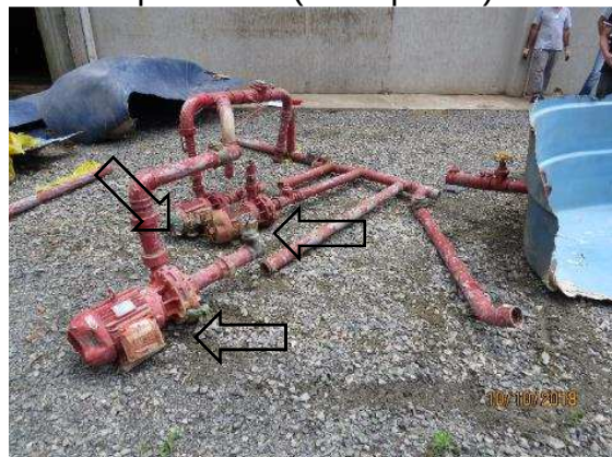
Figura 37 – Reconstituição do traçado dos tubos do sistema de incêndio preservados e dispostos conforme instalados. Notar três bombas presentes (setas pretas)
