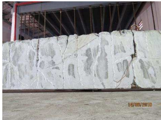
Figura 11 – Viga VP-02 Eixo 02. Detalhe das fissuras ressaltadas nos pontilhados em branco
