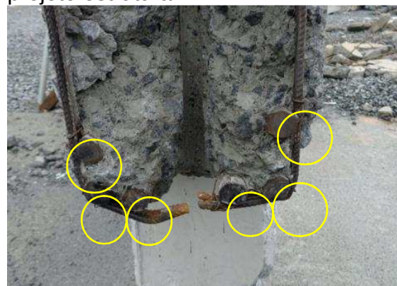
Figura 50 – Viga VP-02 Eixo 02. Detalhe da Figura anterior com armadura do tirante sem dobra, diferente do previsto no projeto estrutural
