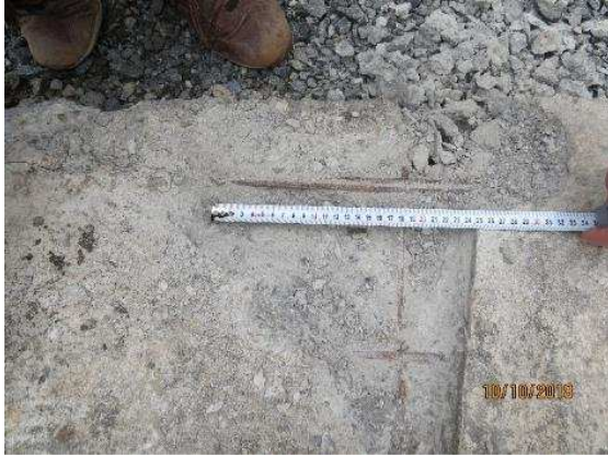
Figura 26 – Espaçamento transversal dos estribos da capa da laje dos reservatórios a cada 18,0 cm
