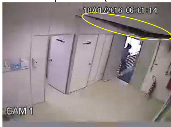
Figura 57 – Colapso em curso. Notar forro se desprendendo (círculo amarelo)
