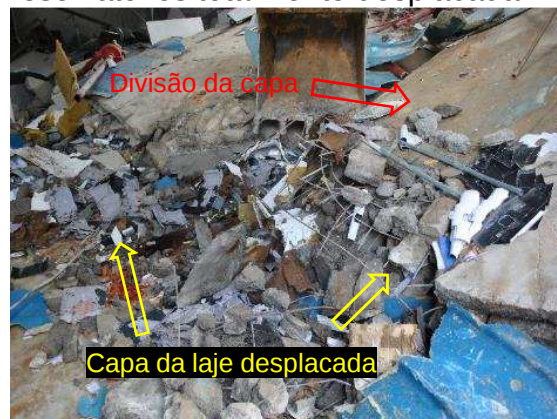
Figura 44 – Capa da laje do nível dos reservatórios totalmente deslocada.
