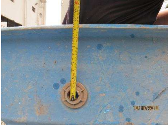
Figura 32 – Destroços dos reservatórios. Tubo extravasor (distante aprox. 24,0 cm, da borda)
