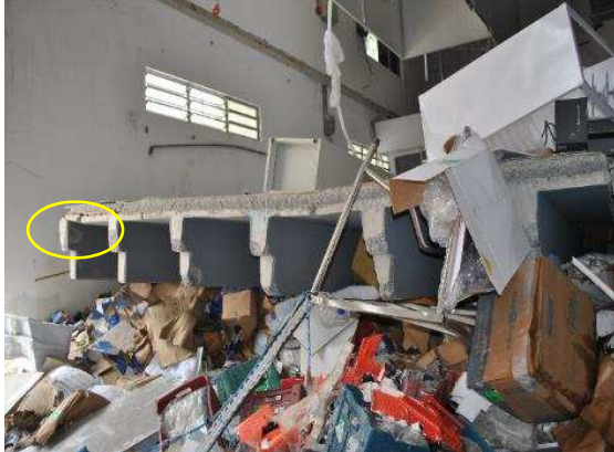
Figura 45 –Laje do 1º pavimento com deslocamento da capa na parte adjacente à parede (elipse amarela)
