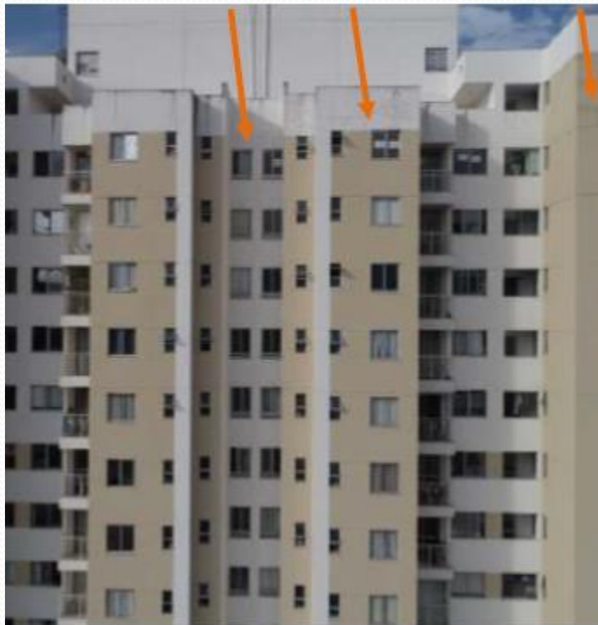
Imagem 53 - Fissuras em fachadas, com aspectos de descuido.
