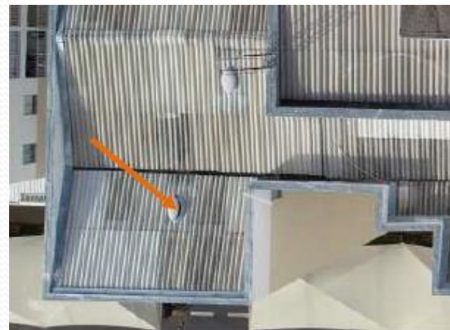
Imagem 47 - Telhado Bloco 2 claraboia não tampada
