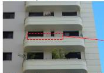
FOTO 54 - Marmore solto no 9º pavimento da fachada sudoeste, lado direito.
