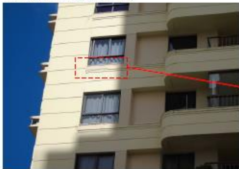
FOTO 18 – Trecho sem mármore no 7º pavimento da fachada nordeste, lado esquerdo.
