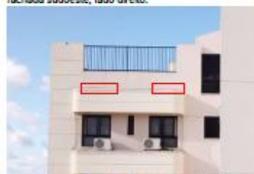
FOTO 56 - Marmores soltos no 15º pavimento da fachada sudoeste, lado esquerdo.
