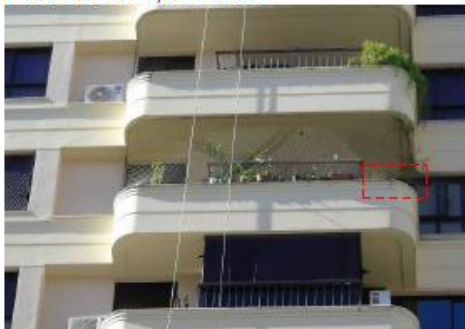
FOTO 14 – Concreto solto no 11º pavimento da fachada sudoeste, lado esquerdo.
