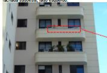
FOTO 48 - Marmore solto no 5º pavimento da fachada sudoeste, lado direito.
