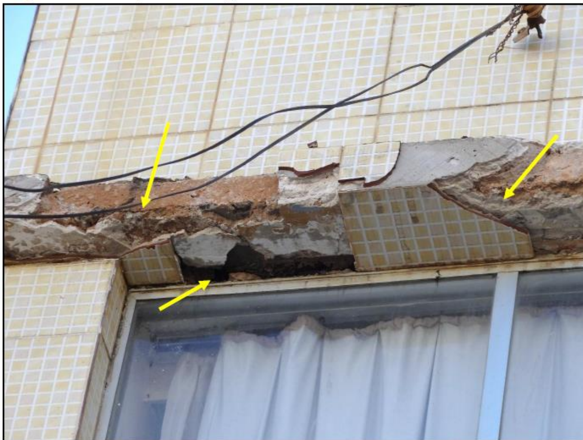
10 – Detalhe da Foto 3, região entre primeiro e segundo pavimento – Deslocamento do revestimento cerâmico e perda do substrato argamassado.
