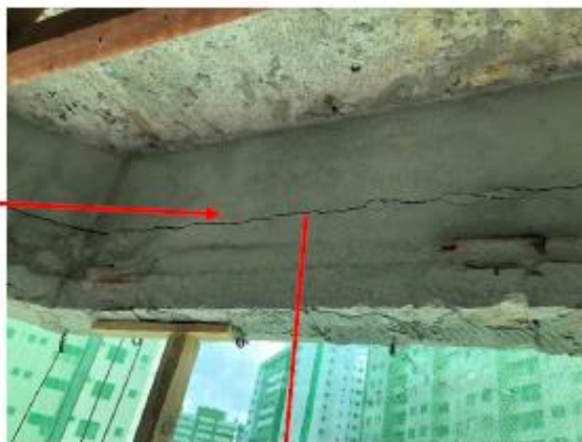
Foto 20 – Detalhe 1 do descolamento da alvenaria sob a viga.
