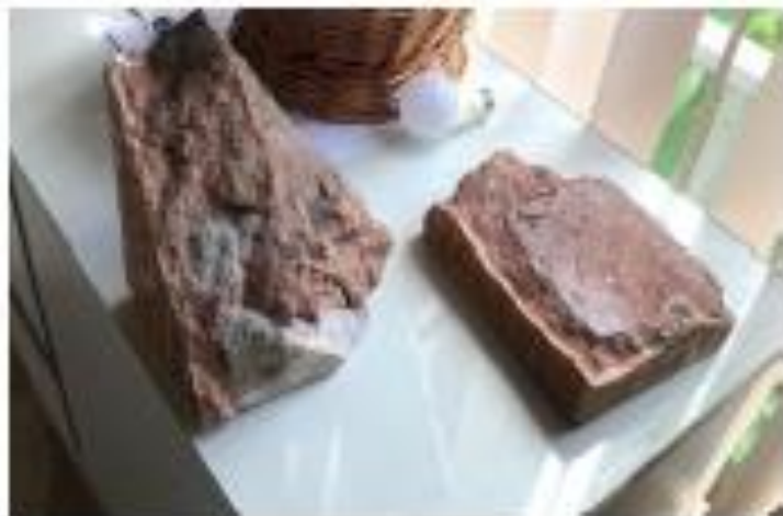
Foto 48 – Fragmentos deslocados da fachada.
