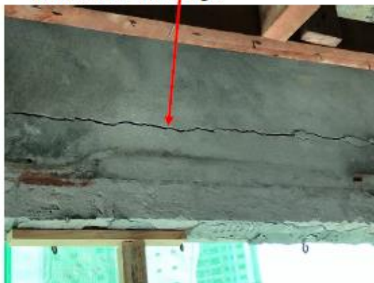
Foto 22 – Detalhe 3 do descolamento da alvenaria sob a viga.
