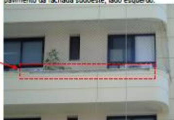
FOTO 49 - Detalhe do marmore removido no 5º pavimento da fachada sudoeste, lado direito.
