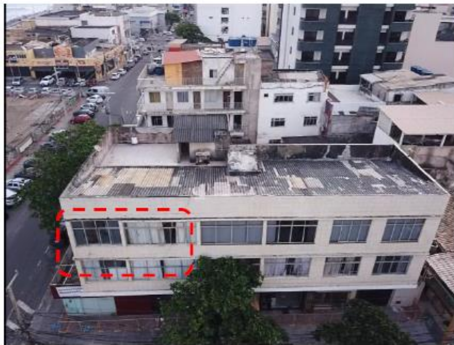
Foto 1 – Vista frontal da fachada com detalhe da área afetada.
