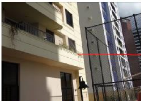
FOTO 16 – Trecho sem mármore no 1º pavimento da fachada nordeste, lado direito.
