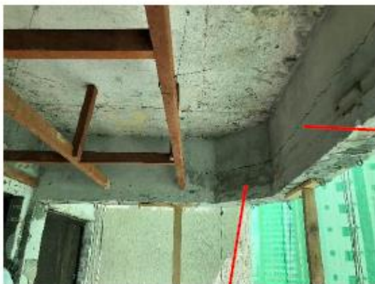
Foto 19 – Vista da fissura de descolamento da alvenaria sob a viga.
