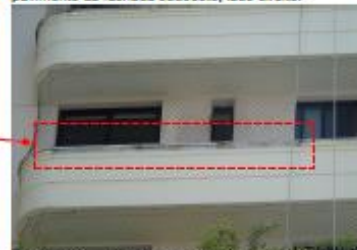
FOTO 55 - Detalhe do marmore removido no 9º pavimento da fachada sudoeste, lado direito.
