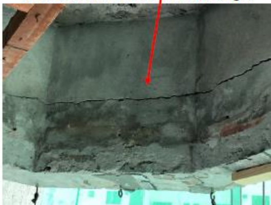
Foto 21 – Detalhe 2 do descolamento da alvenaria sob a viga.
