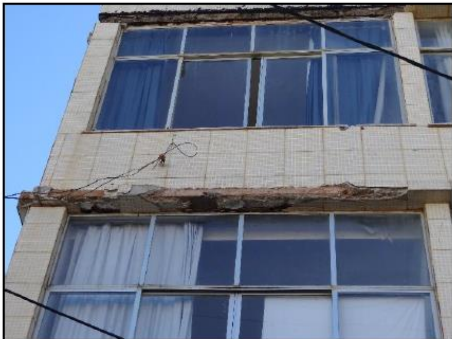
Foto 3 – Vista geral da área afetada.
