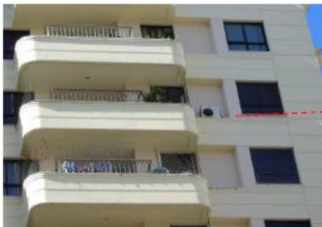
FOTO 12 – Mármore solto no 9º pavimento da fachada sudoeste, lado direito.
