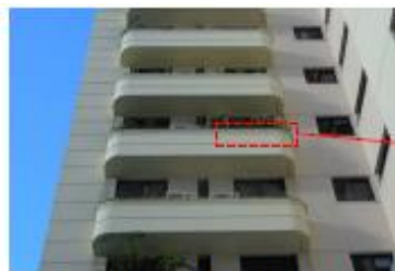
FOTO 46 - Marmore solto no 5º pavimento da fachada sudoeste, lado esquerdo.
