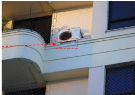
FOTO 13 – Mármore removido no 9º pavimento da fachada sudoeste, lado direito.
