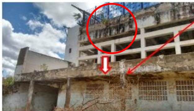
Figura 17 - Detalhe 2 do processo de corrosão dos
