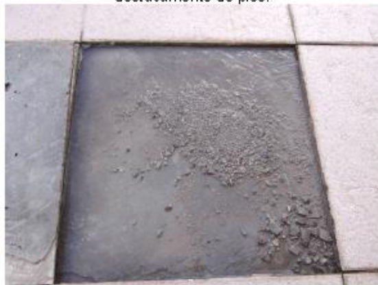
Figura 14 – Detalhe 5 do destacamento do piso.
