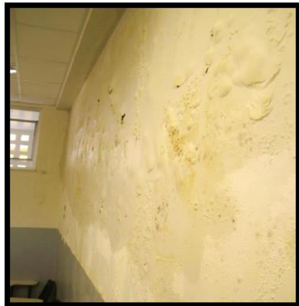
Foto 27b Infiltração na parede da sala de aula do Pavilhão de aulas / Campus Amargosa.
