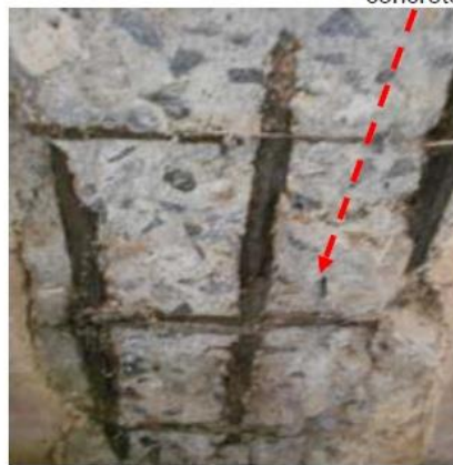
Foto 13: detalhe 2: Corrosão das armaduras do pilar.
