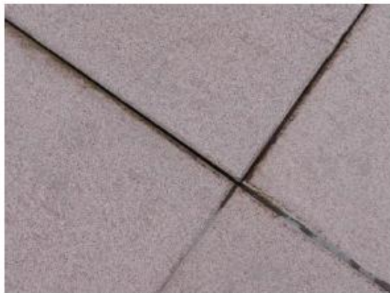
Figura 11 – Detalhe 2 da falha no rejunte e destacamento do piso.
