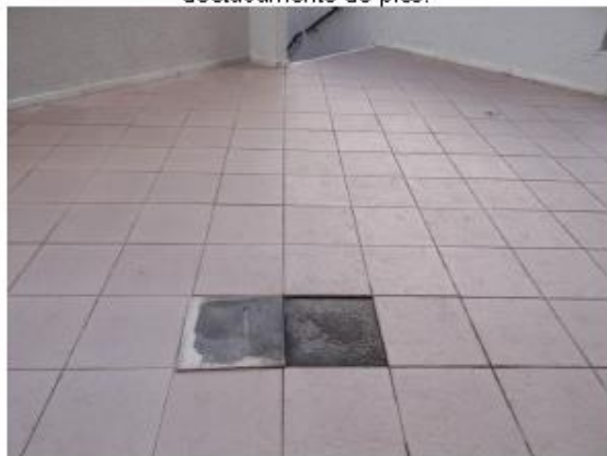
Figura 13 – Detalhe 4 do destacamento do piso.
