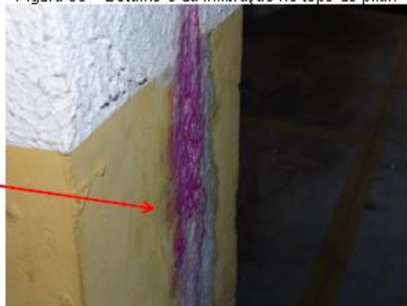
Figura 58 – Detalhe 2 da infiltração no meio do pilar.
