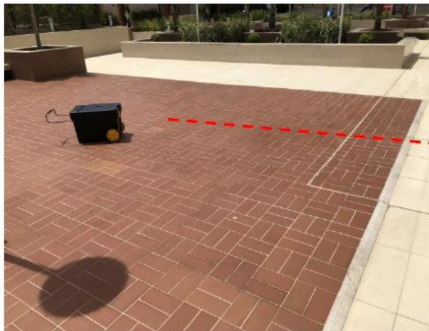
FOTO 20 – Vista de falhas no rejunte do piso
