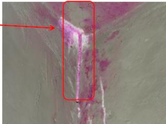
Figura 56 – Detalhe 5 da infiltração no topo do pilar.
