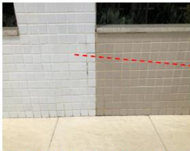
FOTO 18 – Vista da fissuração no revestimento
