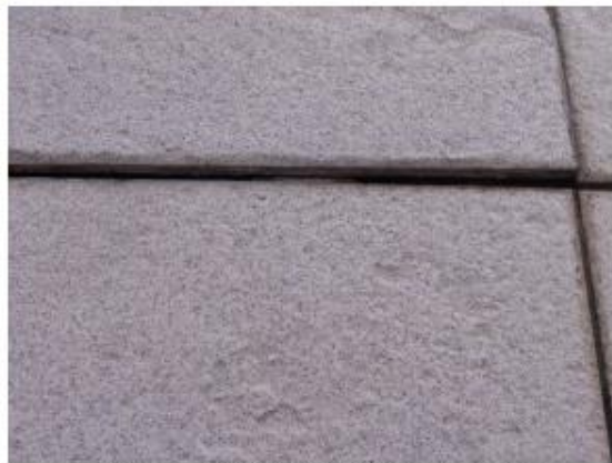
Figura 12 – Detalhe 3 da falha no rejunte e destacamento do piso.
