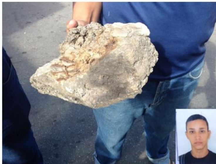
Pai mostra parte de reboco que caiu de viaduto e atingiu Marlon (no destaque) (Foto: Mariucha Machado/G1)
