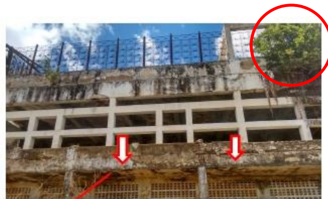
Figura 16 – Detalhe 1 do processo de corrosão dos elementos estruturais.
