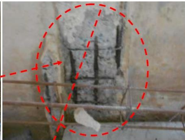
Foto 12: Detalhe 1: Deslocamento do cobrimento do concreto e corrosão das armaduras.
