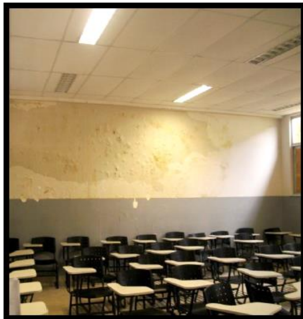
Foto 27a Infiltração na parede da sala de aula do Pavilhão de aulas / Campus Amargosa.
