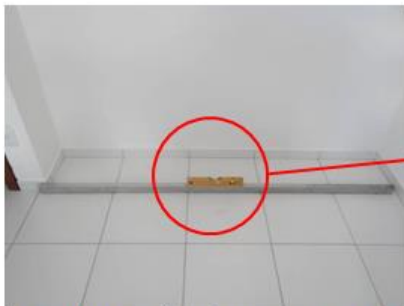
Figura 1 – Verificação do nível do piso no quarto 1.
