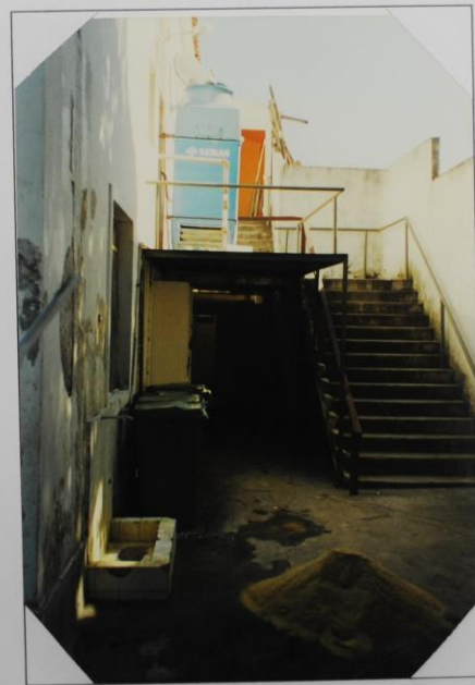
FACHADA LATERAL . ACRÉSCIMO SEM ANUÊNCIA DO IPHAN
