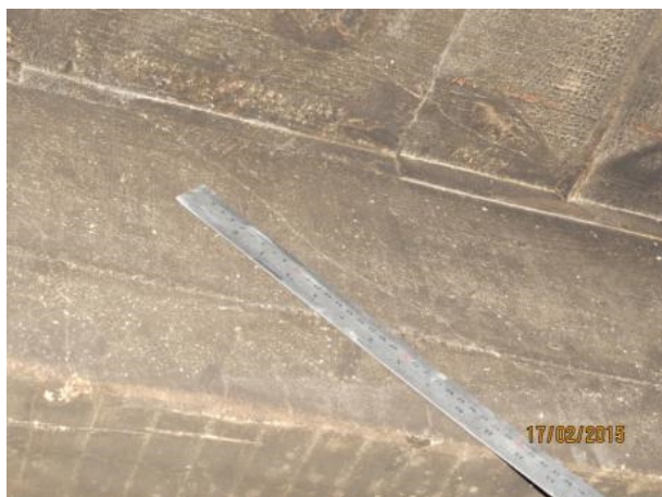
Figura 13 – SALA 09. No detalhe, trincas localizadas em laje e viga próximas ao ponto 11
