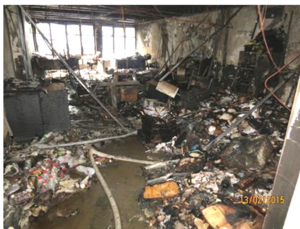
Figura 2 – SALA 09. Notar situação no dia seguinte ao ocorrido
