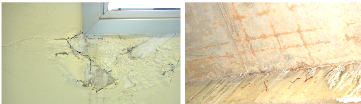
Fotos 5 e 6: Infiltração com deslocamento do revestimento e infiltração com presença de eflorescência, respectivamente. Fonte: Arquivos do autor.
