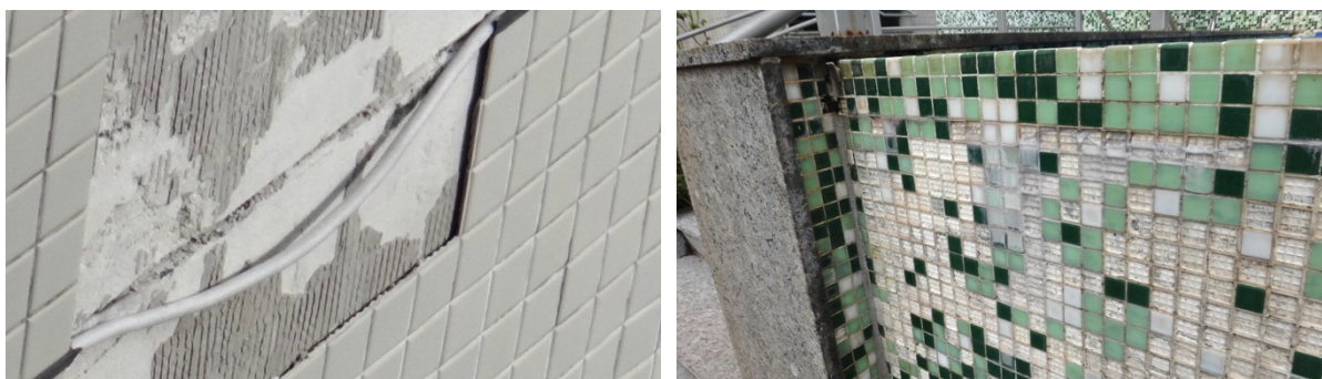
Fotos 7 e 8: Deslocamento do revestimento cerâmico e deslocamento do revestimento em pastilha, respectivamente. Fonte: Arquivos do autor.
