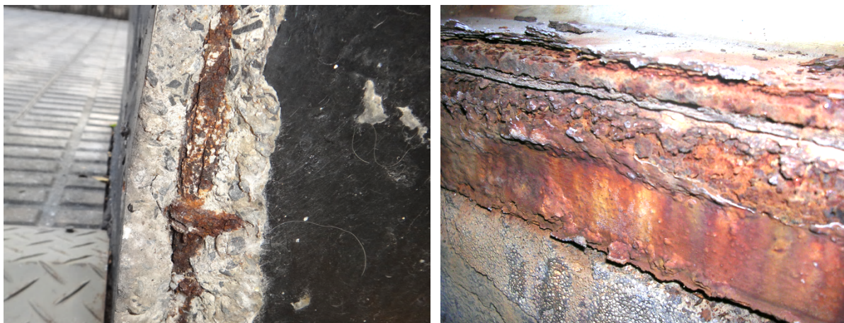
Fotos 3 e 4: Corrosão de armadura com deslocamento do concreto e corrosão em estrutura metálica, respectivamente. Fonte: Arquivos do autor.
