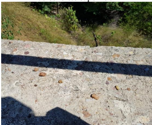
Figura 04- Desprendimento dos agregados do concreto superficial
