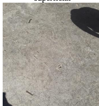
Figura 03 – Regiões onde se encontram ou se encontravam pedaços de madeira no concreto superficial
