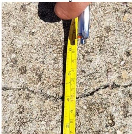
Figura 09– Fissuras encontradas ao longo da barragem
