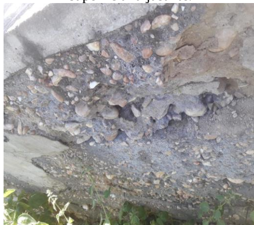
Figura 05- Desprendimento do concreto superficial a jusante.
