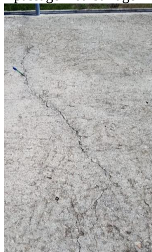
Figura 10 - Fissuras de um lado a outro da passagem da barragem
