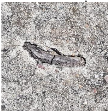
Figura 02 – Pedaco de madeira encontrado no concreto superficial
