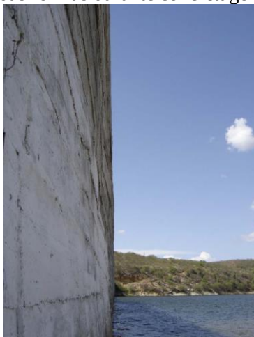
Figura 08 – Paramento de montante apresentando irregularidades causadas por falha de instalação das formas durante concretagem
