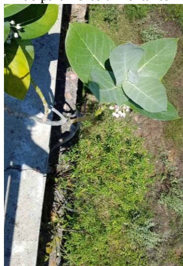
Figura 07 – Vegetação nascendo nas dobras do paramento a montante
