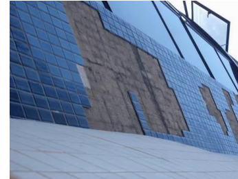
Fadiga e perda de aderência do material cerâmico da fachada
