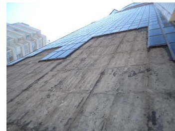
Porosidade da argamassa de rejunte e perda de aderência com remoção das peças cerâmicas
