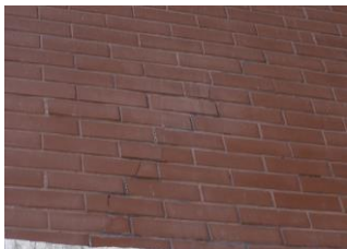
Trincamento nas elevações de alvenaria
